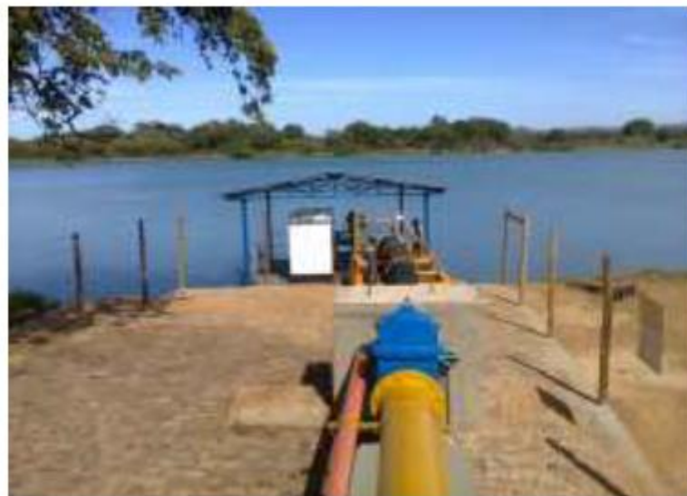
Estação ETA 1 - montante
