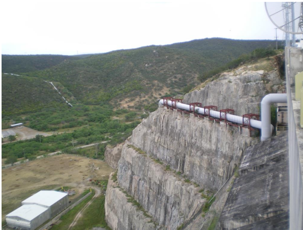
Adutora para irrigação oriundo do reservatório de Xingó. (Foto do autor)
