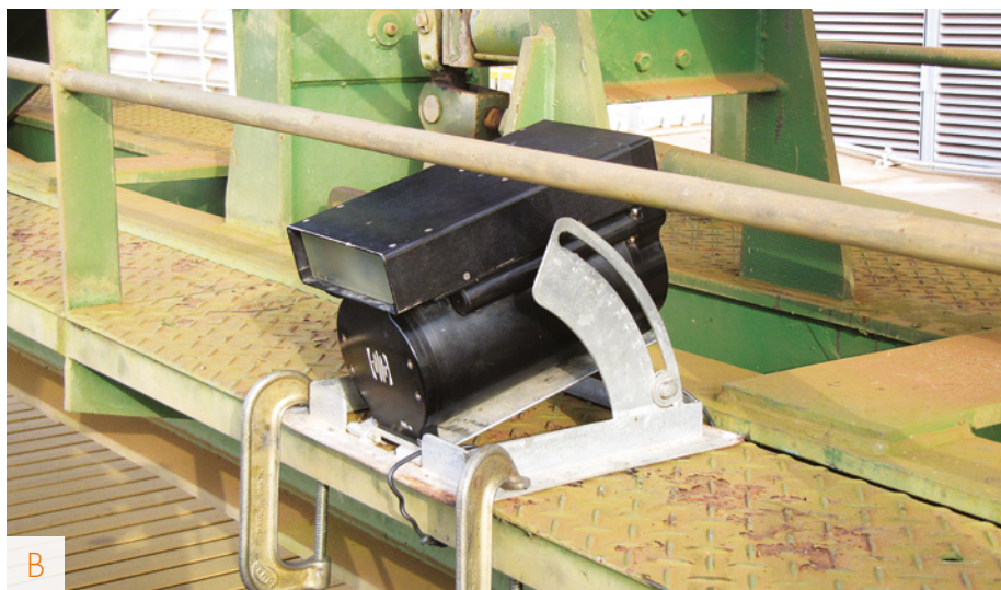
FIGURA 8 – Ecossonda científica digital ( Biosonics Inc. ) utilizada para avaliação da distribuição de peixes no canal de fuga da UHE Três Marias, unidade de superfície conectada ao computador, à esquerda, e transdutor que está conectado à unidade de superfície, preso à lateral da embarcação a 50 cm da superfície da água, à direita (A). Dual-frequency IDentification SONar (DIDSON – Sound Metrics) utilizado para avaliar a densidade de peixes nas UHEs São Simão e Amador Aguiar II (B). Foto B: Alejandro Giraldo.
