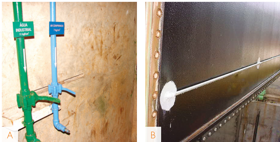
FIGURA 6 – Instalação de sistema de fornecimento de água (tubulação verde) e ar comprimido (tubulação azul) na UHE Emborcação (A) e de sistema de aeração no painel stop log da UHE Funil (B).
