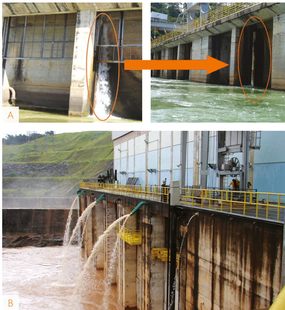
FIGURA 4 – Canalização da água de refrigeração dos geradores da UHE Três Marias (A). Alongamento da saída da água de refrigeração na UHE Funil afastando das paredes da casa de força (B).
