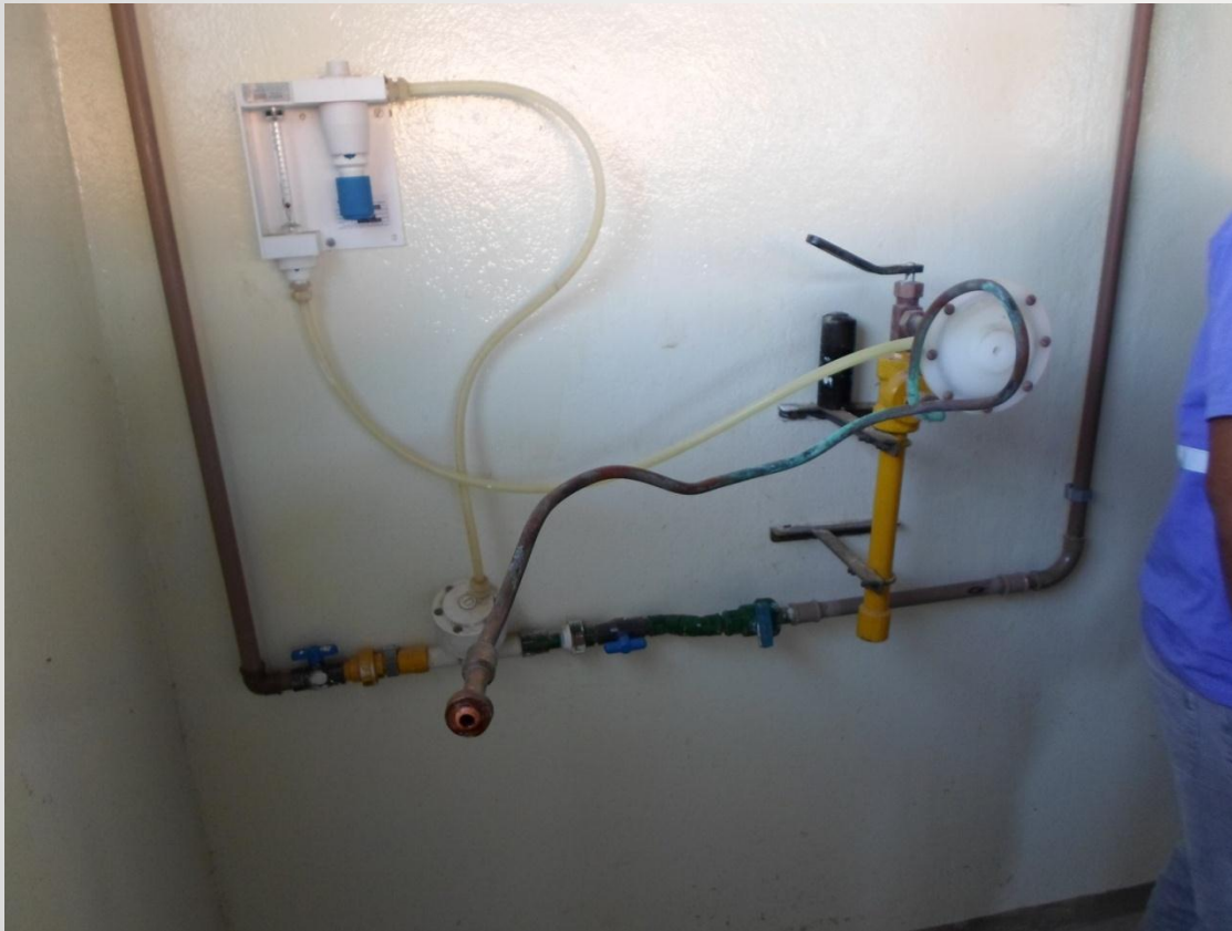
Ausência de cloração na água
