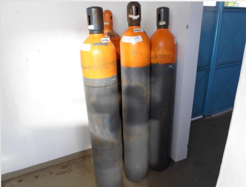
Armazenagem inadequada dos cilindros de cloro gás
