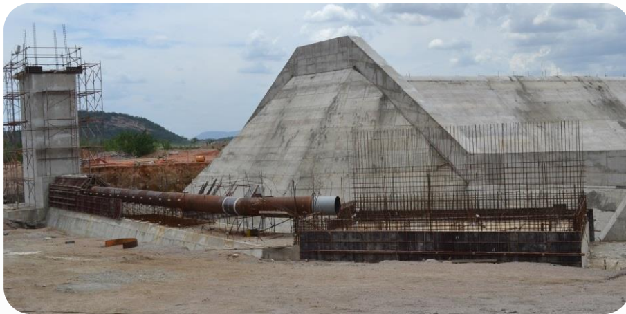
Tomada de uso difuso do Res. Serra do Livramento - Montagem da tubulação da adutora.
