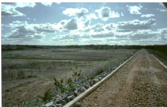
Foto 2. Vista Noroeste da Barragem-mãe Vira Beiju (em colapso)
