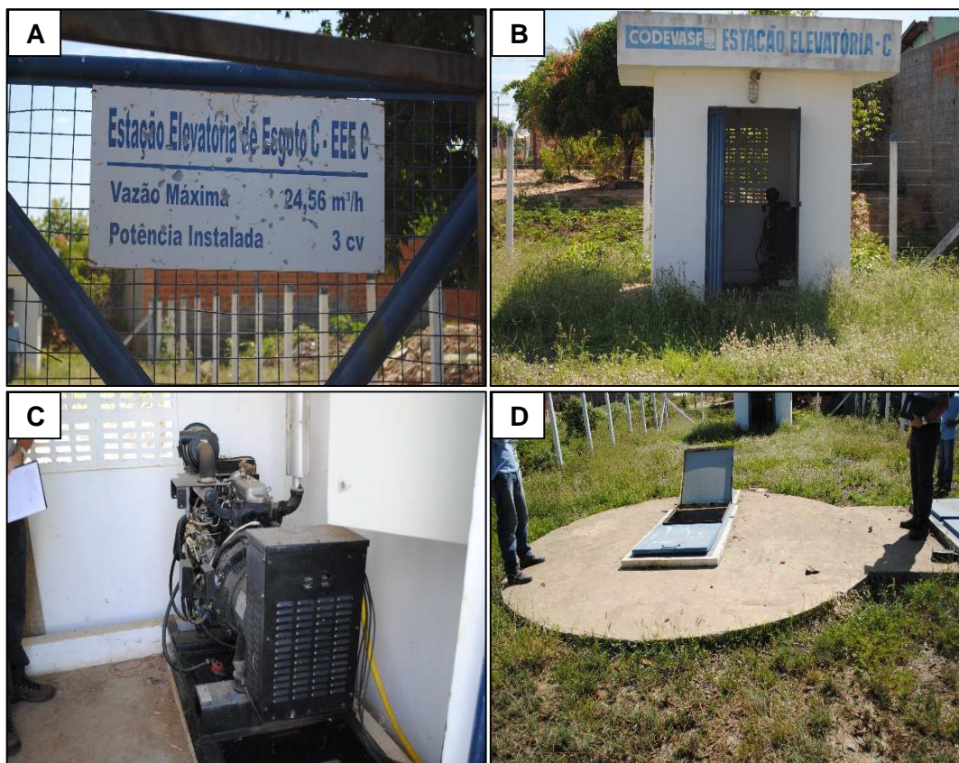
Figura 6.81 – Estação Elevatória de Esgoto - EEE 03.
