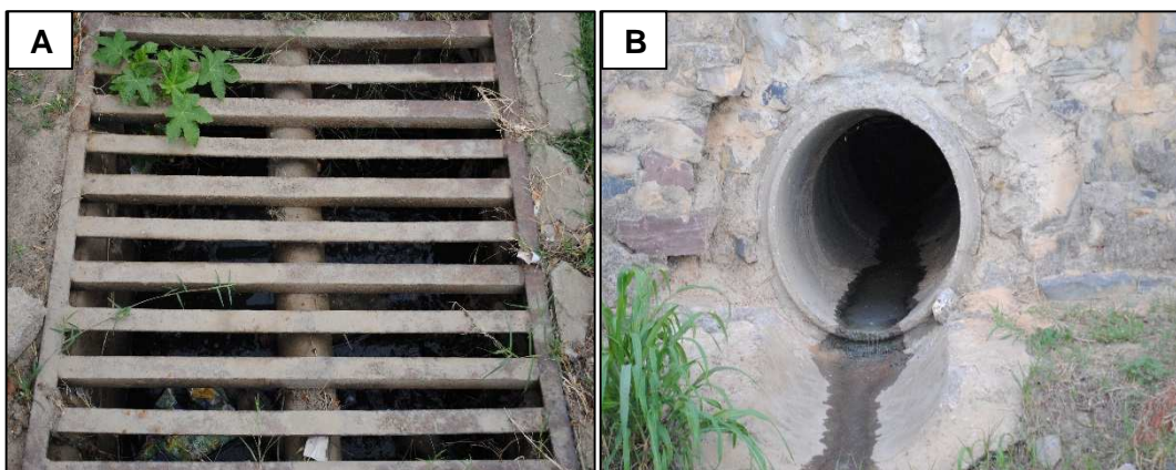
Figura 6.150 – Lançamento de esgoto na rede de drenagem. Fonte: DRZ Geotecnologia e Consultoria (2015).
