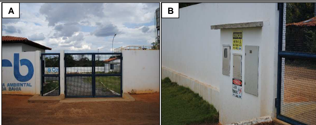
Figura 6.54 – Entrada da estação de tratamento e comando de energia. Fonte: DRZ Geotecnologia e Consultoria (2015).
