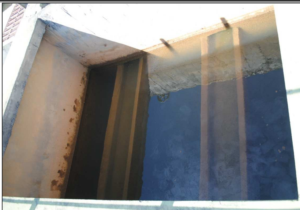
Figura 6.18 – Filtros da ETA. Fonte: DRZ Geotecnologia e Consultoria (2015).
