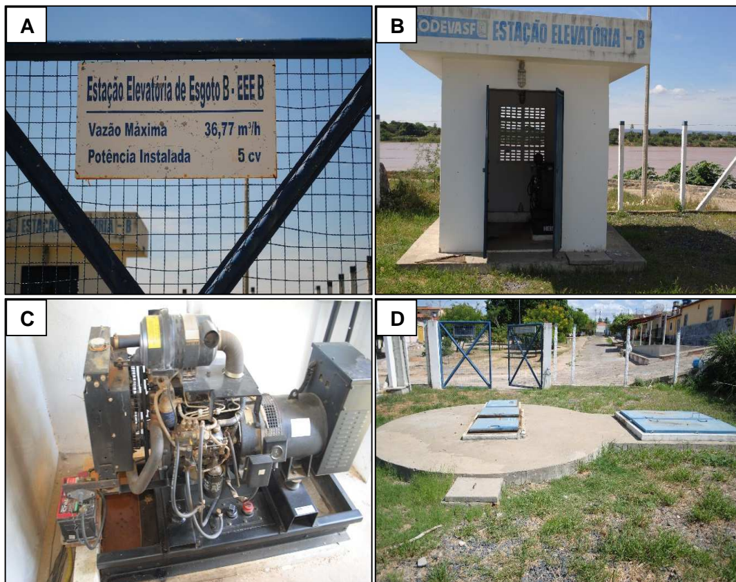
Figura 6.80 – Estação elevatória de esgoto - EEE 02.
