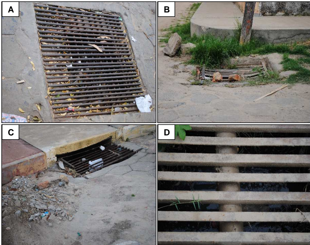
Figura 6.137 – Dispositivos de drenagem obstruídos com resíduos. Fonte: DRZ Geotecnologia e Consultoria (2015).
