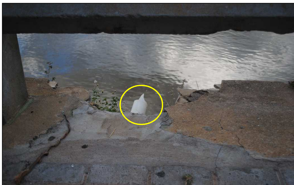
Figura 6.90 – Lançamento clandestino de esgoto no Rio São Francisco.
