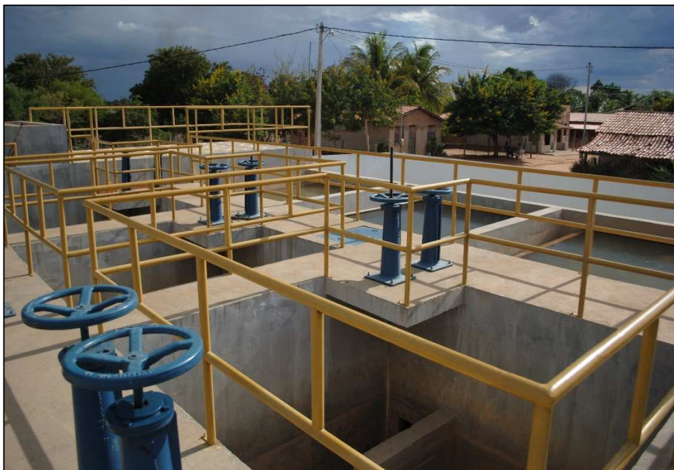
Figura 6.63 – Filtros da ETA. Fonte: DRZ Geotecnologia e Consultoria (2015).
