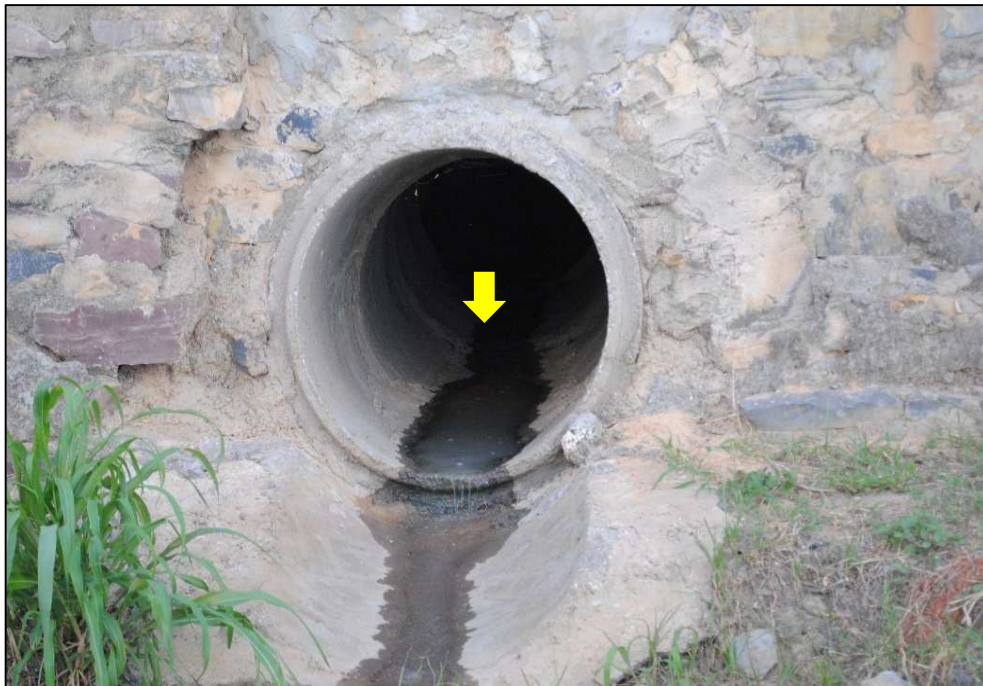
Figura 6.89 – Lançamento de esgoto na galeria de água pluvial do Rio São Francisco.
