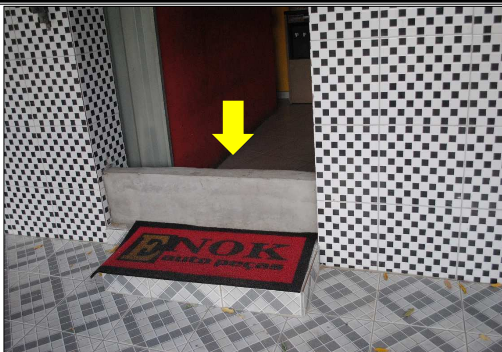
Figura 6.160 – Barreira de contenção da água da chuva em comércio de Carinhanha.
