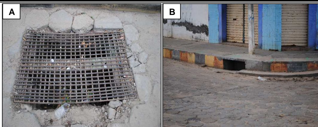
Figura 6.135 – Dispositivos de drenagem de Carinhanha. Fonte: DRZ Geotecnologia e Consultoria (2015).
