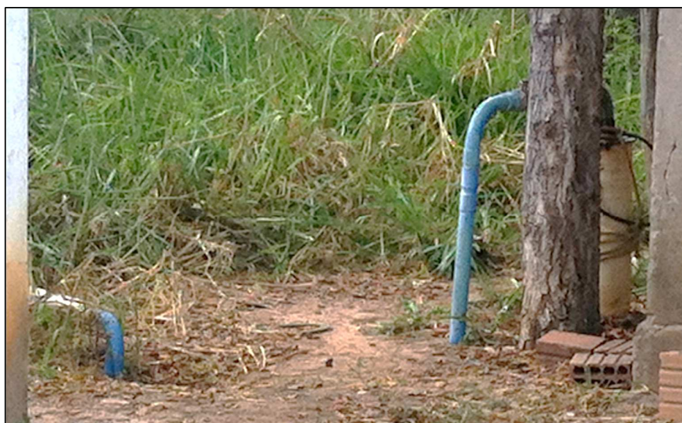
Figura 6.28 – Poço de captação da Comunidade Rural de Santa Luzia. Fonte: DRZ Geotecnologia e Consultoria (2015).
