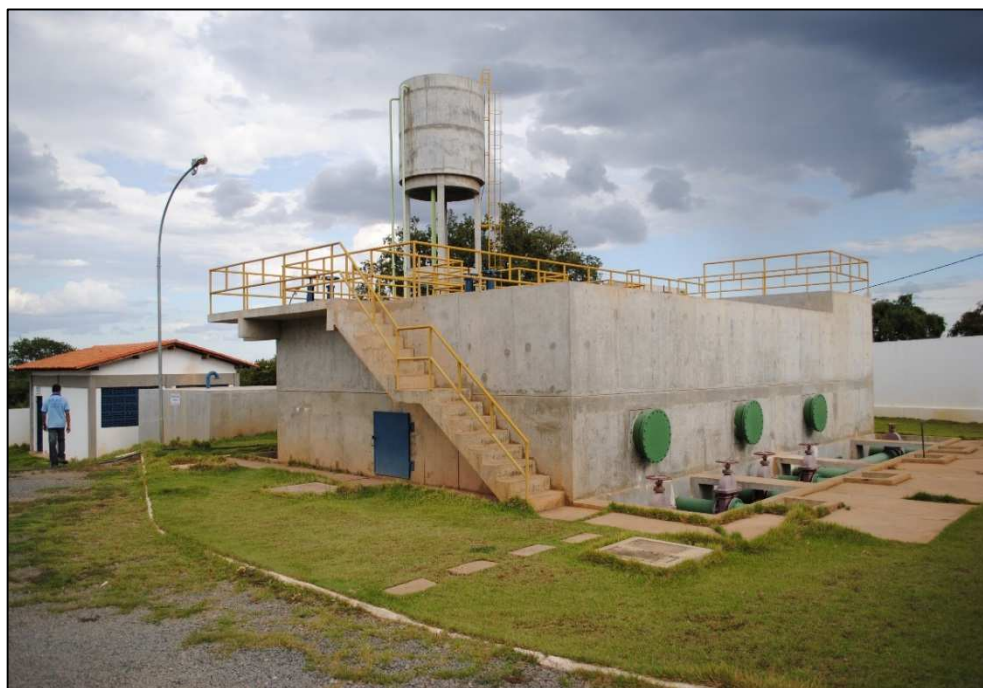
Figura 6.55 – Estação de tratamento de água. Fonte: DRZ Geotecnologia e Consultoria (2015).
