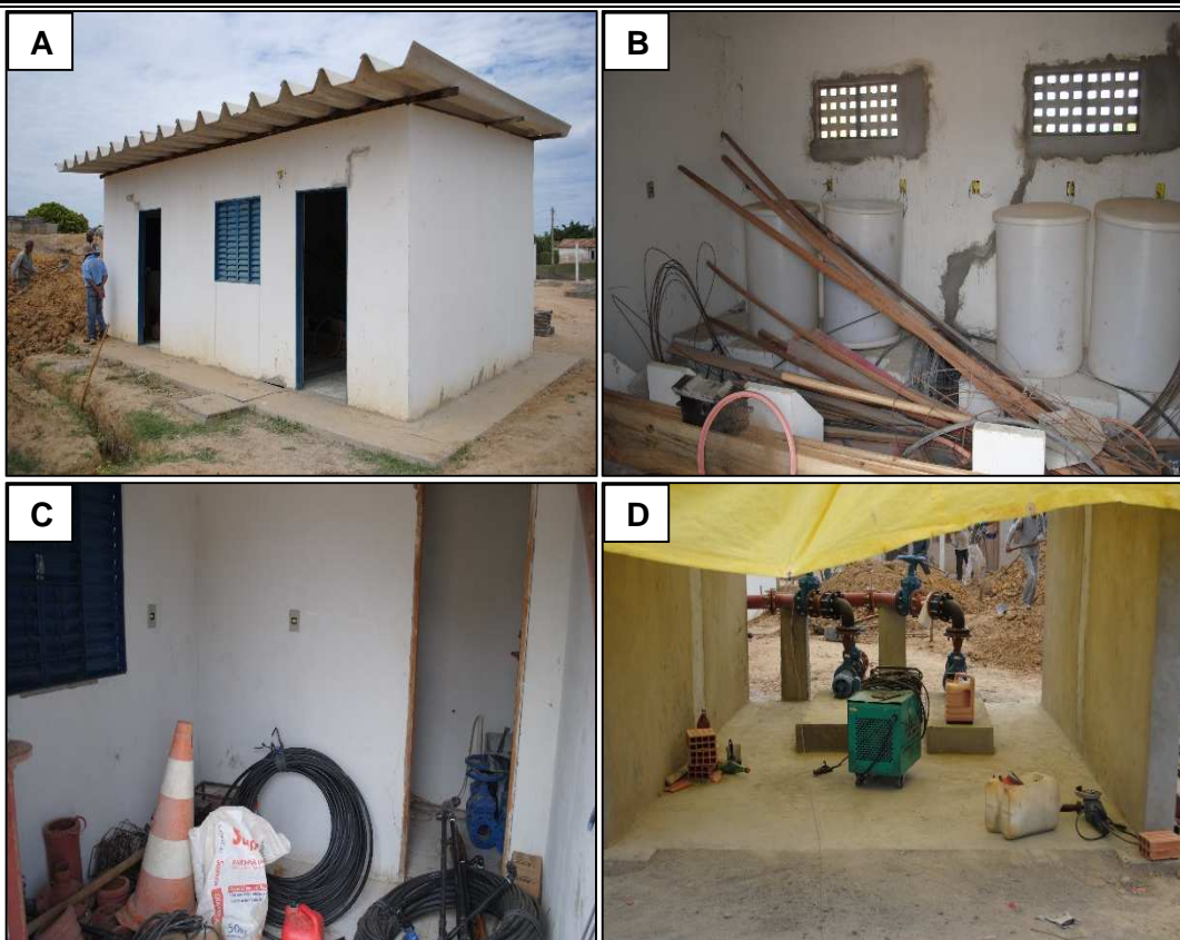
Figura 6.50 – Estação de tratamento de água de Barra do Parateca. Fonte: DRZ Geotecnologia e Consultoria (2015).
