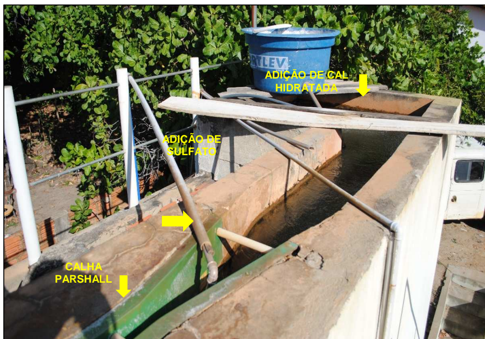
Figura 6.12 – Calha parshall e adição das soluções. Fonte: DRZ Geotecnologia e Consultoria (2015).
