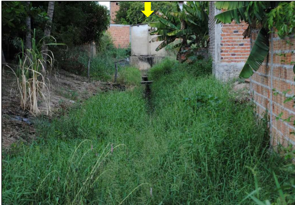
Figura 6.146 – Ladrão (casa de bombas) da Lagoa 4 - Sudene. Fonte: DRZ Geotecnologia e Consultoria (2015).
