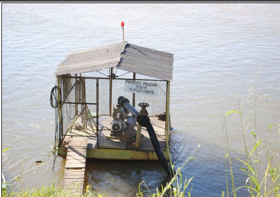
Figura 6.9 – Captação superficial do SAA de Carinhanha. Fonte: DRZ Geotecnologia e Consultoria (2015).
