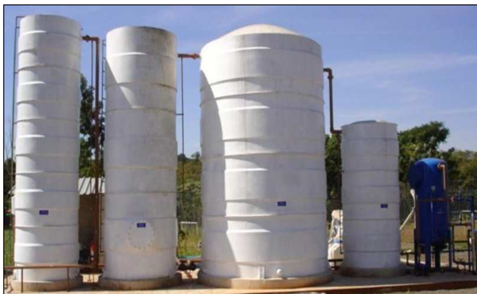
Figura 6.96 – Estação compacta de tratamento de esgoto sanitário. Fonte: DRZ Geotecnologia e Consultoria.
