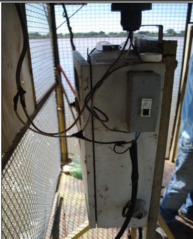
Figura 6.10 – Quadro de comando da EEAB. Fonte: DRZ Geotecnologia e Consultoria (2015).
