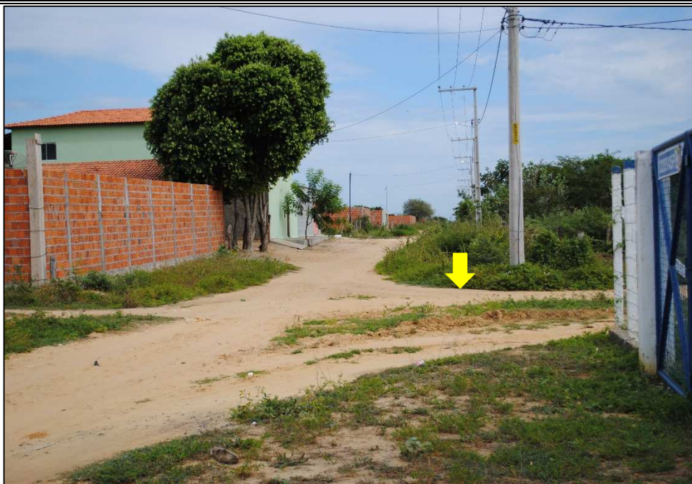
Figura 6.162 – Erosão em rua não pavimentada de Carinhanha. Fonte: DRZ Geotecnologia e Consultoria (2015).
