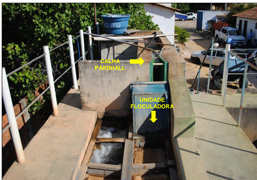
Figura 6.14 – Passagem da calha parshall para os floculadores. Fonte: DRZ Geotecnologia e Consultoria (2015).
