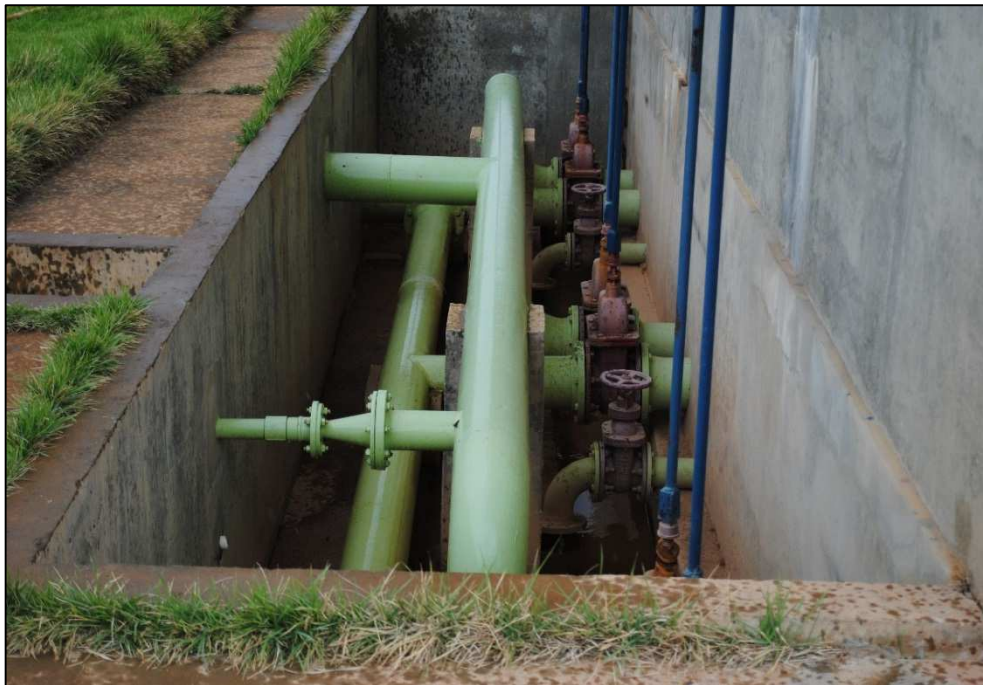
Figura 6.64 – Barrilete de saída da ETA. Fonte: DRZ Geotecnologia e Consultoria (2015).
