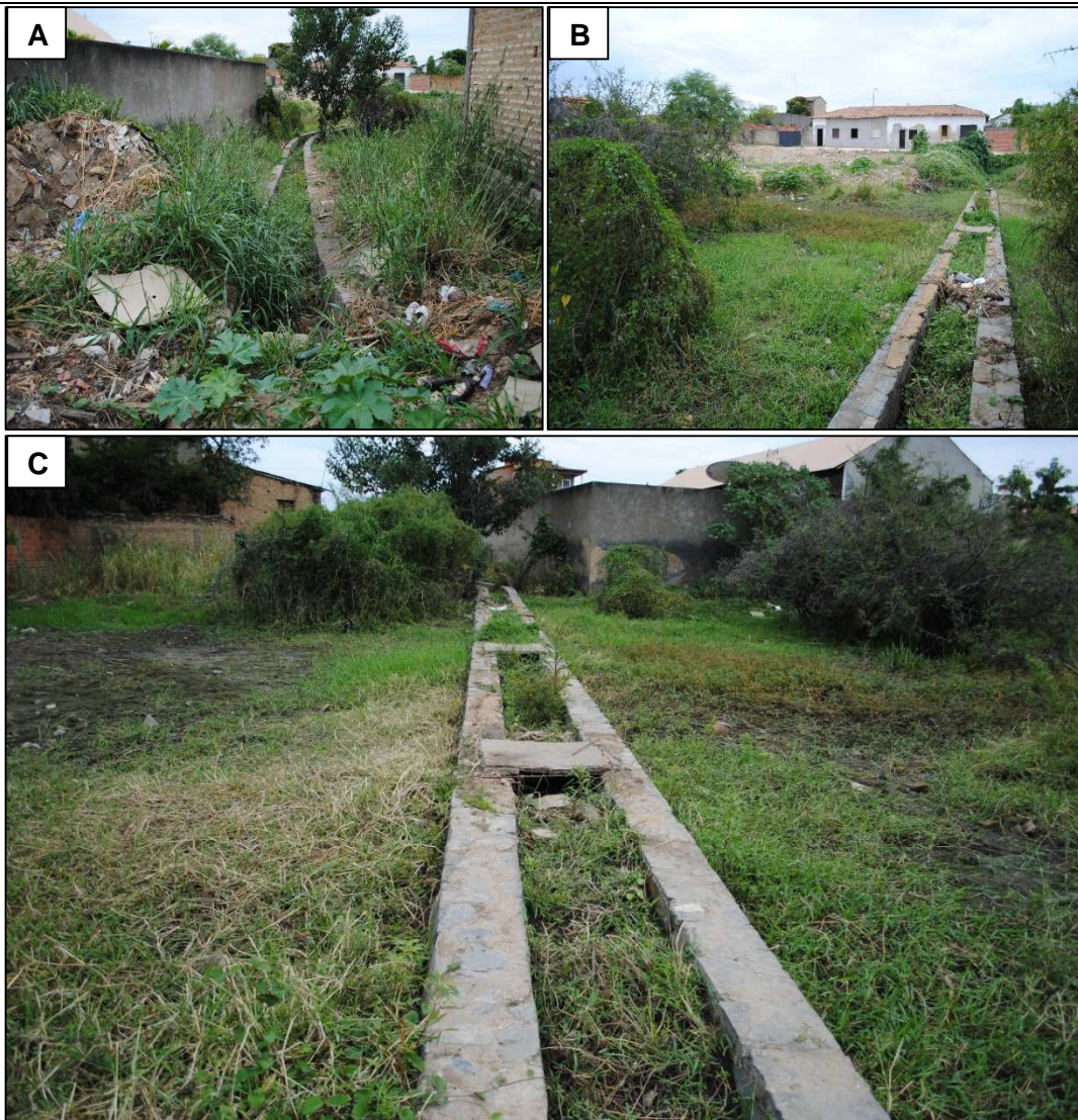
Figura 6.148 – Canal de drenagem da Lagoa 4 para a Lagoa 5. Fonte: DRZ Geotecnologia e Consultoria (2015).
