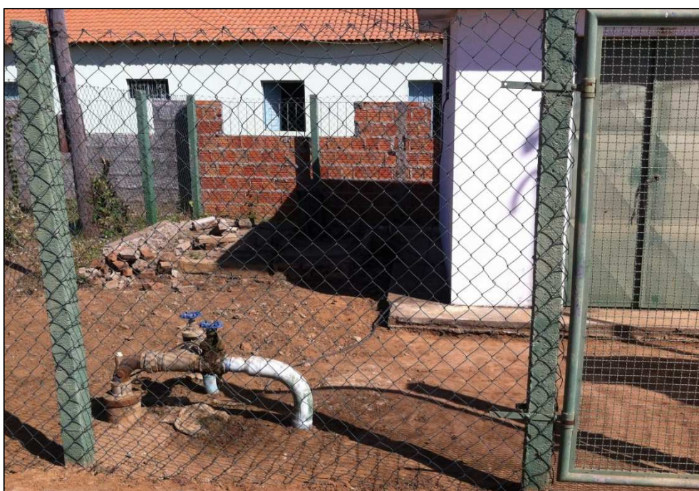
Figura 6.32 – Poço de captação de Barrinha. Fonte: DRZ Geotecnologia e Consultoria (2015).
