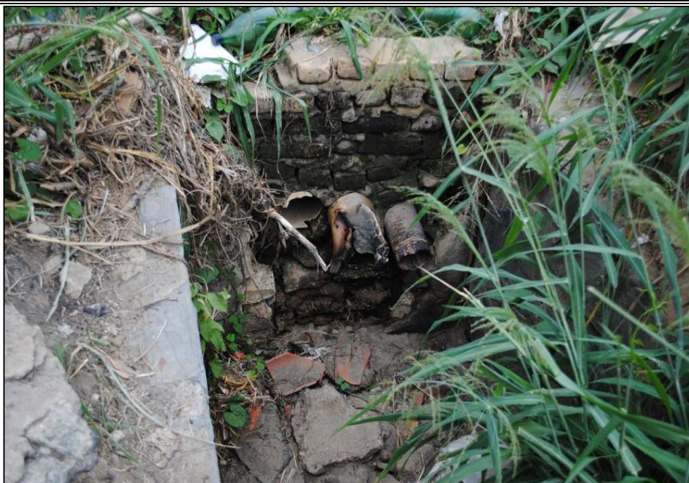
Figura 6.147 – Canos de drenagem da Lagoa 4 (da elevatória para o canal). Fonte: DRZ Geotecnologia e Consultoria (2015).
