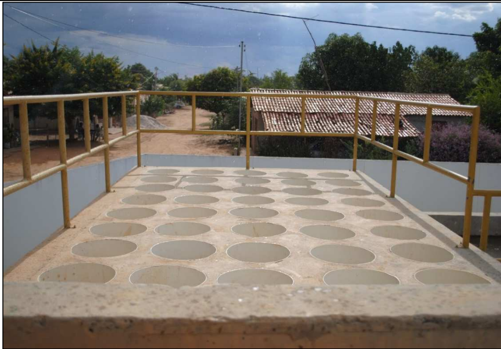
Figura 6.61 – Misturador da ETA. Fonte: DRZ Geotecnologia e Consultoria (2015).
