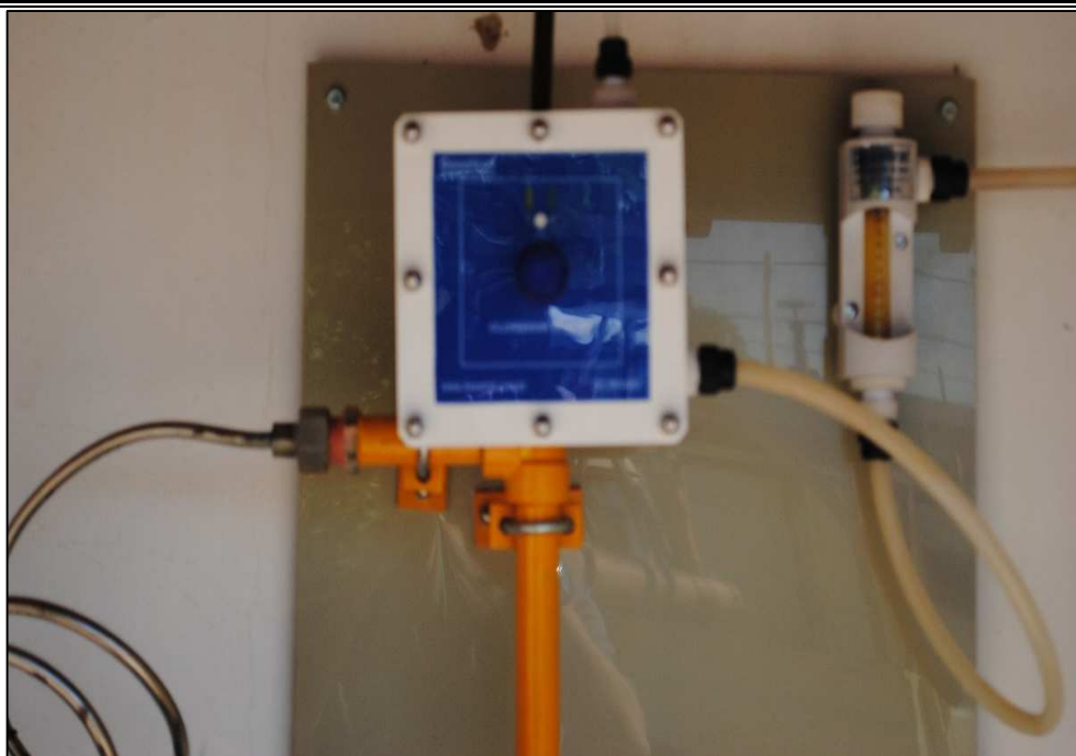
Figura 6.21 – Dosador de cloro para desinfecção da água tratada na ETA. Fonte: DRZ Geotecnologia e Consultoria (2015).
