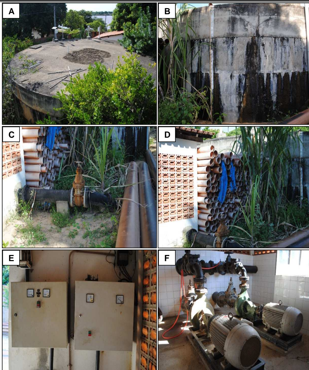
Figura 6.23 – Estação elevatória de água tratada. Fonte: DRZ Geotecnologia e Consultoria (2015).
