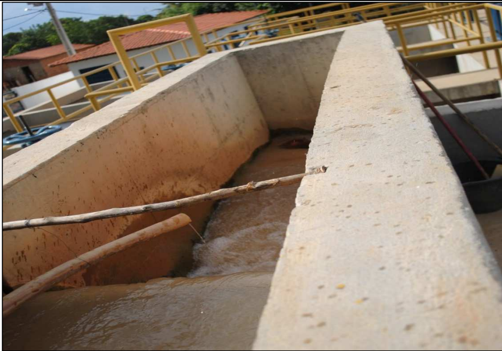
Figura 6.58 – Entrada de água bruta e dosador de sulfato. Fonte: DRZ Geotecnologia e Consultoria (2015).
