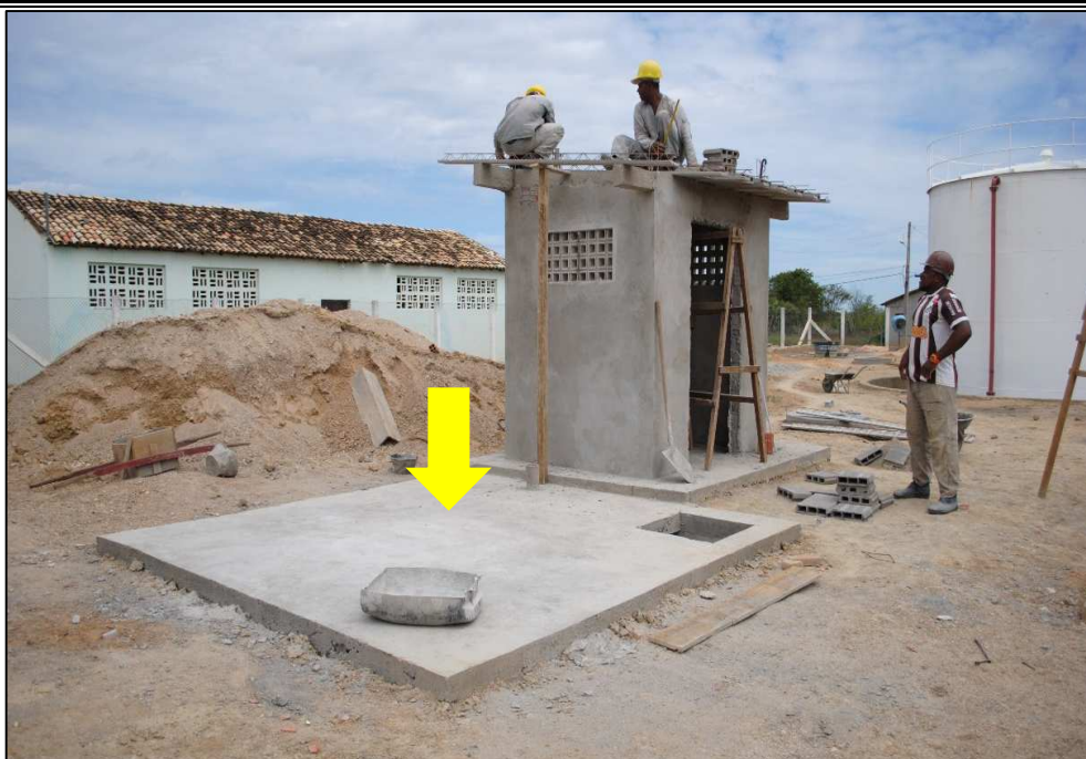
Figura 6.48 – Reservatório enterrado para retro-lavagem dos Filtros. Fonte: DRZ Geotecnologia e Consultoria (2015).
