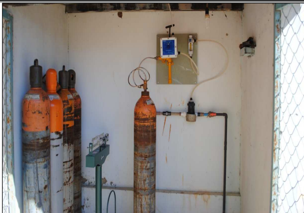
Figura 6.20 – Cilindros de cloro gasoso para desinfecção da água. Fonte: DRZ Geotecnologia e Consultoria (2015).
