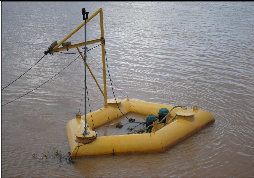
Figura 6.56 – Balsa de captação superficial da ETA de Estreito. Fonte: DRZ Geotecnologia e Consultoria (2015).
