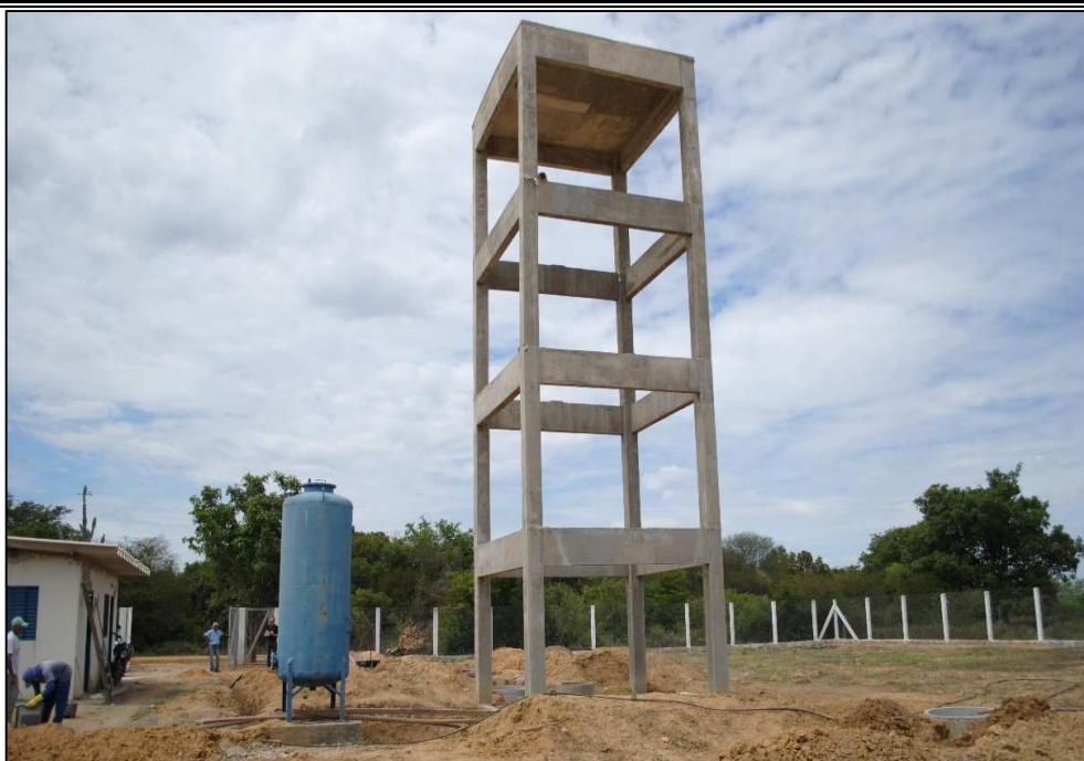
Figura 6.43 – Estrutura do reservatório elevado de Três Ilhas. Fonte: DRZ Geotecnologia e Consultoria (2015).
