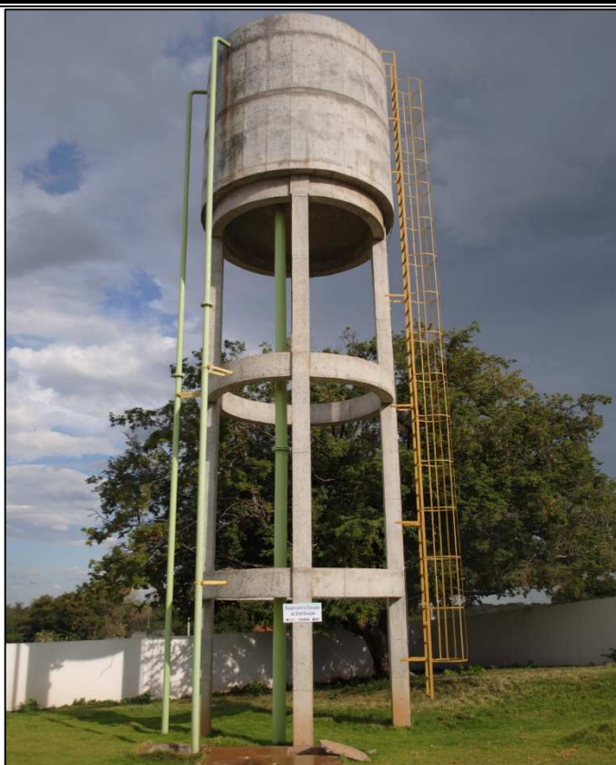
Figura 6.72 – Reservatório elevado de distribuição. Fonte: DRZ Geotecnologia e Consultoria (2015).
