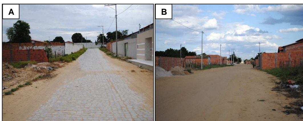
Figura 6.152 – Ausência de sistema de drenagem nas ruas de Carinhanha. Fonte: DRZ Geotecnologia e Consultoria (2015).
