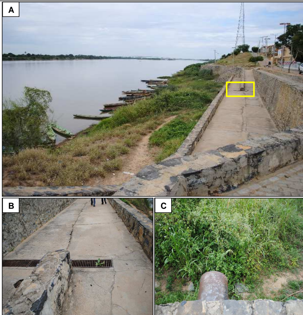
Figura 6.136 – Dispositivos de drenagem na orla de Carinhanha. Fonte: DRZ Geotecnologia e Consultoria (2015).
