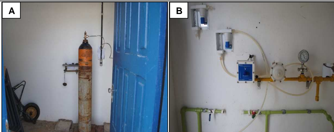
Figura 6.65 – Sistema de dosagem de cloro. Fonte: DRZ Geotecnologia e Consultoria (2015).
