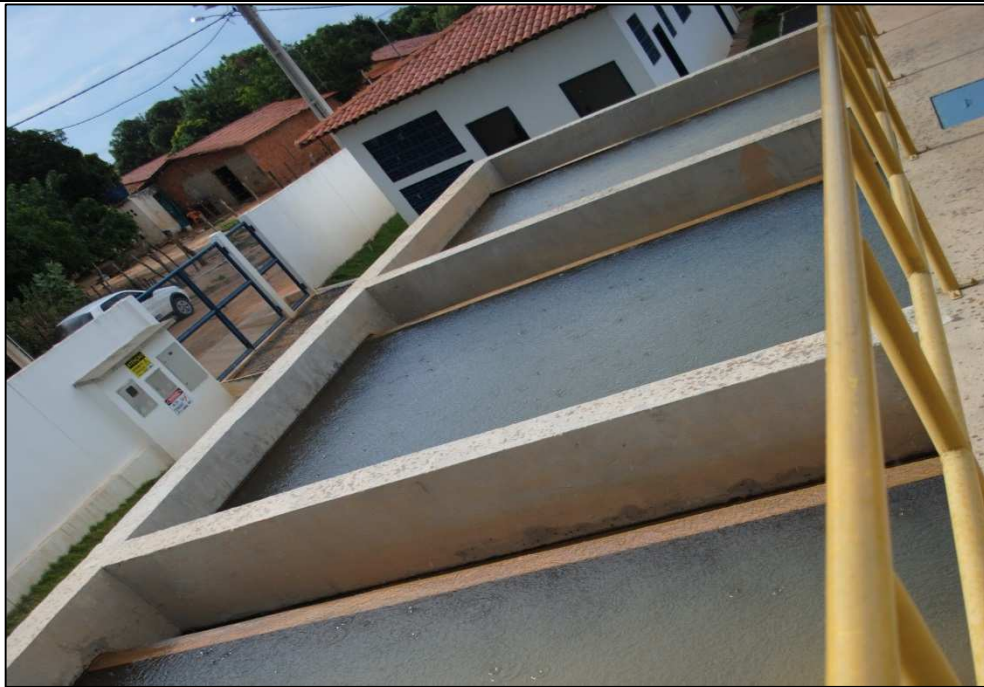
Figura 6.62 – Decantadores da ETA. Fonte: DRZ Geotecnologia e Consultoria (2015).
