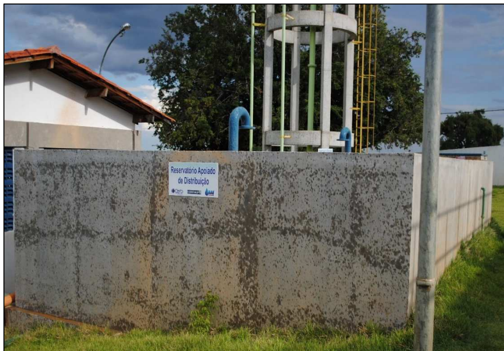
Figura 6.70 – Reservatório apoiado de distribuição e tanque de contato. Fonte: DRZ Geotecnologia e Consultoria (2015).
