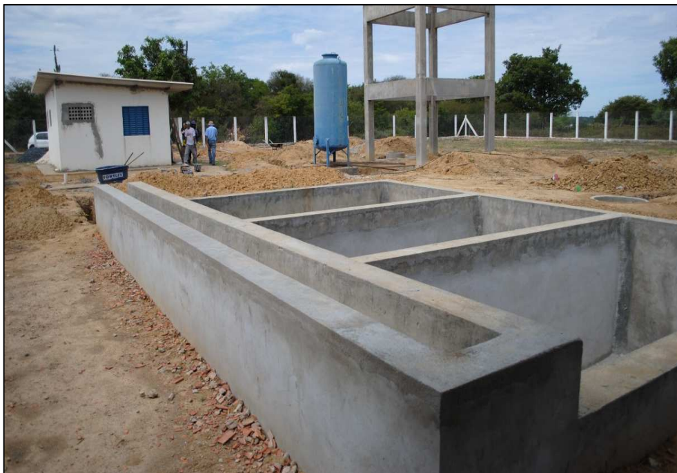
Figura 6.42 – Leito de secagem. Fonte: DRZ Geotecnologia e Consultoria (2015).
