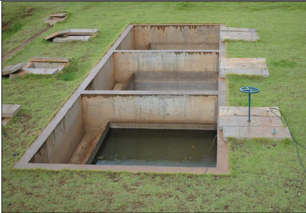
Figura 6.68 – Caixa de passagem para o leito de secagem. Fonte: DRZ Geotecnologia e Consultoria (2015).
