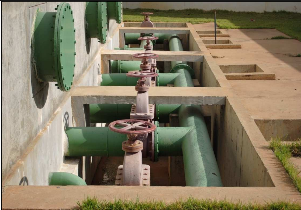
Figura 6.60 – Barrilete de entrada da ETA. Fonte: DRZ Geotecnologia e Consultoria (2015).
