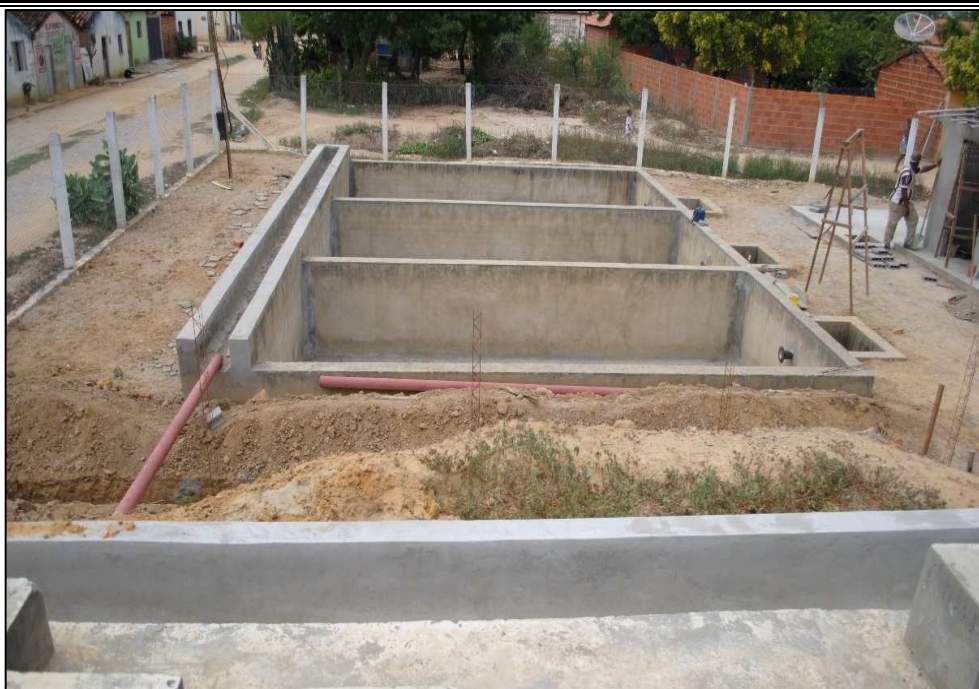
Figura 6.49 – Leito de secagem do filtro da ETA de Barra do Parateca. Fonte: DRZ Geotecnologia e Consultoria (2015).
