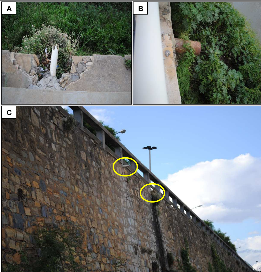
Figura 6.151 – Lançamento irregular de esgoto no Rio São Francisco. Fonte: DRZ Geotecnologia e Consultoria (2015).
