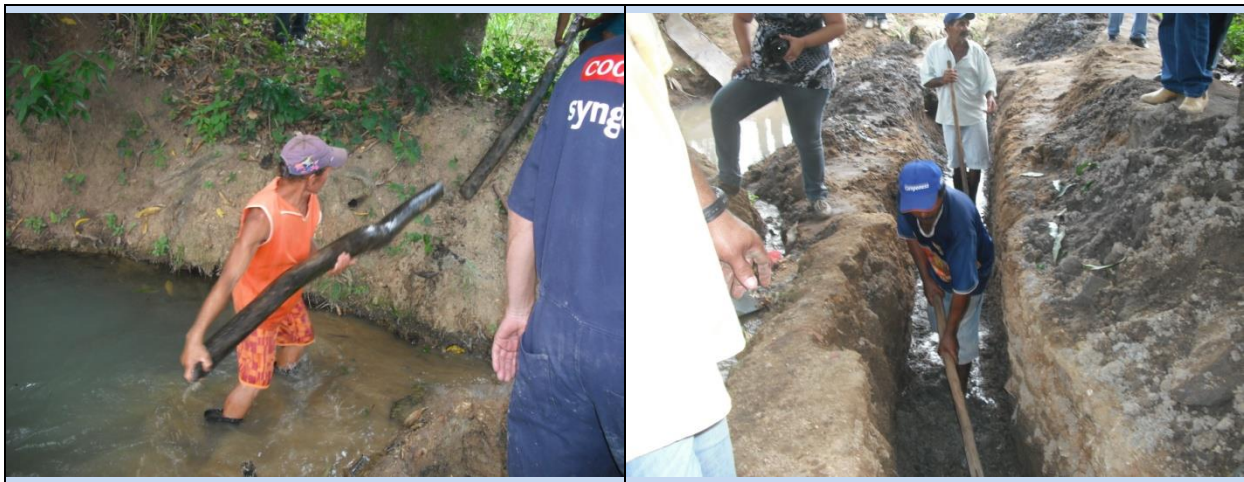
A Figura 7.9 apresenta algumas fotografias que ilustram a execução das etapas descritas, em trabalho numa nascente no âmbito do Projeto “Sombra e Água Viva”.
