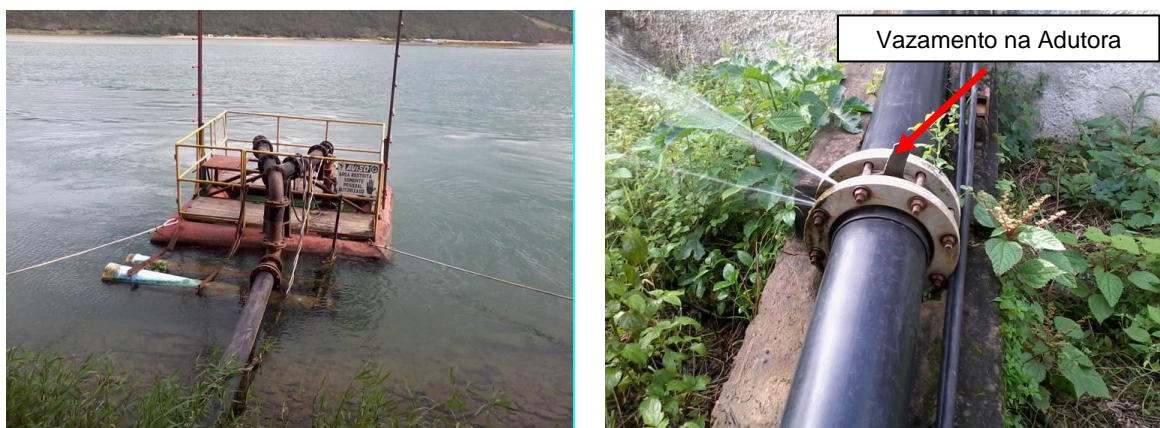
Figura 6: Captação e Adutora do SAA operado pela CASAL Fonte: Gesois, 2014.
