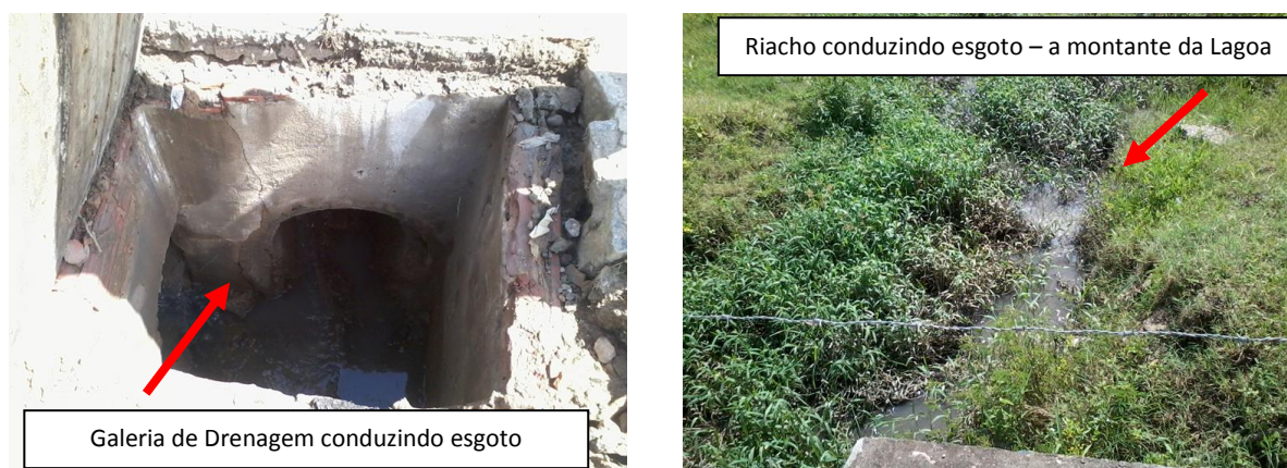
Figura 9: Lançamento de esgoto inadequado na sede municipal de Telha.
