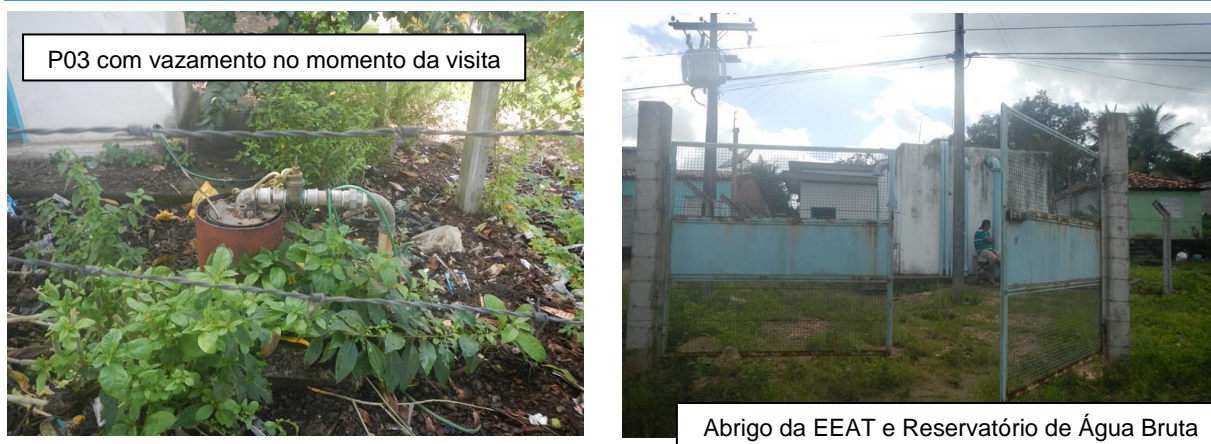
Figura 6: Poço do SAA operado pela CASAL, reservatório e abrigo Fonte: Gesois, 2014.
