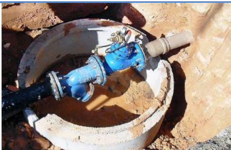
Figura 18: Equipamento para combate às perdas
