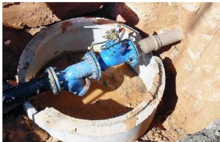
Figura 21: Equipamento para combate às perdas Fonte: Viegas et al., 2006
