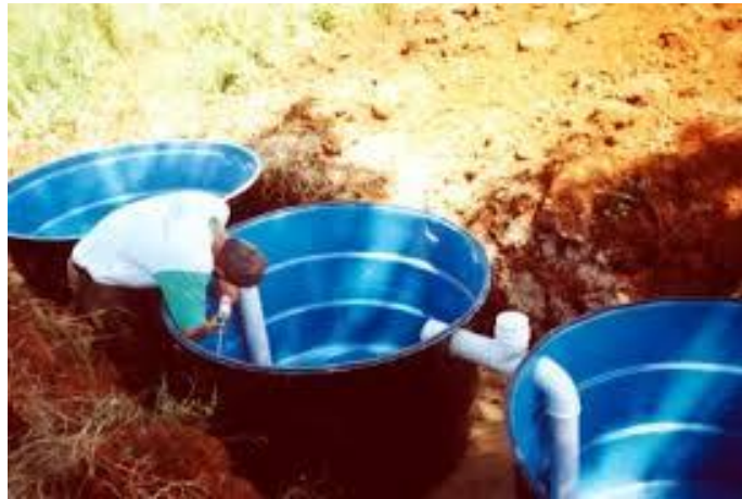
Figura 31: Fossa Séptica Fonte: Emater, 2014
