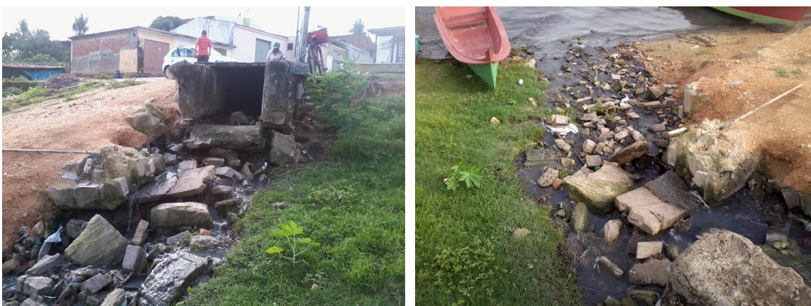
Figura 130: Lançamento de esgoto inadequado no rio São Francisco, rua Frei Caneca.
