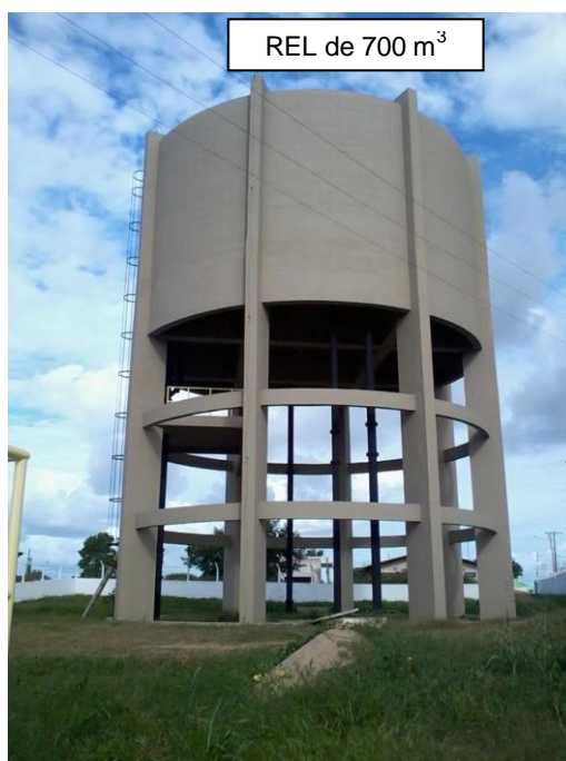
Figura 104: Reservatórios do SAA operado pela CASAL.
