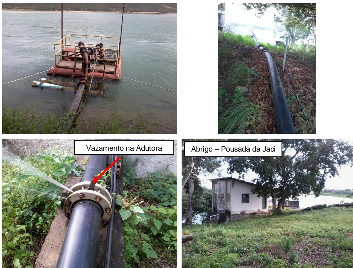
Figura 102: Captação e Adutora do SAA operado pela CASAL. Fonte: Gesois, 2014.
