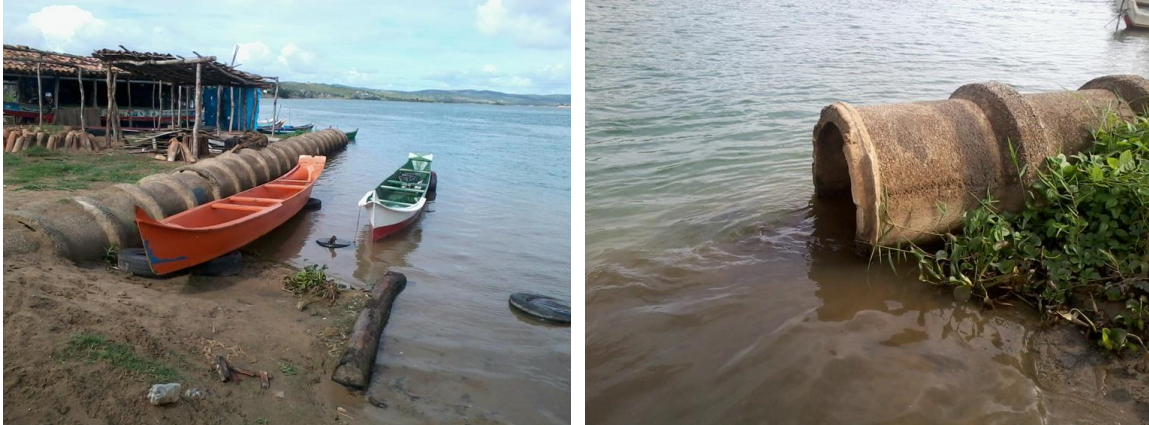
Figura 127: Lançamento de esgoto inadequado no rio São Francisco.
