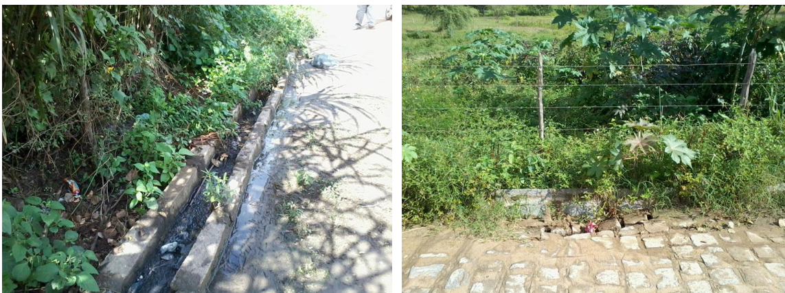
Figura 129: Esgoto escoando a céu aberto nas ruas e seguindo para terreno particular.
