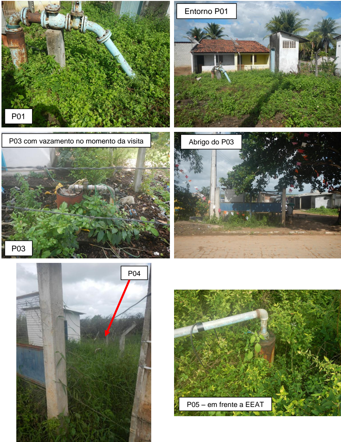
Figura 101: Poços que pertencem ao SAA operado pela CASAL. Fonte: Gesois, 2014
