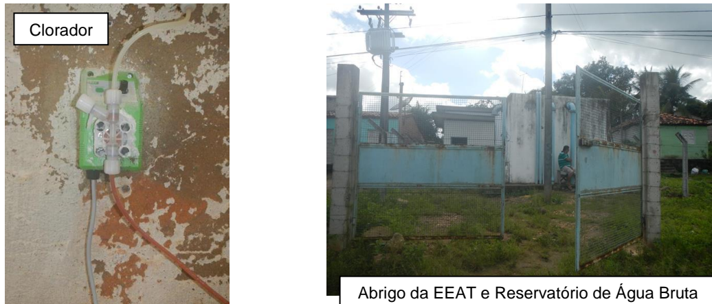
Figura 102: Estação elevatória de água bruta, tratamento com cloro líquido e abrigo. Fonte: Gesois, 2014
