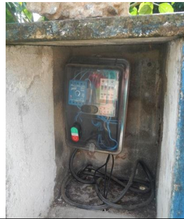
Painel de Automação de uma das Bombas
