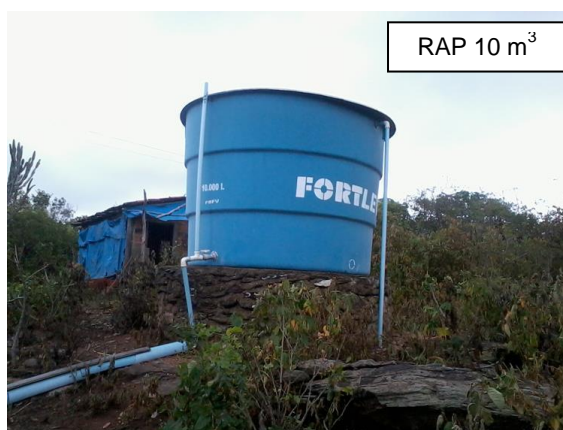
Figura 107: Fotografias do reservatório do SAA do Assentamento Prazeres
