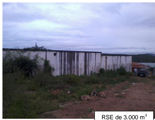
Figura 100: Reservatórios do SAA operado pela CASAL.
