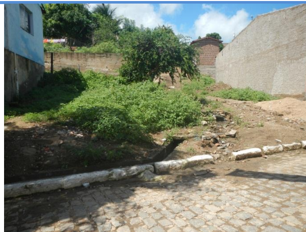
Figura 10: Esgoto a céu aberto em Belo Monte/AL
