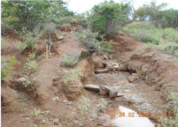
Figura 67 - Voçoroca 7 - características e locação
