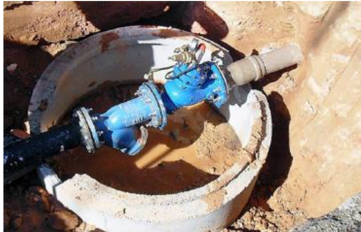
Figura 13: Equipamento para combate às perdas
