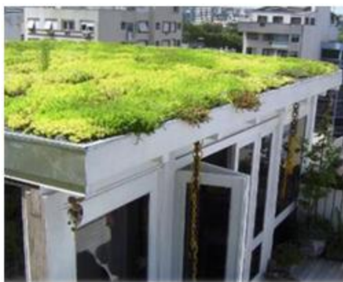
Figura 52: Exemplo de telhado verde Fonte: Ecotelhado (2013).
