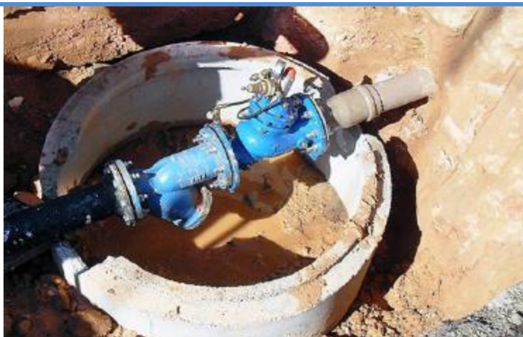
Figura 15: Equipamento para combate às perdas
