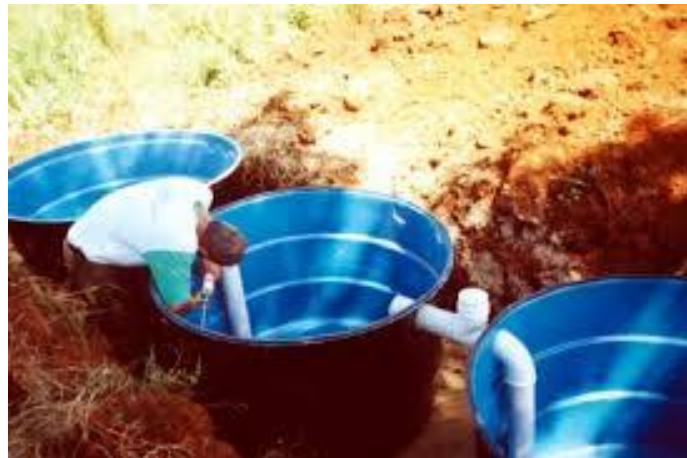
Figura 33: Fossa Séptica Fonte: Emater, 2014
