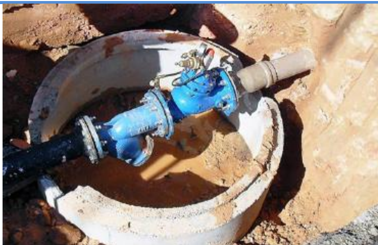
Figura 22: Equipamento para combate às perdas
