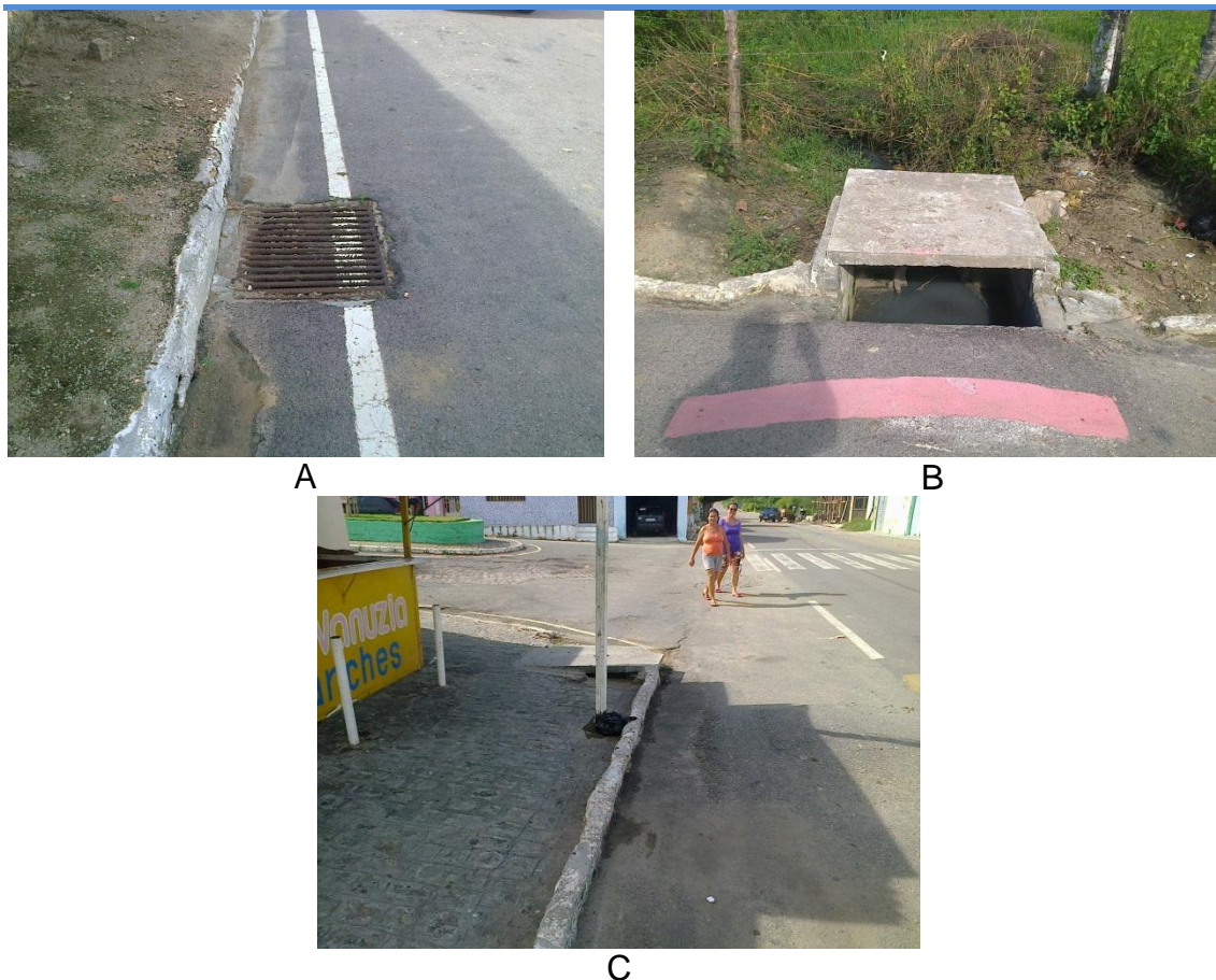
Figura 131: Bocas-de-lobo e bueiros
