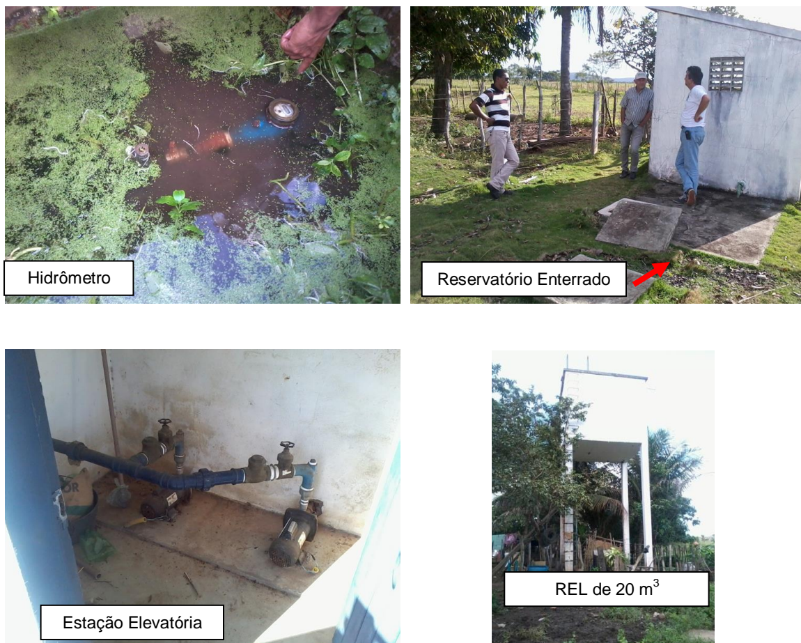
Figura 126: Fotografias da infraestrutura para o abastecimento de água da etnia Tingui-Botó.
