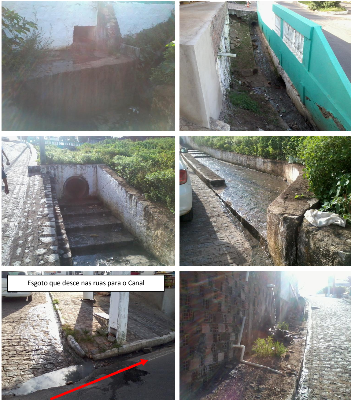
Figura 137: Principal ponto de concentração de esgoto a céu aberto na cidade. Fonte: Gesois, 2014.
