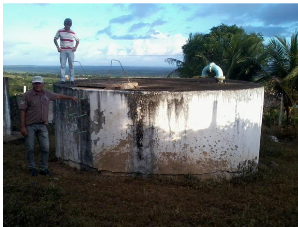
Figura 101: Reservatório de distribuição do SAA operado pela CASAL, localizado na Sede.
