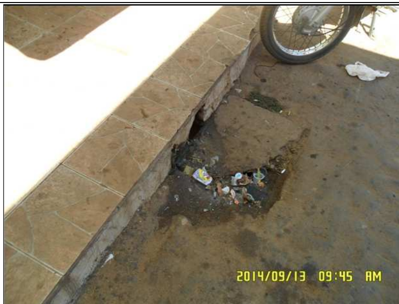
Figura 88 - Resíduos sólidos no solo obstruindo caixa de visita
