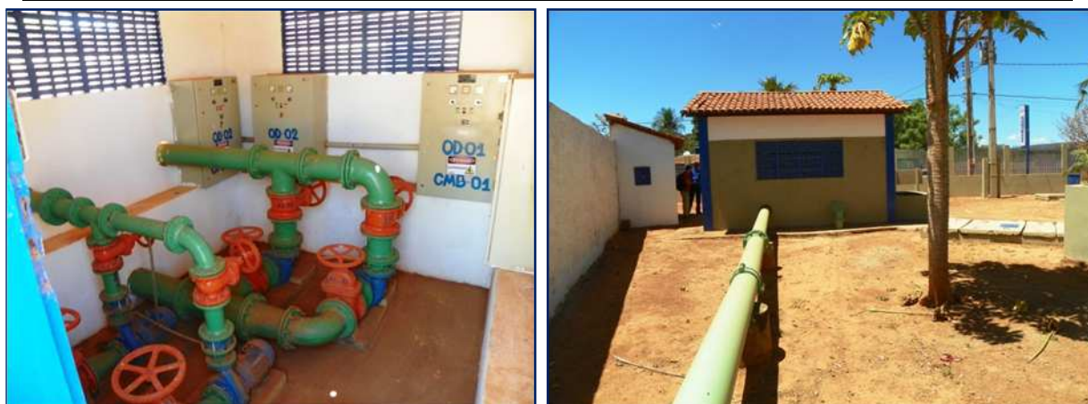
Figura 43 – Bombas e adutora de água tratada
