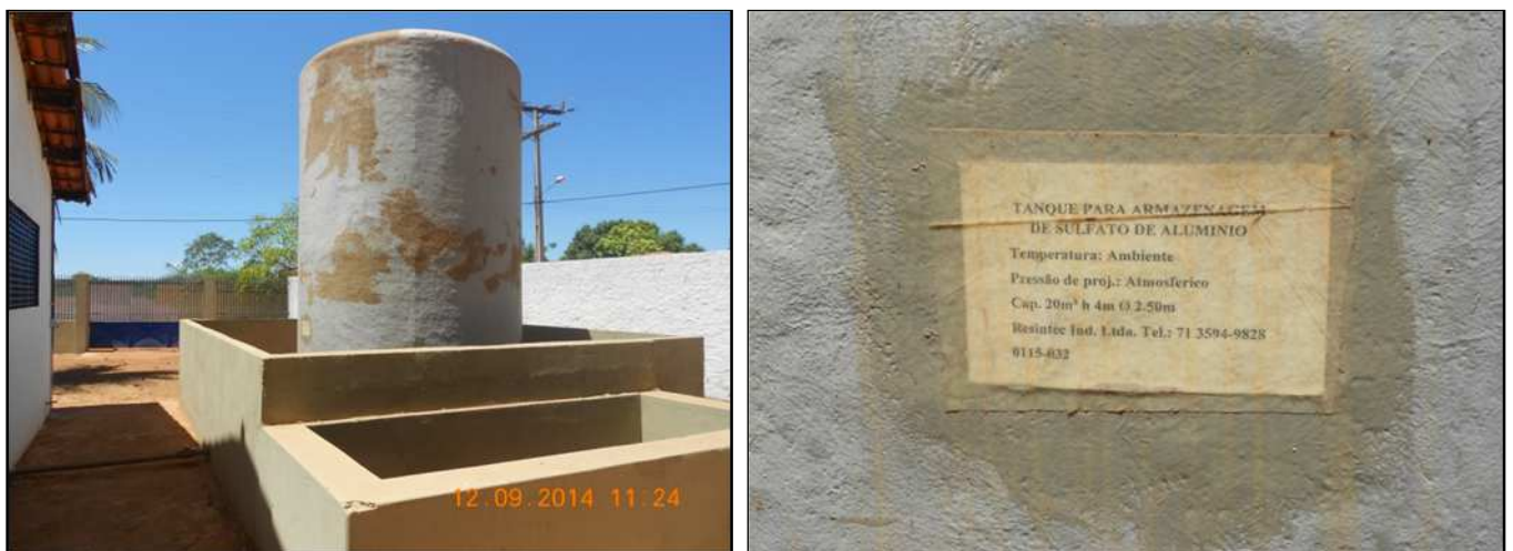
Figura 35 – Tanque de armazenamento de Sulfato Desativado.
