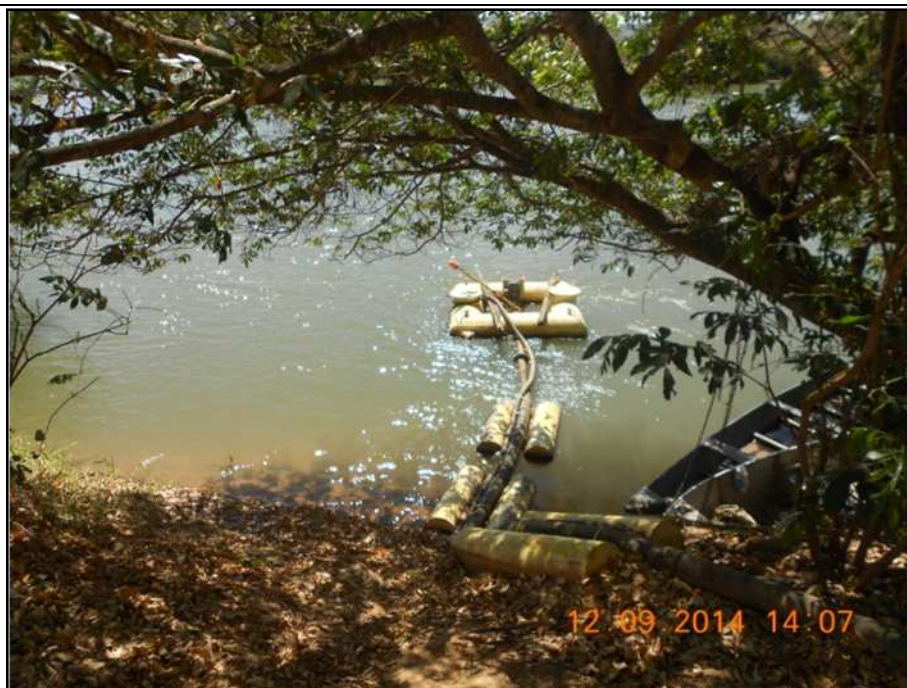
Figura 54– Captação superficial flutuante da EMBASA na Localidade de Santa Luzia
