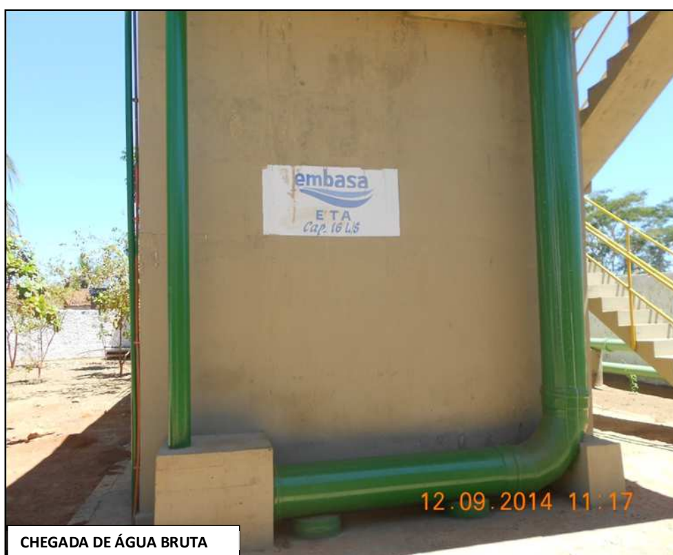
Figura 31 – Chegada da Água Bruta na ETA
