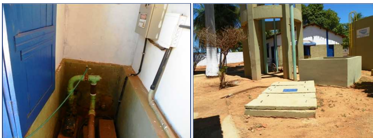
Figura 44 – Booster 1 e macromedidor
