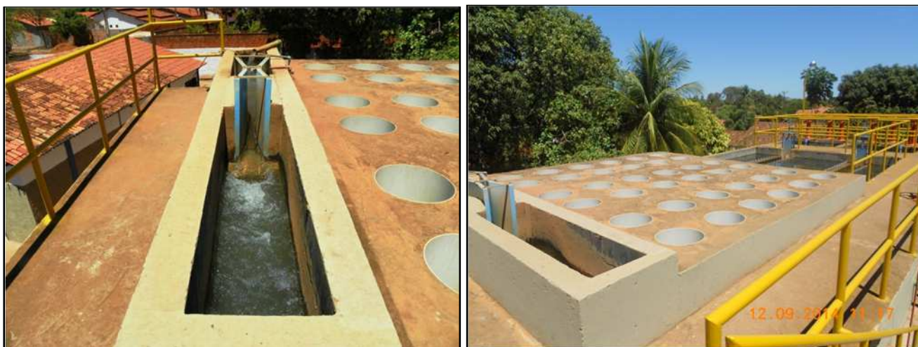
Figura 37 – Coagulador e Floclulador - ETA de Angical
