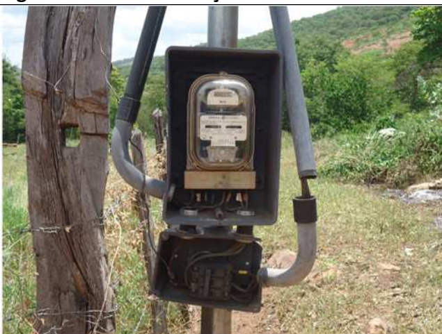
Figura 69– Caixa de força
