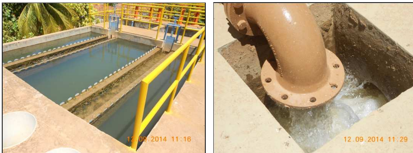
Figura 38 – Decantadores e Descarga dos decantadores.
