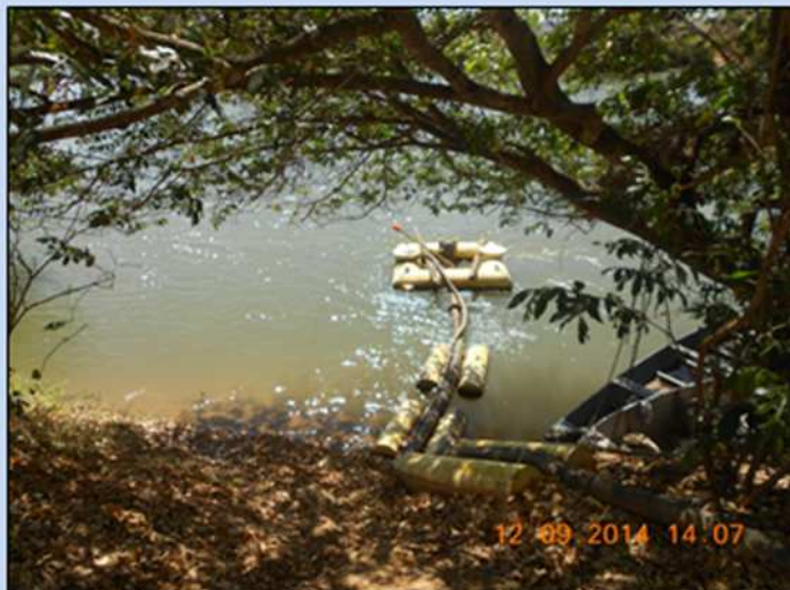
Captação superficial flutuante da EMBASA na Localidade de Santa Luzia
