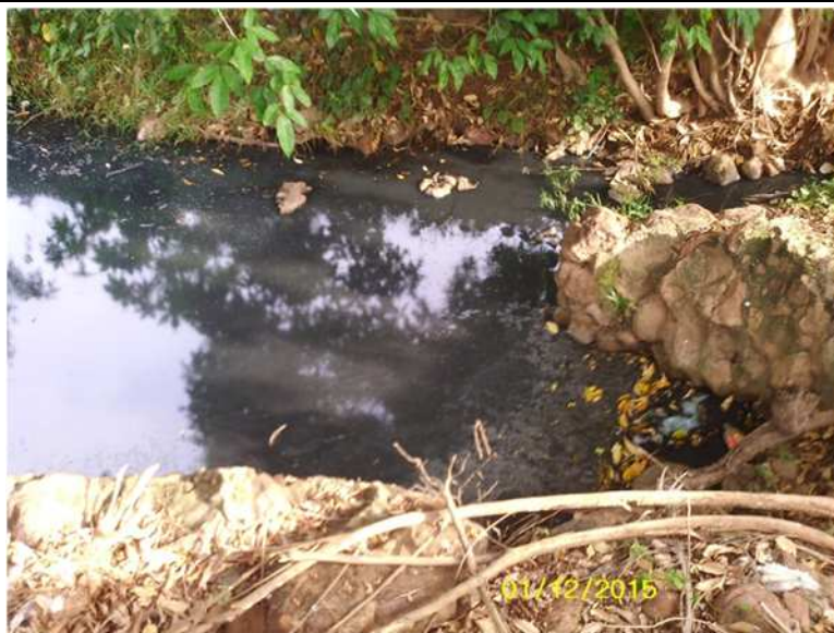
Figura 77– Esgoto sanitário no leito do riacho Redenção
