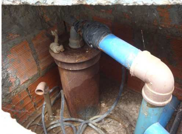
Figura 62– bomba do poço dentro do abrigo
