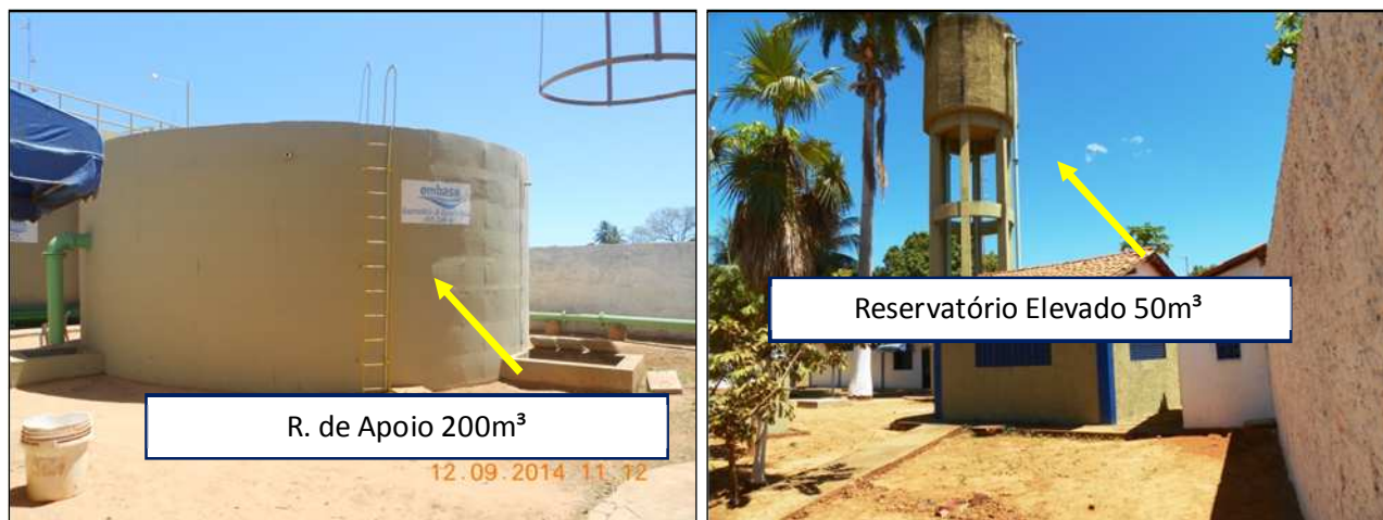
Figura 42 – Reservatório de apoio e Reservatório Elevado da ETA
