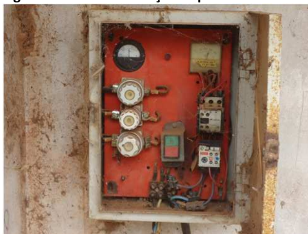
Figura 57– Pannel de força em precário estado
