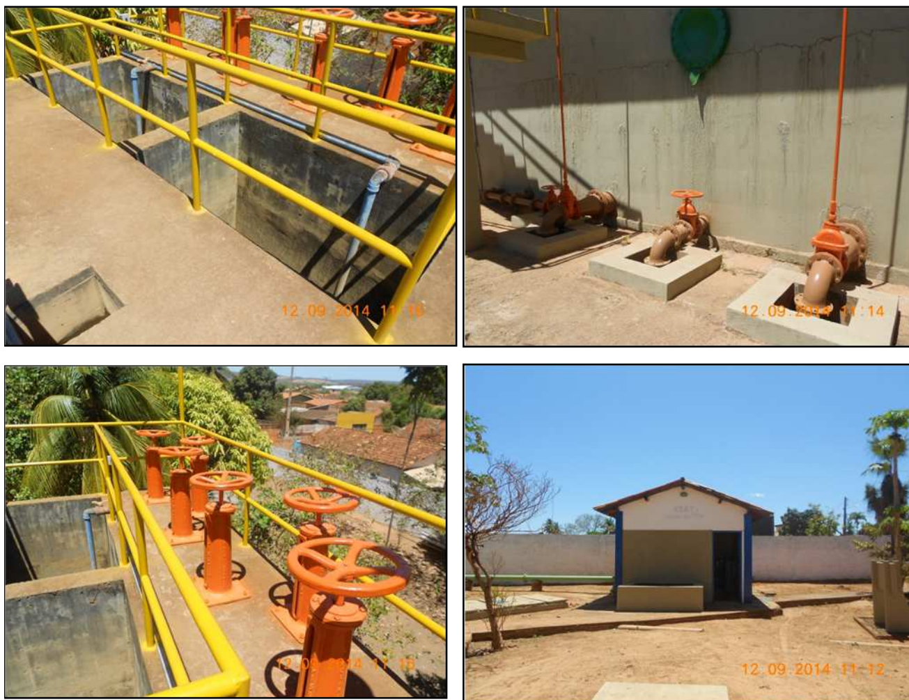
Figura 39 – Filtros e Descarga dos Filtros.
