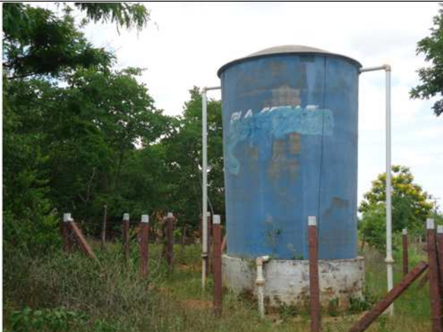
Figura 68 – Reservatório do poço
