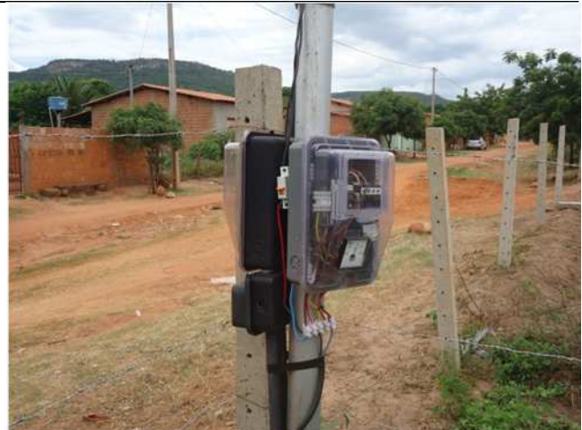
Figura 61– painel de entrada de energia
