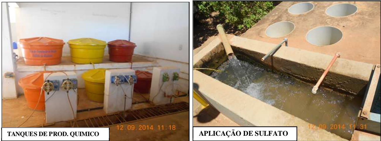
Figura 34 – Aplicação De produtos químicos na ETA
