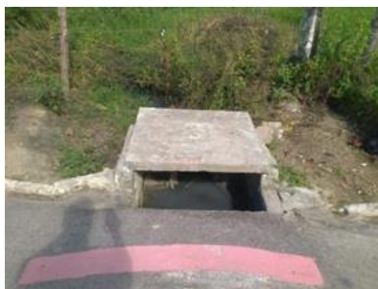
Figura 9: Esgoto em bueiro no município de Telha Fonte: Instituto Gesois, 2014
