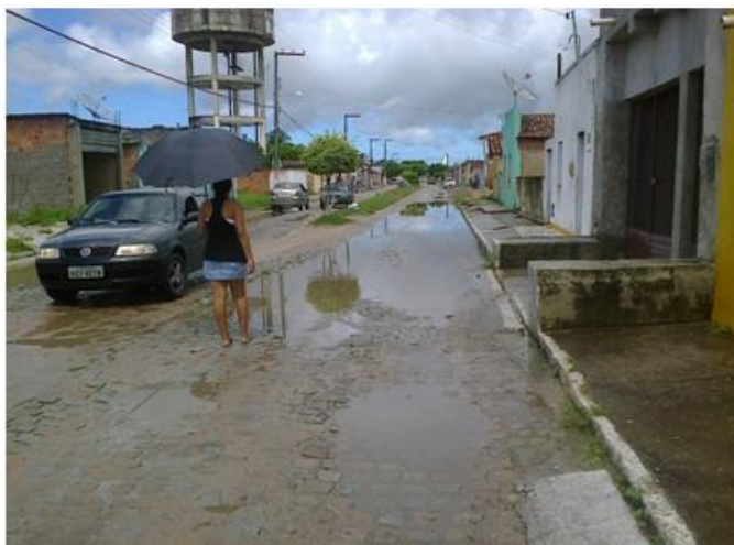
Figura 11: Problemas de drenagem no município de Ilha das Flores
