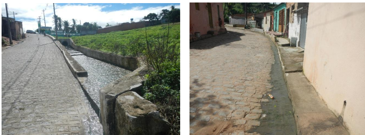
Figura 9: Lançamento de Esgoto em Curso D' Água em Feira Grande
