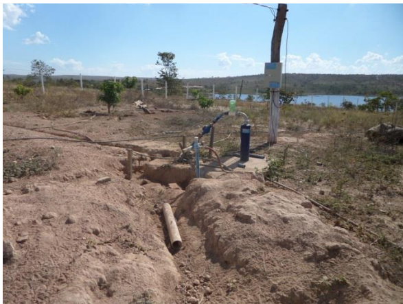
Figura 4.8 - Poço artesiano no condomínio Recanto do Laranjo Fonte: COBRAPE (2014)
