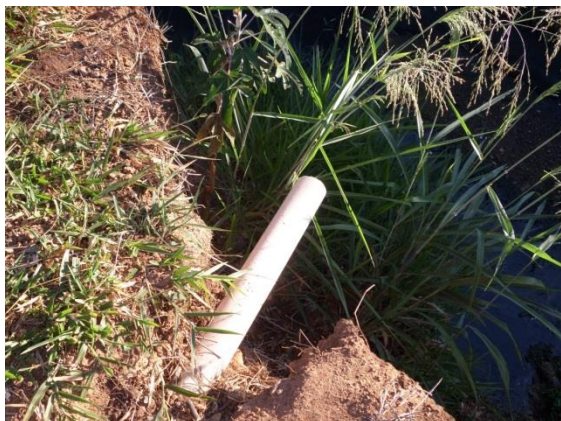
Figura 4.11 - Ponto clandestino de lançamento de esgoto na rede coletora no sistema Sede Fonte: COBRAPE (2014)
