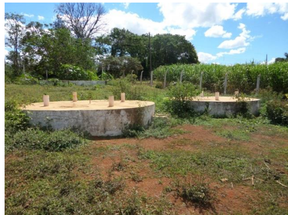
Figura 4.15 - Decantadores secundários na ETE Silva Campos Fonte: COBRAPE (2014)
