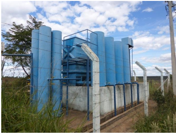
Figura 4.7 - ETA desativada em Reino dos Lagos Fonte: COBRAPE (2014)
