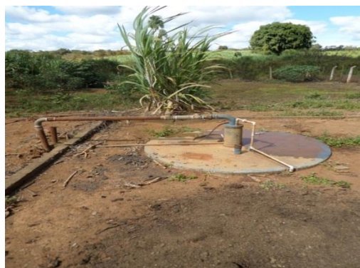
Figura 4.6 - Poço artesiano de Silva Campos operado pelo SCAE
