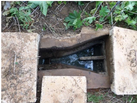
Figura 4.13 - Medidor Parshall da ETE Silva Campos Fonte: COBRAPE (2014)
