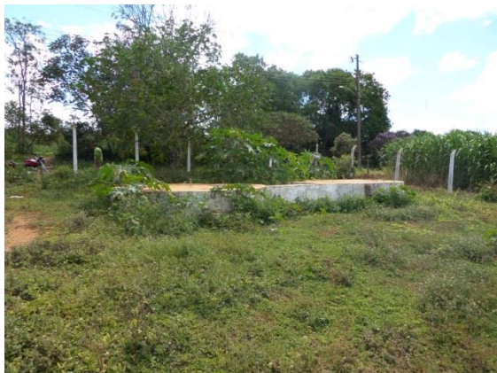
Figura 4.14 - Filtros biológicos da ETE Silva Campos Fonte: COBRAPE (2014)
