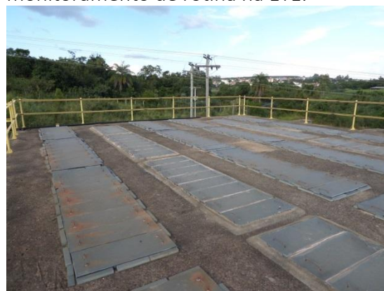
Figura 4.9 – Reator UASB operado pelo SMAE
