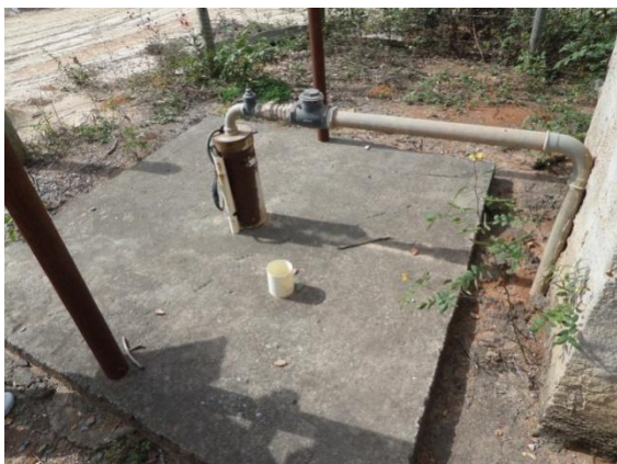
Figura 4.5 – Poço 2 em Vargem Grande
