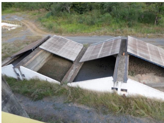
Figura 4.11 – Leitões de secagem na ETE operada pelo SMAE
