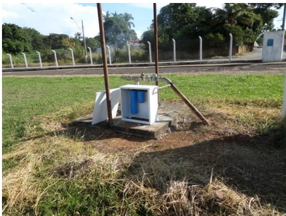
Figura 4.4 – Poço da Lagoa na Sede Fonte: COBRAPE (2014)
