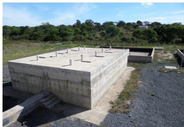
Figura 4.7 – Filtros anaeróbios Fonte: COBRAPE (2014)
