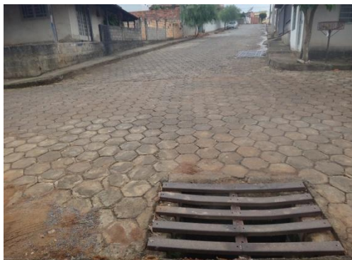
Figura 4.19 – Bocas de lobo com grelha na Rua Paraguaçu
