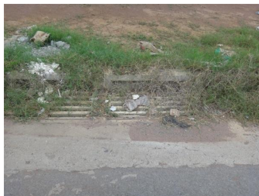
Figura 4.23 – Boca de Lobo com grelha, Estrada da Peteca
