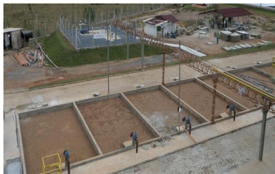
Figura 4.7 – Leitos de secagem Fonte: COBRAPE (2014)
