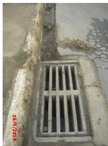
Figura 4.37 – Captação de água pluvial, Avenida Dr. Roberto Queiroz Foto: COBRAPE (2014)
