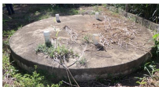
Figura 4.9 – Filtro anaeróbico da ETE Engenho do Ribeiro I Fonte: COBRAPE (2014)
