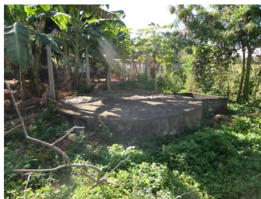
Figura 4.8 – Tanque séptico da ETE Engenho do Ribeiro II Fonte: COBRAPE (2014)
