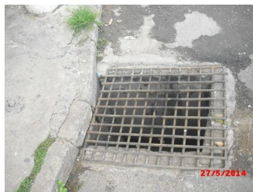
Figura 4.36 – Captação com grelha fina, Av. São Vicente Foto: COBRAPE (2014)
