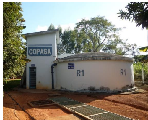
Figura 4.5 – Casa de química ao lado do reservatório (RAP 1) do distrito de Engenho do Ribeiro Fonte: COBRAPE (2014)
