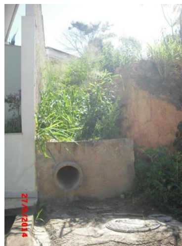
Figura 4.38 – Rede tubular conduz águas pluviais captadas da R. da Olaria para escoamento superficial nesta rua (R. Juca Rufino) Foto: COBRAPE (2014)
