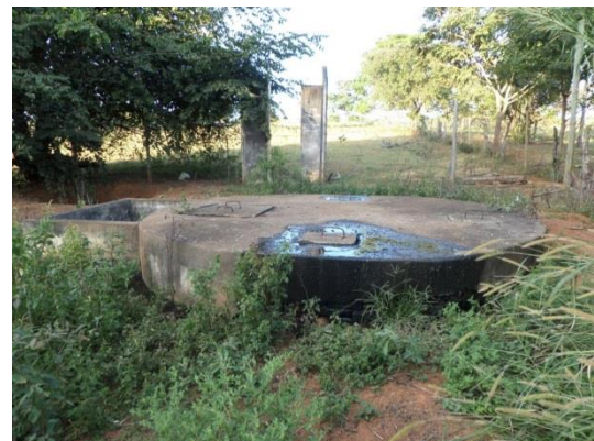
Figura 4.14 – Tanque Séptico da ETE Mato Seco com problemas de extravasamento Fonte: COBRAPE (2014)
