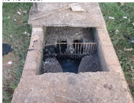
Figura 4.10 – Grade da ETE Engenho do Ribeiro III Fonte: COBRAPE (2014)
