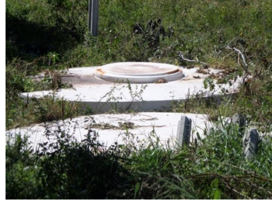
Figura 4.13 – Detalhe das unidades de tratamento da ETE Passagem Fonte: COBRAPE (2014)
