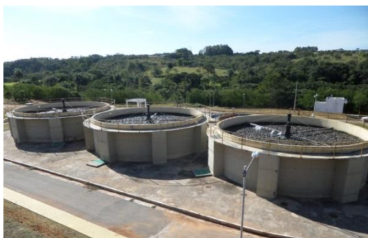
Figura 4.7 – Filtros biológicos percoladores da ETE Matadouro Fonte: COBRAPE (2014)
