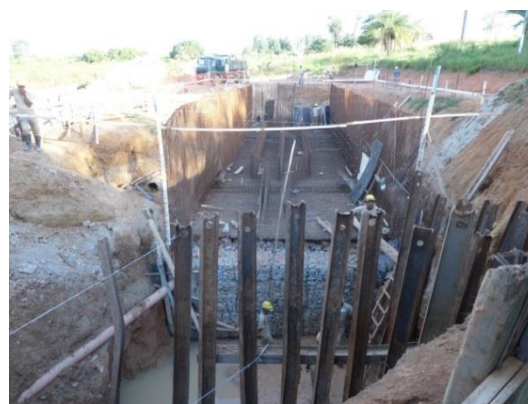
Figura 4.18 – Obras em execução das unidades de tratamento preliminar e do tanque de armazenamento da ETE Chácara Fonte: COBRAPE (2014)
