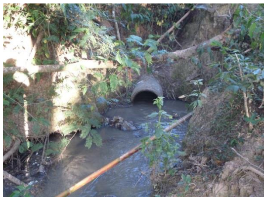
Figura 4.15 – Lançamento in natura no córrego da Chácara – Bairro Jaraguá Fonte: COBRAPE (2014)
