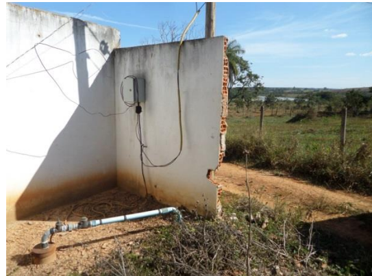
Figura 4.8 - Poço tubular de Paredão Fonte: COBRAPE (2014)
