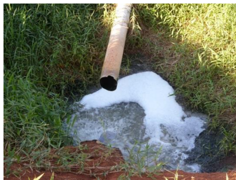
Figura 4.18 – Tubulação rompida na estrada da lagoa facultativa
