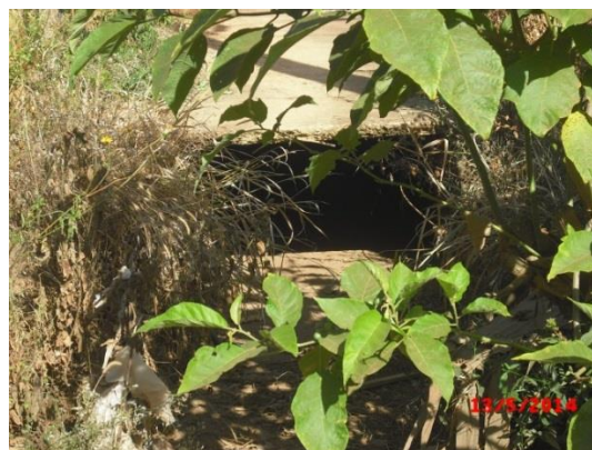
Figura 4.38 – Gaçeria de águas pluviais Foto: COBRAPE (2014)
