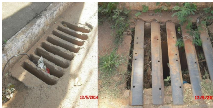
Captção de Água Pluvial, Rua Deusdedit A. Souza
