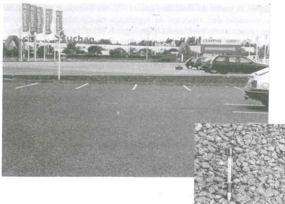
Figura– Utilização de pavimento poroso em estacionamento
