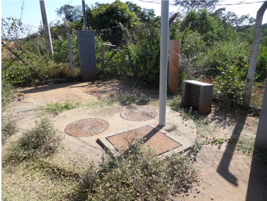
Figura 7.94 – Estação elevatória do bairro Aguada
