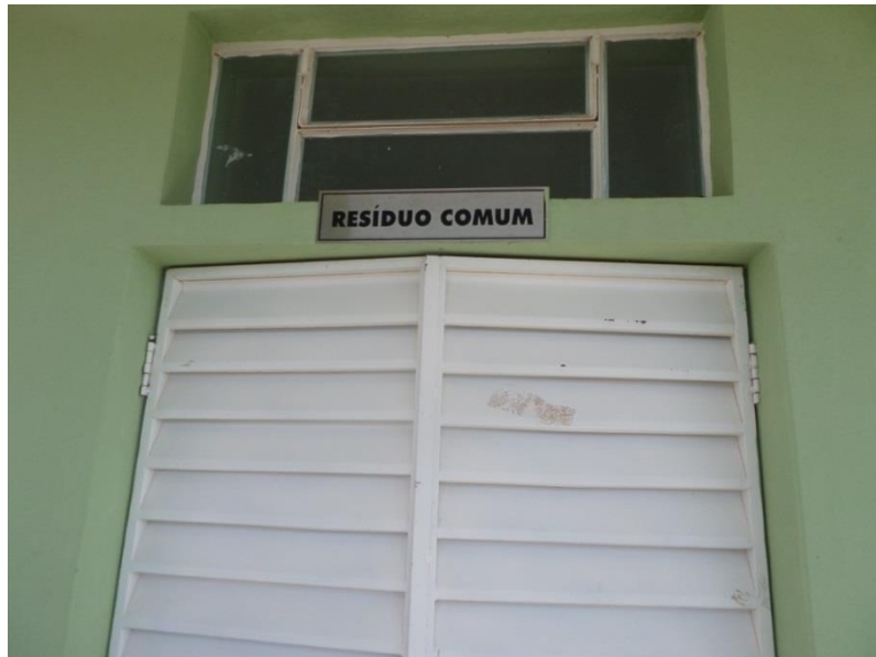
Figura 7.150 – Local de armazenamento dos resíduos comuns na Unidade Irma Inez Carta
