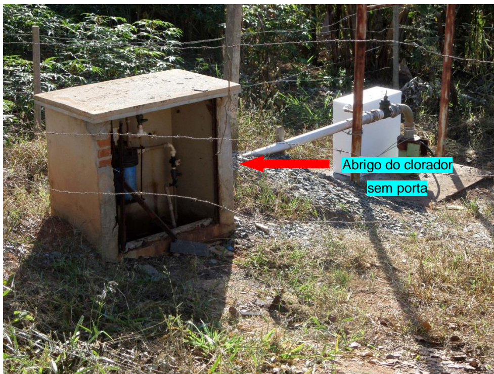
Figura 7.58 – Poço do Mário operado pelo SMAE. Detalhe para o abrigo do clorador sem porta.
