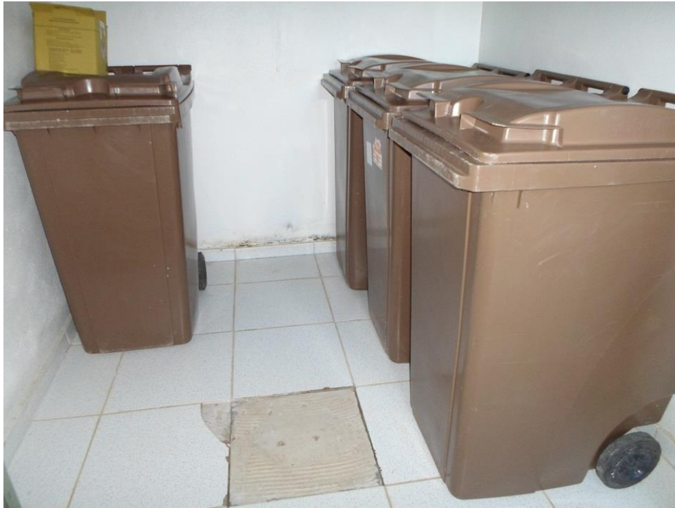
Figura 7.135 – Armazenamento de RSS na Unidade Cândido Gonçalves dos Reis
