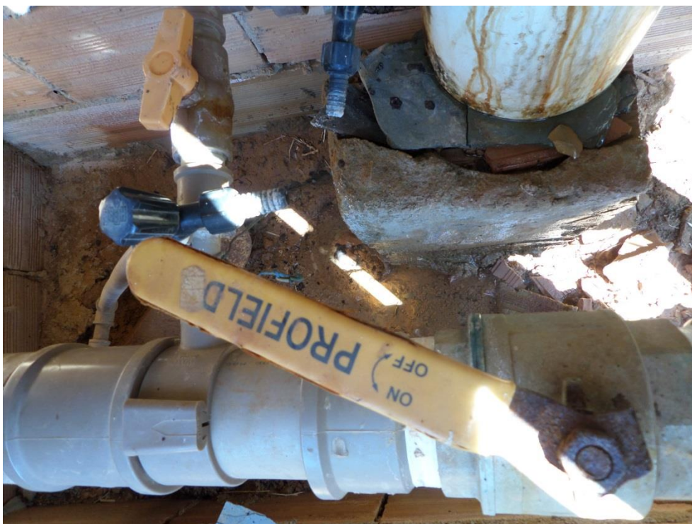
Figura 7.51 – Detalhe para vazamento do clorador no poço Cacau 2 operado pelo SMAE
