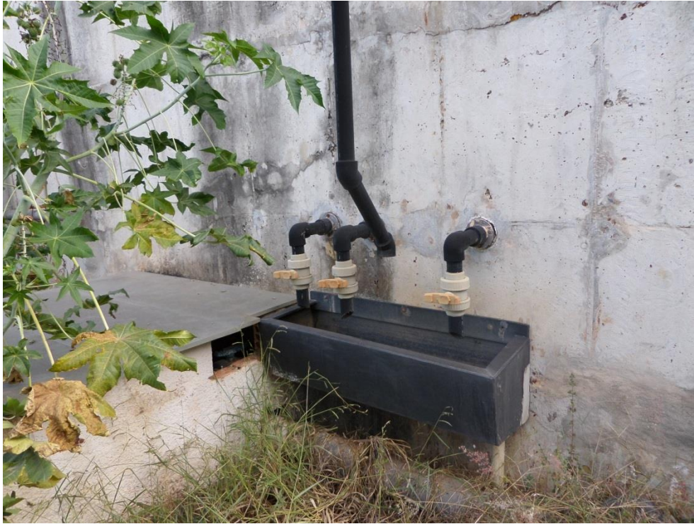
Figura 7.99 – Ponto de monitoramento do esgoto no reator UASB
