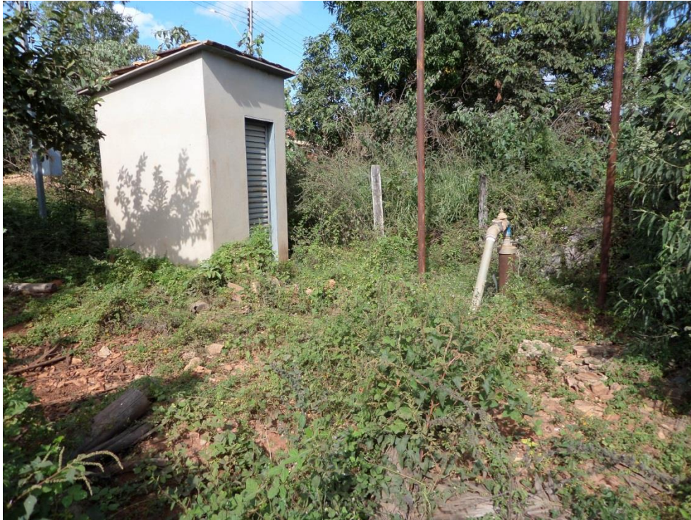
Figura 7.63 – Poço Povoado do Costas, operado pelo SMAE
