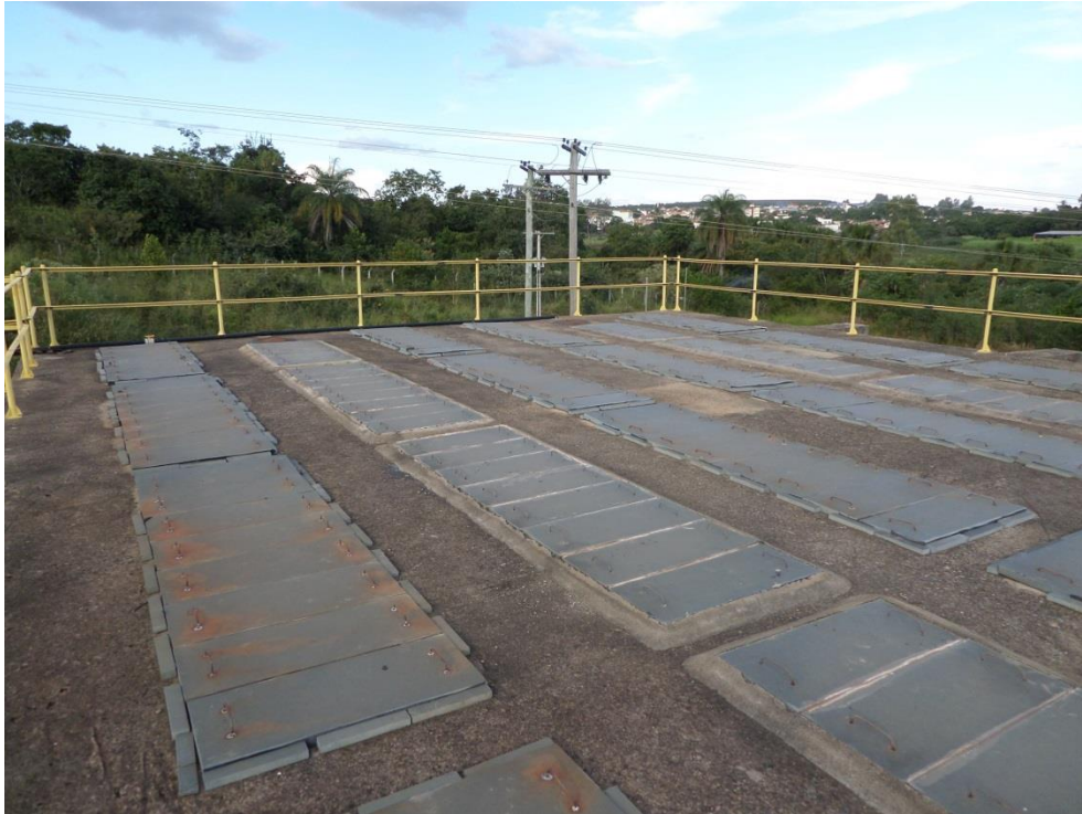
Figura 7.98 – Reator UASB operado pelo SMAE
