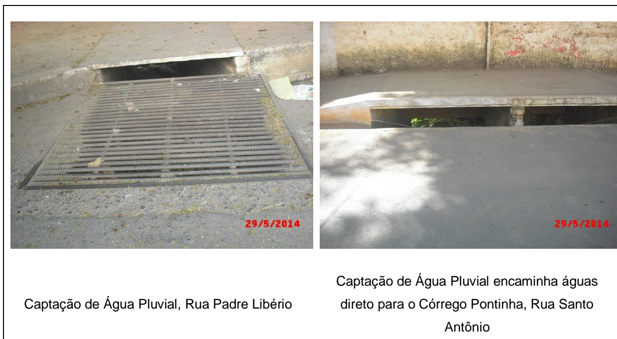
Figura 7.193 - Dispositivos de Microdrenagem existentes - Sede
