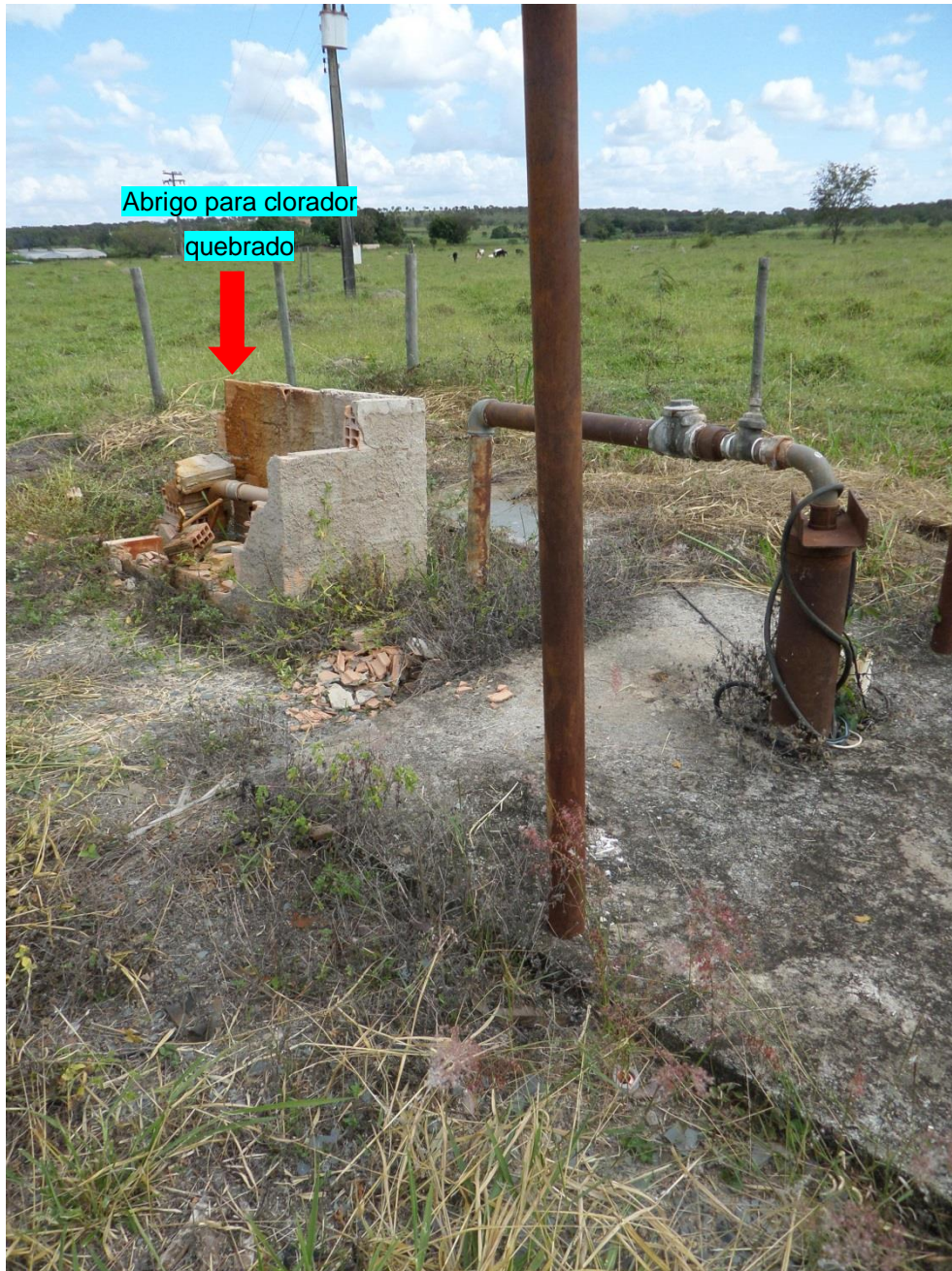
Figura 7.59 – Poço 1) Vargem Grande, operado pelo SMAE. Detalhe para parede quebrada do clorador
