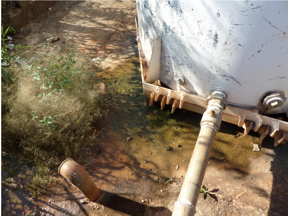
Figura 7.73 – Detalhe para o vazamento no reservatório Vasco Lopes operado pelo SMAE
