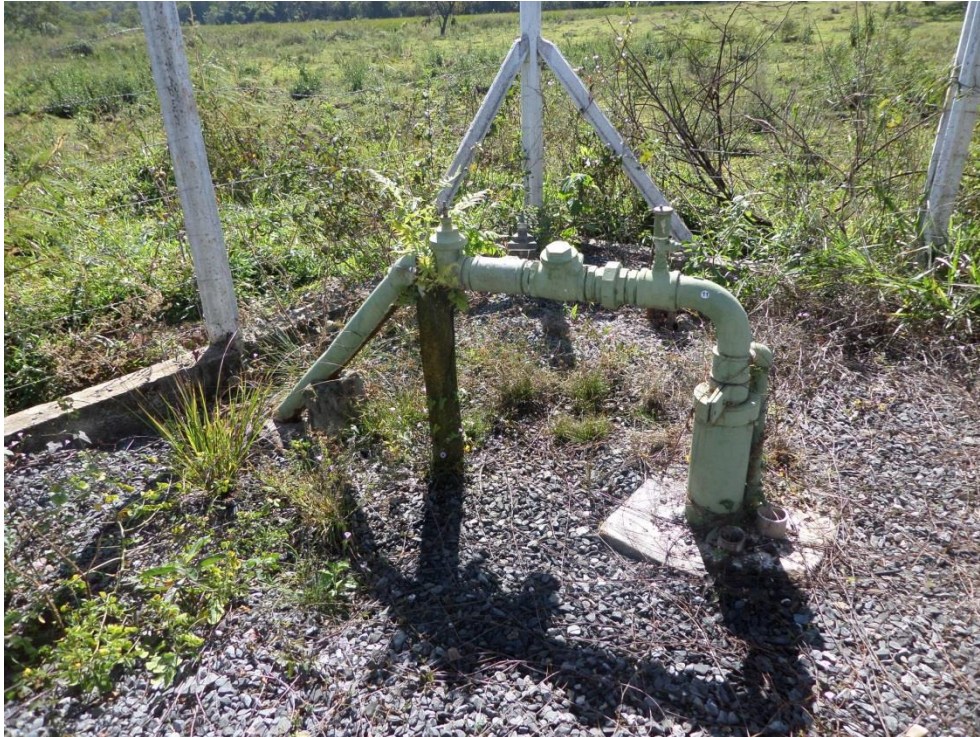
Figura 7.55 – Poço Cacau 1 ou Lineu COPASA, operado pelo SMAE
