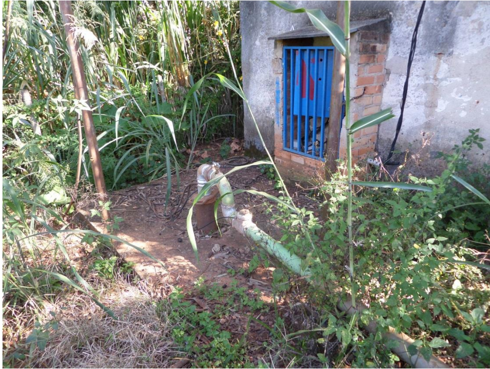
Figura 7.56 – Poço Aurora 1 ou Reserva Aurora, operado pelo SMAE
