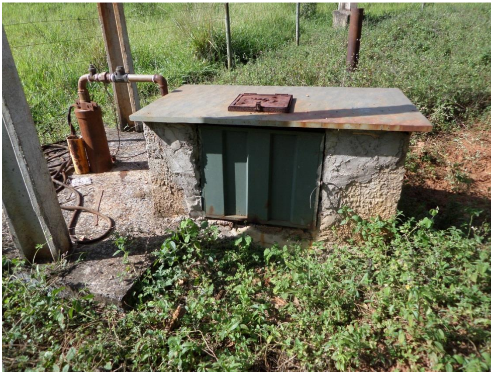
Figura 7.61 – Poço Riacho de Areia, operado pelo SMAE
