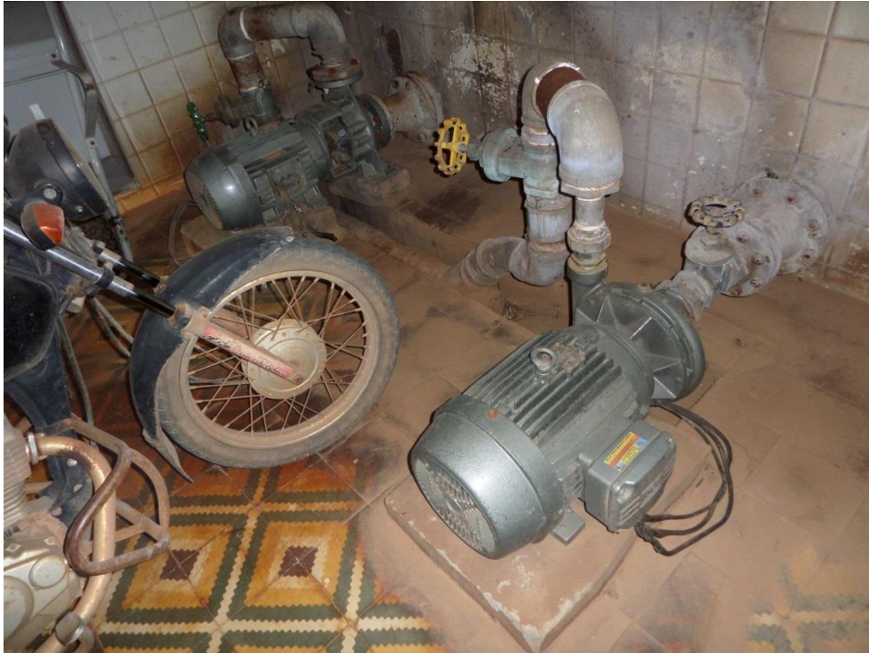
Figura 7.69 – Elevatória de água tratada no reservatório do Depósito, operado pelo SMAE
