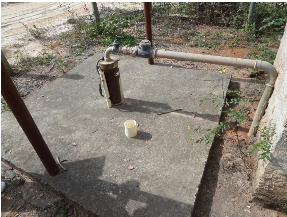
Figura 7.60 – Poço 2) Vargem Grande, operado pelo SMAE
