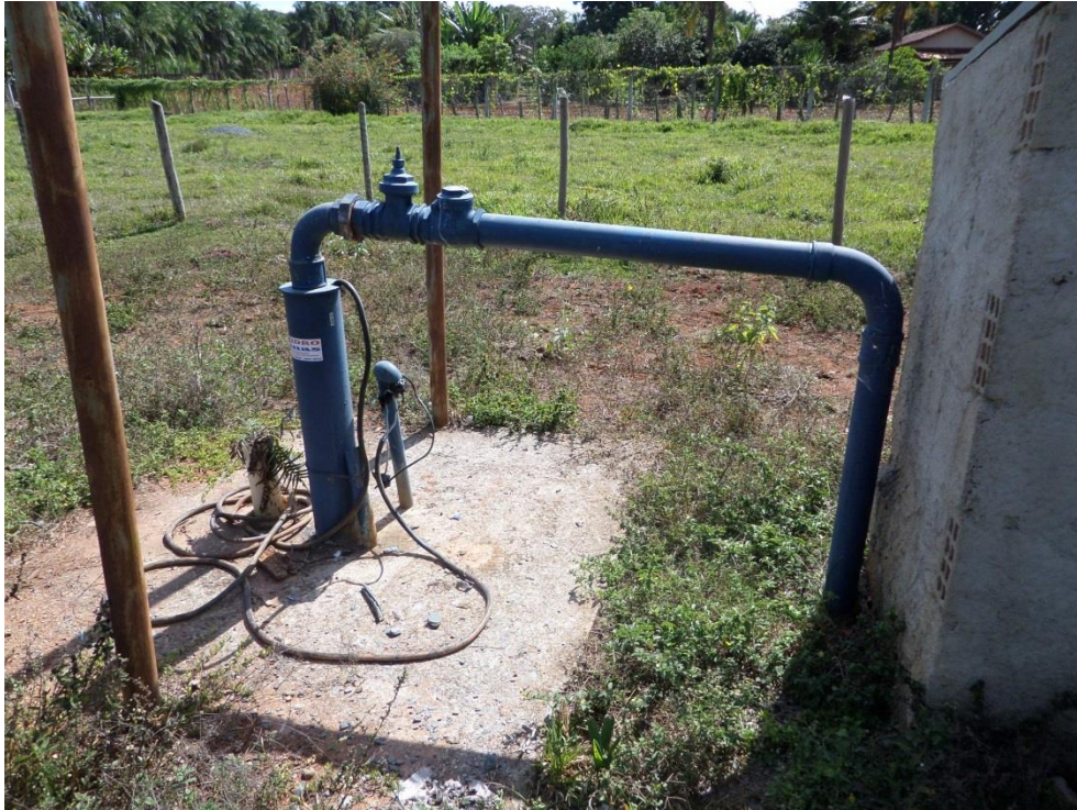
Figura 7.52 – Poço Mozart Fernando operado pelo SMAE
