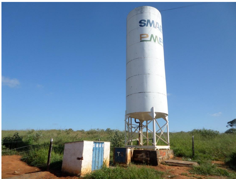
Figura 7.82 – Reservatório Torre operado pelo SMAE
