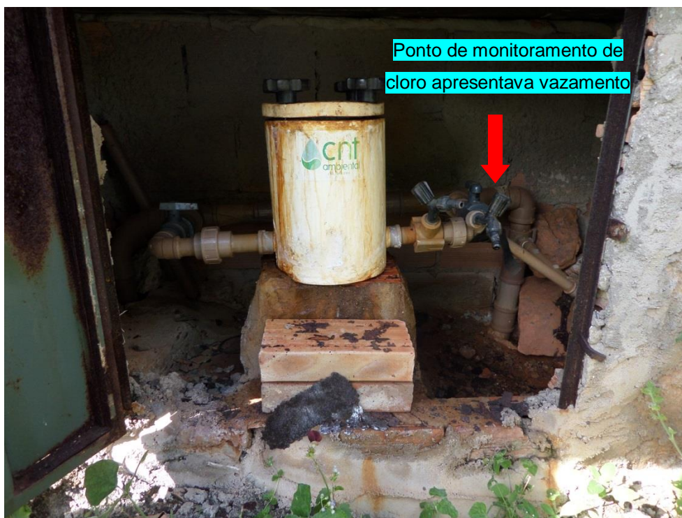
Figura 7.62 – Detalhe para vazamento no ponto de monitoramento de cloro do poço de Riacho de Areia operado pelo SMAE
