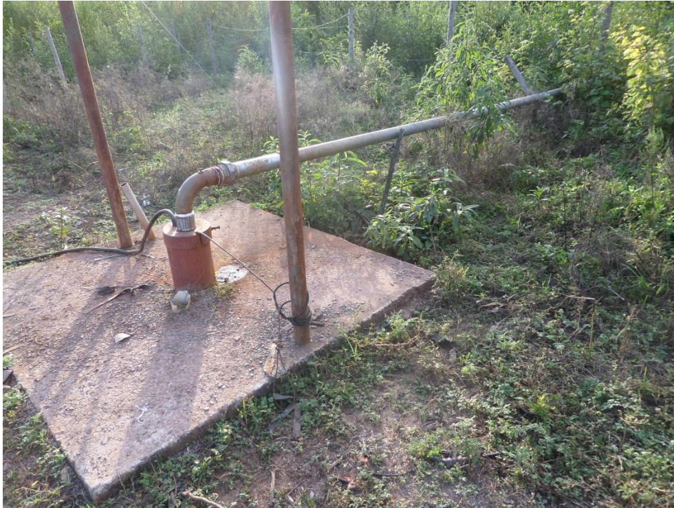
Figura 7.41 – Poço da Torre operado pelo SMAE
