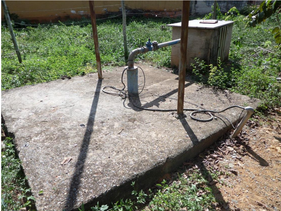
Figura 7.53 – Poço do Walter operado pelo SMAE
