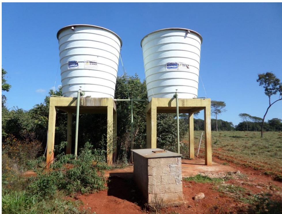
Figura 7.86 – Reservatório Aguada operado pelo SMAE
