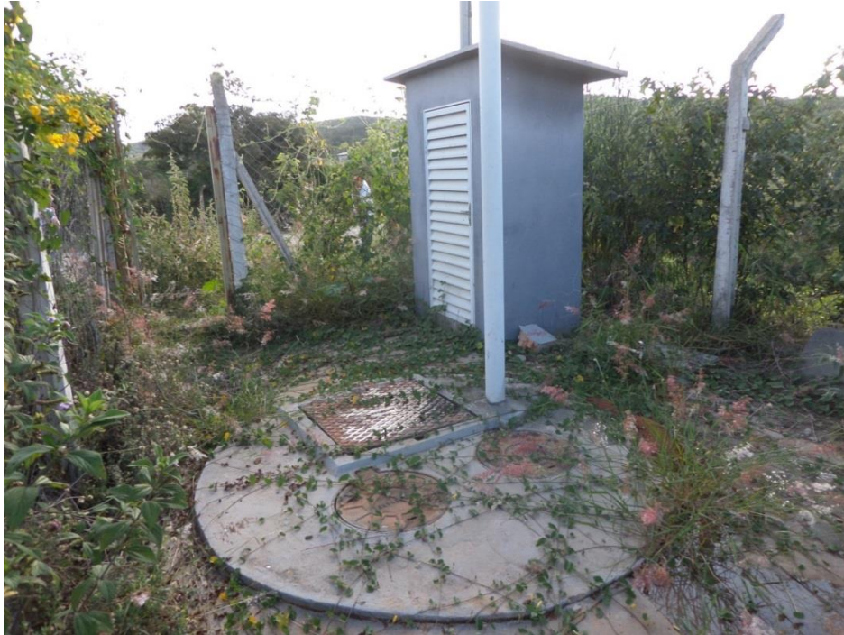
Figura 7.93 – Estação elevatória operada pelo SMAE
