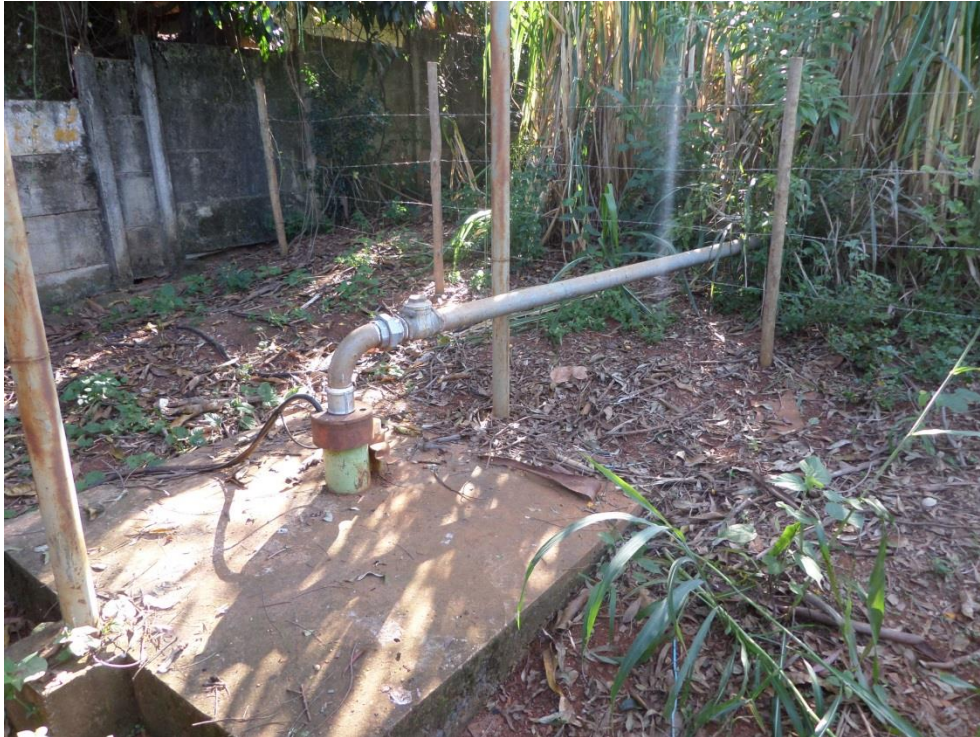
Figura 7.49 – Poço da Aurora 2 operado pelo SMAE
