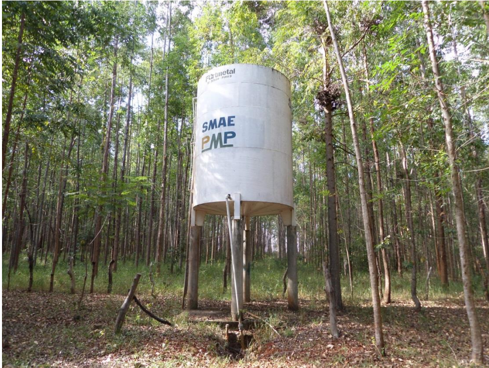
Figura 7.91 – Reservatório 2 – Povoado de Costas, operado pelo SMAE
