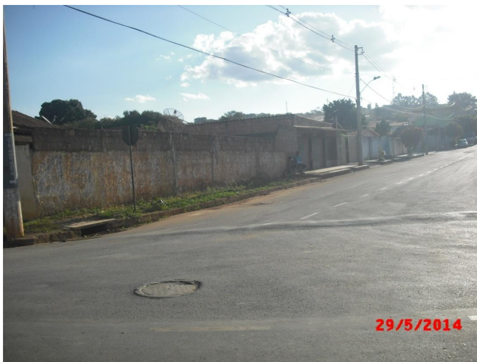
Ponto de alagamento e enxurrada, Rua Cidinho Gato
