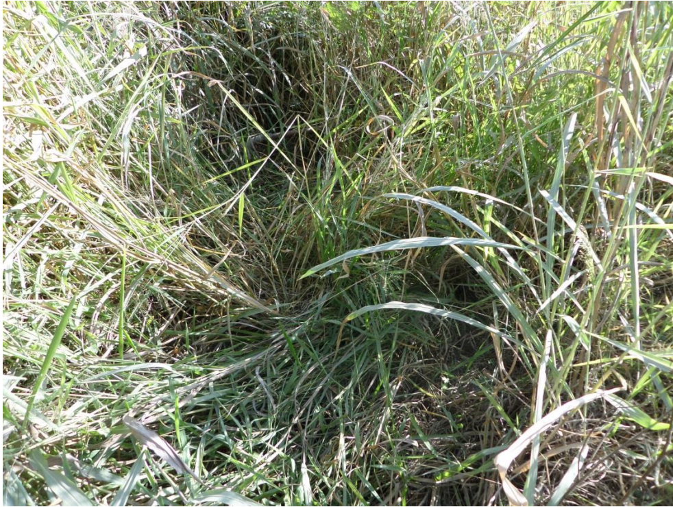
Figura 7.45 – Detalhe para paisagismo inadequado e para vegetação de grande porte dificultando a visualização do poço do Britador
