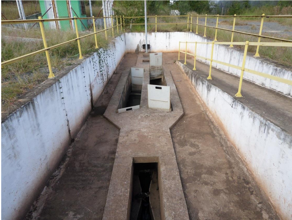
Figura 7.97 – Tratamento preliminar na ETE operada pelo SMAE
