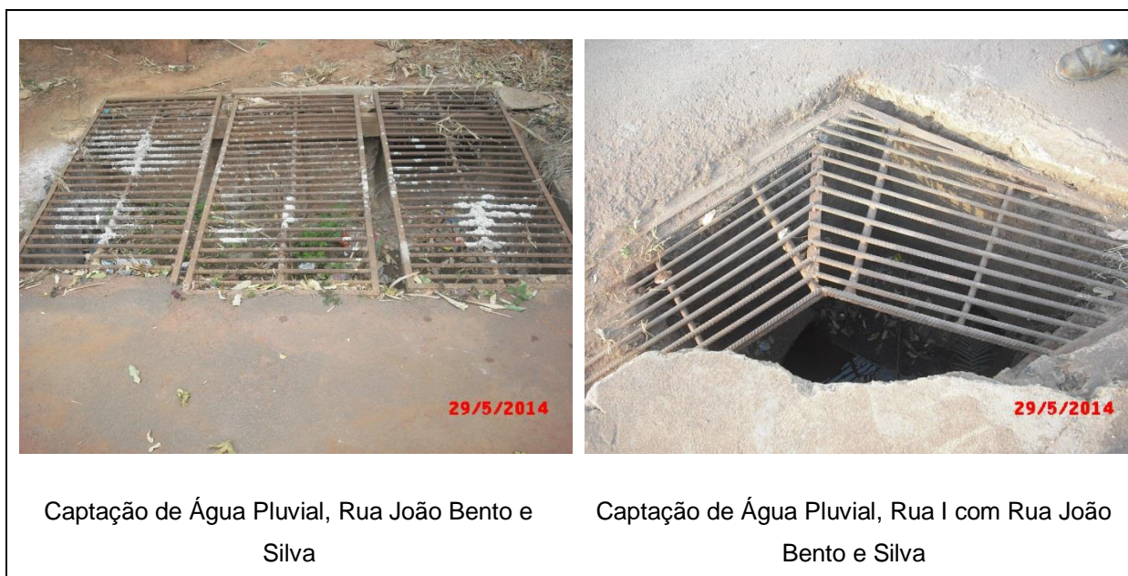
Figura 7.194 – Dispositivos de Microdrenagem existentes - Sede
