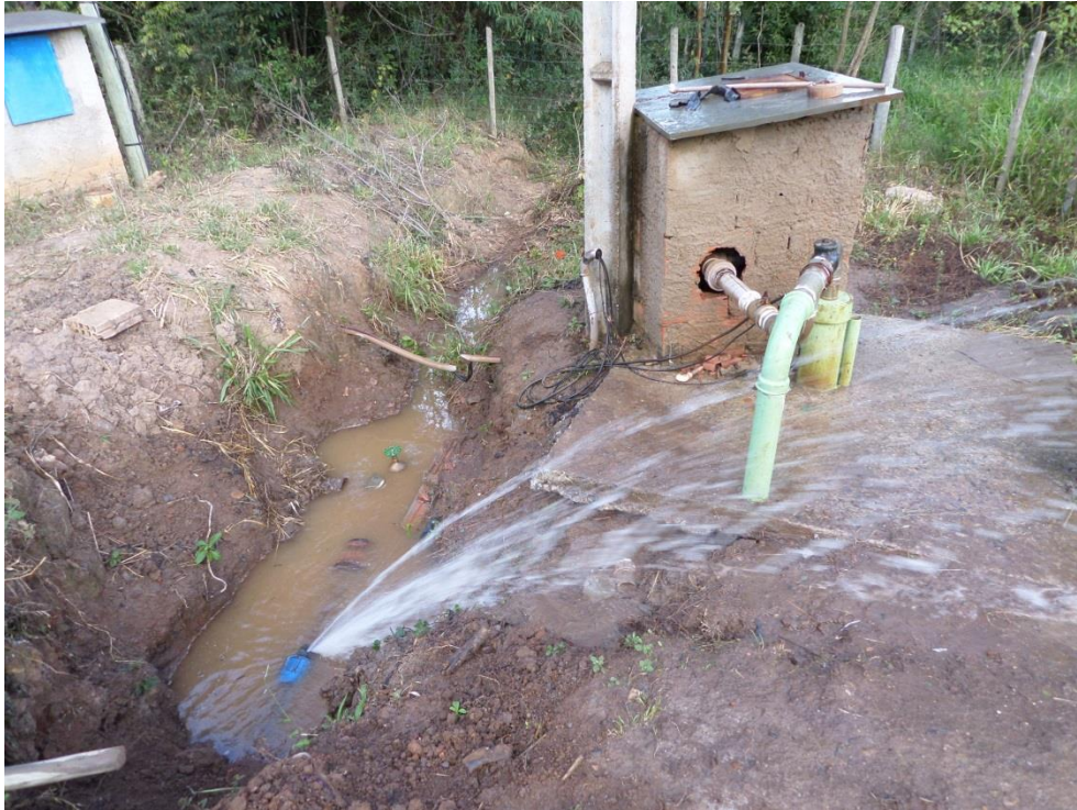
Figura 7.47 – Detalhe para vazamento na tubulação ao lado do poço ETE 1 ou da Lagoa
