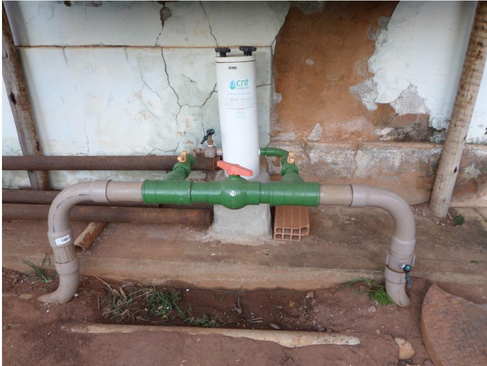
Figura 7.66 – Reservatório Depósito operado pelo SMAE. Detalhe para o clorador presente na área externa
