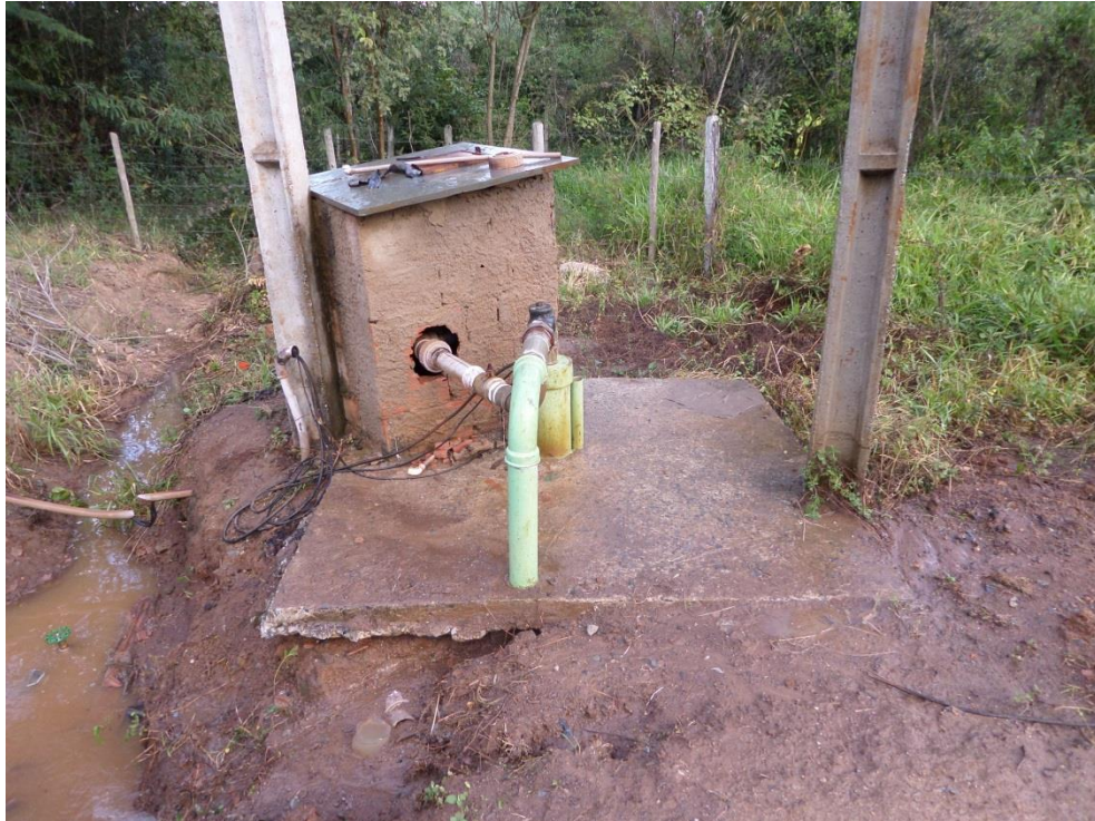
Figura 7.46 – Poço ETE 1 ou Campo da Lagoa operado pelo SMAE
