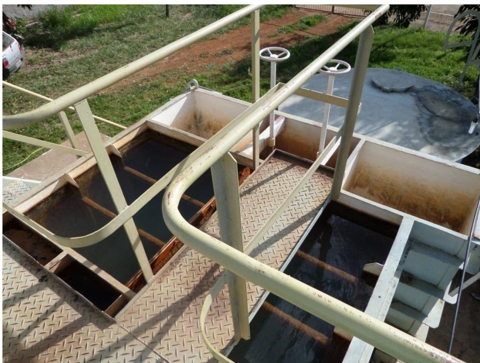
Figura 8.71– Unidades de decantação da ETA
