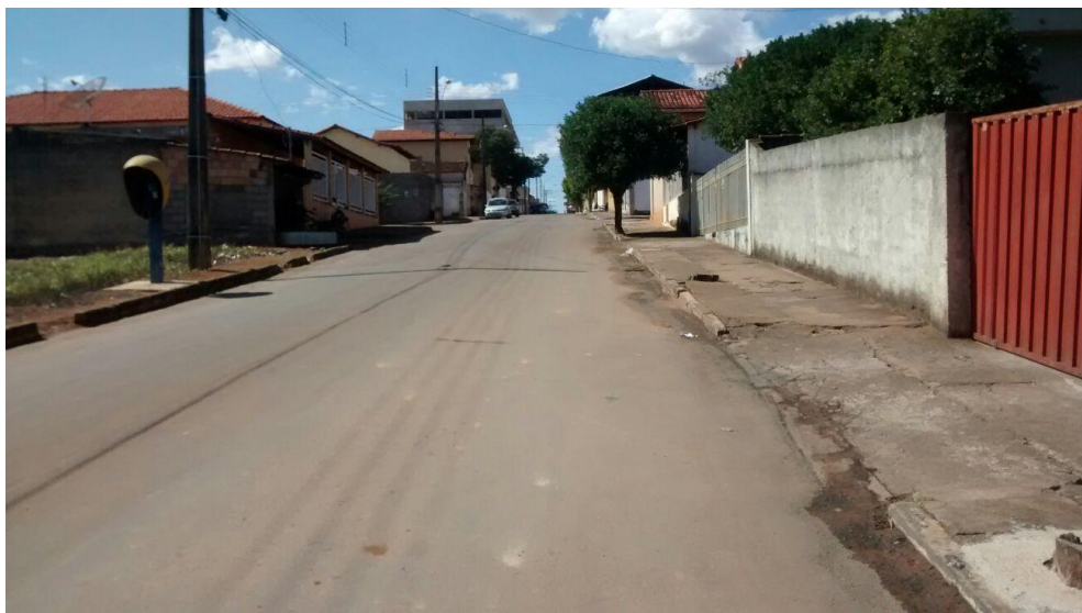
Figura 8.36 –Asfalto da Rua Guarani, Moema
