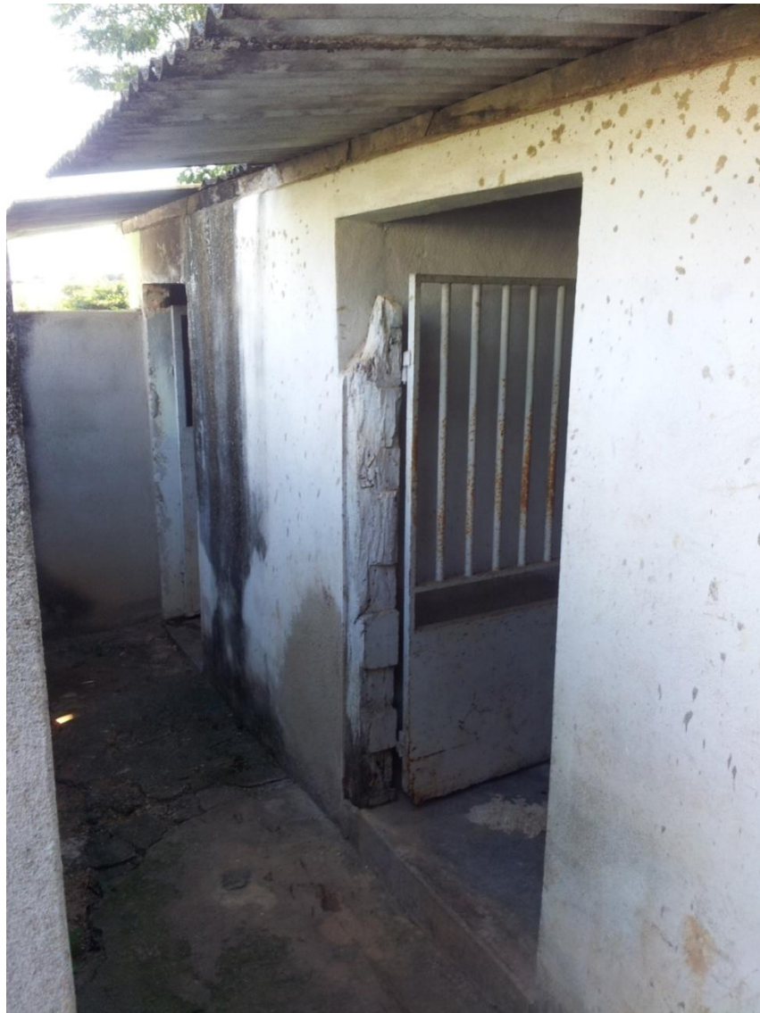
Figura 8.134– Atual abrigo para armazenamento de RSS – Hospital Professor Basílio
