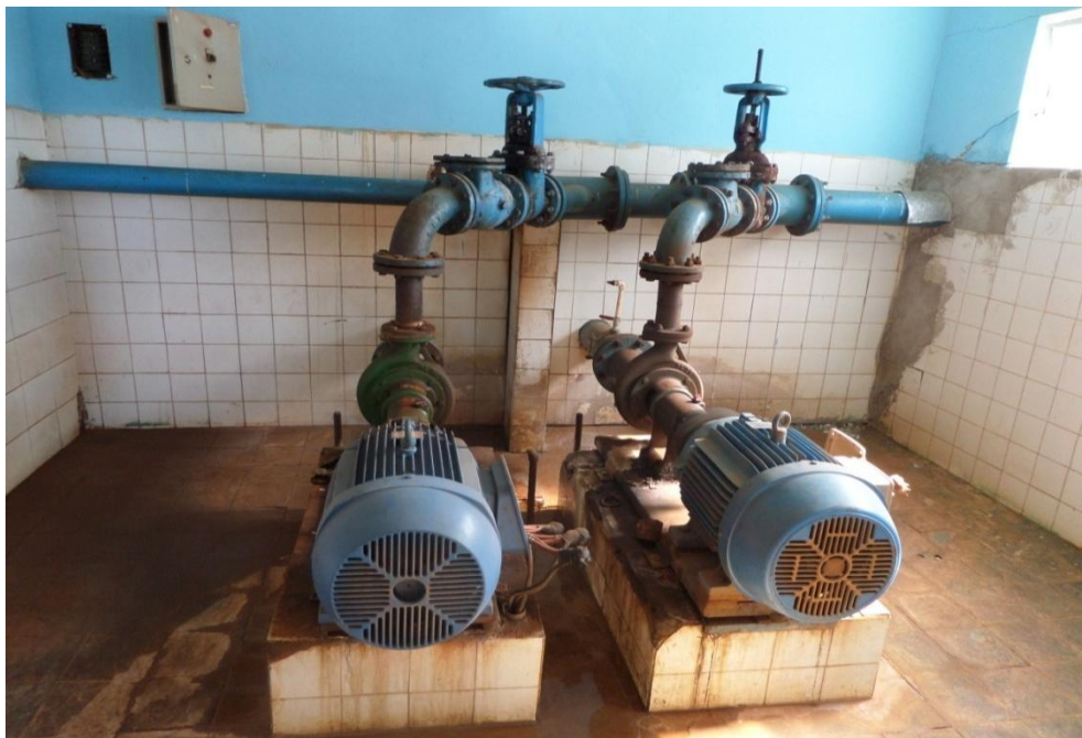
Figura 8.48– Casa de bombas
