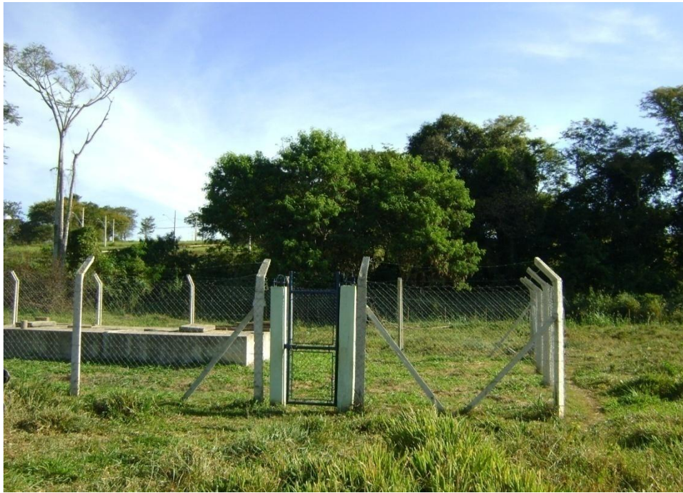
Figura 8.83 - Segunda estação elevatória de esgoto de Moema
