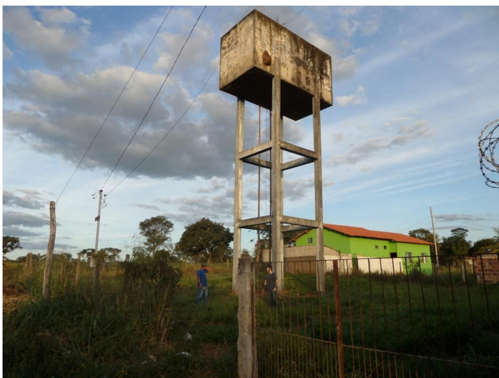
Figura 8.61–Reservatório do sistema Alvorada
