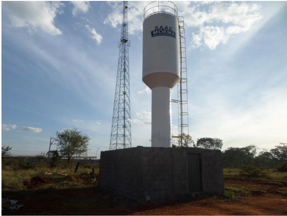
Figura 8.64–Reservatório do sistema do loteamento Recanto do Sabiá
