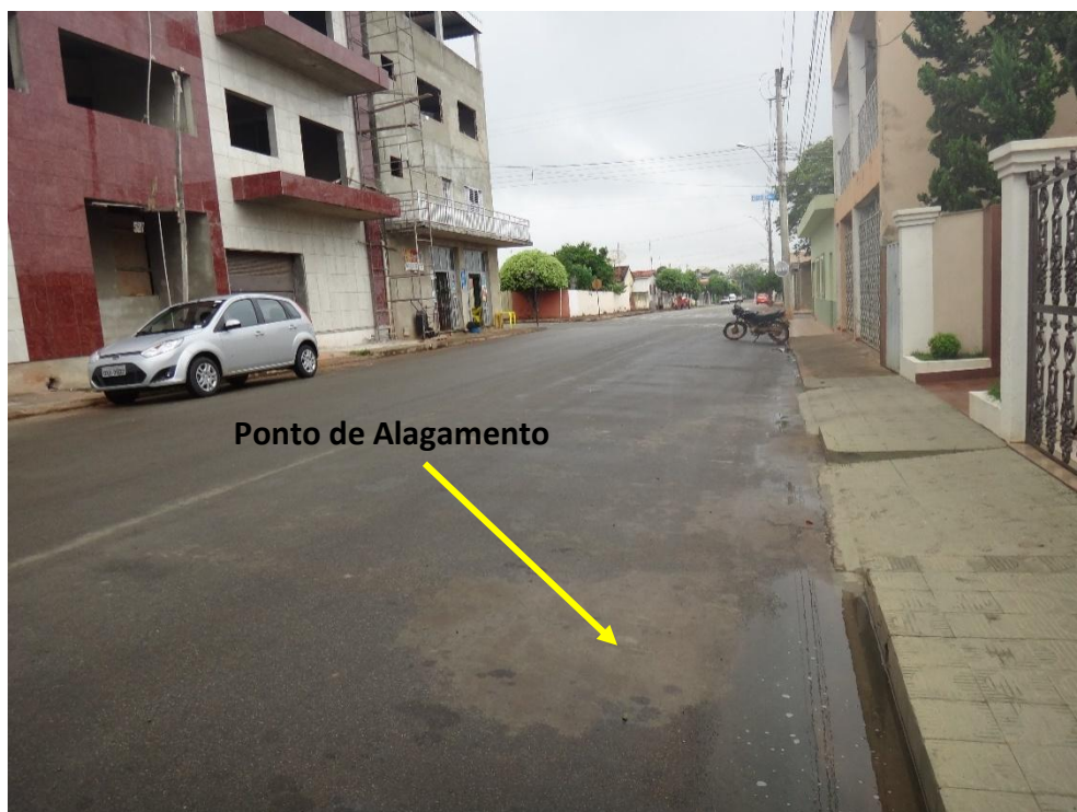
Ponto de alagamento na rua Tupis
