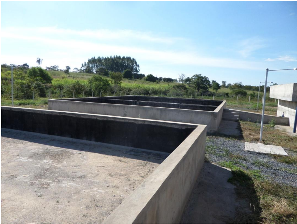
Figura 8.90–Leitos de secagem da ETE de Moema
