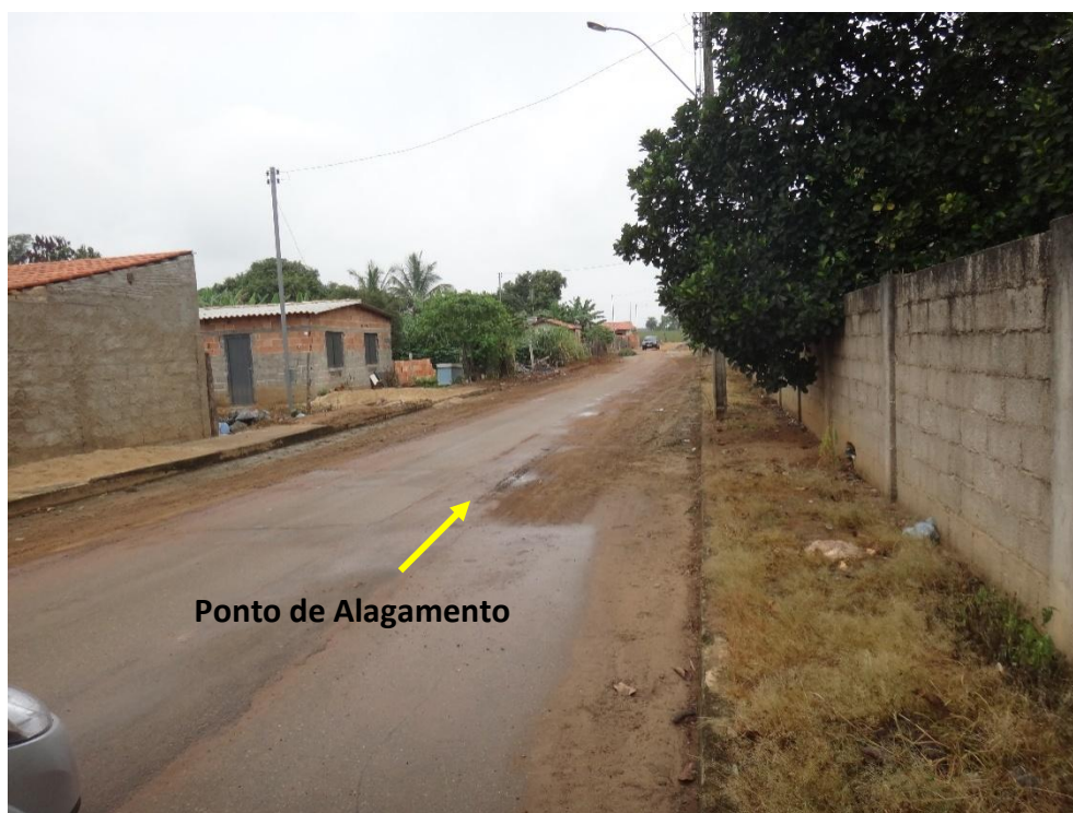
Ponto de Alagamento na rua Oito, ausência de sistema de drenagem
