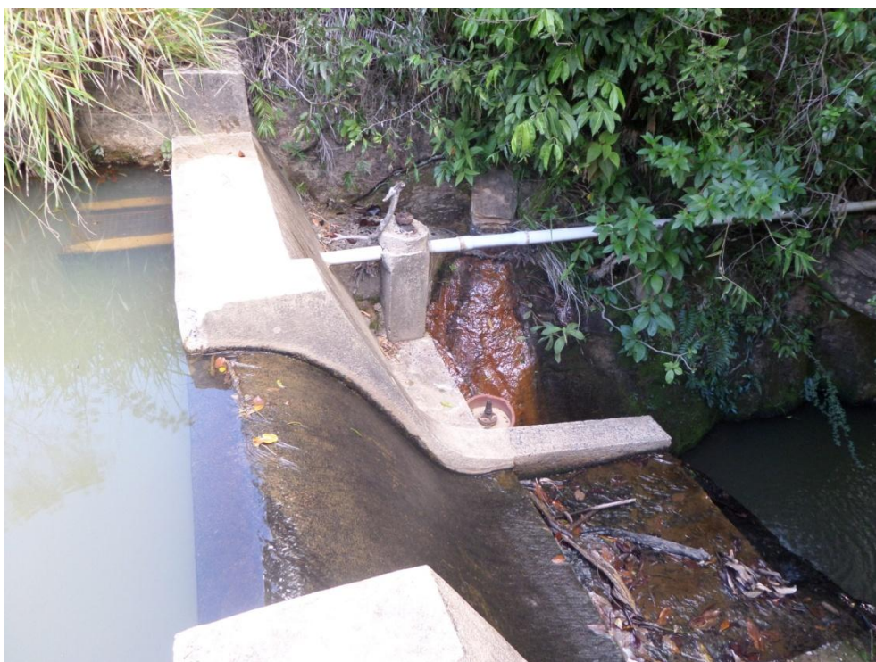
Figura 8.67–Barramento de captação do sistema do distrito da Chapada
