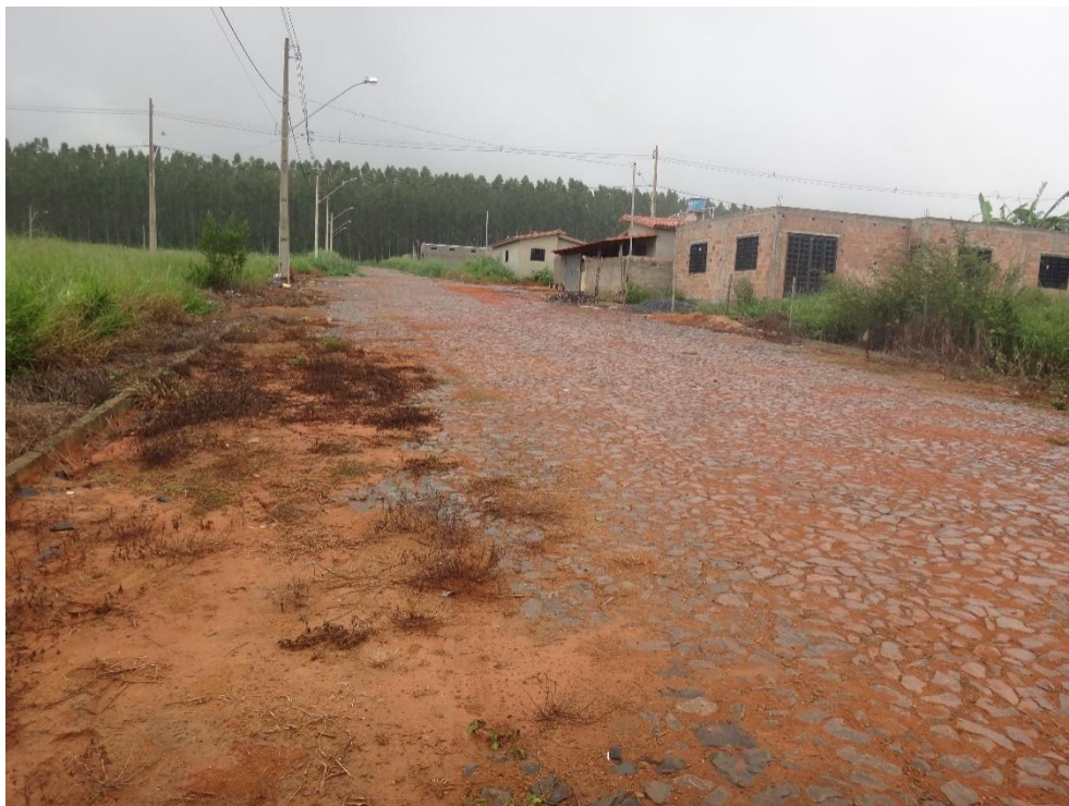
Risco de enxurrada na rua Tupis, Loteamento Palmeiras
