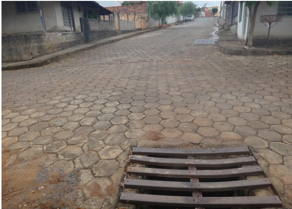
Figura 8.179 – Bocas de lobo com grelha na Rua Paraguaçu
