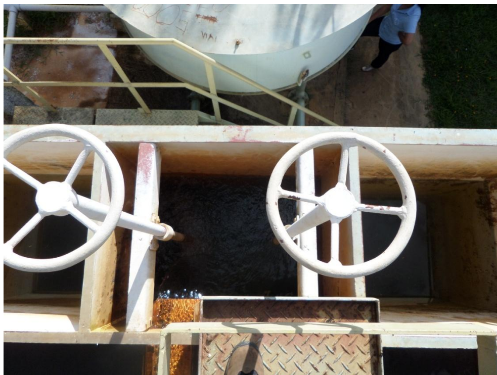
Figura 8.72– Unidades de filtração da ETA
