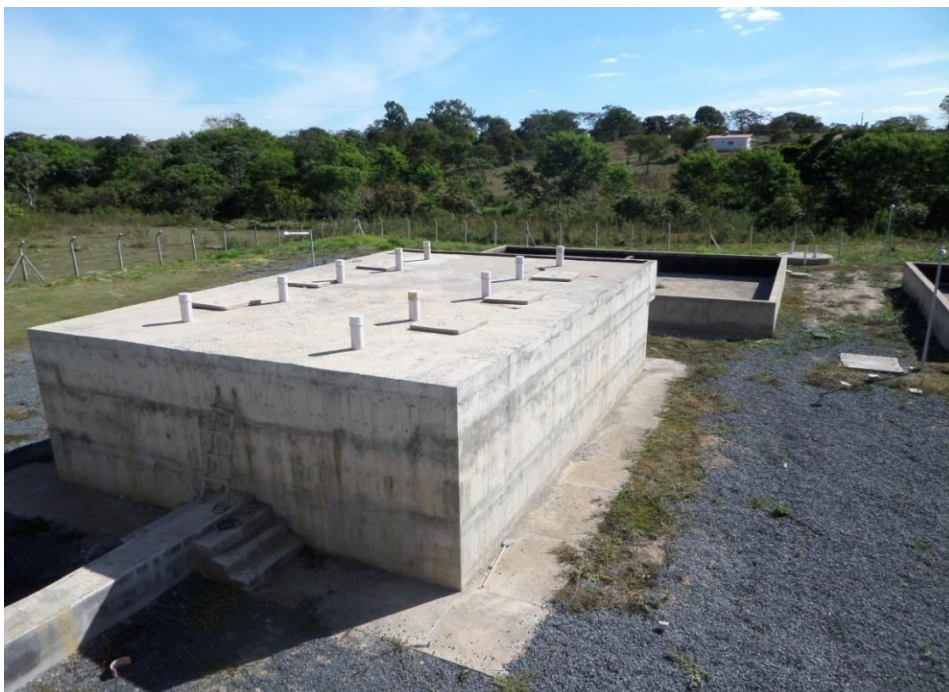
Figura 8.89–Filtro anaeróbio da ETE de Moema
