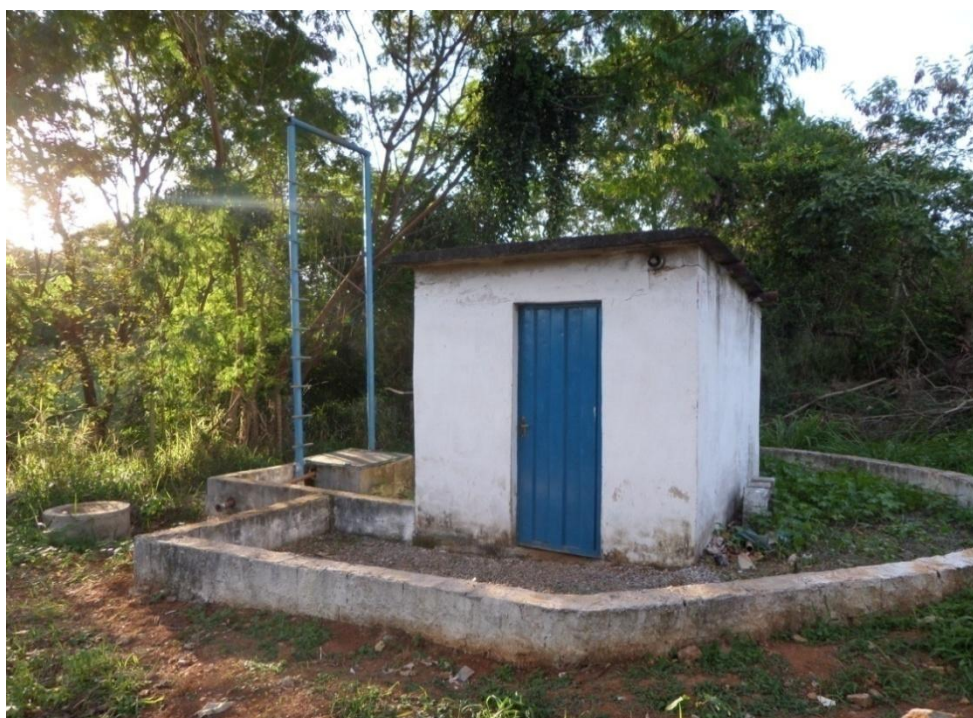
Figura 8.59–Poço tubular sistema Alvorada
