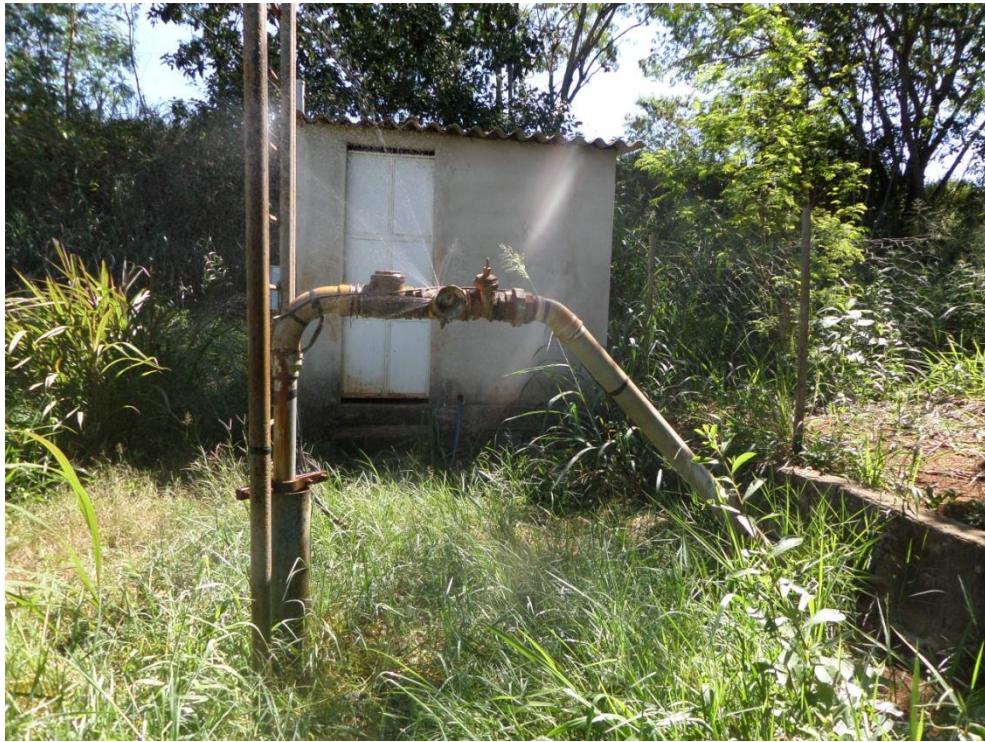
Figura 8.54– Poço tubular sistema bairro Palmeiras
