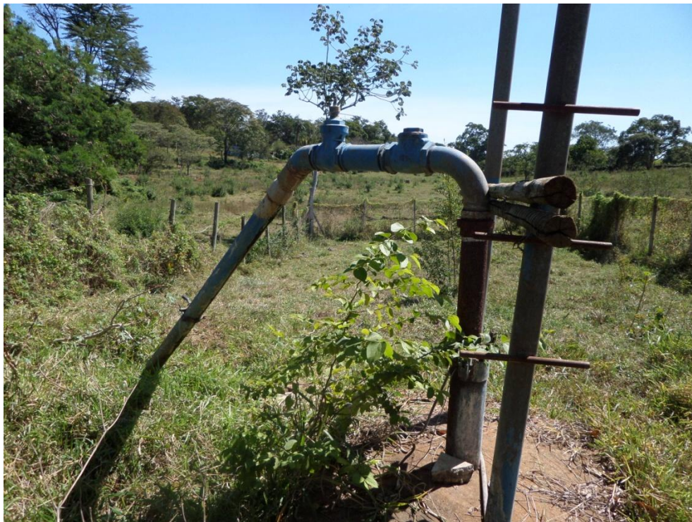
Figura 8.51– Poço tubular Rua Guaraciaba
