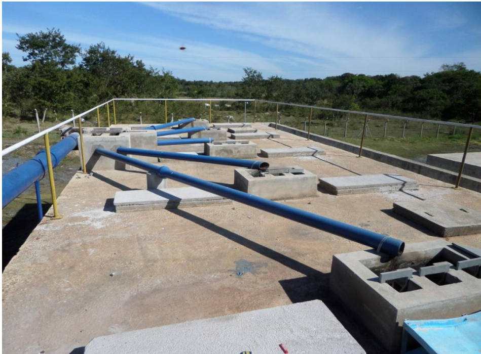
Figura 8.88 – Reator UASB da ETE de Moema
