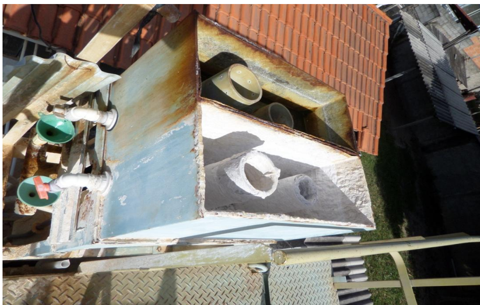
Figura 8.69–Local de adição de Cal hidratada e pré- cloração na ETA
