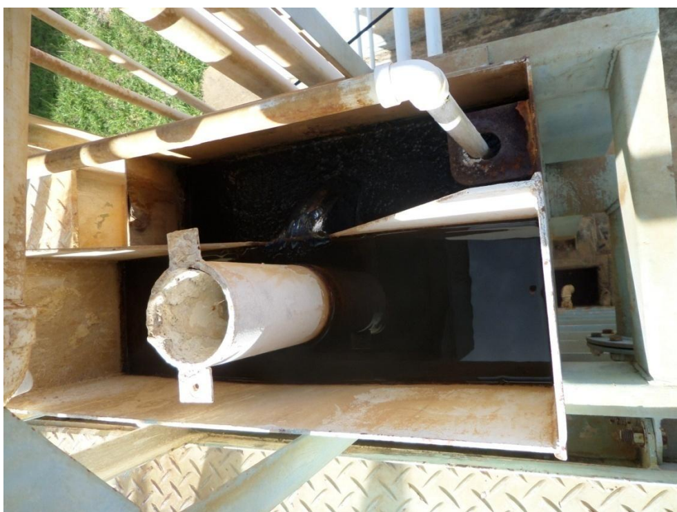
Figura 8.70–Medidor de vazão da ETA
