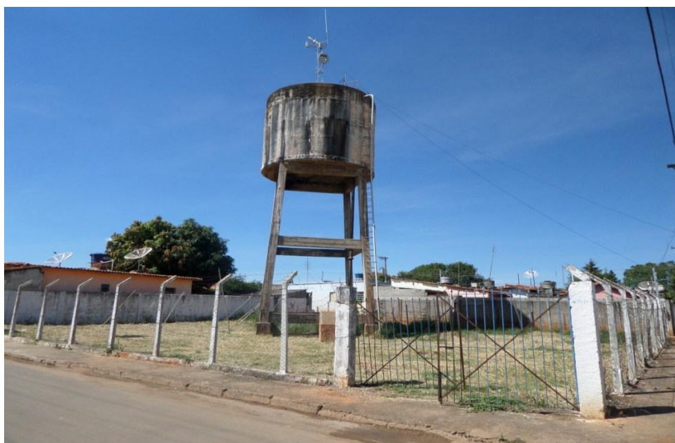
Figura 8.52– Reservatório do sistema centro
