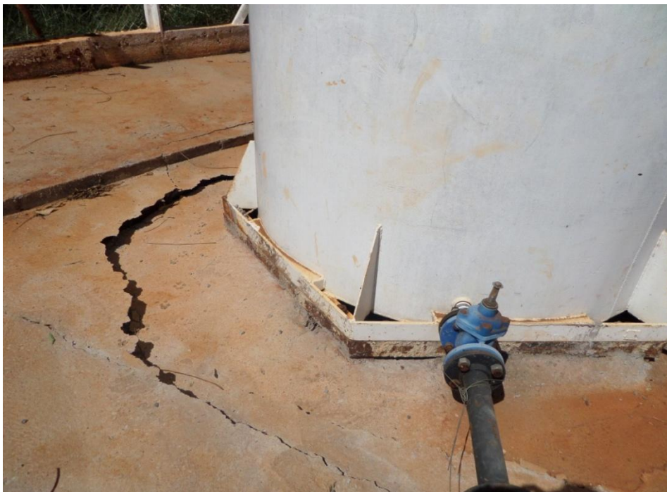
Figura 8.57–Piso de cimento danificado reservatório sistema bairro Palmeiras
