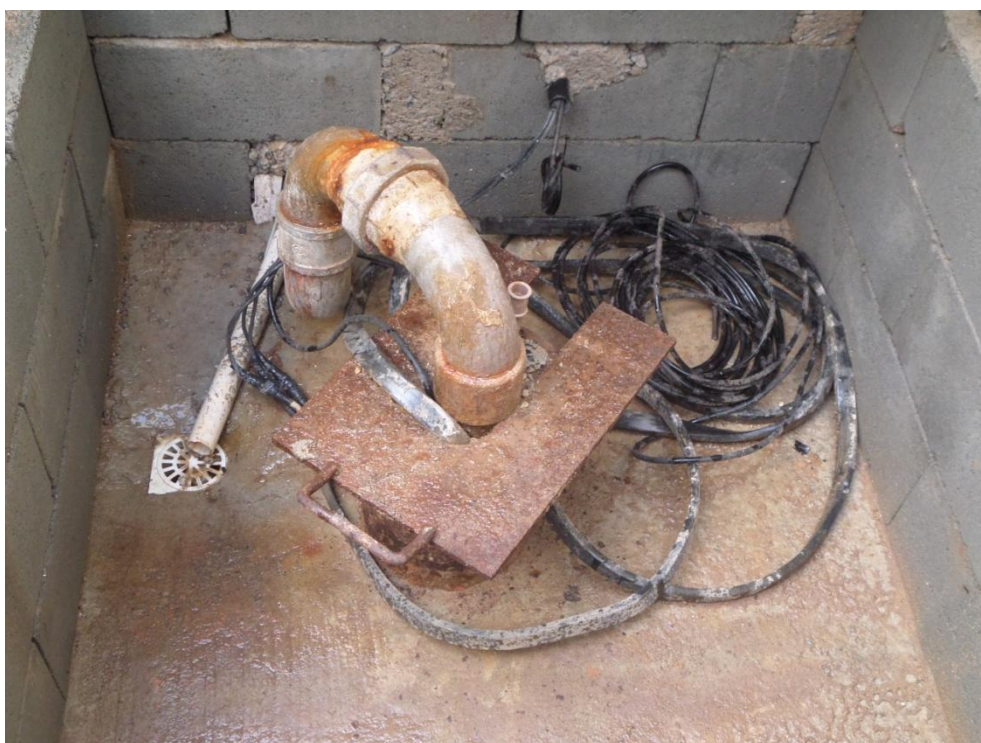
Figura 8.52– Poço tubular n° 3
