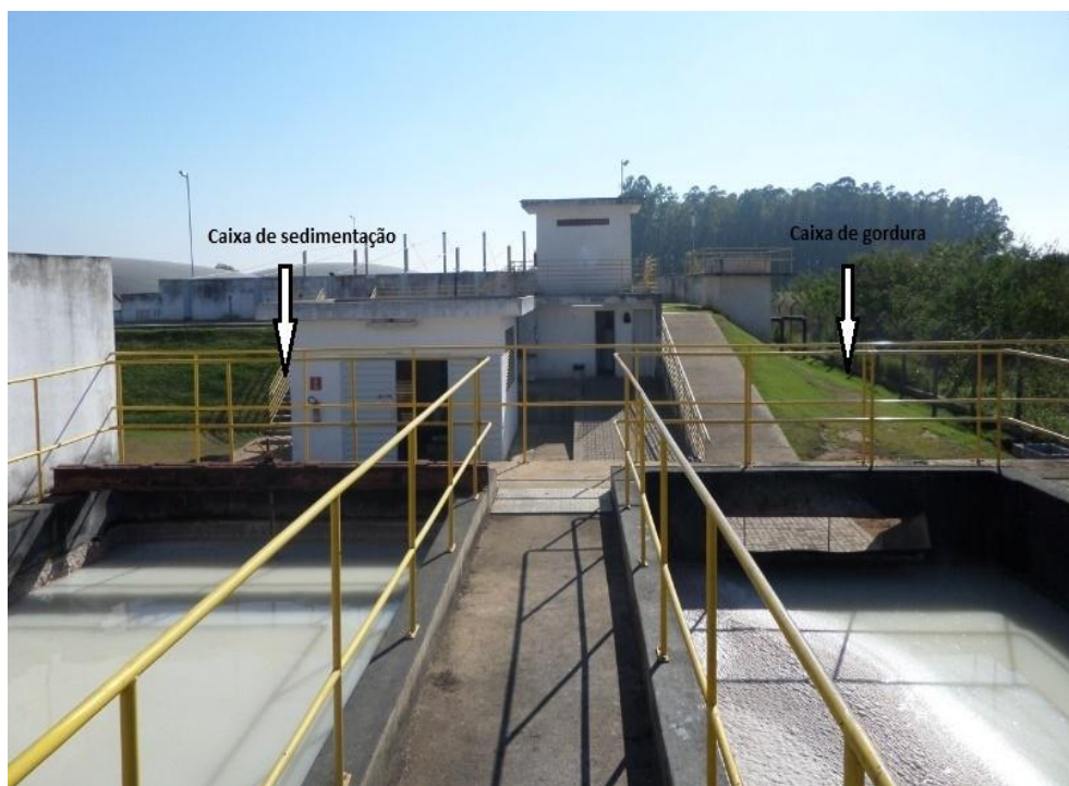
Figura 8.134 – Caixa de sedimentação e caixa de gordura
