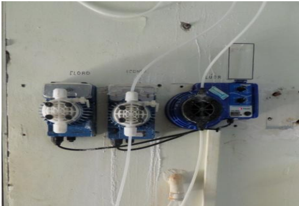
Figura 8.64– Dosadores de cloro, econox e flúor
