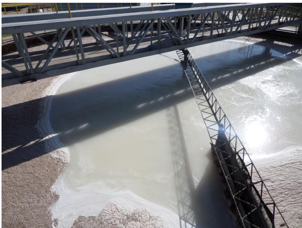
Figura 8.133 – Tanque de equalização
