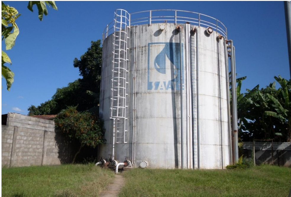
Figura 8.82– Reservatório da Rua Rio Grande do Sul
