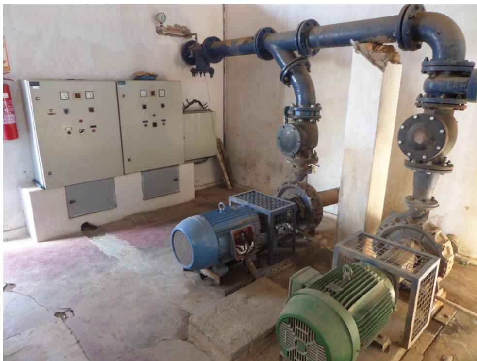
Figura 8.84– Estação elevatória de água tratada da Rua Pará
