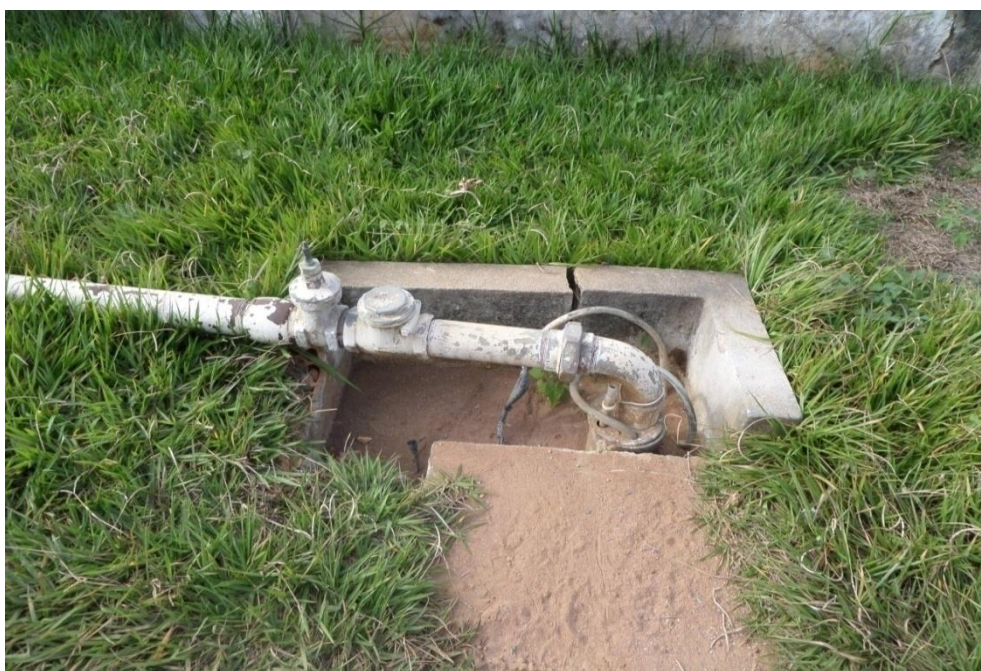
Figura 8.49– Poço tubular nº 1
