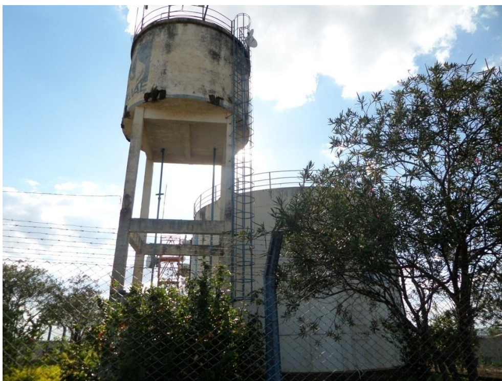
Figura 8.86– Reservatório de 100 m 3 da Rua João Jaffar
