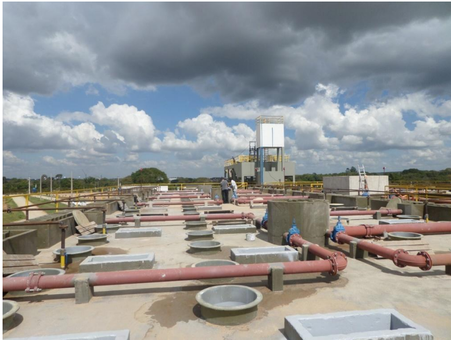
Figura 8.116–Vista externa dos reatores UASB
