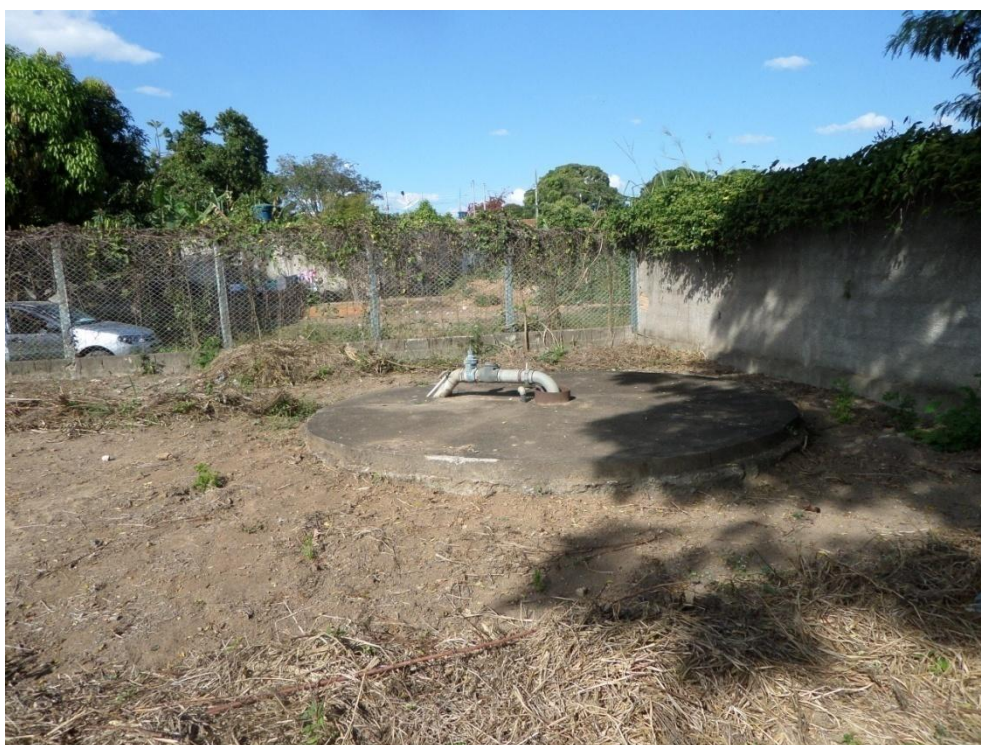
Figura 8.72– Poço tubular nº 25
