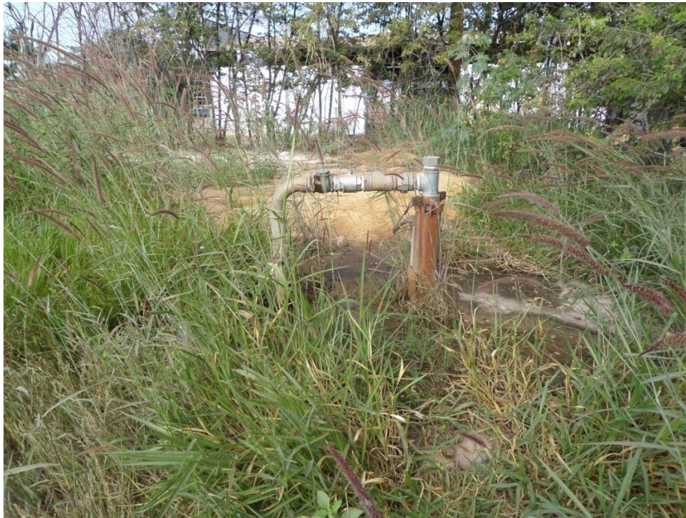
Figura 8.98– Poço tubular nº 12
