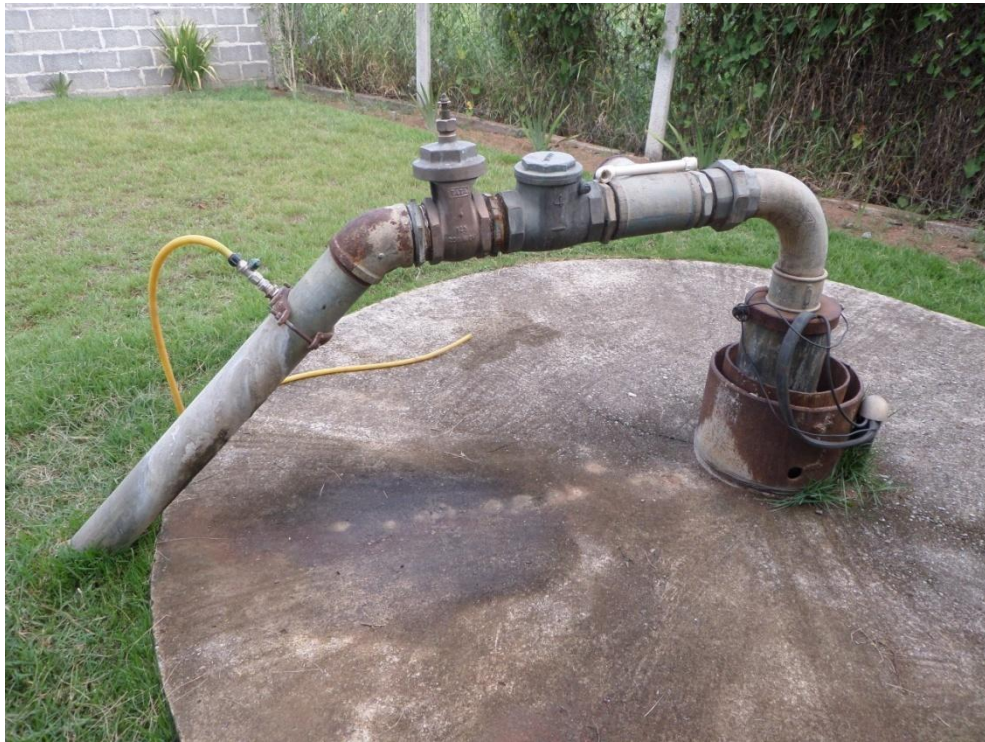
Figura 8.70– Poço tubular nº 23
