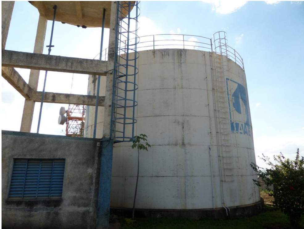
Figura 8.85– Reservatório de 1000 m 3 da Rua João Jaffar
