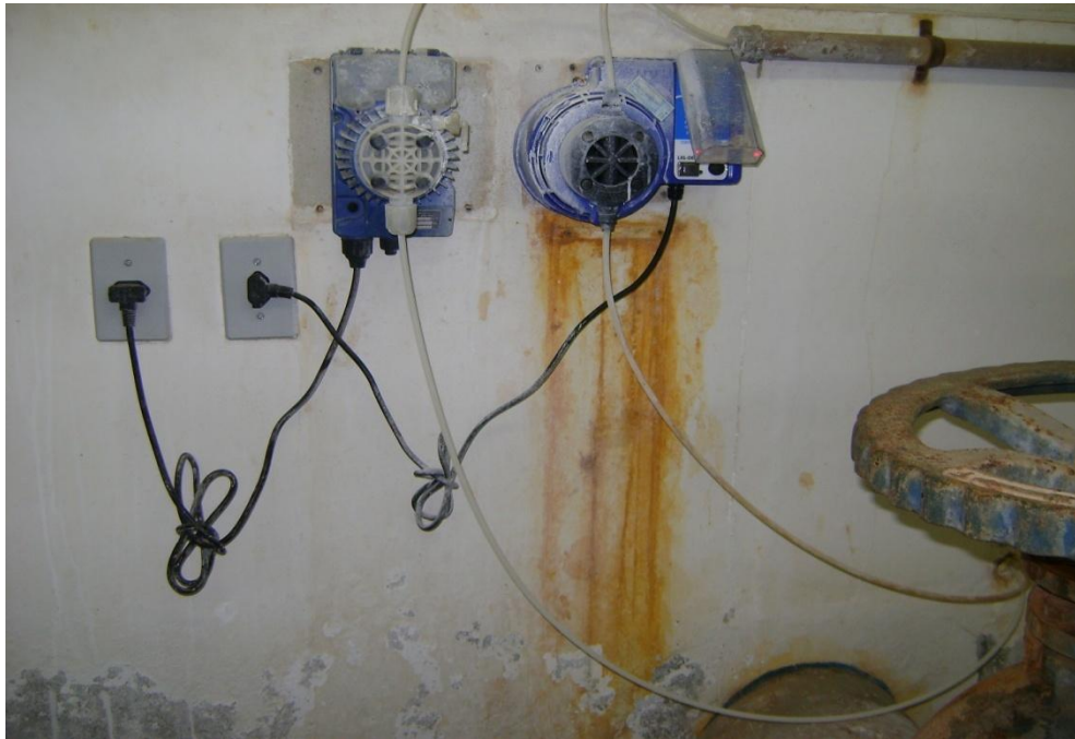
Figura 8.88– Dosadores de cloro e flúor
