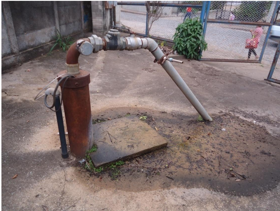
Figura 8.91– Poço tubular nº 16
