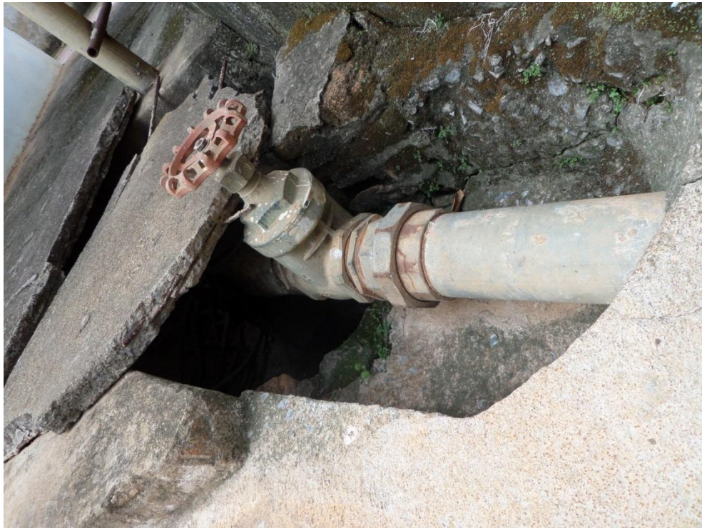
Figura 8.50– Poço tubular n° 2
