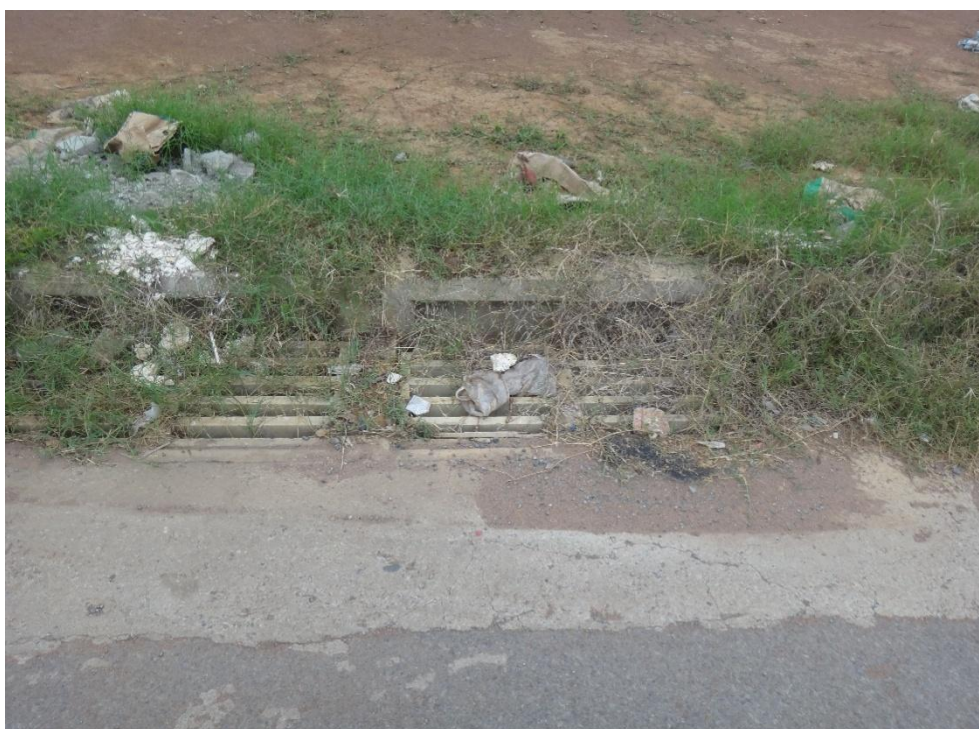
Figura 8.236– Boca de Lobo com grelha, Estrada da Peteca
