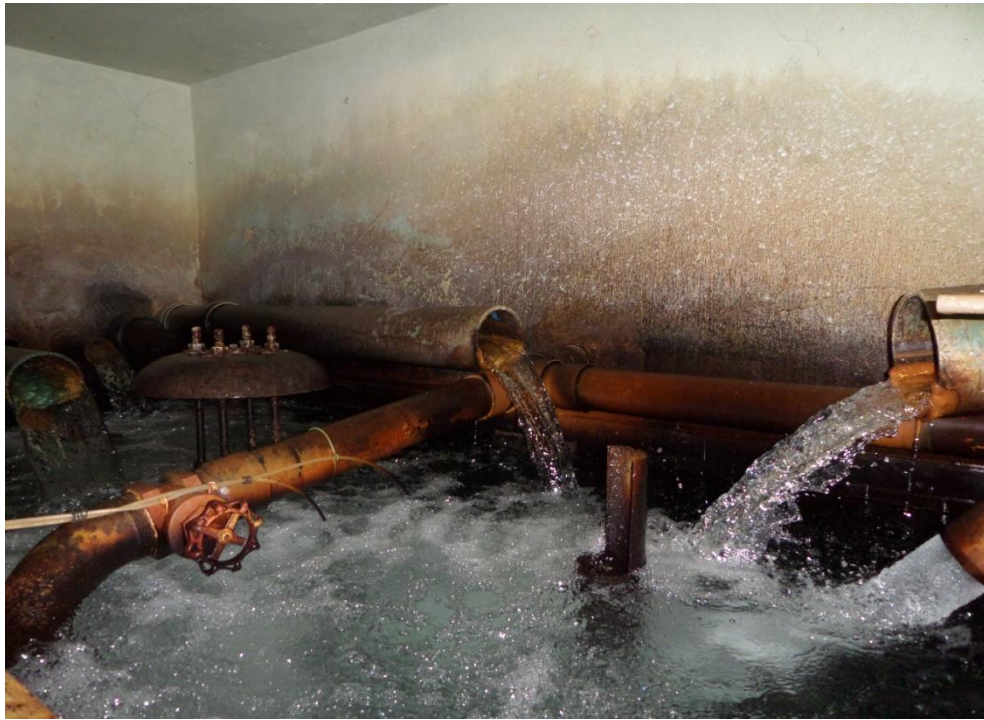
Figura 8.63– Tanque de contato
