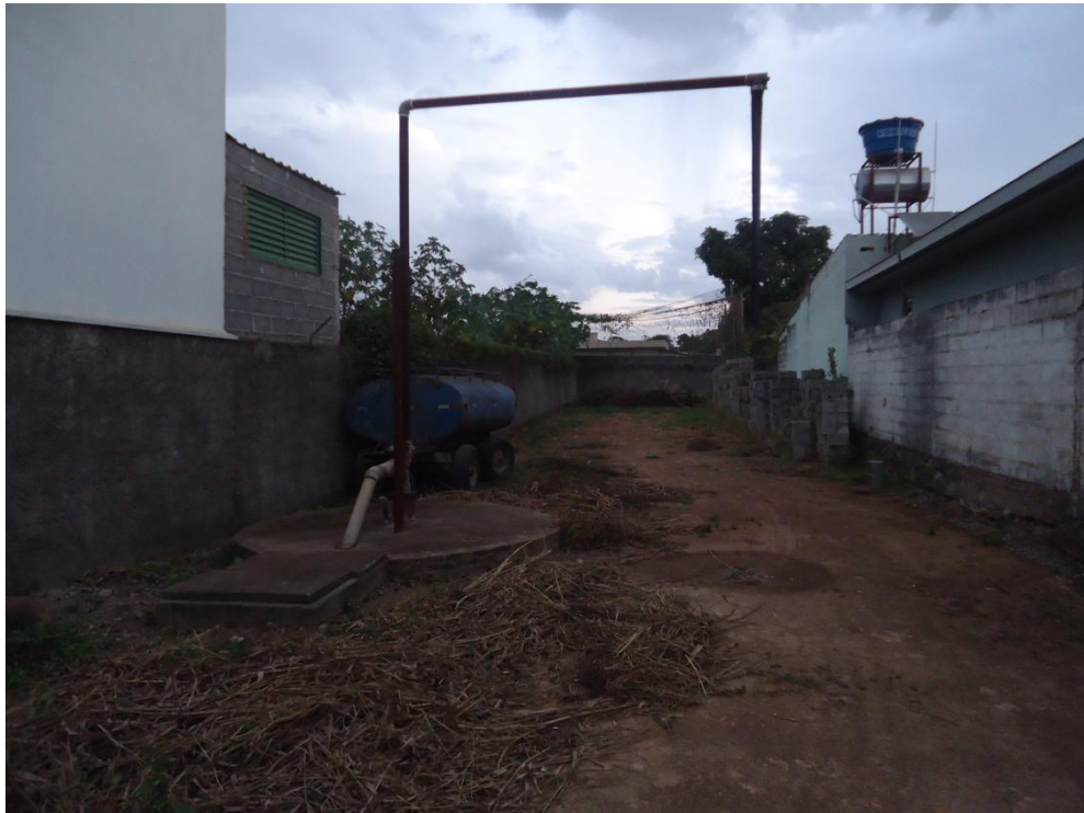
Figura 8.92– Poço tubular nº 18
