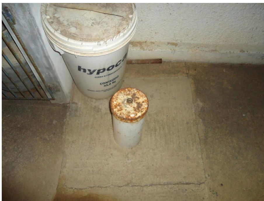
Figura 8.94– Poço tubular n° 6
