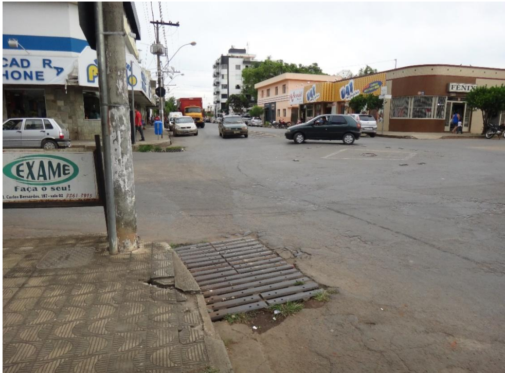
Figura 8.234– Boca de Lobo com grelha, Rua Luís de Guadalupe – Sede
