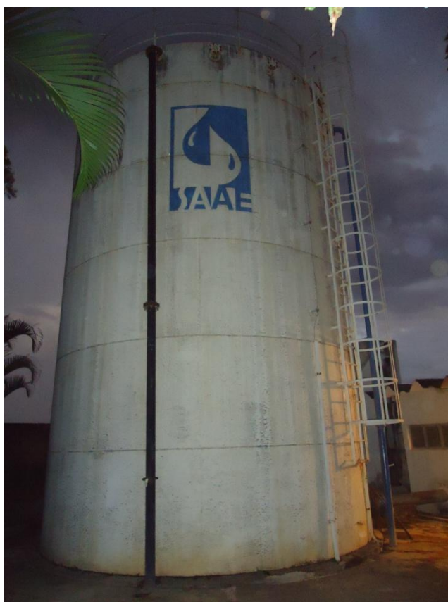
Figura 8.95– Reservatório da Avenida Isabel de Castro
