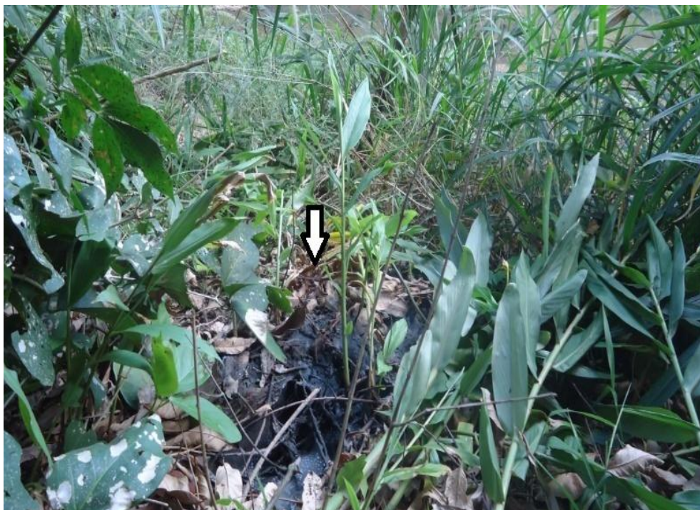
Figura 8.127–Ponto de rompimento na tubulação de lançamento de esgotos da ETE do distrito de Martins Guimarães
