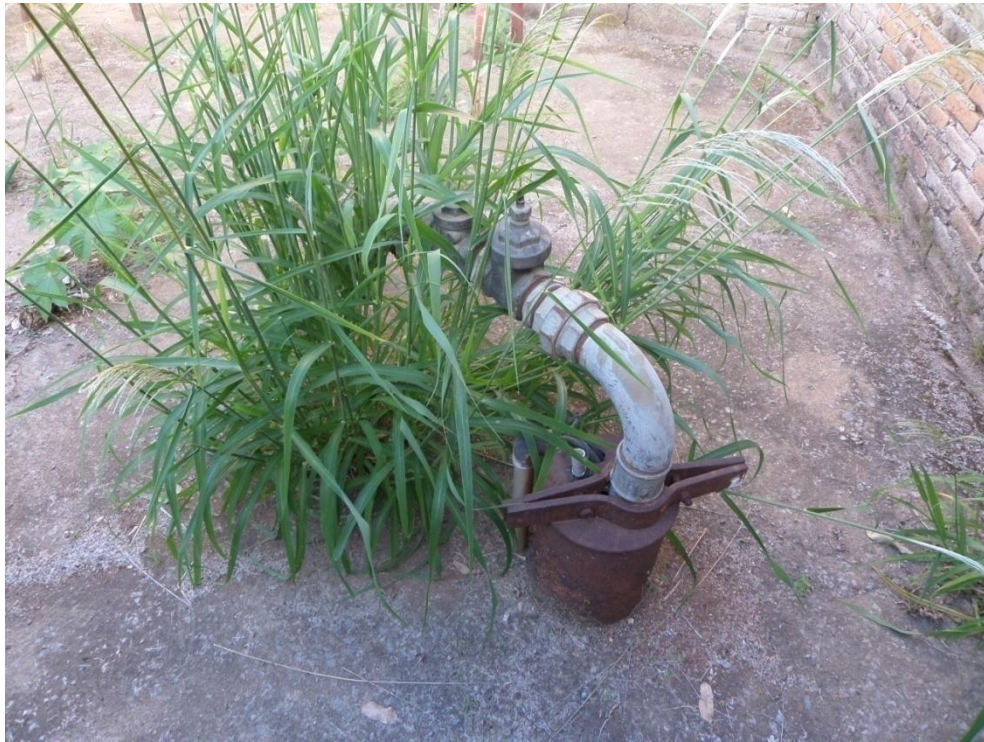
Figura 8.68– Poço tubular nº 11
