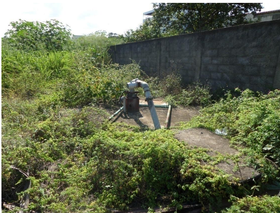
Figura 8.71– Poço tubular nº 24
