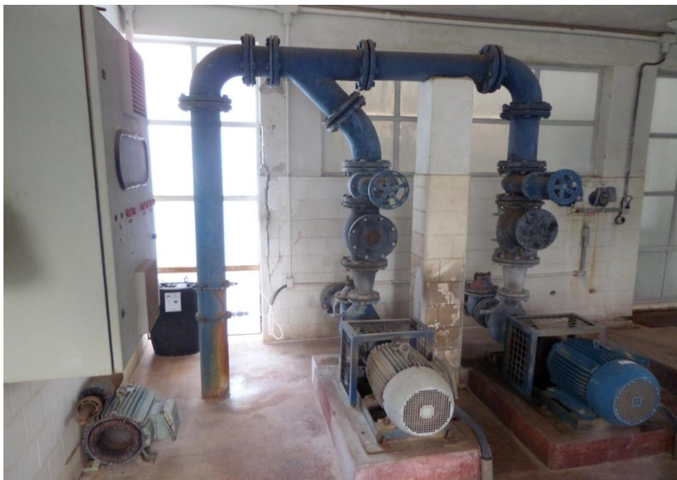
Figura 8.48– Casa de bombas
