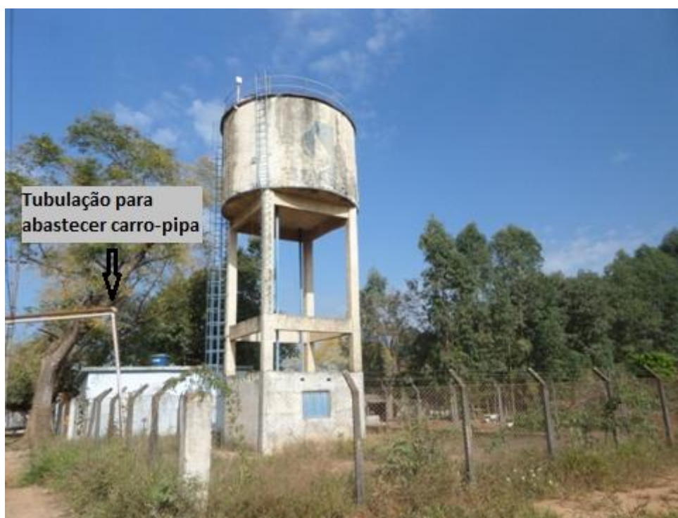
Figura 8.101– Reservatório do sistema do distrito Industrial
