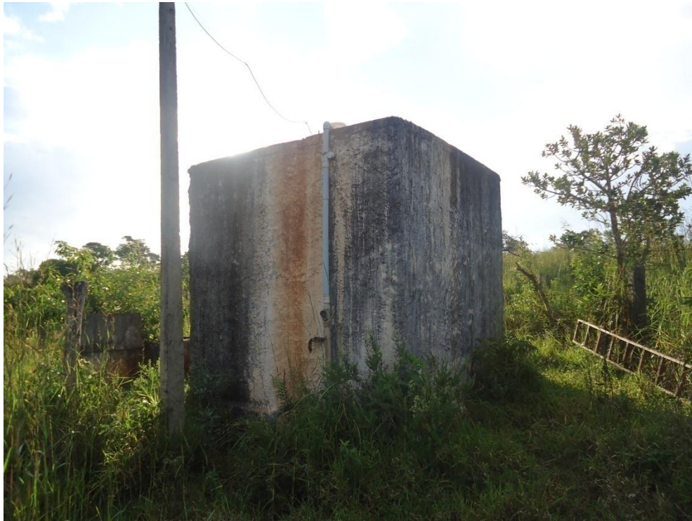
Figura 8.103– Reservatório do sistema do distrito de Martins Guimarães
