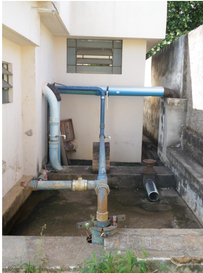
Figura 8.75– Poço tubular nº 4
