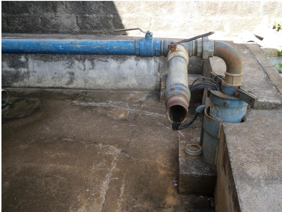
Figura 8.73– Poço tubular n° 26
