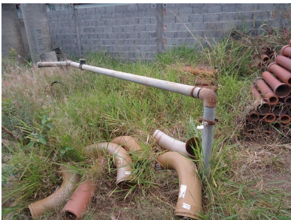
Figura 8.90– Poço tubular n° 9
