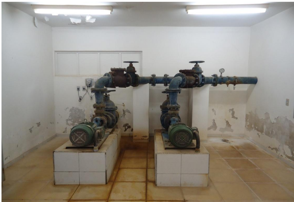
Figura 8.89– Casa de bombas do Sistema Vila Mendonça
