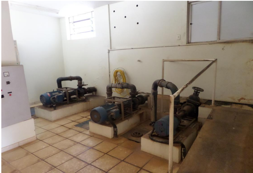
Figura 8.65– Casa de bombas
