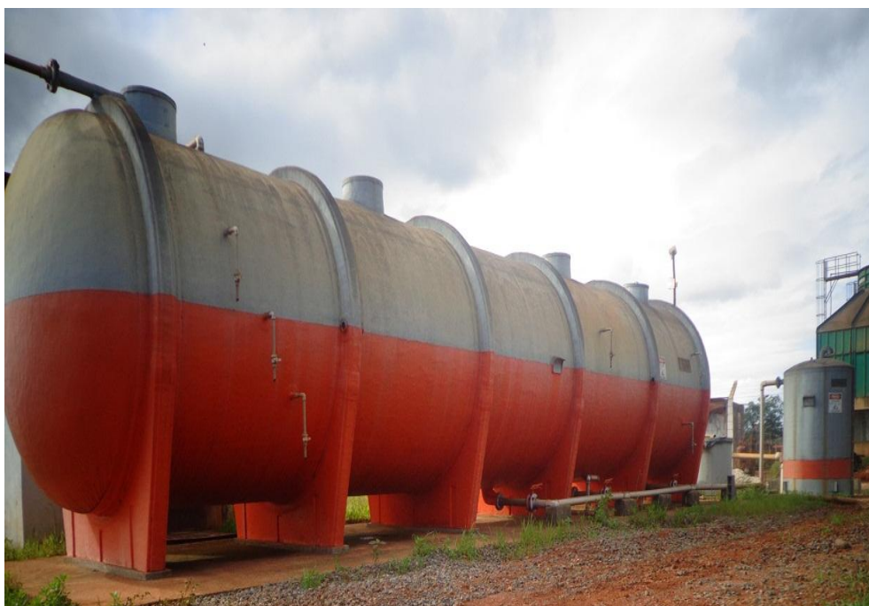
Figura 8.140 – Estação compacta de tratamento de esgotos da usina
