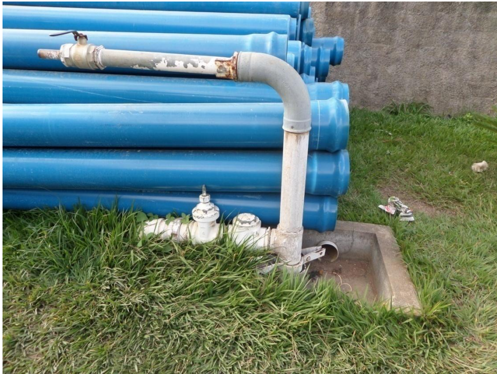
Figura 8.51– Poço tubular nº 7
