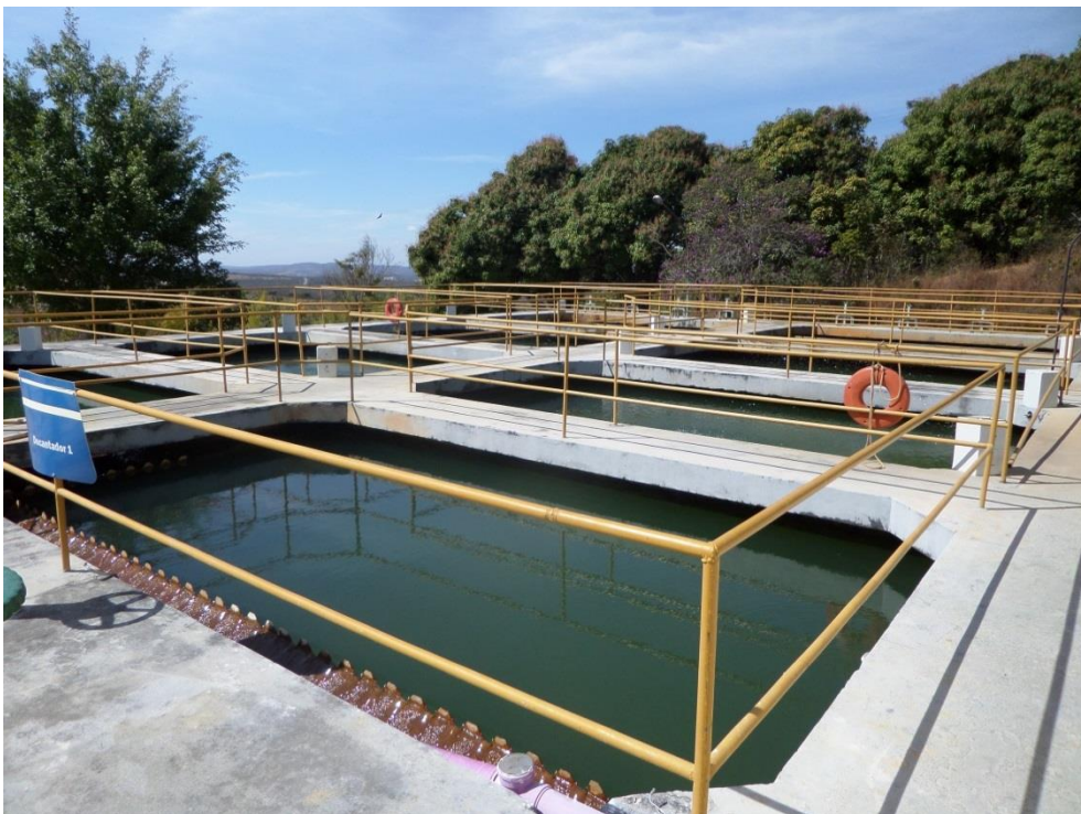
Figura 8.53 – Vista dos decantadores da ETA
