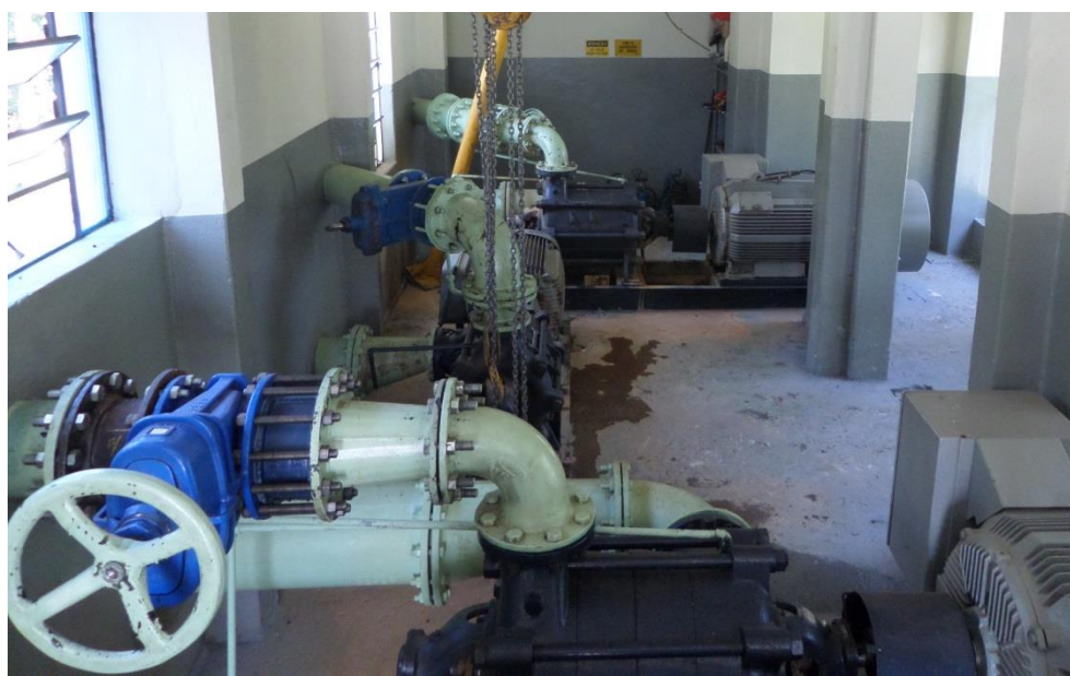
Figura 8.49 – Conjuntos motobombas para adução da água bruta
