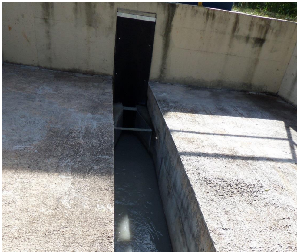
Figura 8.97 – Calha Parshall da ETE Matadouro
