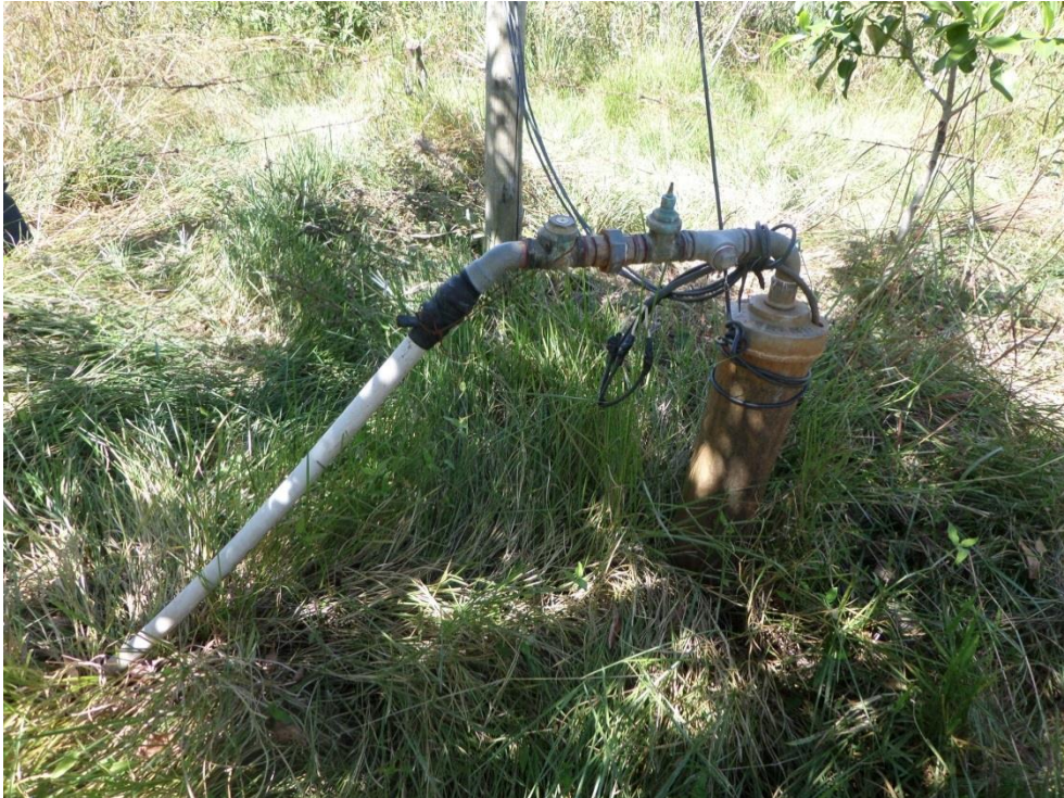
Figura 8.84 – Poço tubular de Passagem
