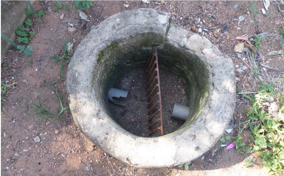
Figura 8.120 – Grade da ETE Engenho do Ribeiro I
