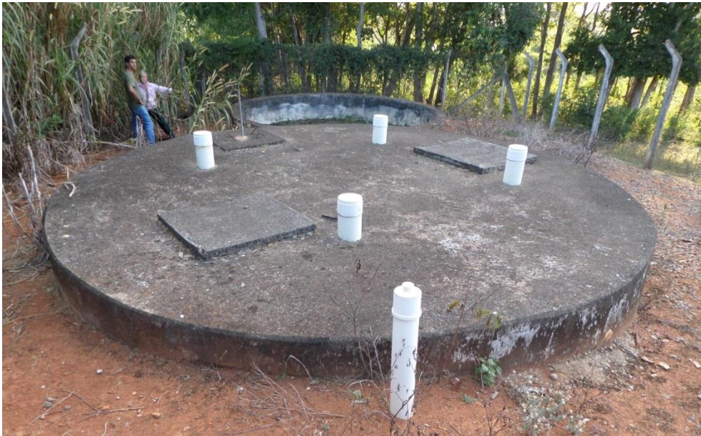
Figura 8.146 – Filtro anaeróbio da ETE Mato Seco
