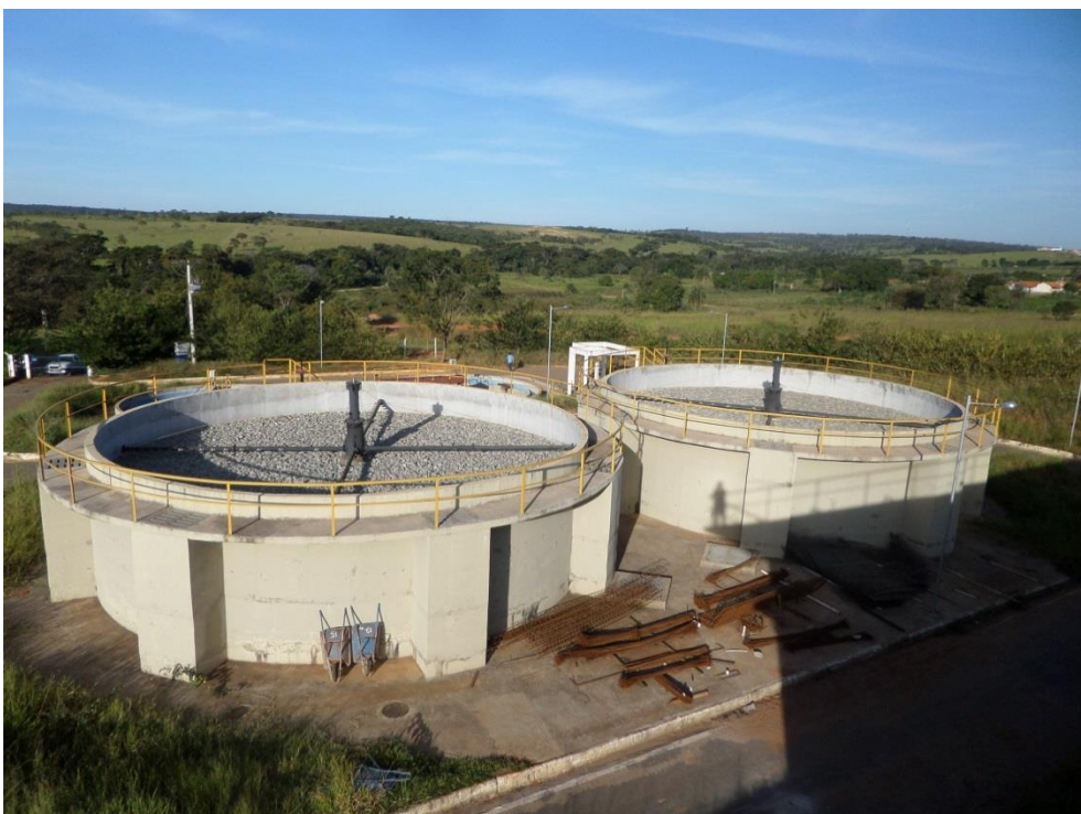
Figura 8.110 – Filtros biológicos percoladores da ETE Matadouro
