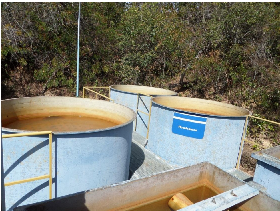
Figura 8.57 – Floculadores do módulo auxiliar da ETA
