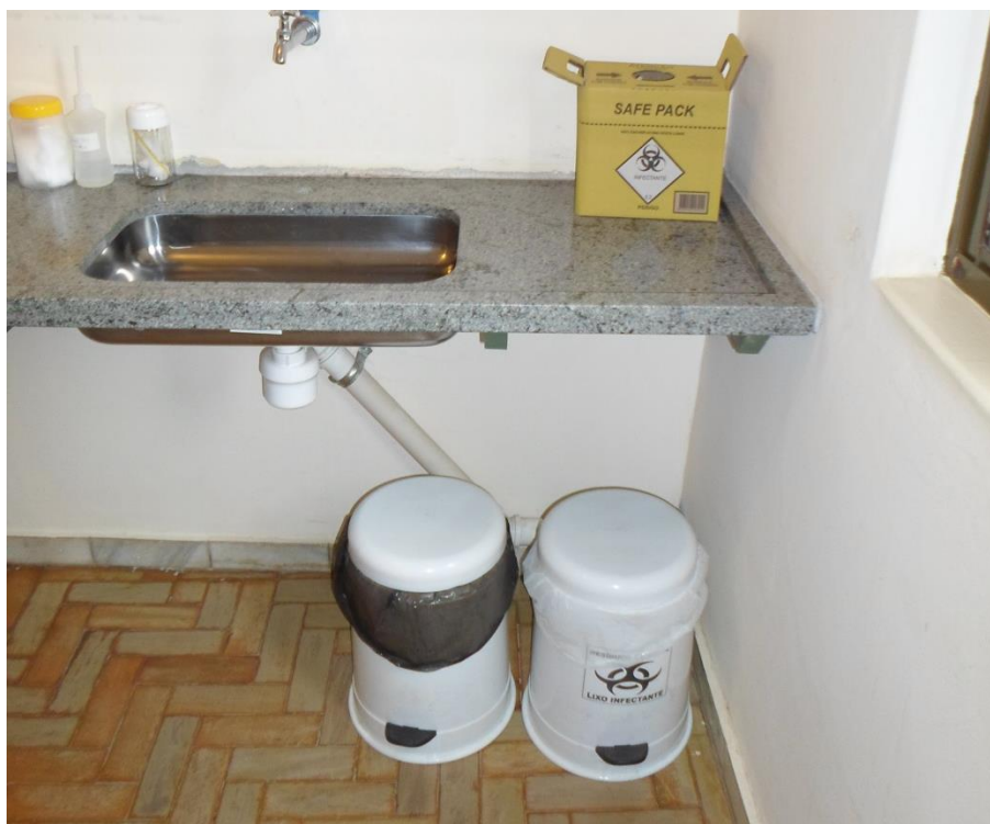
Figura 8.196 – Recipientes para acondicionamento de resíduos comuns, infectantes e perfurocortantes – PSF São José
