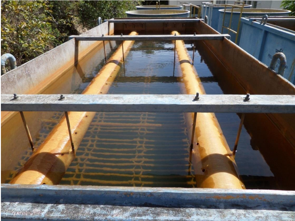
Figura 8.58 – Decantador do módulo auxiliar da ETA
