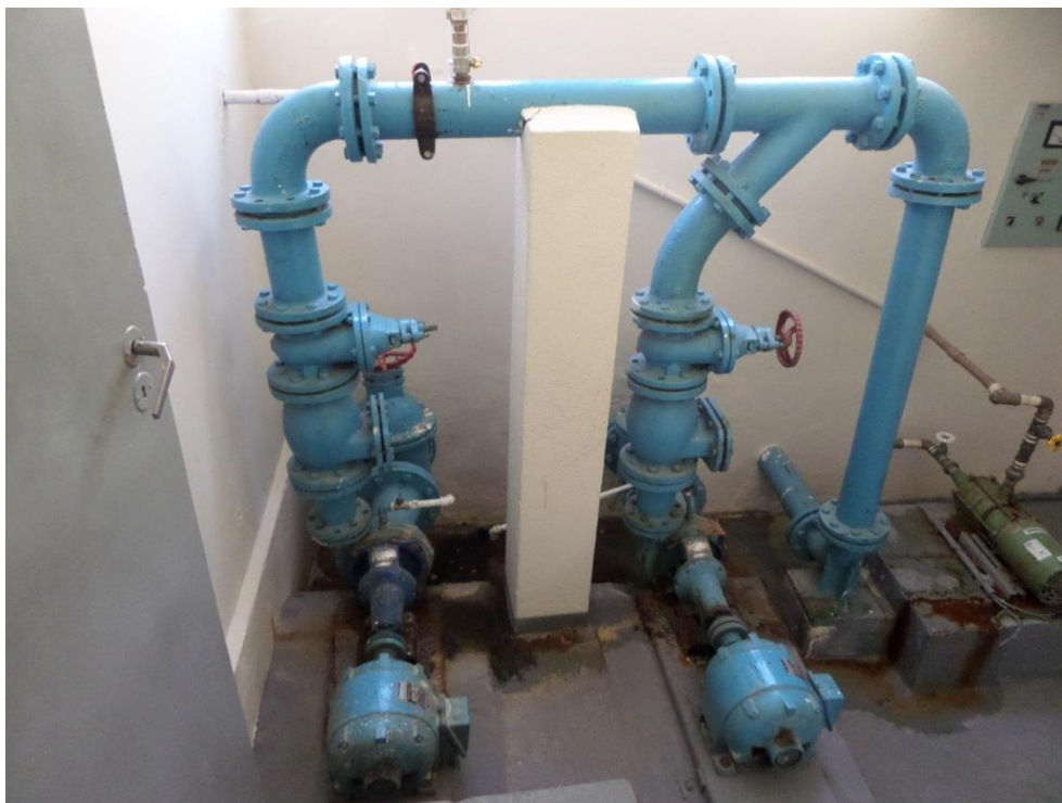
Figura 8.68 – Conjunto motobomba para elevação da água tratada do tanque de contato
