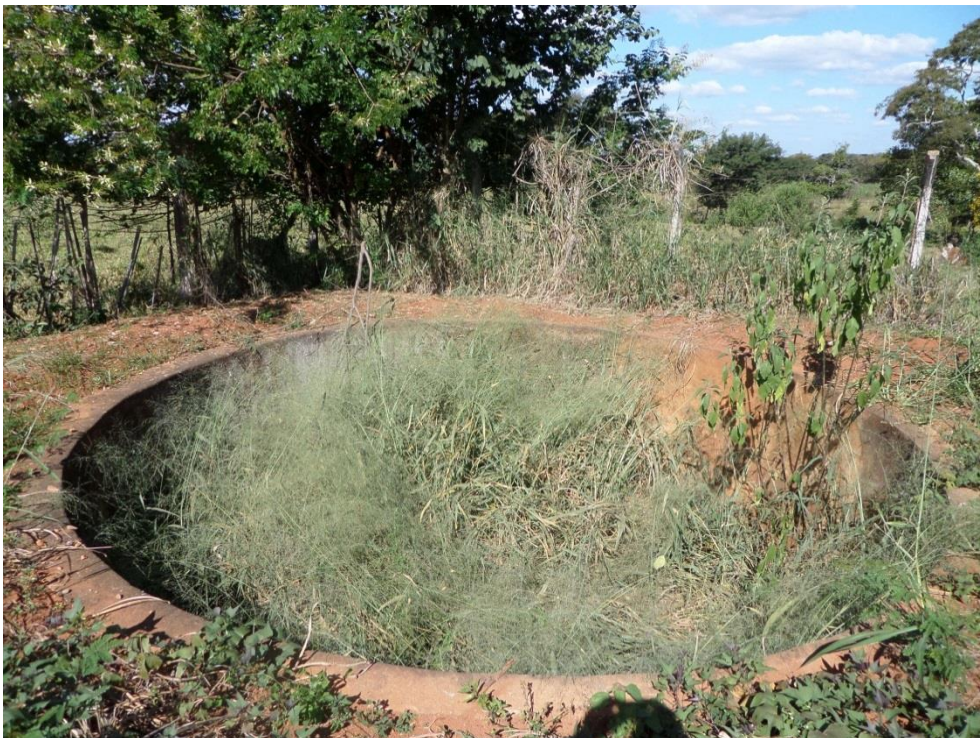
Figura 8.131 – Leito de secagem da ETE Engenho do Ribeiro II com vegetação
