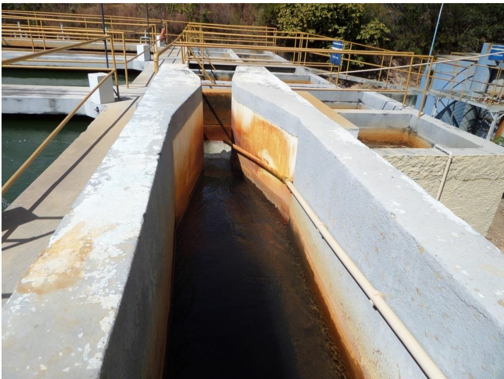
Figura 8.51 – Vista da calha Parshal da ETA
