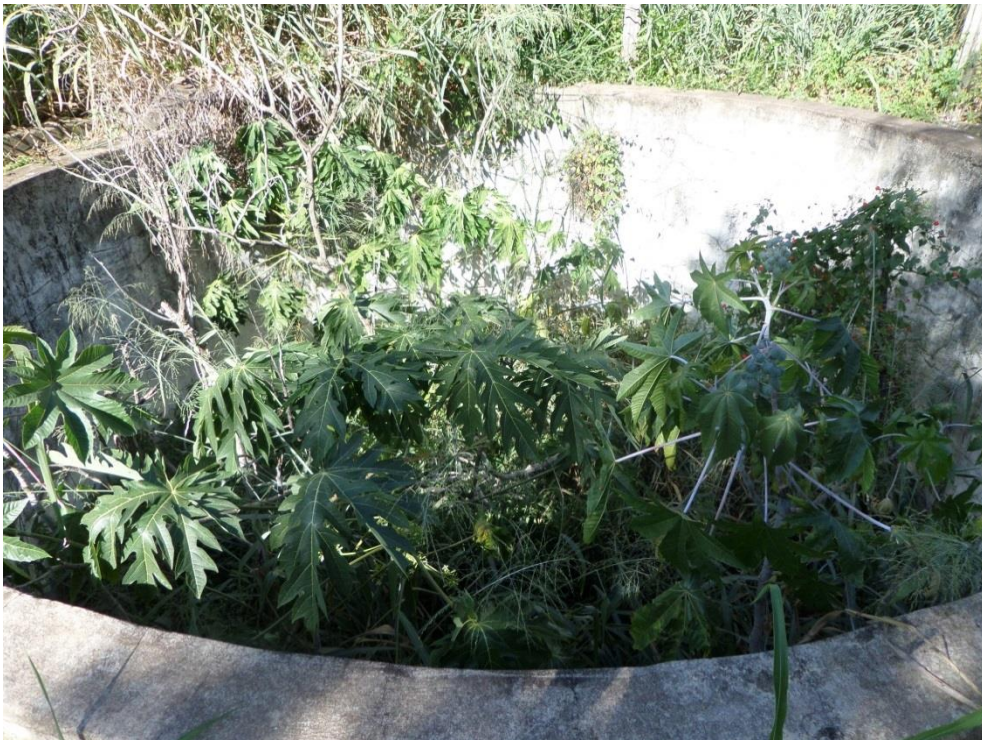
Figura 8.123 – Leito de secagem da ETE Engenho do Ribeiro I com vegetação
