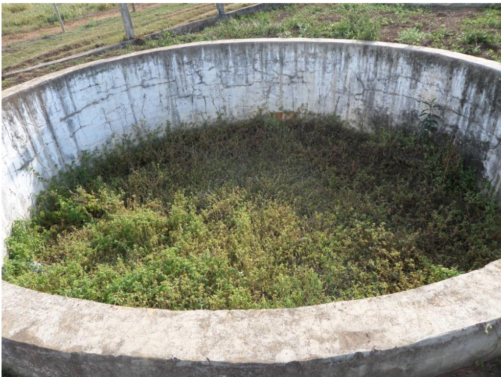
Figura 8.138 – Leito de secagem da ETE Engenho do Ribeiro III com vegetação
