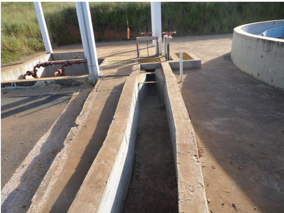
Figura 8.103 – Medido de vazão na saída do tratamento
