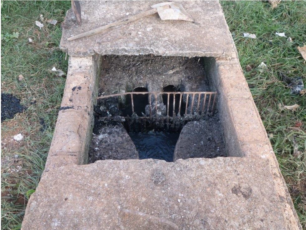
Figura 8.135 – Grade da ETE Engenho do Ribeiro III
