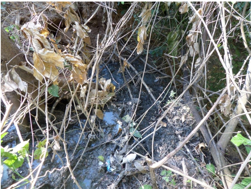
Figura 8.126 – Lançamento in natura devido ao rompimento da rede de esgoto
