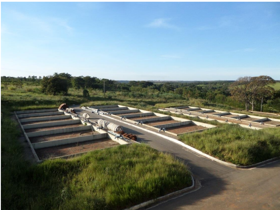
Figura 8.112 – Leitos de Secagem
