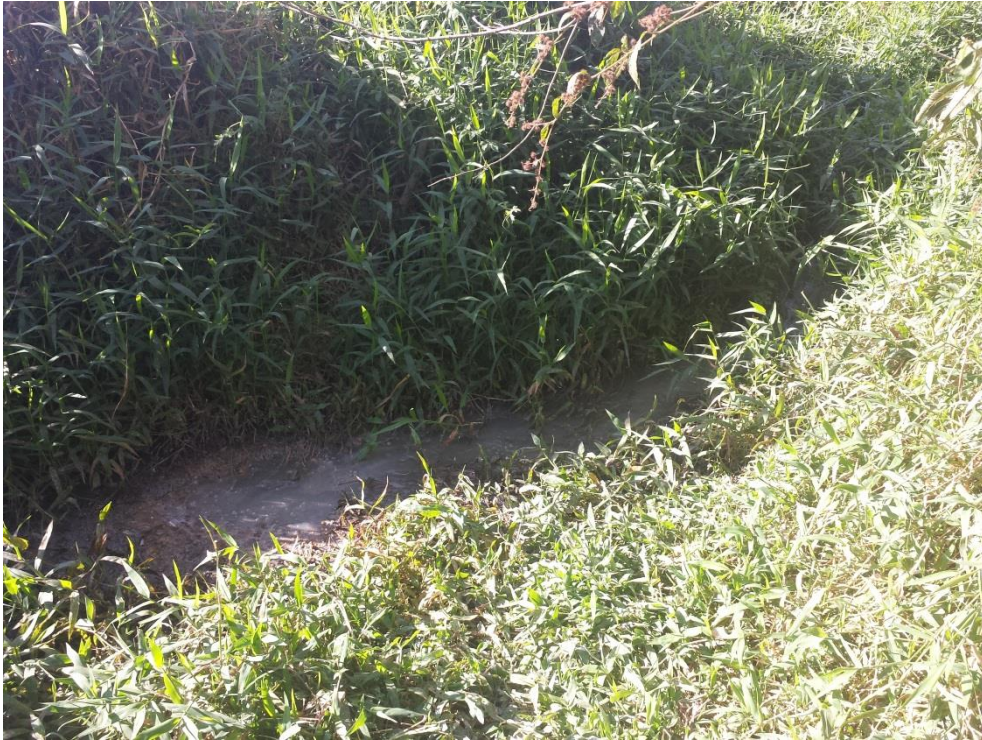
Figura 8.116 – Lançamento in natura no córrego da Areia (ES6)
