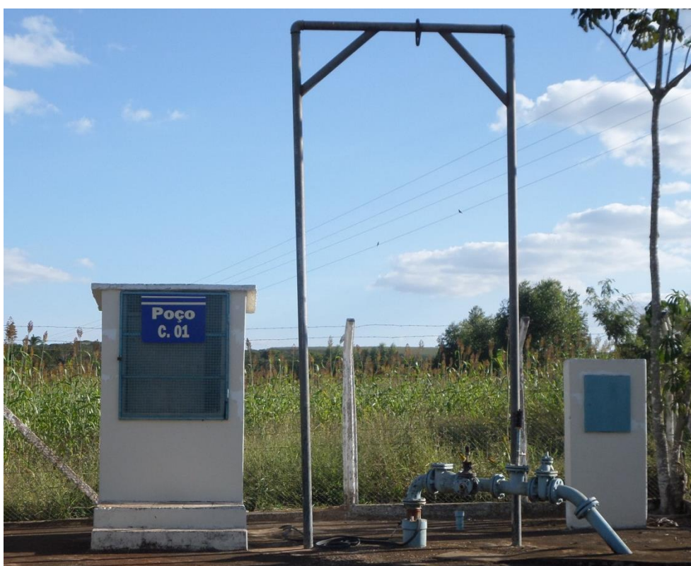
Figura 8.70 – Poço artesiano C-01 em Engenho do Ribeiro
