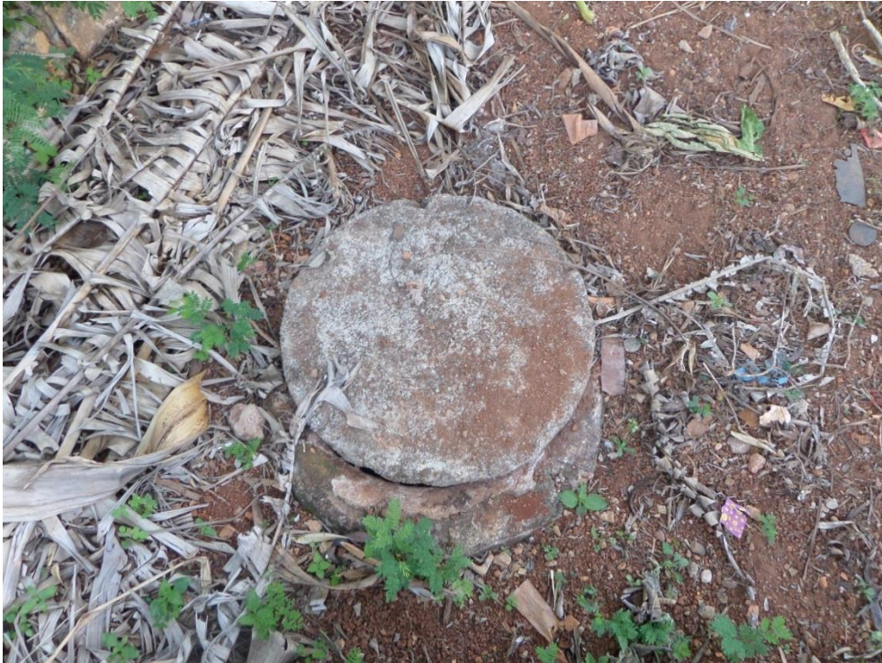
Figura 8.128 – Grade da ETE Engenho do Ribeiro II
