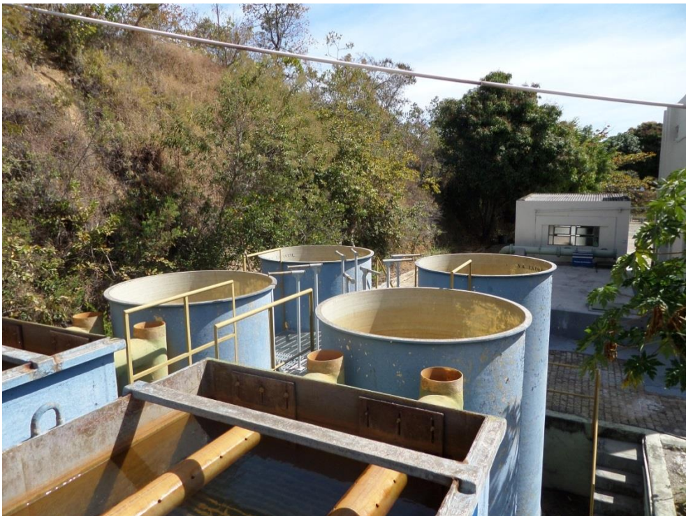
Figura 8.59 – Filtros do módulo auxiliar da ETA
