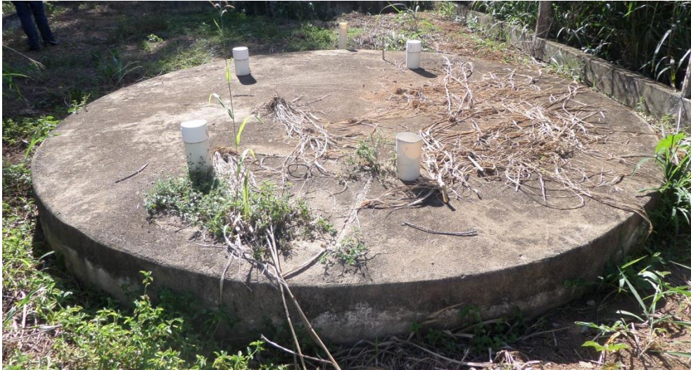
Figura 8.122 – Filtro anaeróbio da ETE Engenho do Ribeiro I
