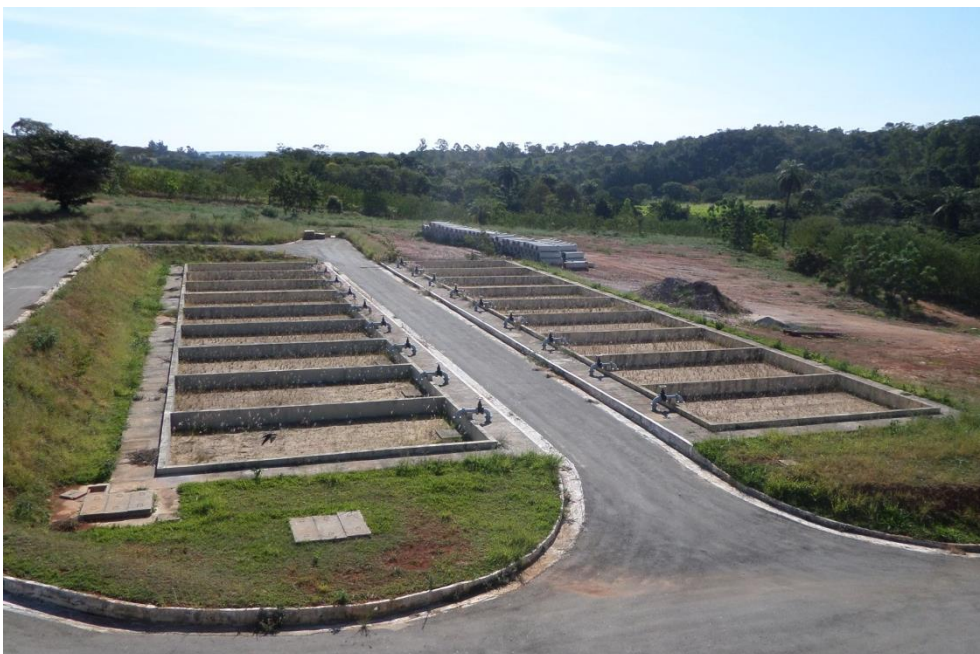
Figura 8.101 – Leitos de Secagem
