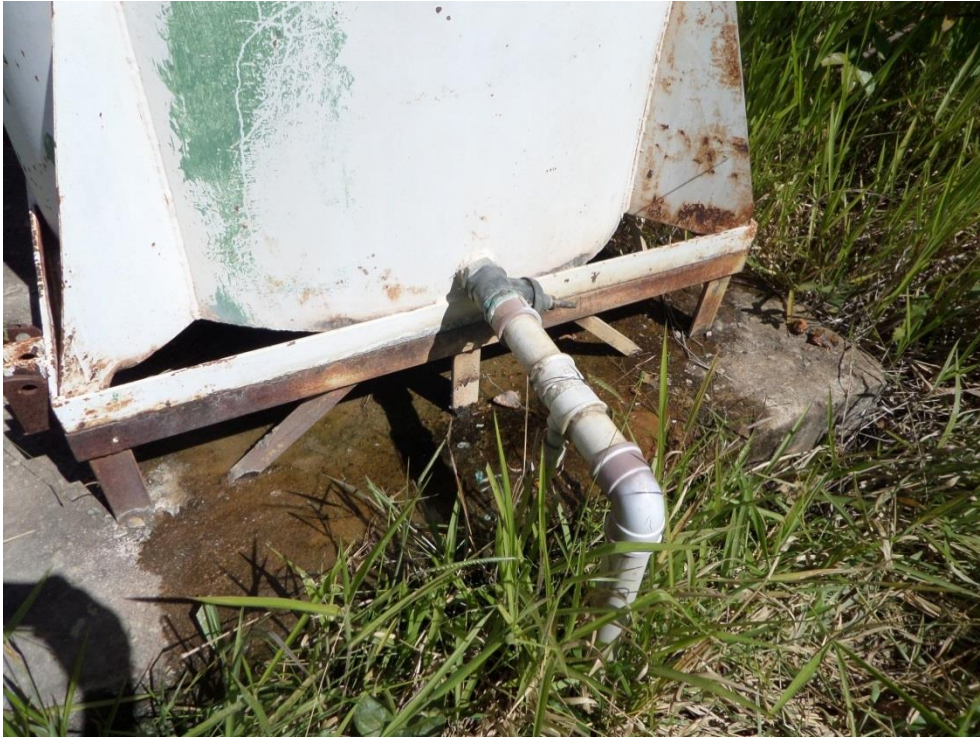
Figura 8.86 – Detalhe do vazamento na base do reservatório em Passagem
