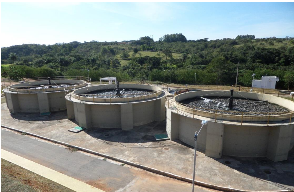
Figura 8.99 – Filtros biológicos percoladores da ETE Matadouro Fonte: COBRAPE (2014)
