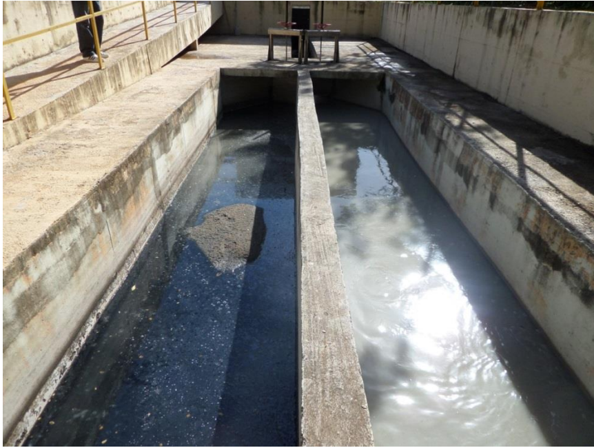
Figura 8.96 – Desanadores da ETE Matadouro
