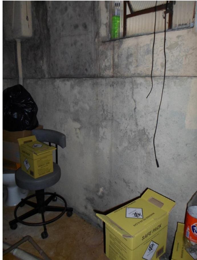
Figura 8.201 – Banheiro desativado utilizado como abrigo para armazenamento de resíduos – PSF São José
