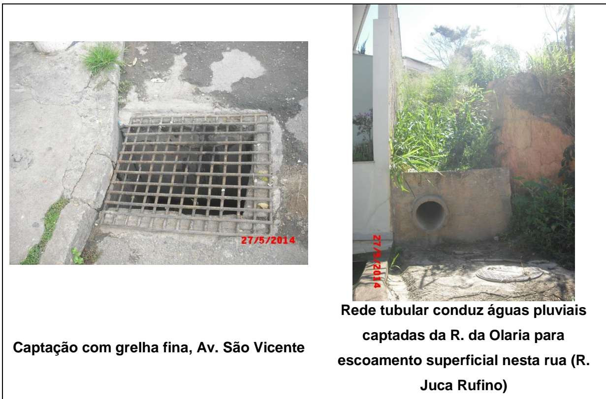
Figura 8.227 – Dispositivos de microdrenagem existentes
