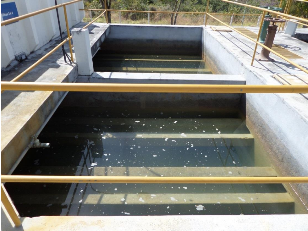
Figura 8.54 – Vista da unidade de filtração da ETA
