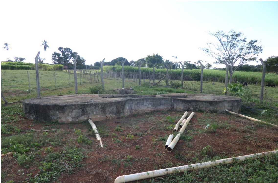
Figura 8.136 – Tanques sépticos da ETE Engenho do Ribeiro III
