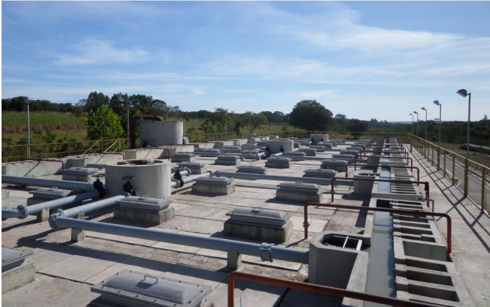
Figura 8.98 – Reatores UASB da ETE Matadouro Fonte: COBRAPE (2014)
