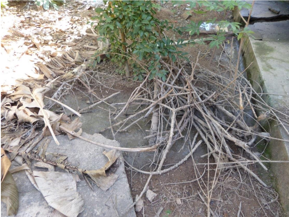
Figura 8.140 – Transbordamento do afluente
