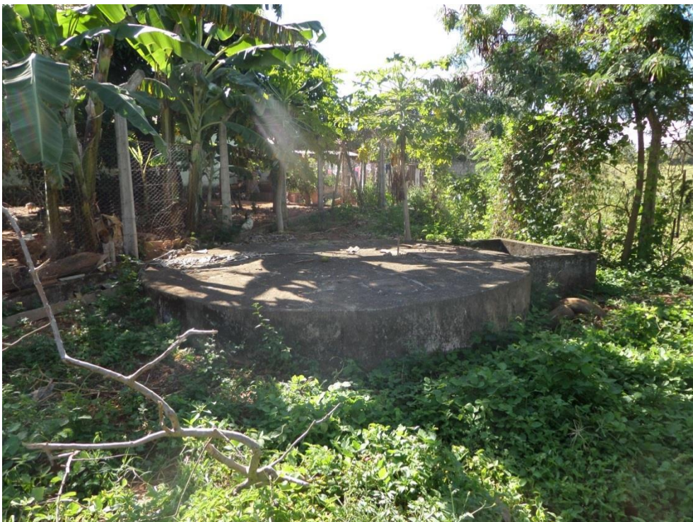
Figura 8.129 – Tanque séptico da ETE Engenho do Ribeiro II
