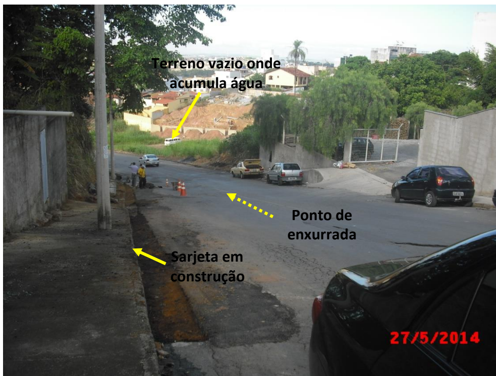
Ponto de enxurrada, Avenida Amazonas
