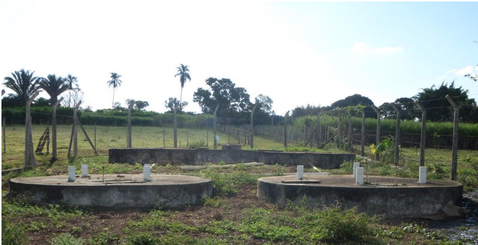
Figura 8.137 – Filtros anaeróbios da ETE Engenho do Ribeiro III
