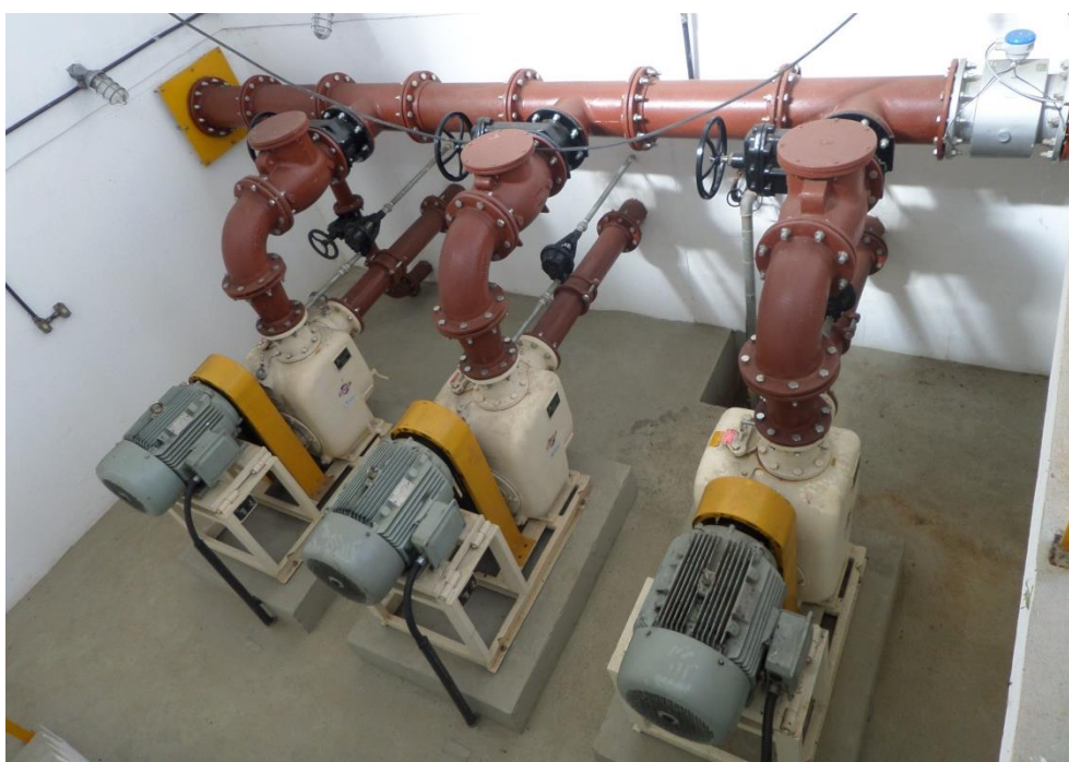
Figura 8.104 – Conjunto motobombas para elevação do efluente
