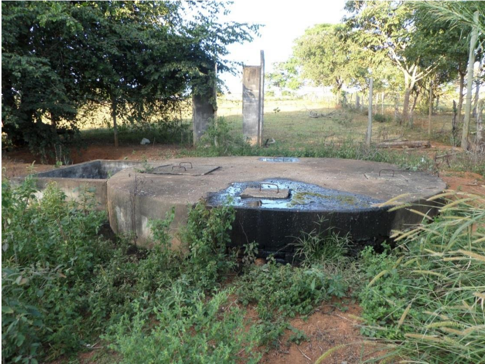
Figura 8.145 – Tanque séptico da ETE Mato Seco
