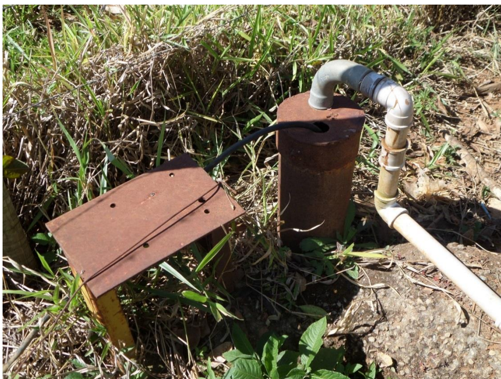
Figura 8.81 – Poço tubular de Garça
