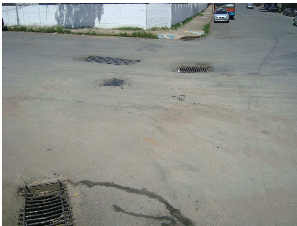
Figura 5.11 – Estruturas do sistema de drenagem de águas pluviais em Lagoa da Prata
