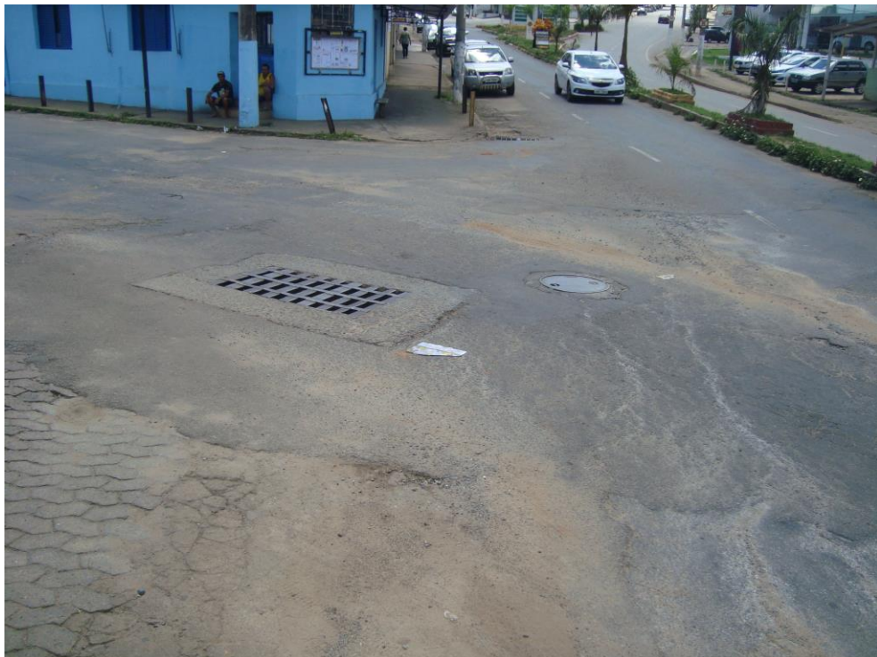
Figura 5.8 – Estruturas do sistema de drenagem em Bom Despacho
