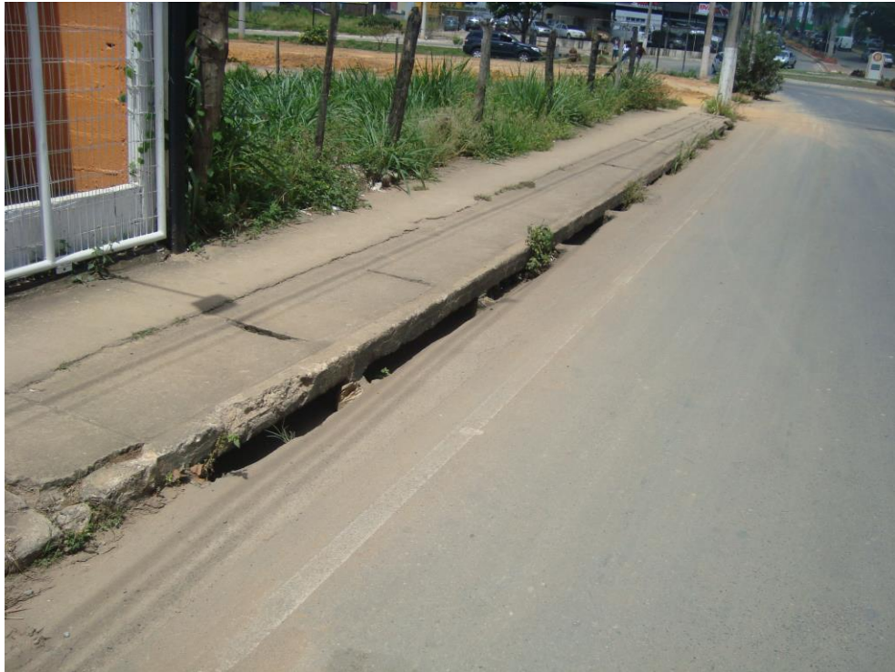
Figura 5.7 – Estruturas do sistema de drenagem em Bom Despacho
