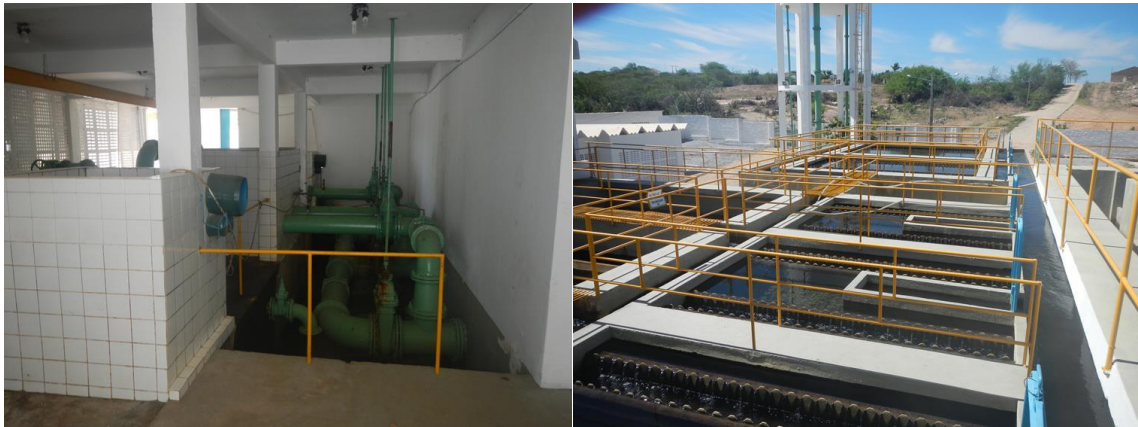
Figura 5: Estações elevatórias de água e ETA em Afogados da Ingazeira/PE.
