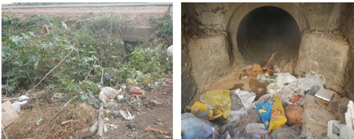
Figura 14: Dispositivos de Drenagem Obstruídas
