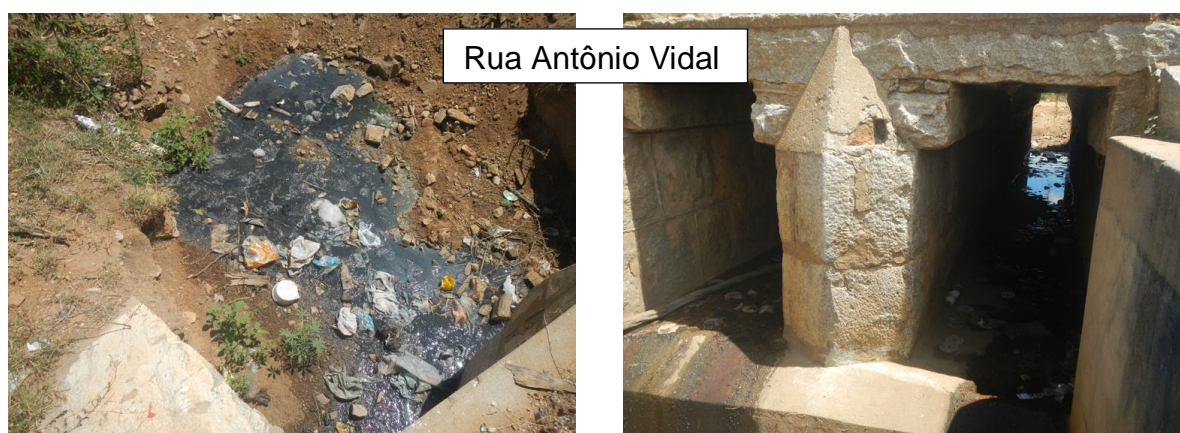
Figura 11: Esgoto a céu aberto na cidade de Afogados da Ingazeira
