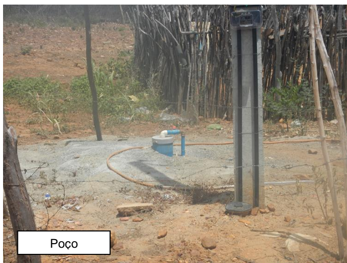
Figura 138: Captação do SAA Maravilha. Fonte: Gesois, 2015.
