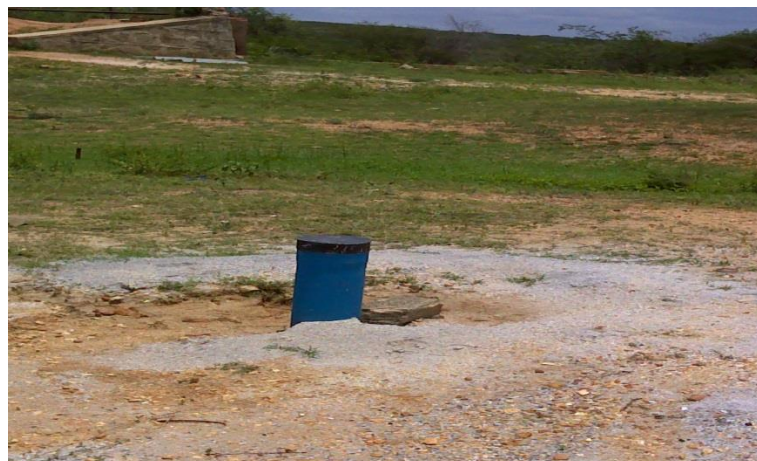
Figura 167: Poço artesiano do SAA Laje do Gato.
