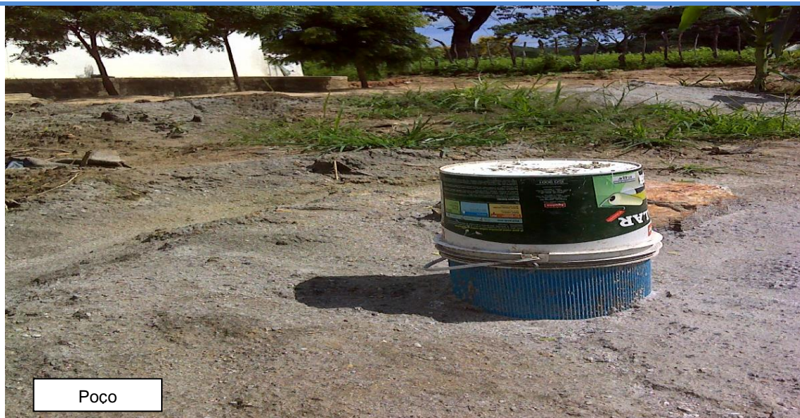
Figura 147: Poço artesiano do SAA Gameleira. Fonte: Gesois, 2015.
