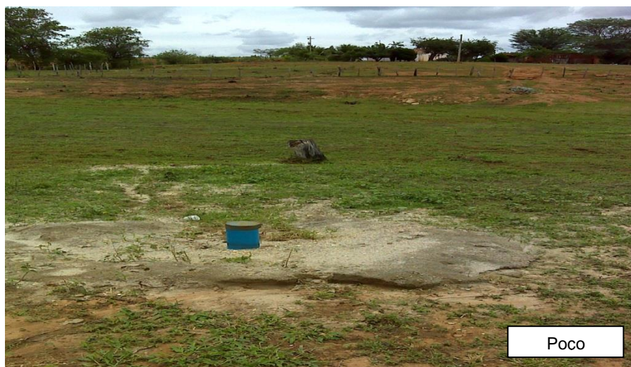
Figura 162: Poço artesiano do SAA Manoel Soares.
