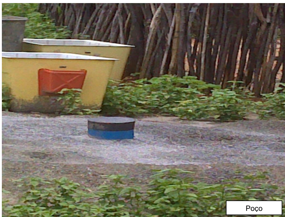
Figura 137: Poço artesiano do SAA de São Joaquim.
