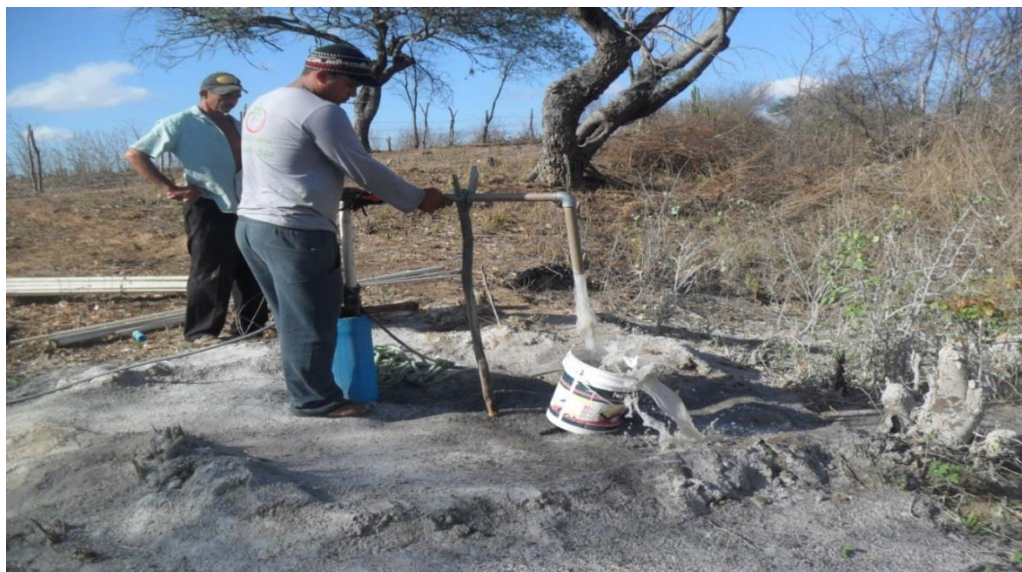
Figura 168: Poço artesiano do SAA Jatobá de Dois Riachos.
