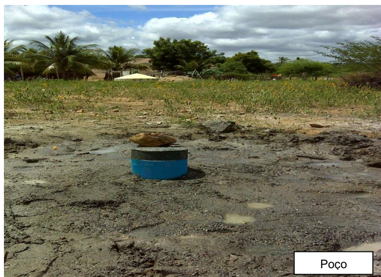
Figura 125: Poço artesiano do SAA Santiago II.
