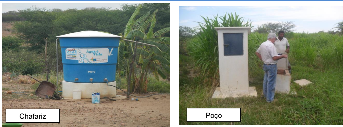
Figura 132: Unidades do SAA Retiro.
