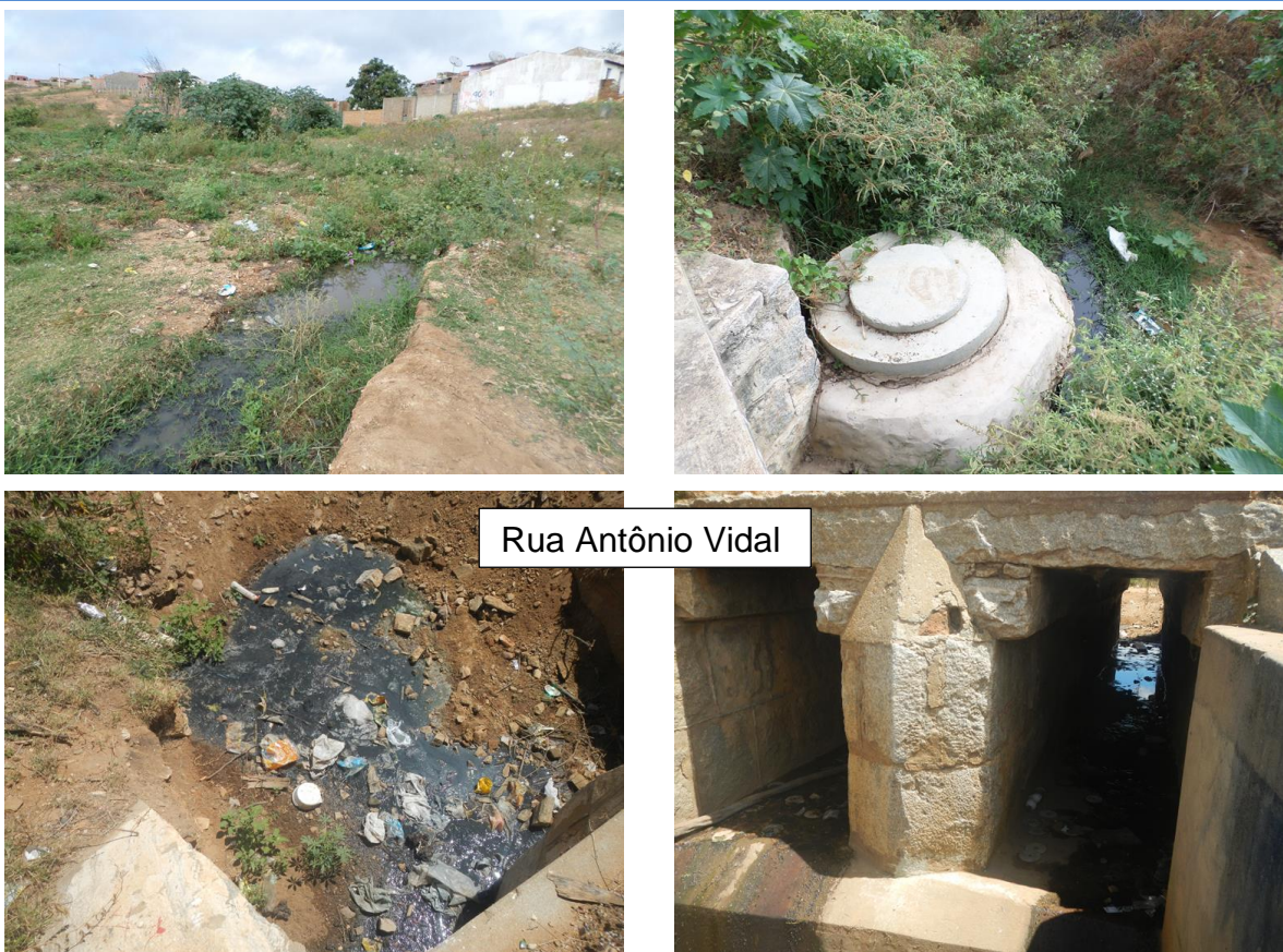
Figura 229: Esgoto a céu aberto na cidade de Afogados da Ingazeira – Parte 01/02.
