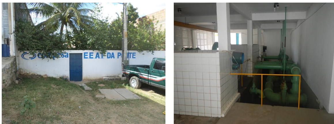
Figura 108: Estações elevatórias de água em Afogados da Ingazeira/PE.
