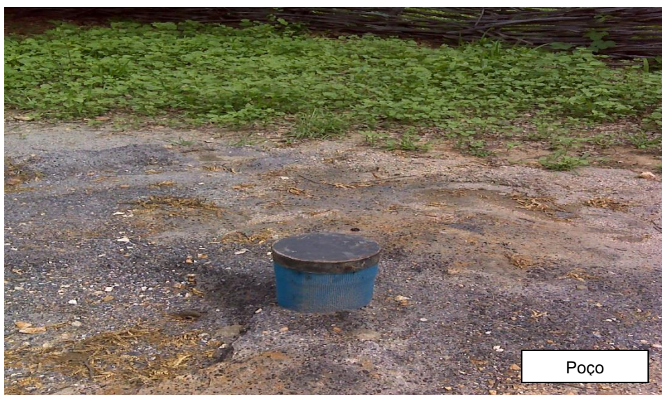
Figura 135: Poço artesiano do SAA Carnaúba dos Santos II.
