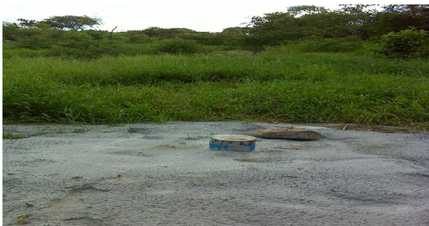
Figura 166: Poço artesiano do SAA Dois Riachos.
