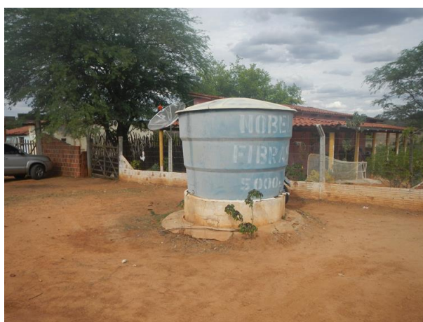
Figura 182: Reservatório do SAA Travessão. Fonte: Gesois, 2015.
