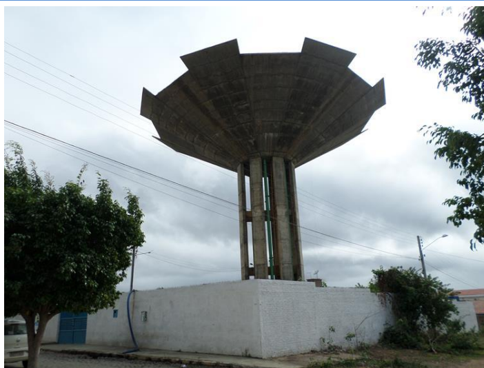
Figura 110: Reservatórios do SAA operado pela COMPESA. Fonte: Gesois, 2014 e 2015.
