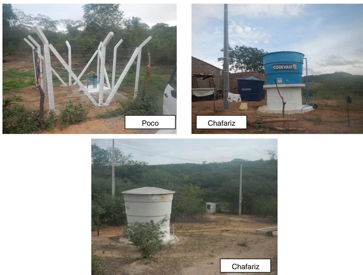
Figura 170: Unidades do SAA Escada.
