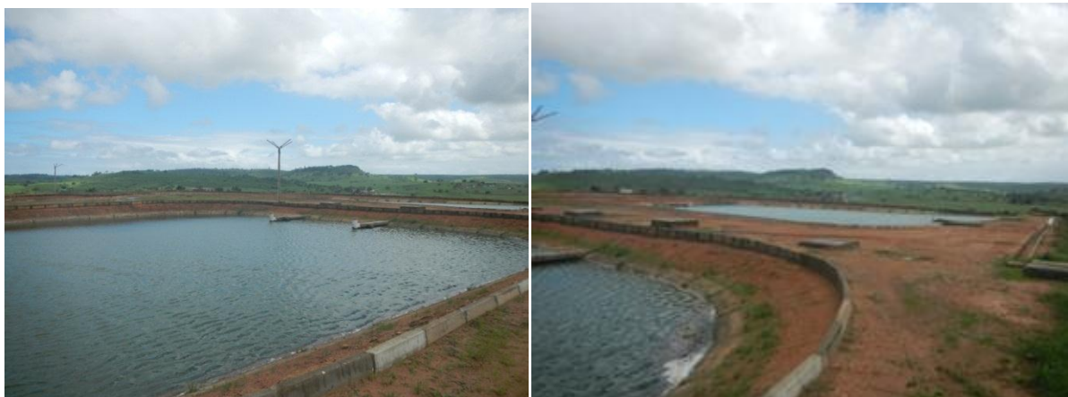
Figura 9: Lagoas de tratamento de esgoto em Igreja Nova/AL
