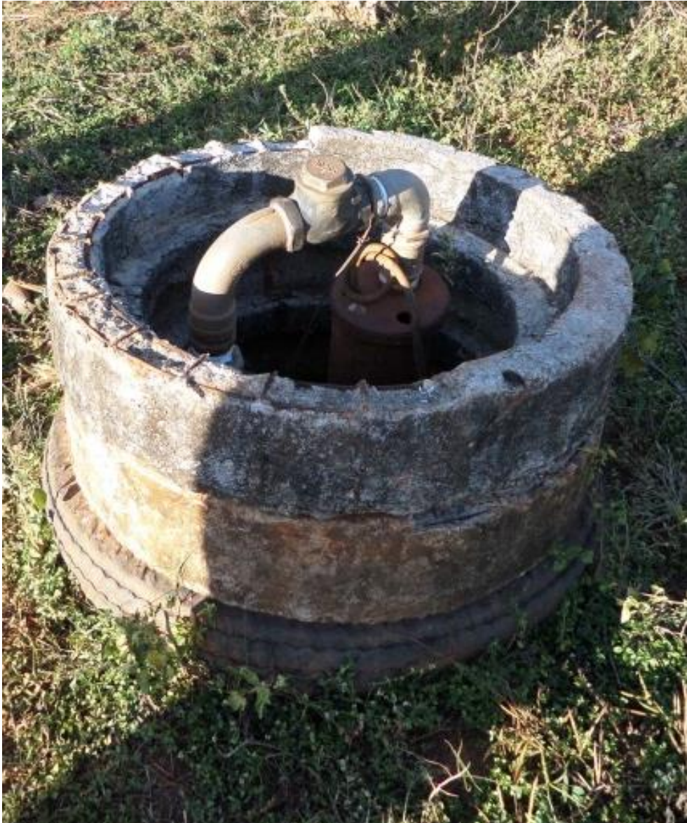
Figura 8.79 – Poço tubular de Veredas
