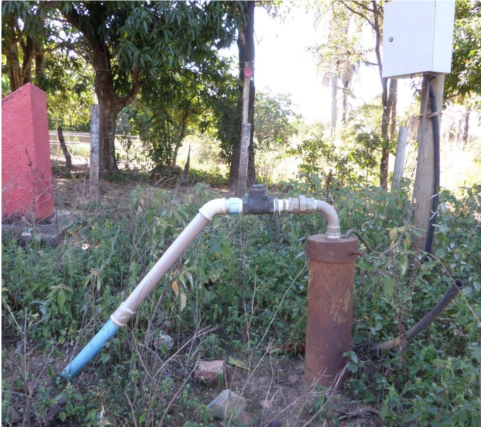
Figura 8.67 – Poço tubular de Patos do Abaeté
