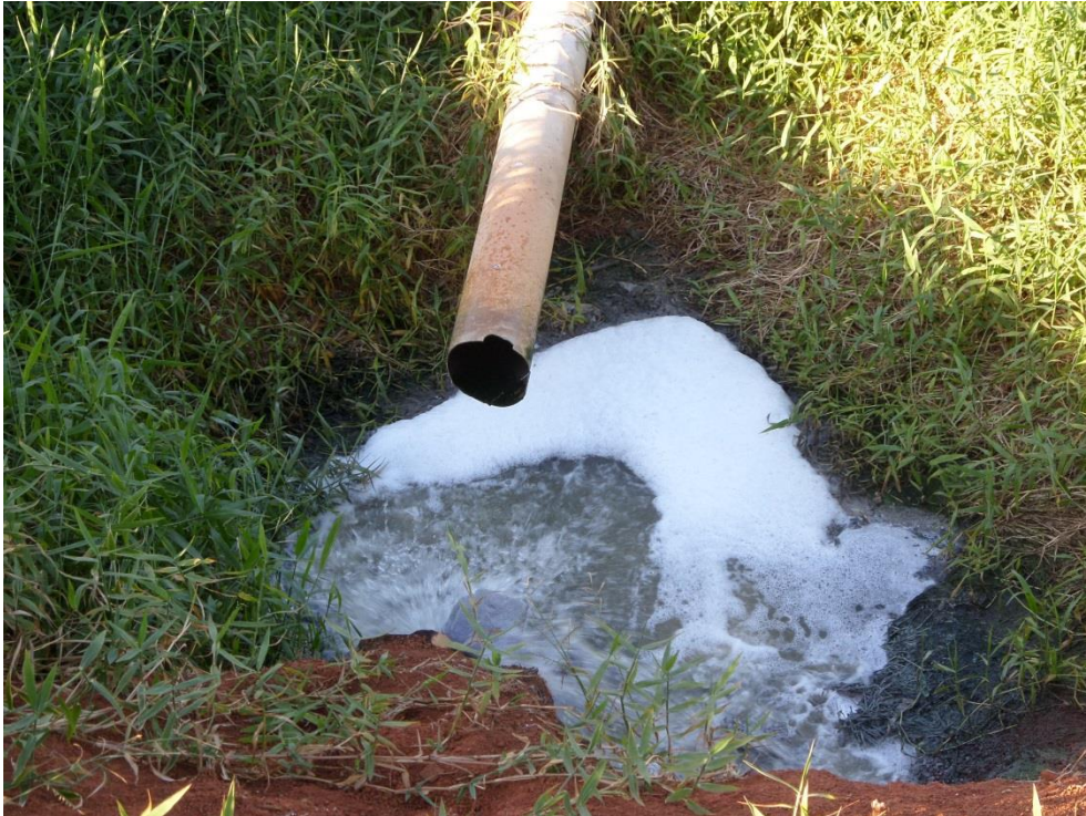
Figura 8.91 – Tubulação rompida na entrada da lagoa facultativa
