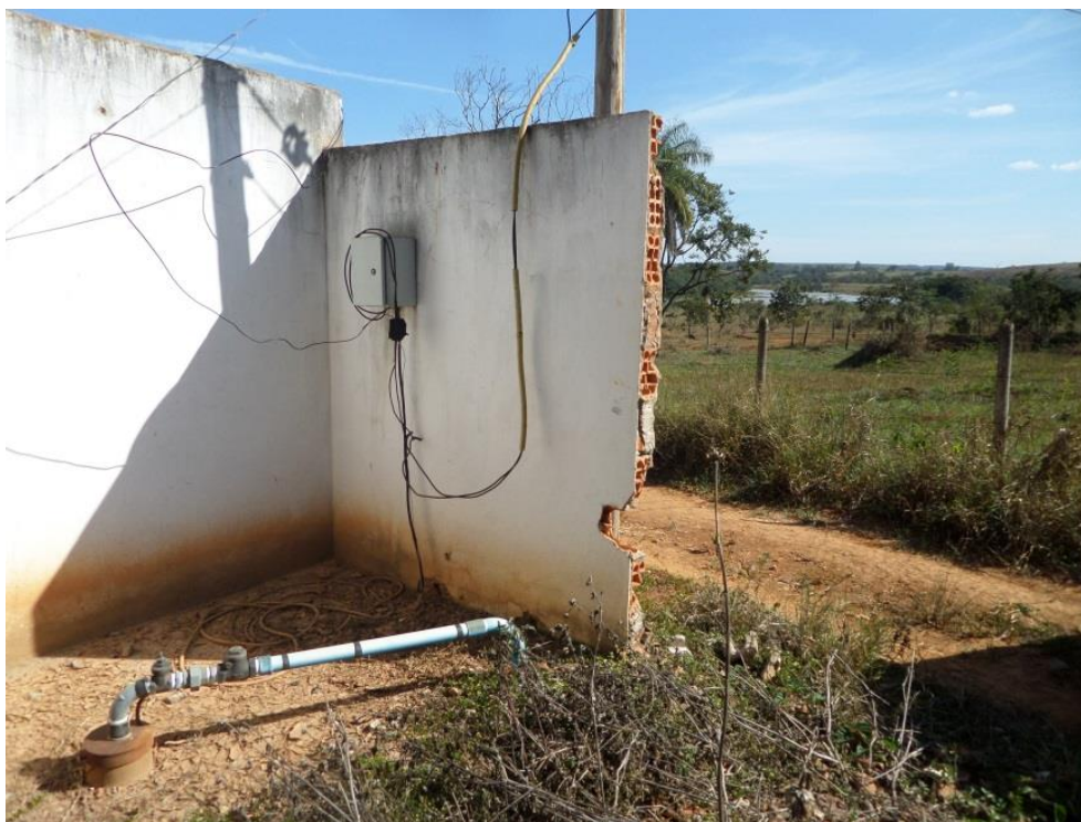
Figura 8.65 – Poço tubular de Paredão
