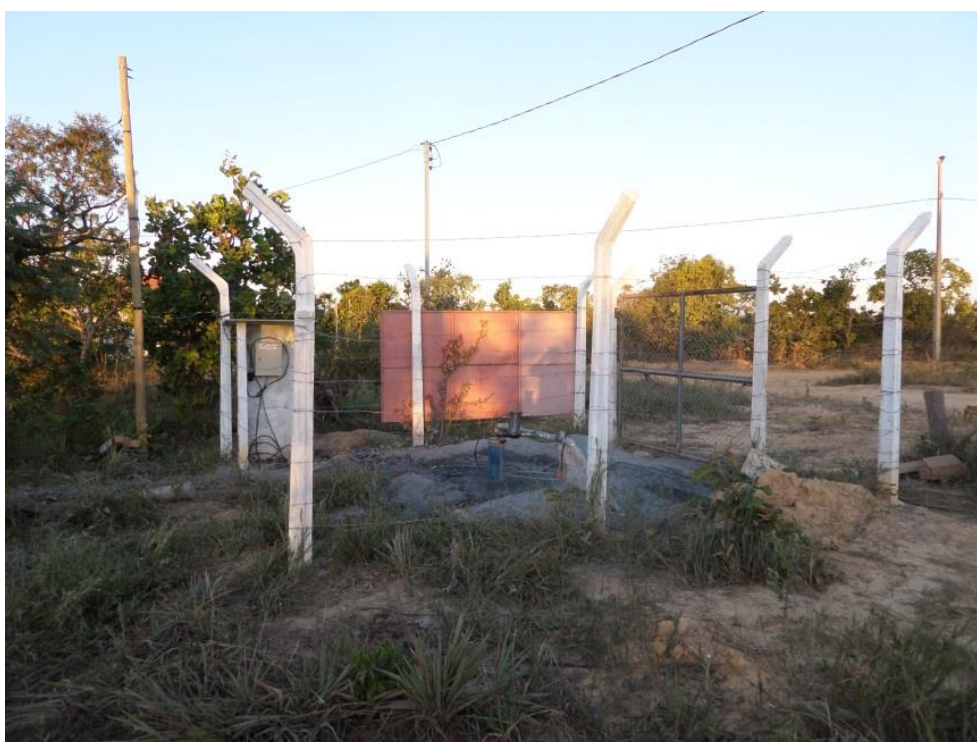
Figura 8.73 – Poço tubular de Riacho das Areias
