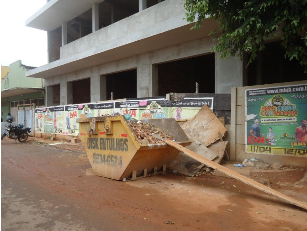
Figura 8.139 – Caçamba para acondicionamento de RCC disponibilizado por empresa privada do Município de Abaeté
