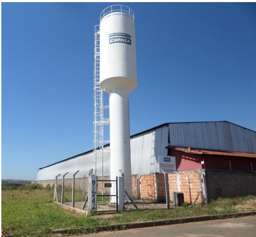
Figura 8.58 – Reservatório elevado (REL 5)
