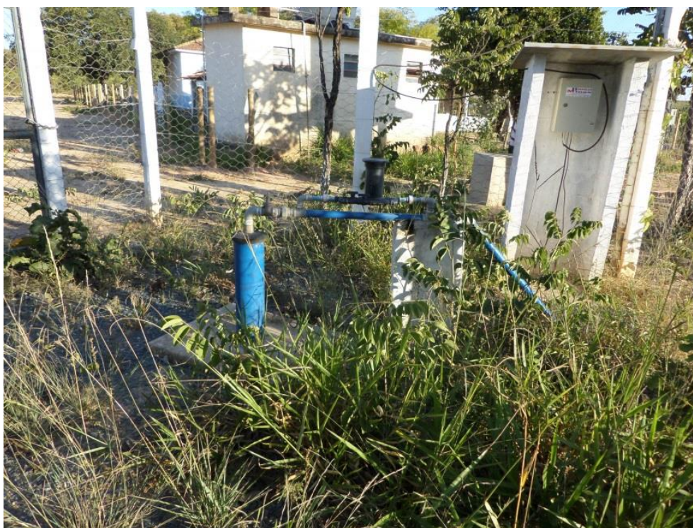
Figura 8.61 – Poço tubular de Aldeia
