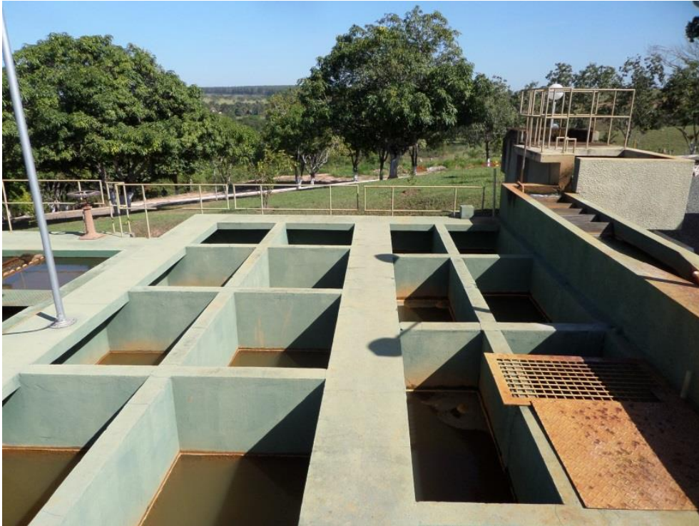
Figura 8.48 – Detalhe das câmaras do floculador da ETA
