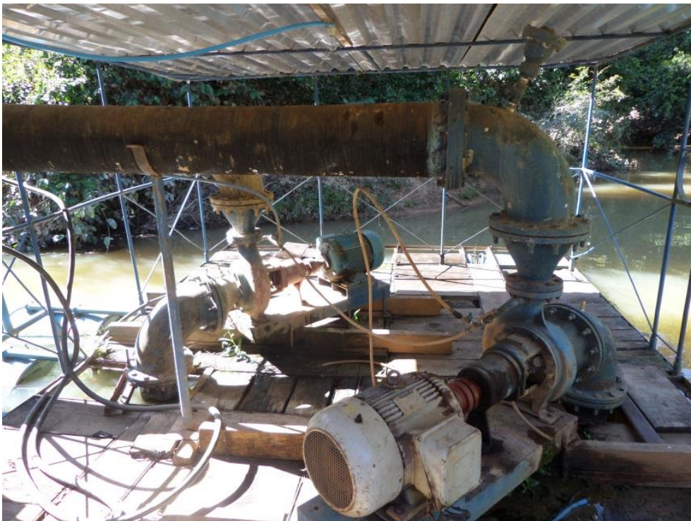
Figura 8.45 – Conjunto moto-bomba para captação da água
