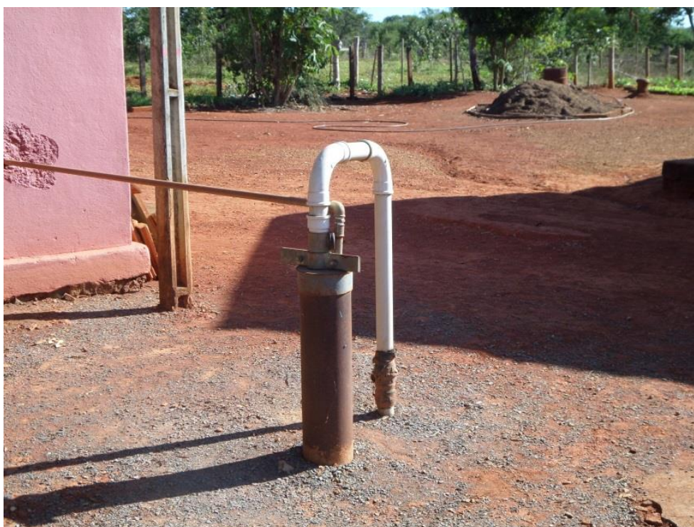
Figura 8.63 – Poço tubular de Lagoa de Santa Maria
