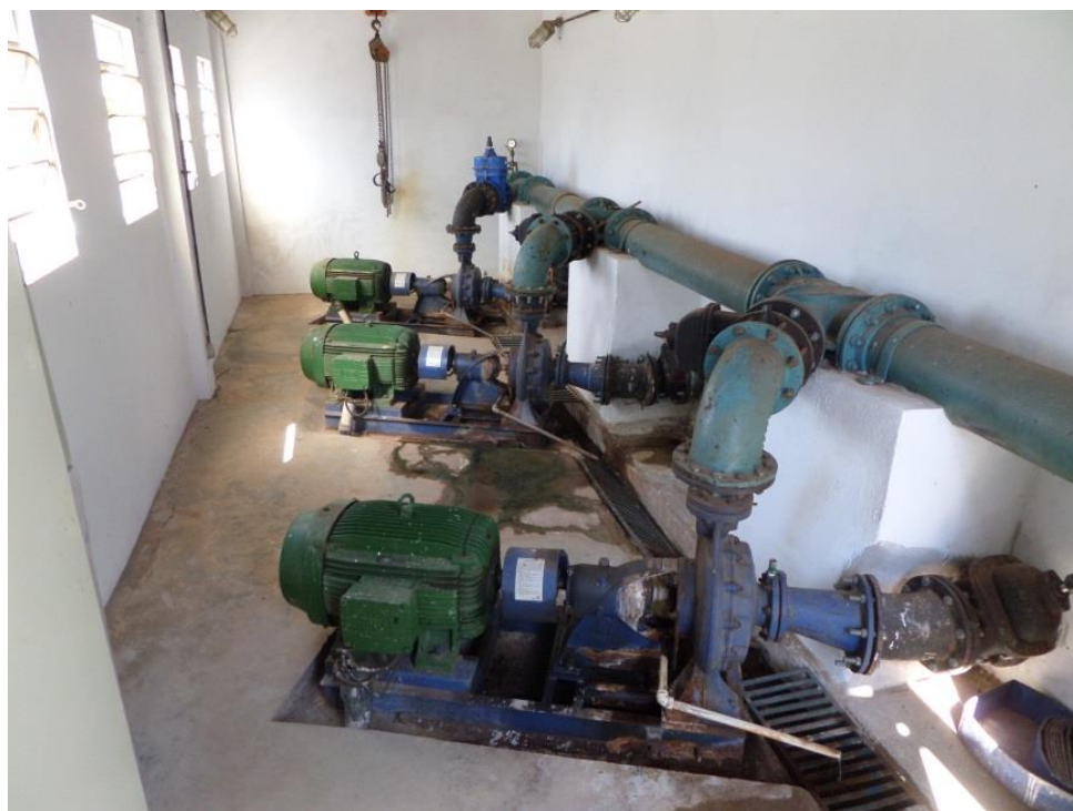
Figura 8.53 – Bombeamento da água para a rede de distribuição
