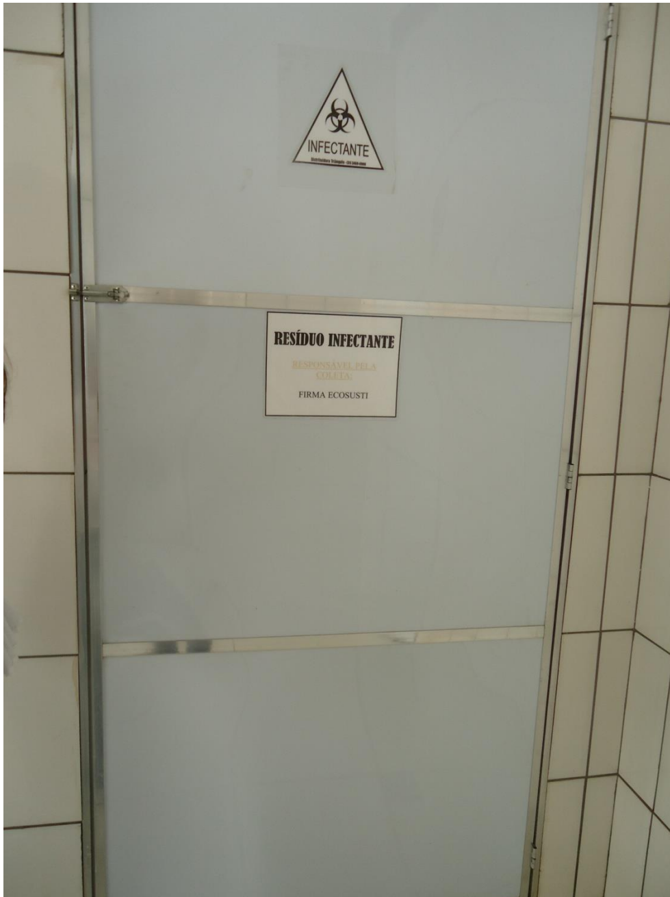
Figura 8.150 – Abrigo para armazenamento de Resíduos Infectantes
