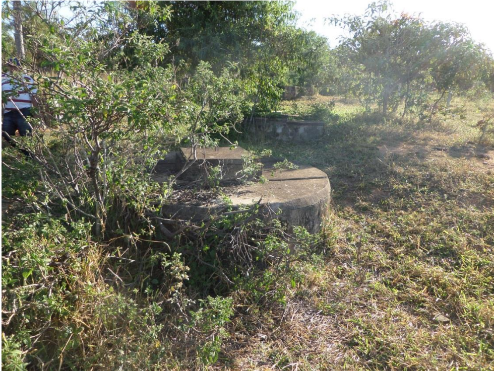
Figura 8.105 – Detalhe do filtro anaeróbico da ETE Veredas
