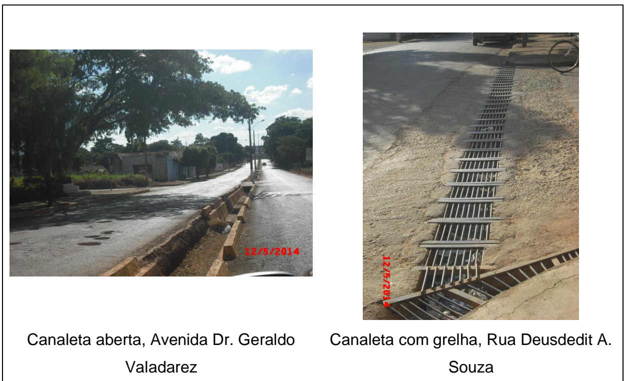
Figura 8.189 – Dispositivos de microdrenagem existentes
