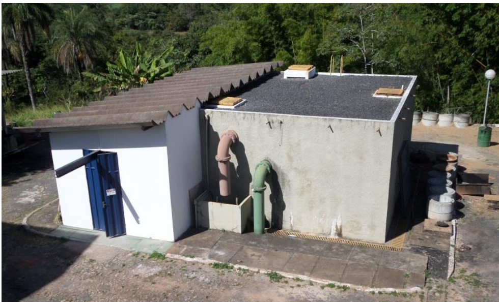
Figura 8.51 – Detalhe do tanque de contato da ETA
