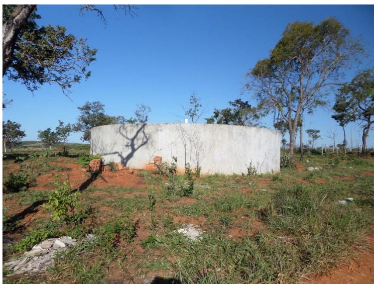
Figura 8.84 – Reservatório 2 do Balneário Vitória Porto Mangaba
