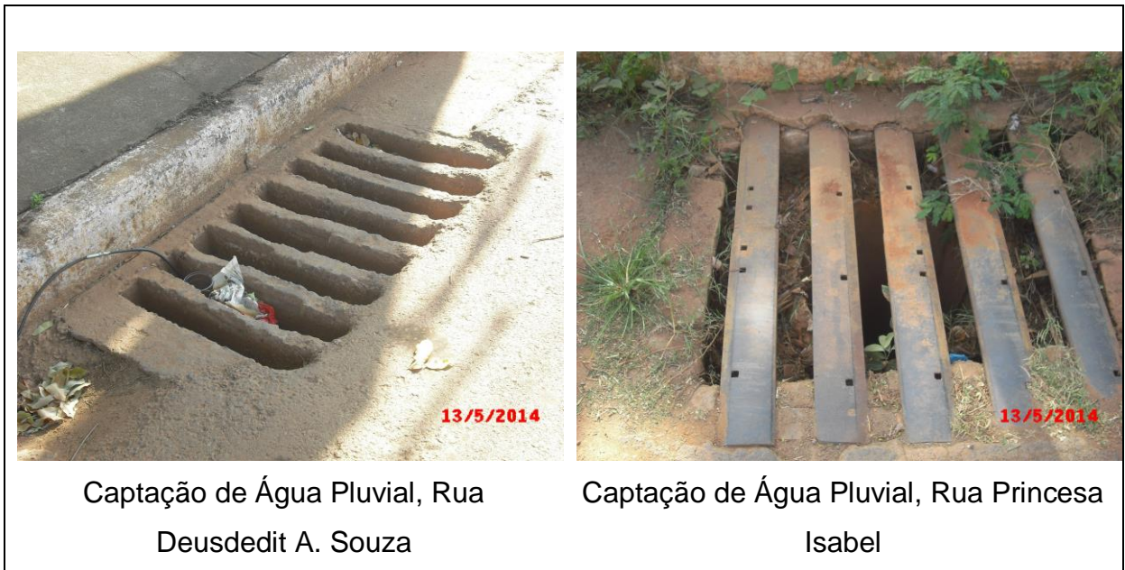
Figura 8.188 – Dispositivos de microdrenagem existentes
