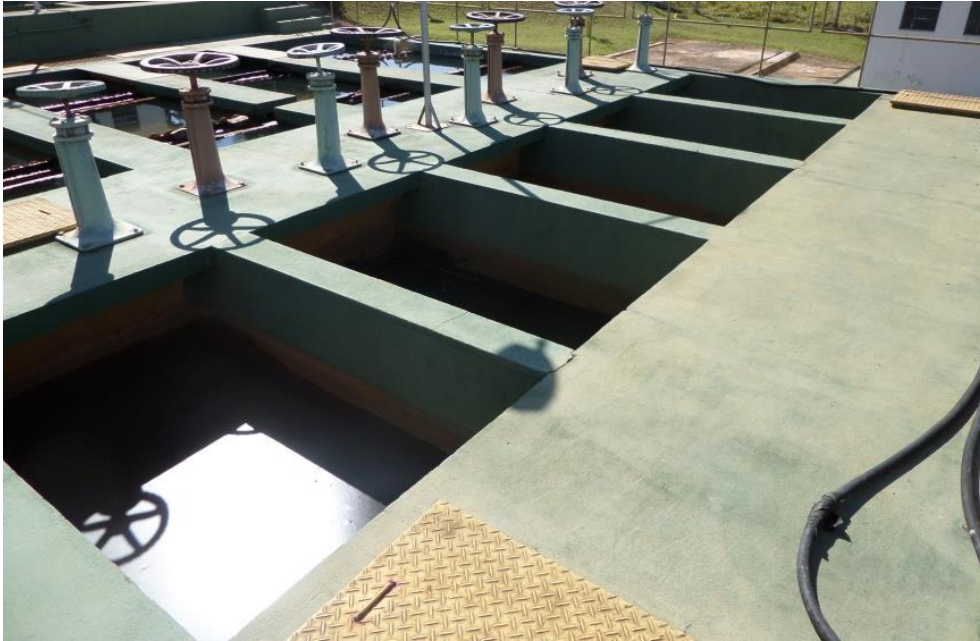
Figura 8.50 – Vista das unidades de filtração da ETA
