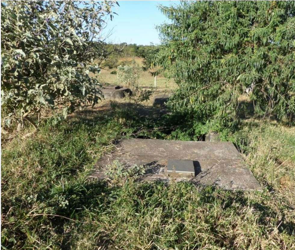
Figura 8.104 – Detalhe do tanque de decantação e digestão da ETE Veredas
