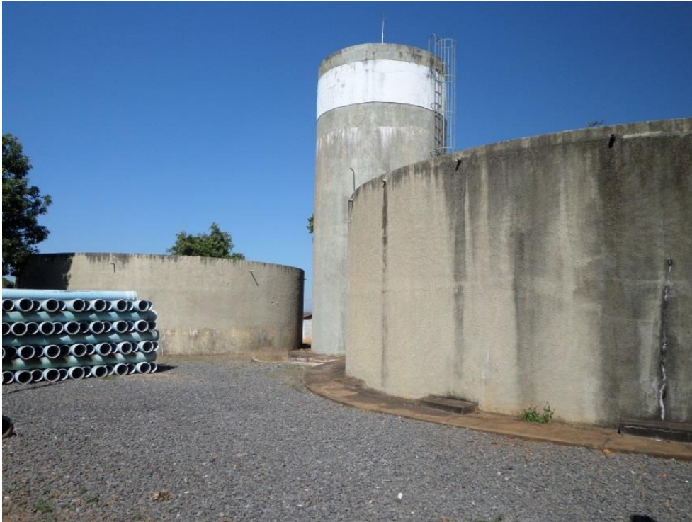
Figura 8.56 – Reservatórios apoiados (RAP 2 e RAP 4) e elevado (REL 3)
