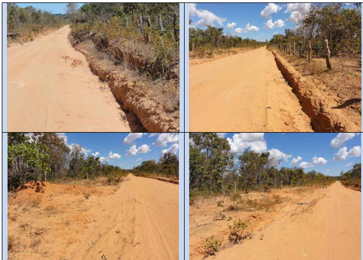
Figura 6.5 - Estrada Rural que deverá ser readequada.
