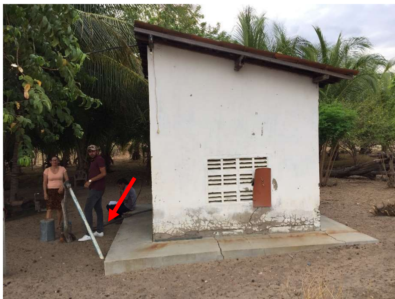
Figura 4-55 - Poço artesiano inoperante na localidade de Tamboril
