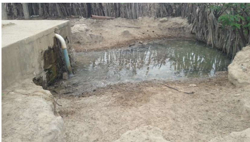
Figura 4-40 - Evidência de vazamento no reservatório de água
