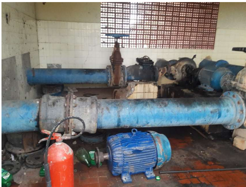
Figura 4-28 - Estação elevatória de água tratada na ETA Fonte: Projeta Engenharia (2017)
