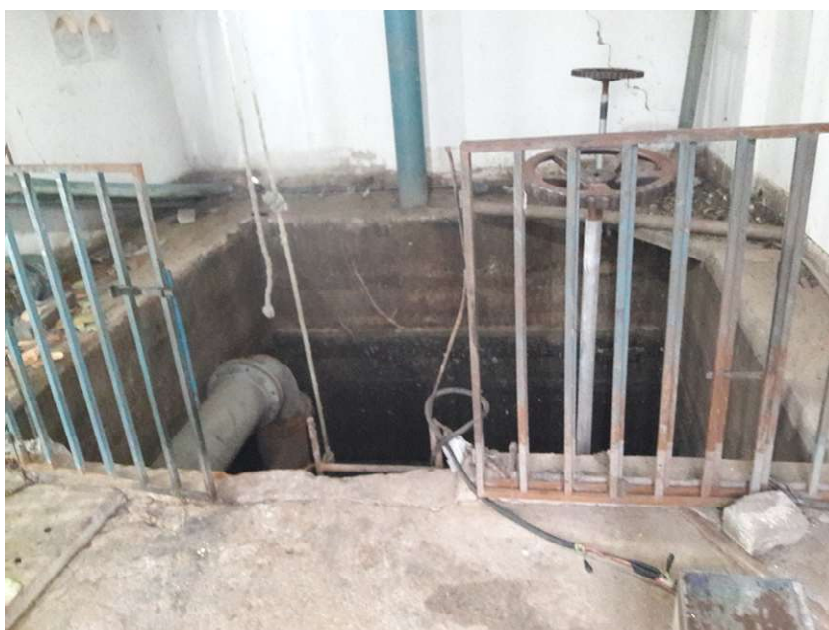
Figura 4-78 - Vista interna da estação elevatória de esgoto 1
