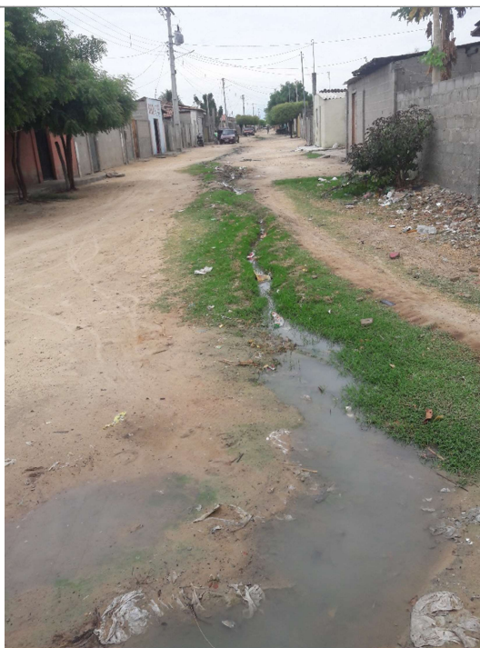
Figura 4-83 - Esgoto a céu aberto em Vila Matilde Fonte: Projeta Engenharia (2017)
