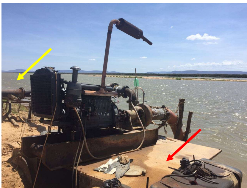
Figura 4-39 - Bomba da captação, com destaque em vermelho a ponto de vazamento e em amarelo a adutora de água bruta
