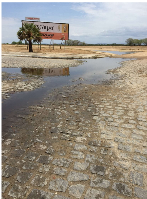
Figura 4-180 - Ponto de alagamento na rua paralela à biblioteca municipal
