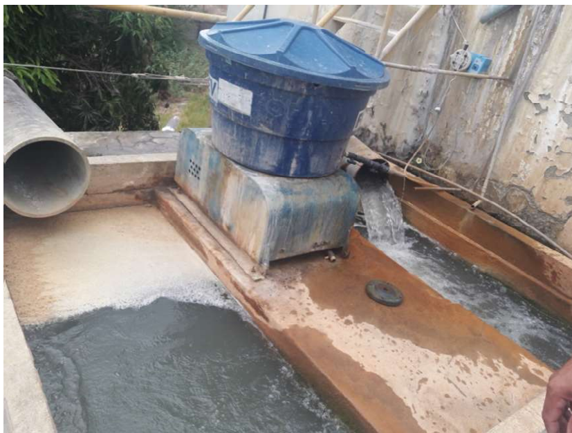
Figura 4-15 - Floculadores Fonte: Projeta Engenharia (2017)
