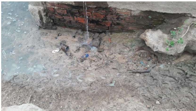
Figura 4-42 - Evidência de vazamento no reservatório de água Fonte: Projeta Engenharia (2017)
