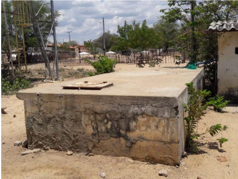
Figura 4-56 - Reservatório de água tratada na localidade de Vila Aparecida
