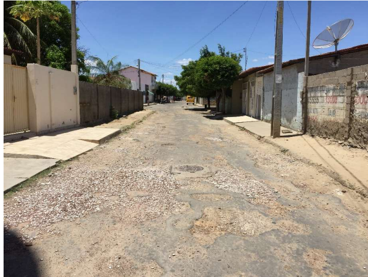
Figura 4-184 - Ponto de alagamento na Rua Presidente João Figueiredo, entre a quadra 16 e 17
