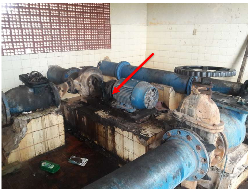
Figura 4-29 - Estação elevatória de água tratada com destaque para evidências de vazamentos Fonte: Projeta Engenharia (2017)
