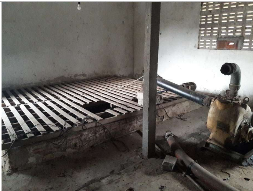
Figura 4-79 - Estação elevatória de esgoto 2
