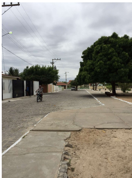
Figura 4-154 - Área sem dispositivos de microdrenagem em Novo Marcos
