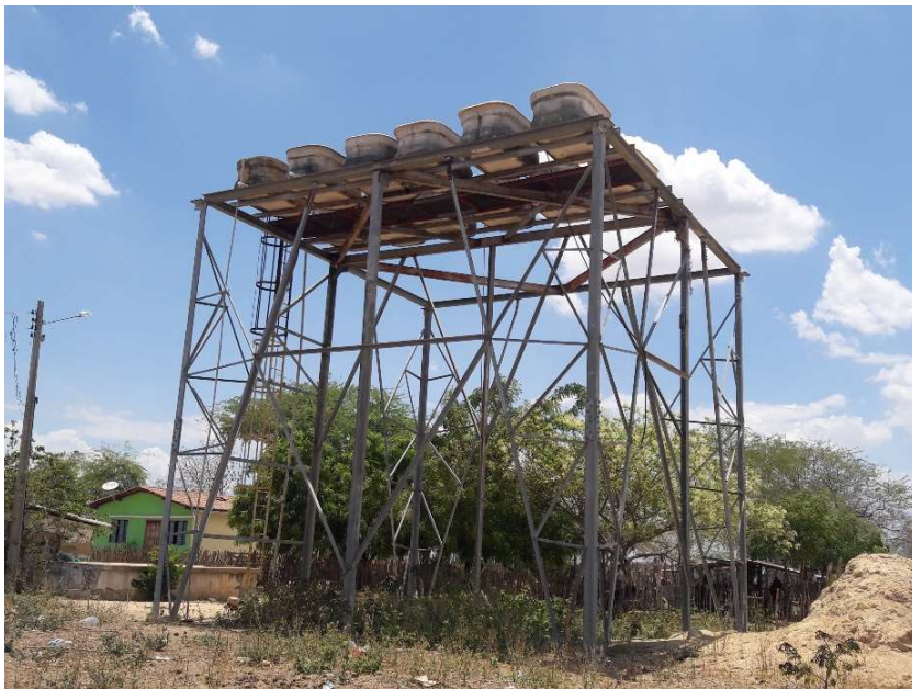
Figura 4-57 - Reservatórios de água tratada na localidade de Vila Aparecida
