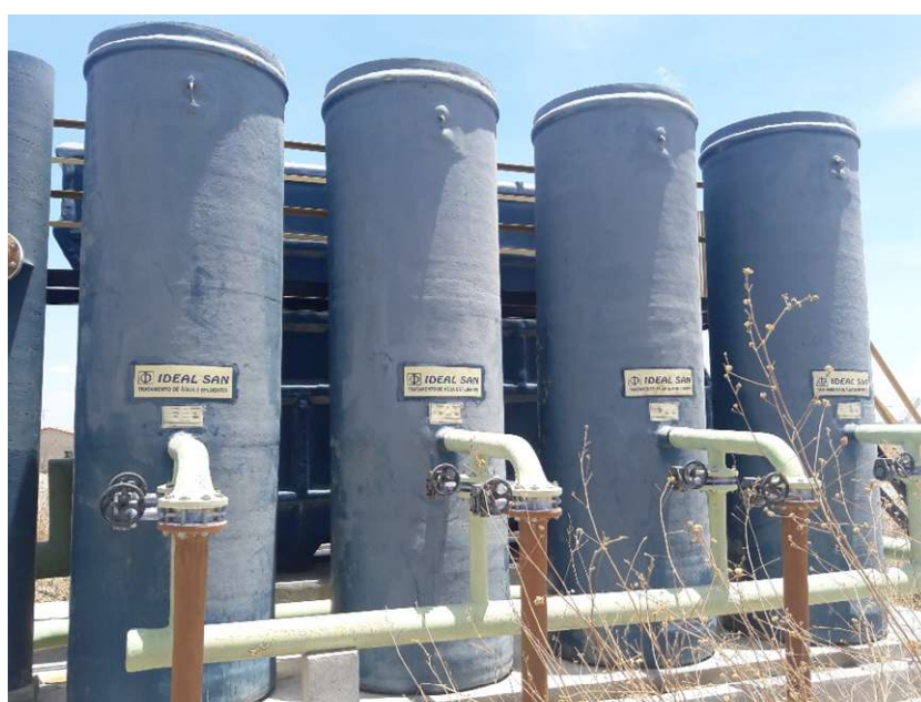
Figura 4-70 - Filtros Fonte: Projeta Engenharia (2017)
