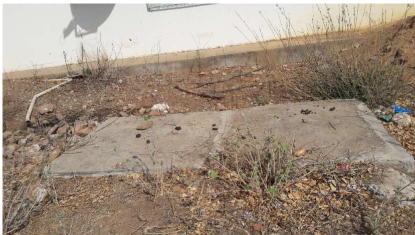
Figura 4-94 - Fossa rudimentar da escola municipal em Espinheiro
