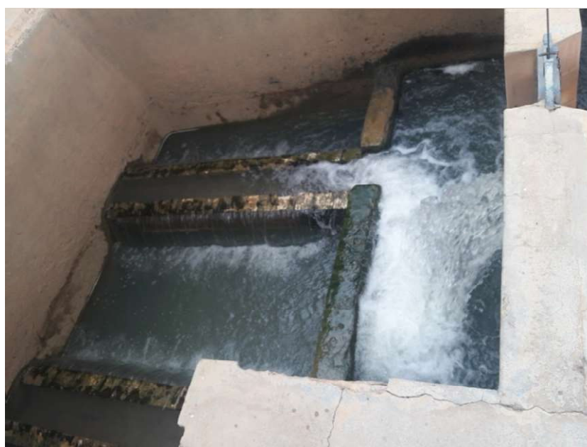
Figura 4-20 - Filtro 1 Fonte: Projeta Engenharia (2017)
