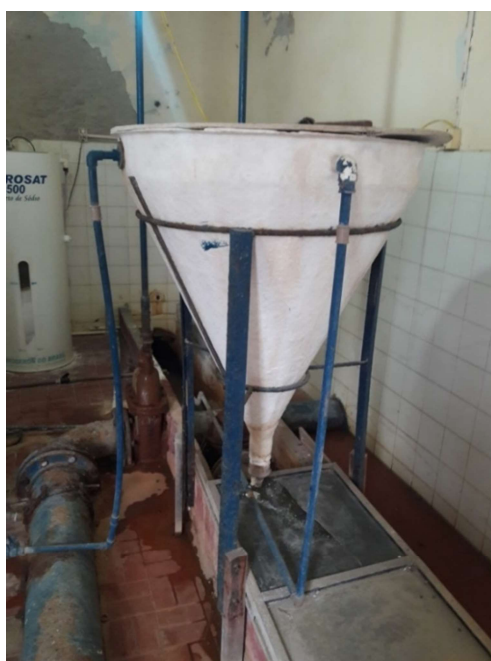
Figura 4-25 - Dosador de flúor
