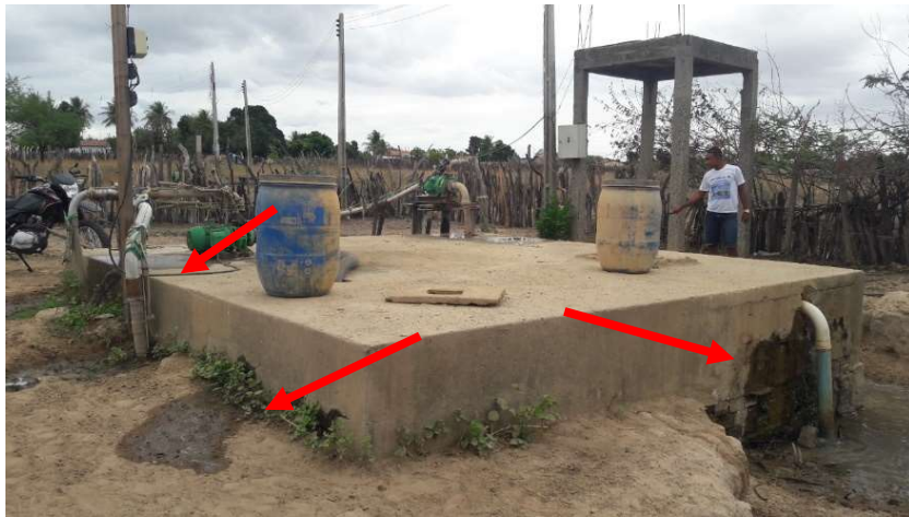
Figura 4-41 - Evidência de vazamentos no reservatório de água Fonte: Projeta Engenharia (2017)
