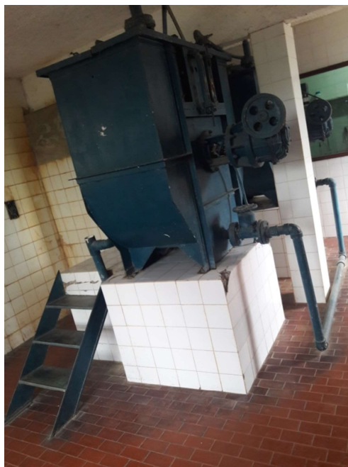
Figura 4-24 - Misturador de cal desativado
