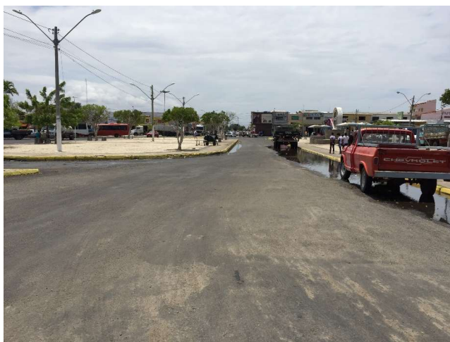
Figura 4-153 - Área sem dispositivos de microdrenagem, sede municipal
