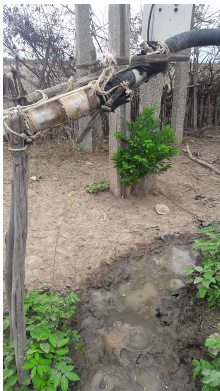
Figura 4-43 - Vazamento na adutora de água tratada
