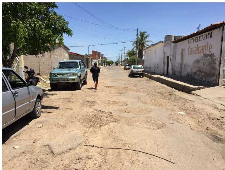
Figura 4-158 - Área apresentando desgaste da manta asfáltica, com presença de depressões, na Rua Coronel Francisco Leobas
