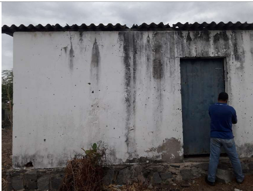
Figura 4-81 - Estação elevatória de esgoto 3
