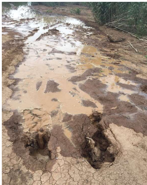
Figura 4-49 - Vazamento na adutora de água bruta de malhadinha
