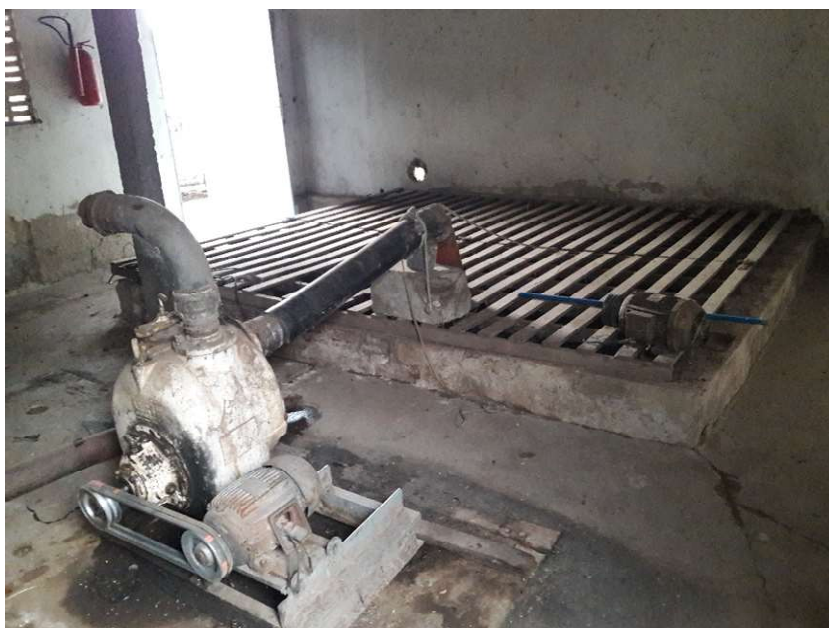
Figura 4-80 - Estação elevatória de esgoto 2
