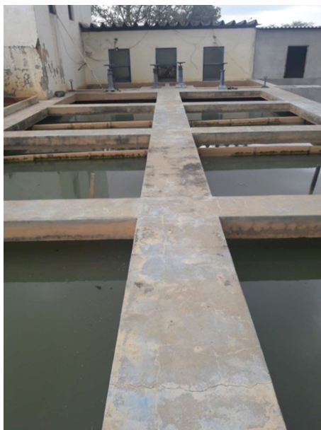
Figura 4-19 - Decantadores Fonte: Projeta Engenharia (2017)
