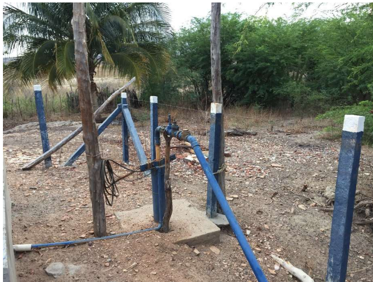
Figura 4-54 - Poço artesiano na localidade de Tamboril
