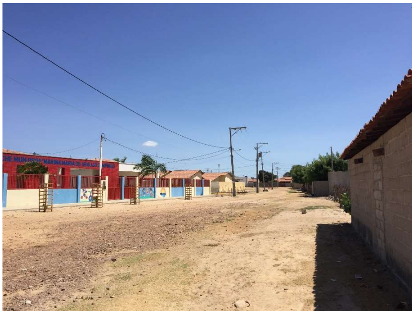
Figura 4-175 - Ponto de alagamento e canal natural de escoamento de águas pluviais – Vila Matilde Fonte: Projeta Engenharia (2017)
