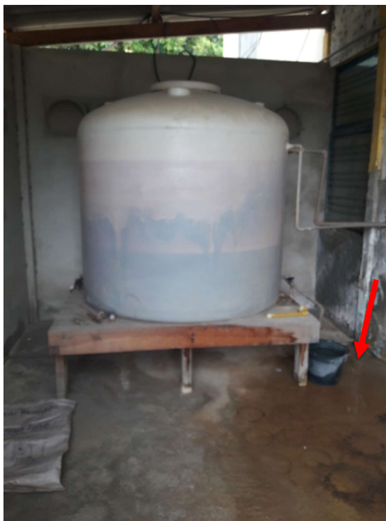
Figura 4-27 - Reservatório de Cloro, destaque para vazamento
