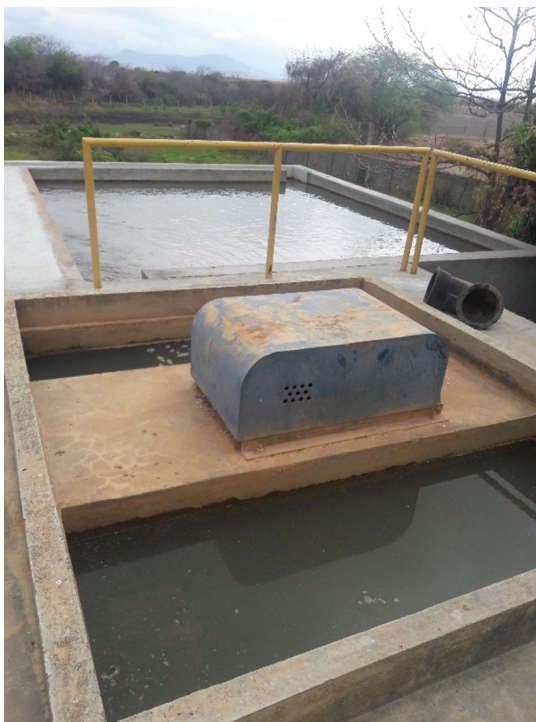
Figura 4-17 - Floculadores Fonte: Projeta Engenharia(2017)
