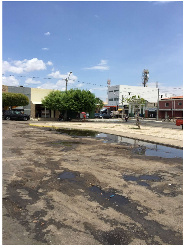
Figura 4-172 - Ponto de alagamento na rua do mercado (praça central) – alagamento em toda via
