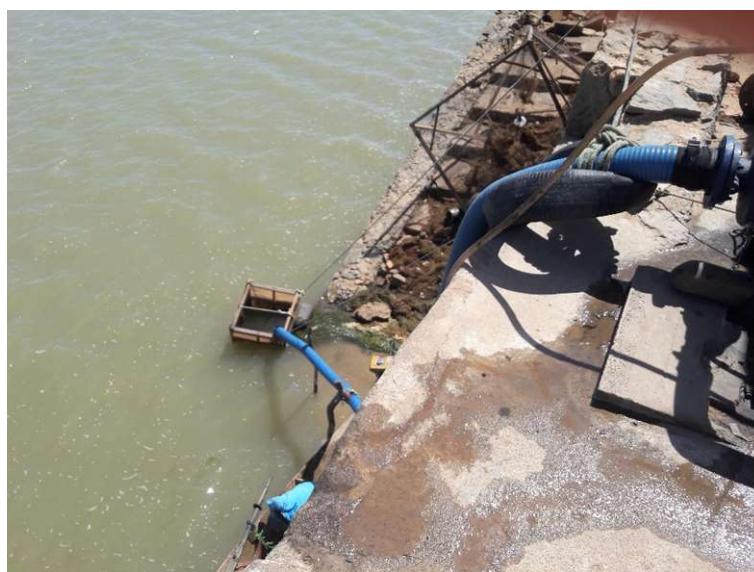
Figura 4-11 - Captação para abastecimento dos caminhões pipa Fonte: Projeta Engenharia (2017)
