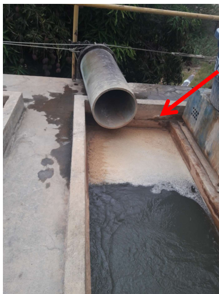
Figura 4-16 - Vista de um dos floculadores com destaque para adutora de água da captação do cais Fonte: Projeta Engenharia (2017)
