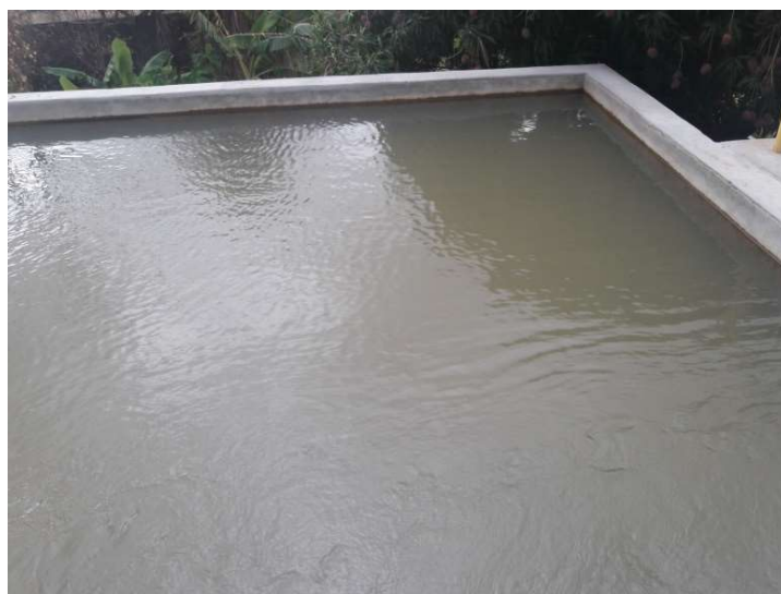
Figura 4-18 - Floculador Fonte: Projeta Engenharia (2017)
