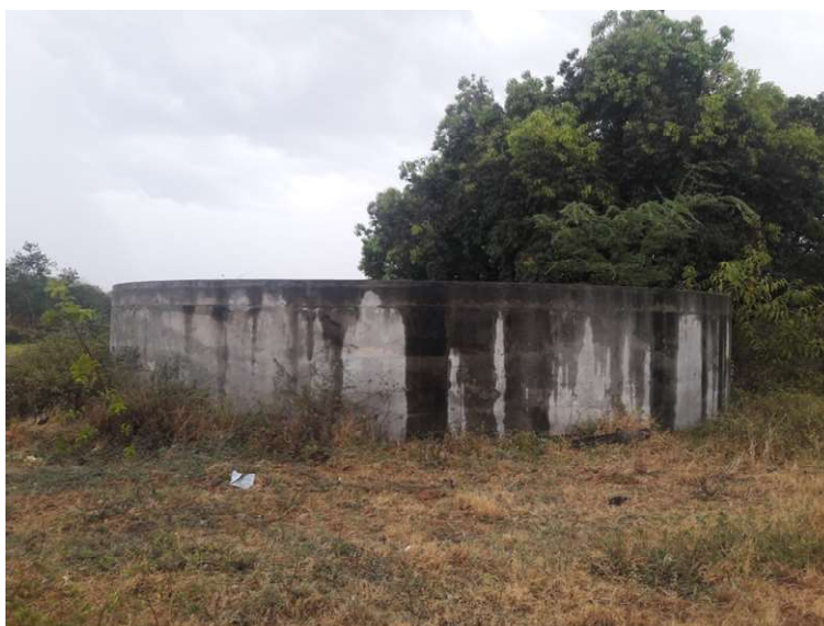
Figura 4-33 - Reservatório semienterrado inoperante Fonte: Projeta Engenharia (2017)
