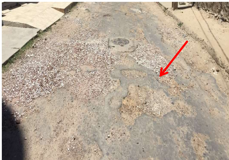
Figura 4-157 - Área apresentando desgaste da manta asfáltica na rua Presidente João Figueiredo
