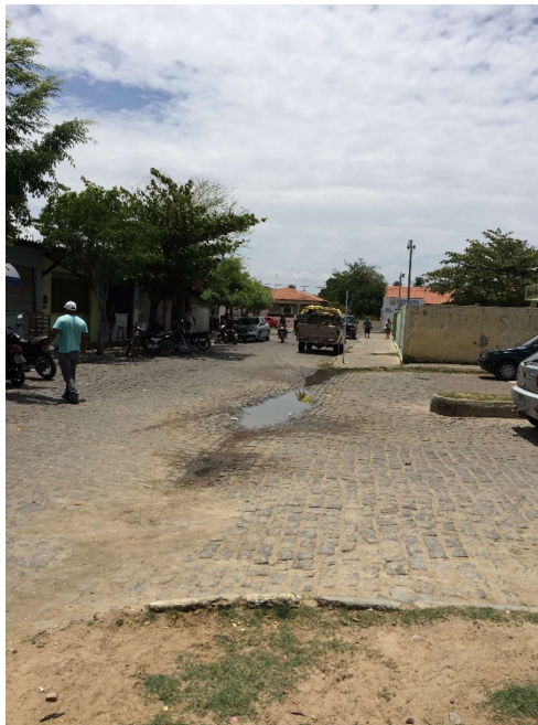
Figura 4-179 - Ponto de alagamento na rua dos Evangélicos, episódios de alagamento em toda a via
