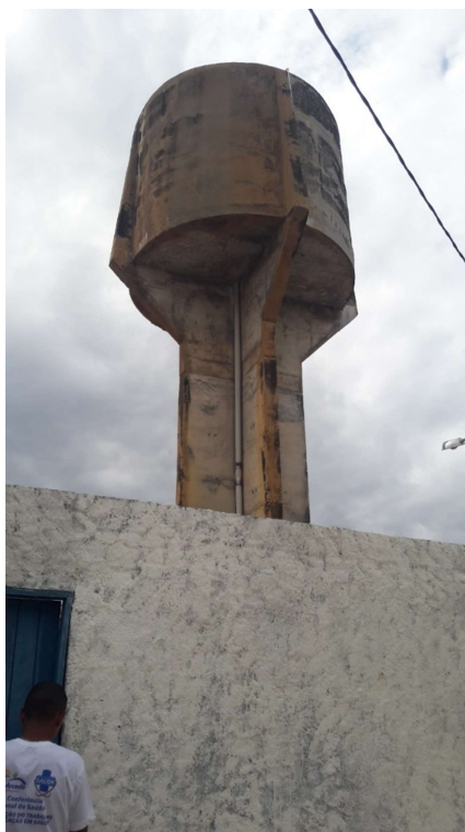
Figura 4-48 - Reservatório inoperante de Malhadinha
