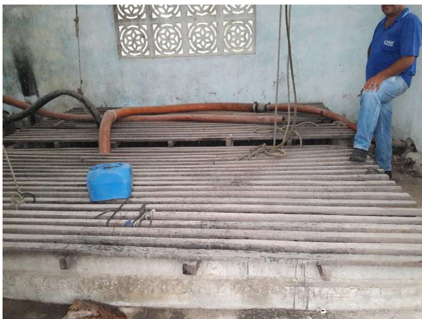
Figura 4-82 - Vista interna da estação elevatória de esgoto 3
