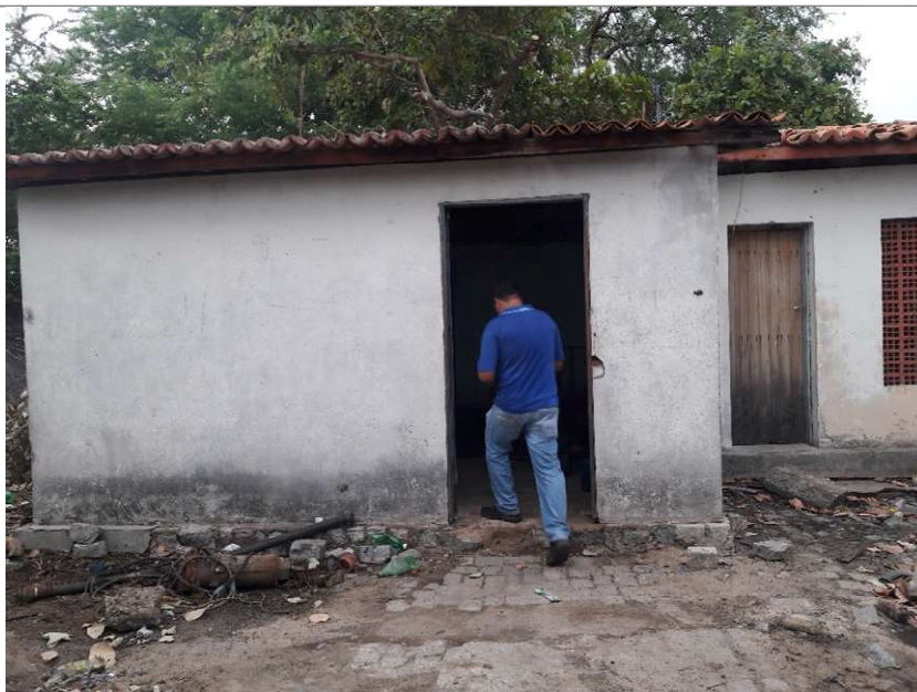
Figura 4-77 - Estação elevatória de esgoto 1 receptora do esgoto das outras duas estações
