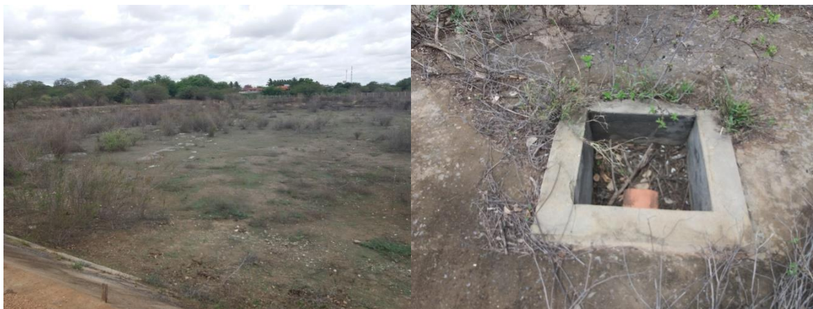
Figura 107 – Lagoa de Maturação 1 e canal de passagem, na ETE da sede de Lapão
