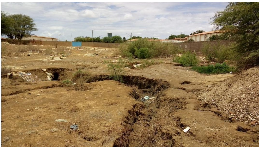
Figura 201 – Área identificada com processo erosivo (sede)
