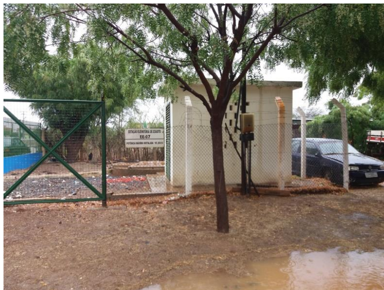
Figura 95 – Estação Elevatória de Esgoto na área da Secretaria de Infraestrutura (desativada), na sede de Lapão
