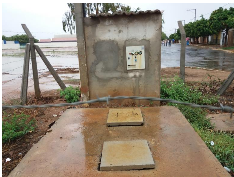
Figura 96 – Estação Elevatória de Esgoto na Rua do Hospital, na sede de Lapão
