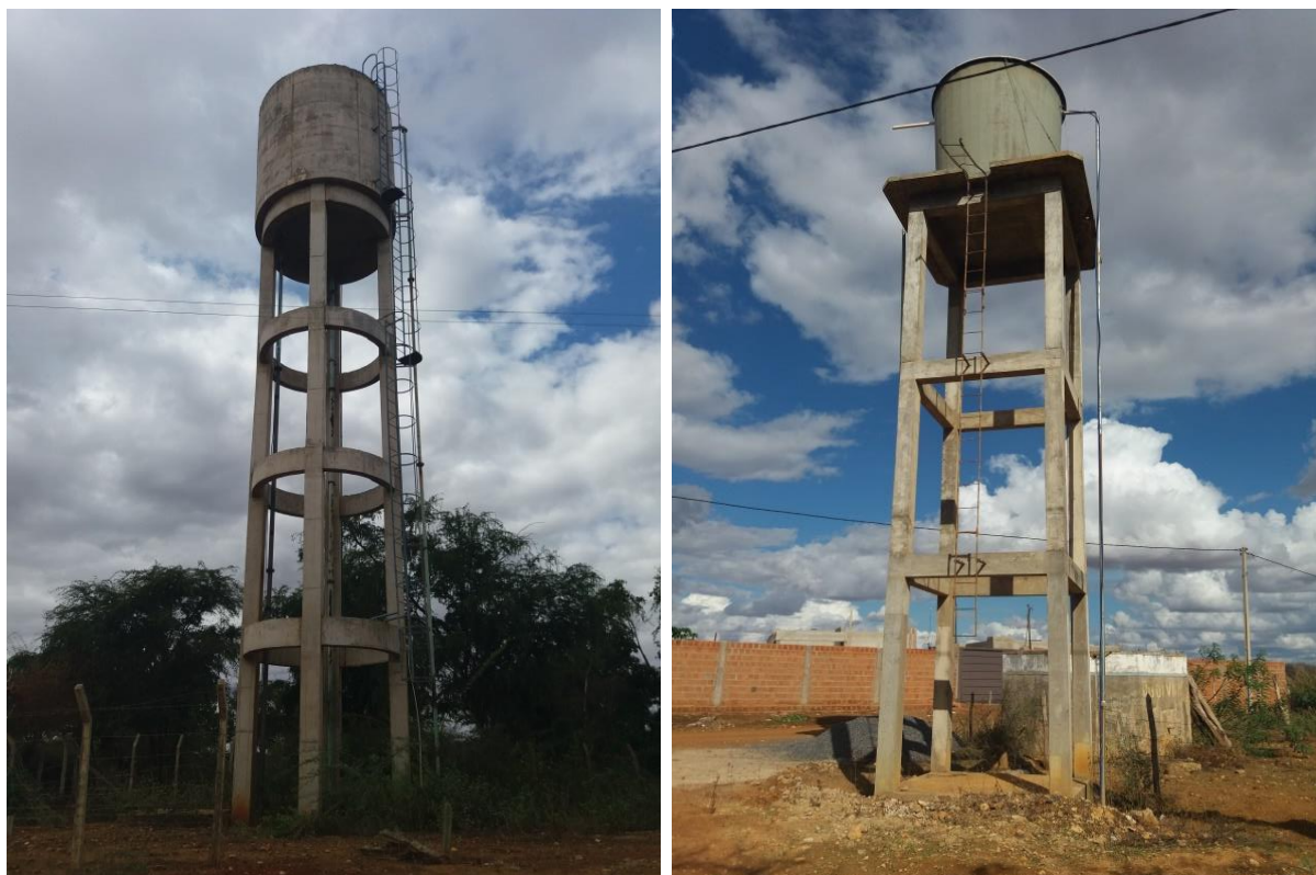
Figura 63 – Reservatório em Corta Facão (à esquerda) e reservatório em Floresta (à direita)
