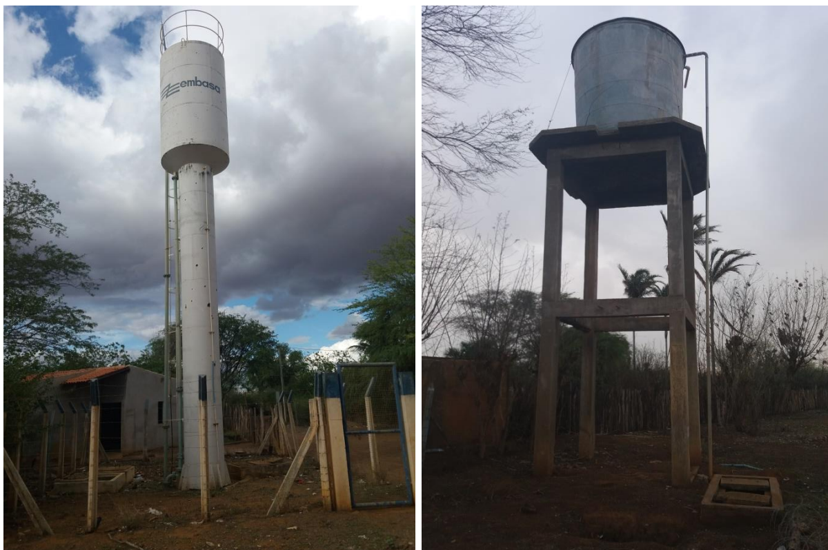
Figura 64 – Reservatório em Bonzão I (à esquerda) e reservatório em Boa Esperança (à direita)
