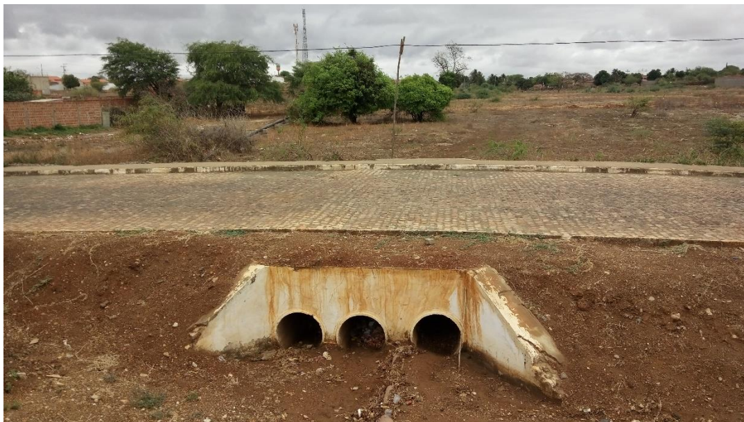
Figura 173 – Bueiro para passagem de água
