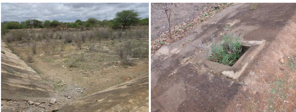
Figura 106 – Lagoa Facultativa 2 e canal de passagem, na ETE da sede de Lapão
