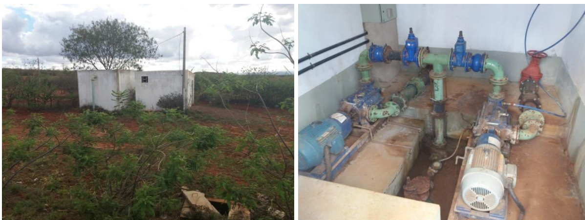
Figura 68 – Estação Elevatória de Aguada Nova e conjunto moto-bomba
