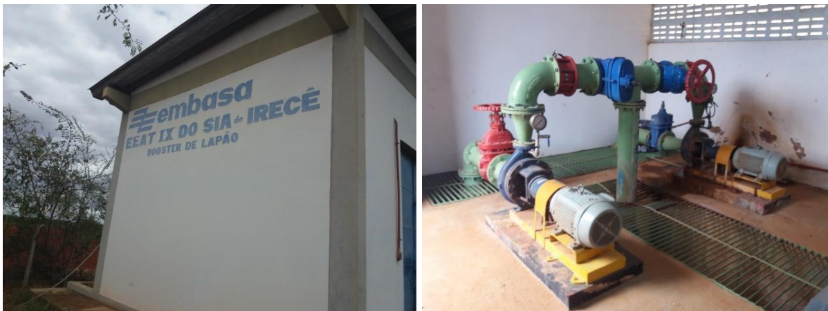
Figura 67 – Estação Elevatória de Tanquinho e conjunto moto-bomba
