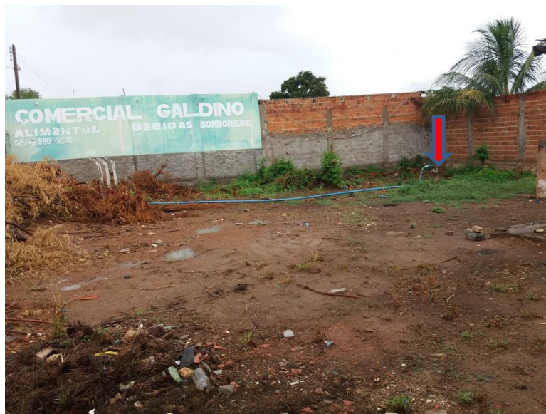
Figura 73 – Poço artesiano da Rua Leobino Rocha (Profundidade: 140 m; Vazão: 20 m 3 /h; Potência da bomba: 4,5 CV)
