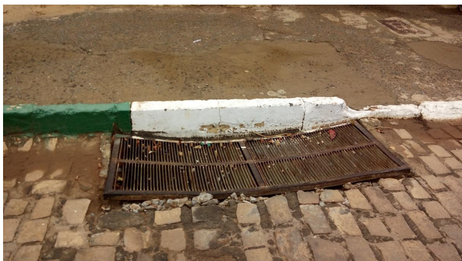
Figura 175 – Boca de lobo
