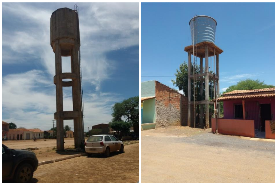
Figura 65 – Reservatório em Belo Campo (à esquerda) e reservatório em Lagoa de Gaudêncio (à direita)
