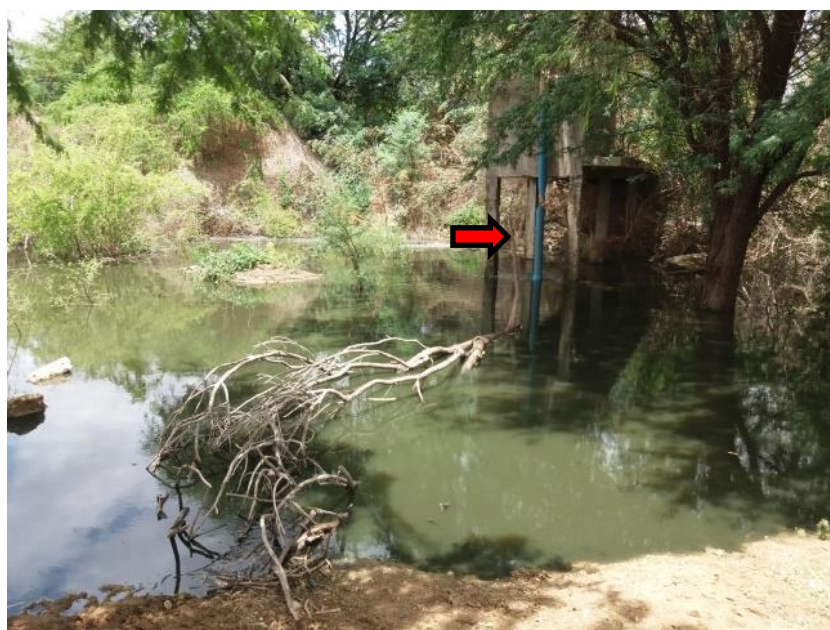
Figura 101 – Emissário rompido na lagoa formada por vazamento dos efluentes, na ETE da sede de Lapão
