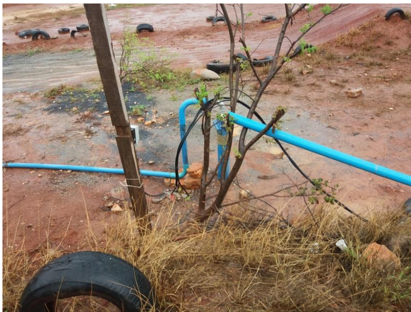
Figura 71 – Poço artesiano do Parque da Cidade (Profundidade: 150 m; Vazão: 20 m 3 /h; Potência da bomba: 6 CV)
