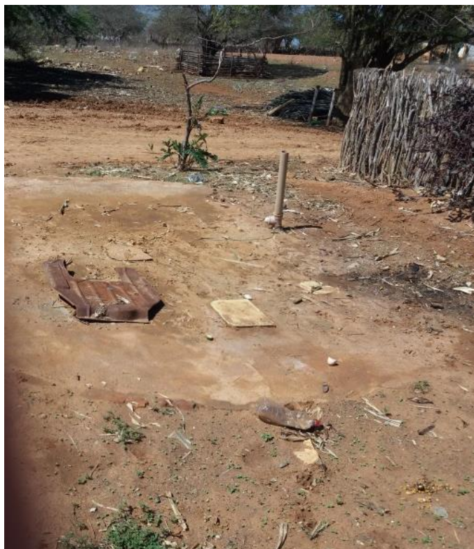
Figura 110 – Fossa rudimentar com suspiro em domicílio de Alto Bonito
