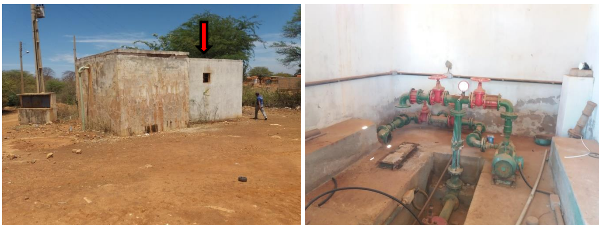
Figura 69 – Estação Elevatória de Bom Prazer e conjunto moto-bomba
