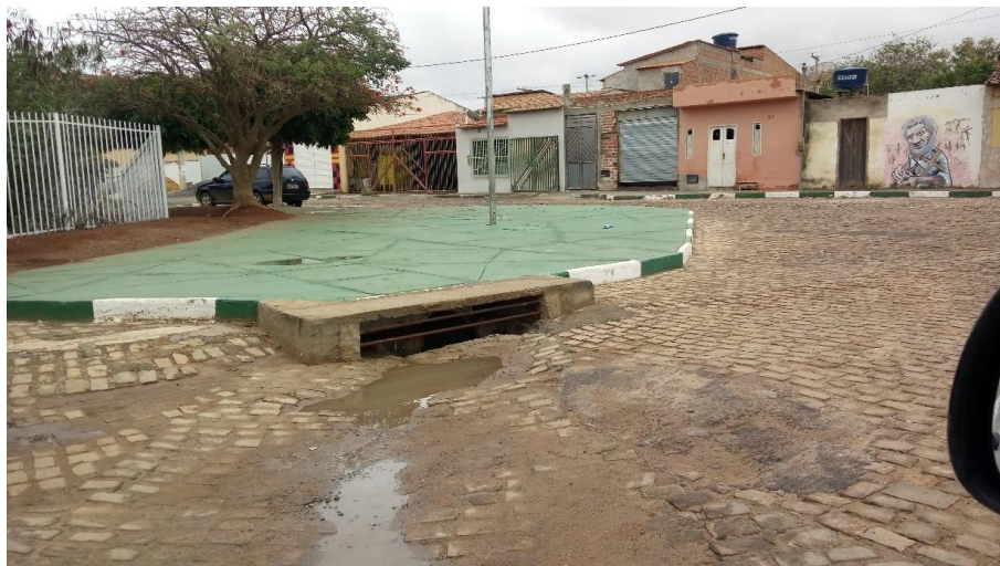
Figura 174 – Boca de lobo
