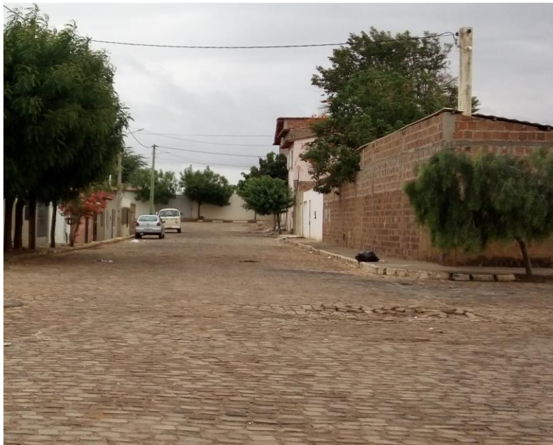
Figura 177 – Rua sem dispositivos de microdrenagem
