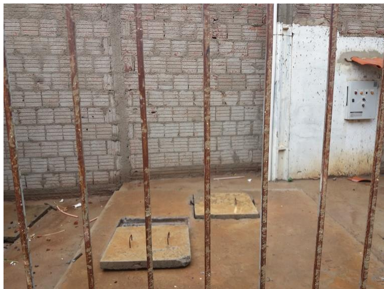
Figura 97 – Estação Elevatória de Esgoto na Rua Leobino Rocha, na sede de Lapão
