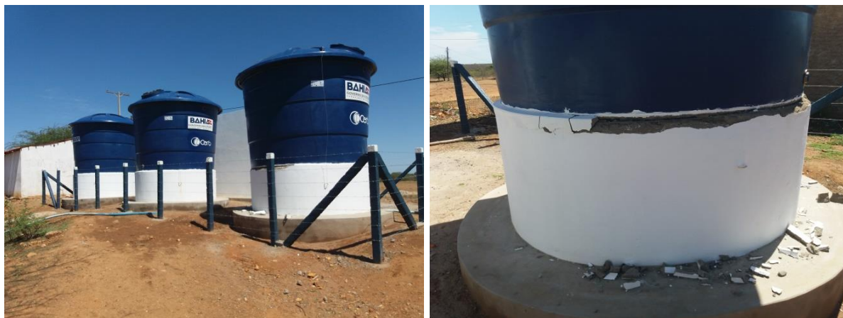
Figura 80 – Estação de Dessalinização em Lagedinho
