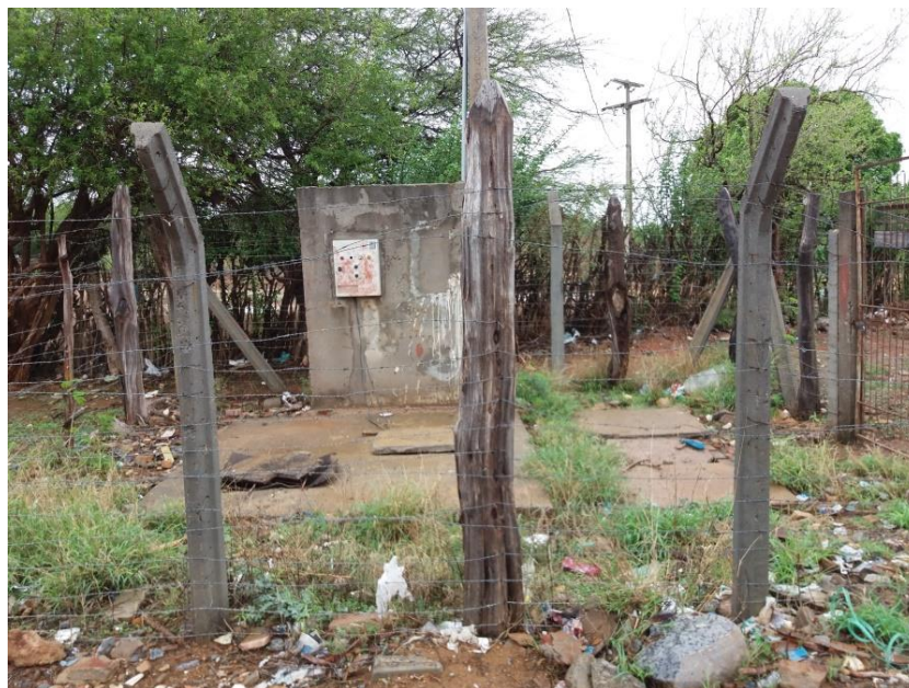
Figura 99 – Estação Elevatória de Esgoto na Rua Ida Cardoso, na sede de Lapão
