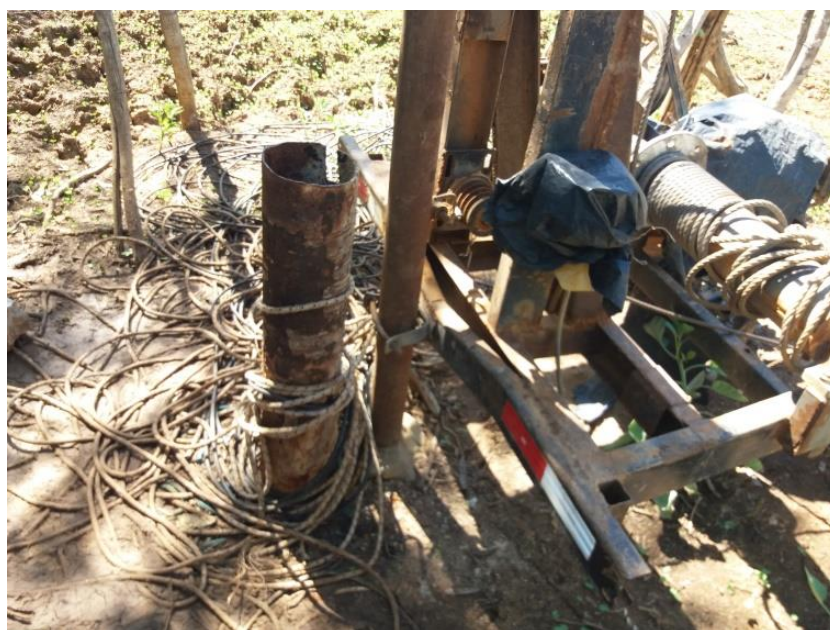
Figura 77 – Poço artesiano no povoado de Aroeira
