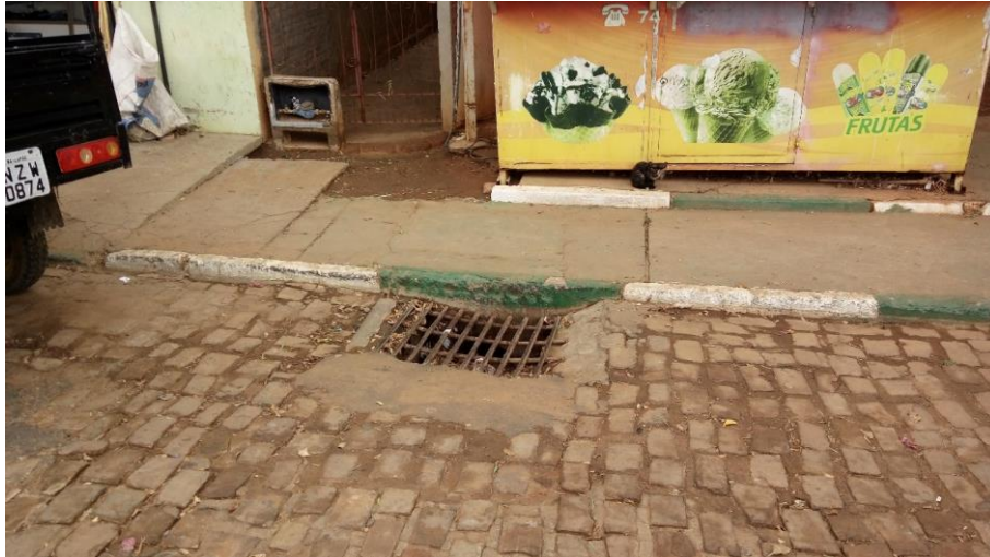
Figura 176 – Boca de lobo
