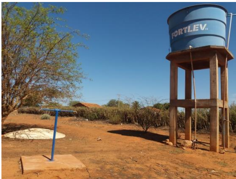
Figura 78 – Reservatório e chafariz inoperantes no povoado de Alto Bonito
