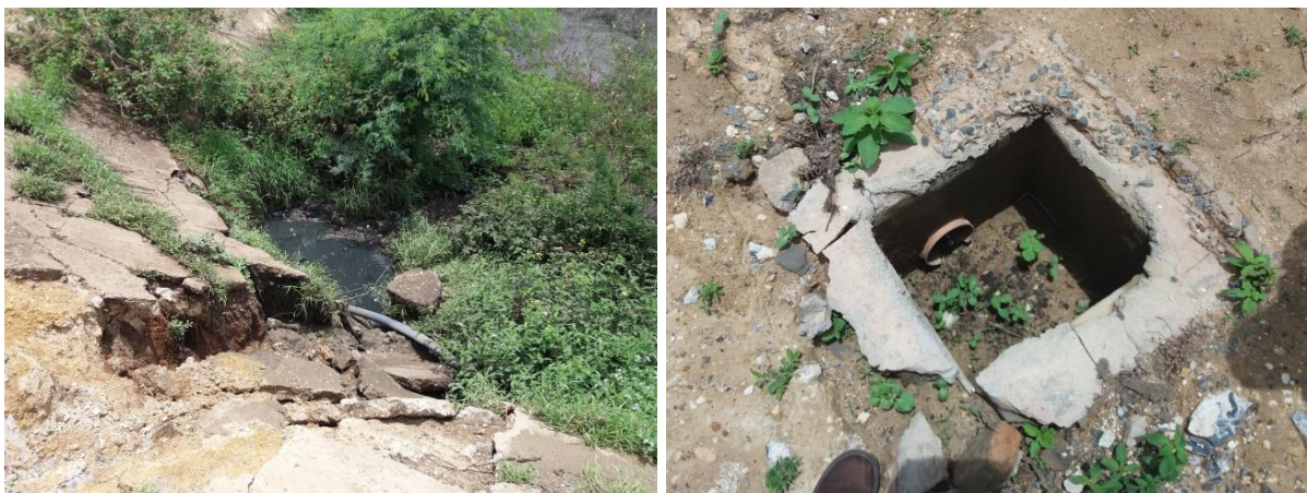
Figura 105 – Canal de passagem entre lagoas degradado e caixa de passagem entupida, na ETE da sede de Lapão
