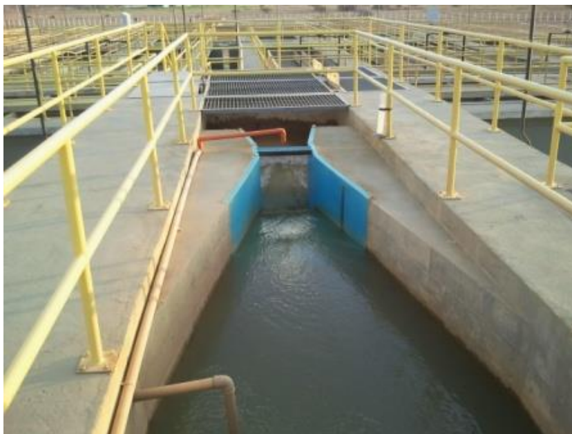
Figura 61 – Calha parshall da ETA Ibititá
