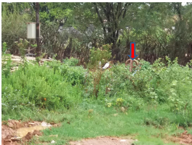
Figura 72 – Poço artesiano da área da Secretaria de Infraestrutura (Profundidade: 60 m; Vazão: 20 m 3 /h; Potência da bomba: 6 CV)
