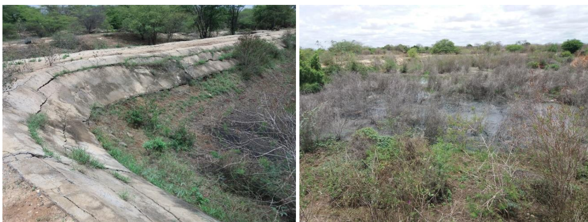
Figura 104 – Bordas rachadas da lagoa facultativa e arbustos na lagoa facultativa, na ETE da sede de Lapão
