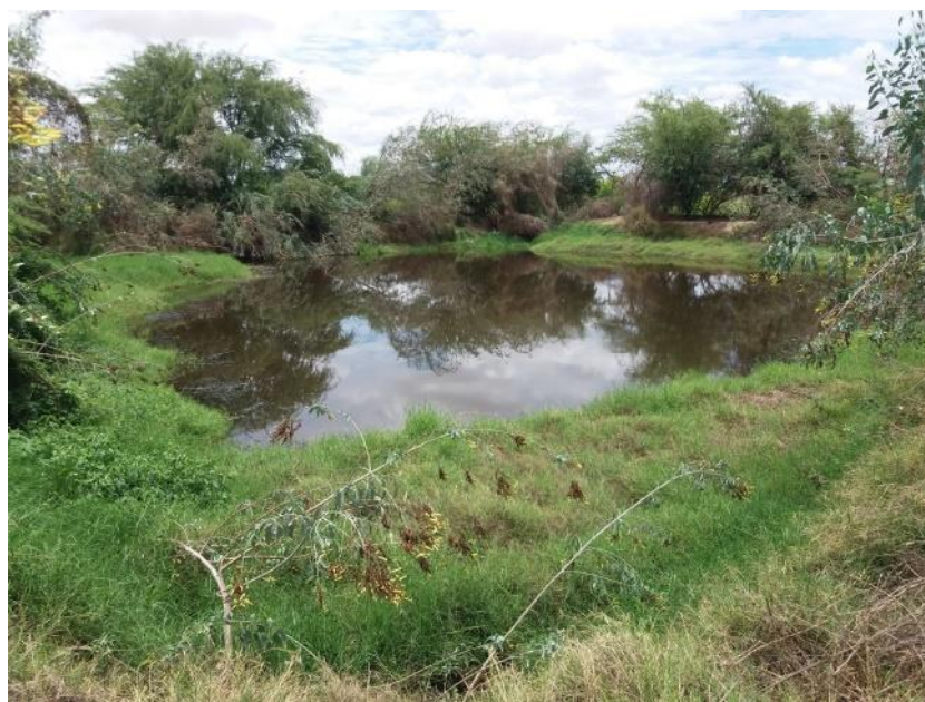
Figura 100 – Lagoa Anaeróbia, na ETE da sede de Lapão
