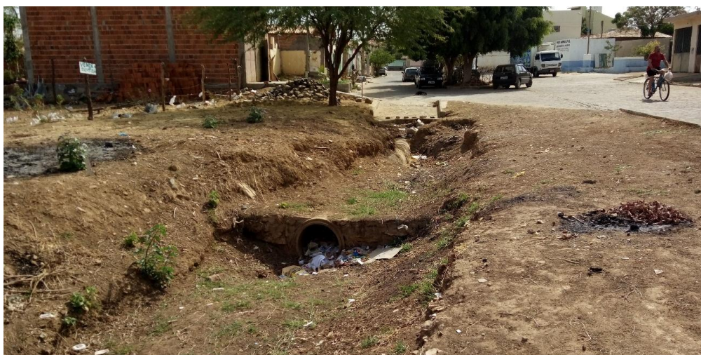
Figura 4-131 - Manilha de pequeno porte que conduz as águas captadas por bueiros e bocas de lobo para os dispositivos de macrodrenagem
