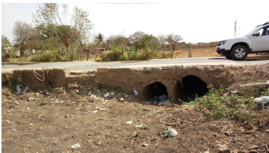
Figura 4-130 - Manilhas de saída das águas pluviais da Lagoa Grande
