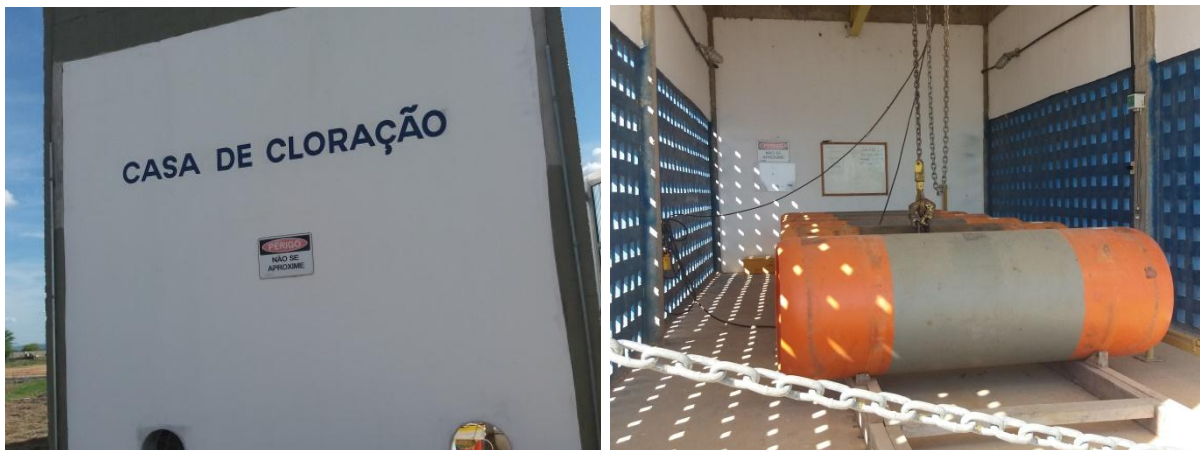
Figura 4-31 – Tinas de cloro destinado ao reservatório, da Casa de Cloração da ETA Rio Verde
