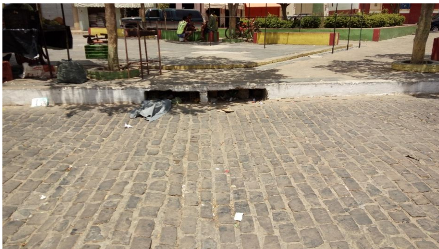
Figura 4-134 - Boca de Lobo situada na praça do Comércio que faz a interceptação das águas pluviais e a direciona para a Lagoa do Ferreira
