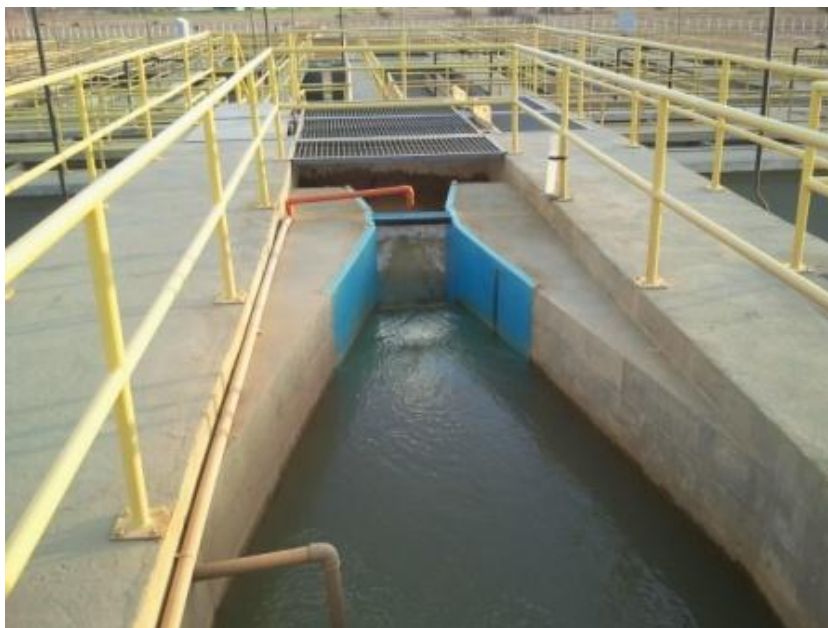
Figura 4-14 – Calha parshall da ETA Ibititá.
