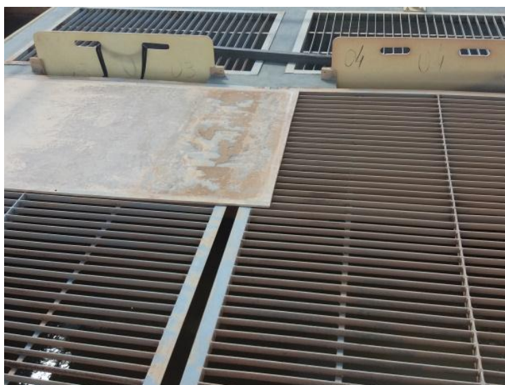
Figura 4-21 – Caixas de distribuição para coagulação na ETA Rio Verde
