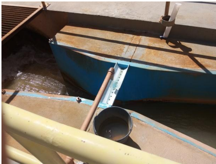
Figura 4-20 – Dosador de coagulante na calha parshall na ETA Rio Verde
