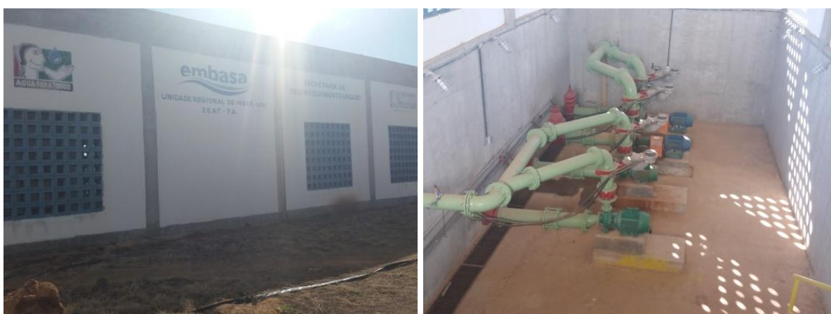
Figura 4-35 – Estação Elevatória de Água Tratada 9A e conjuntos moto-bomba
