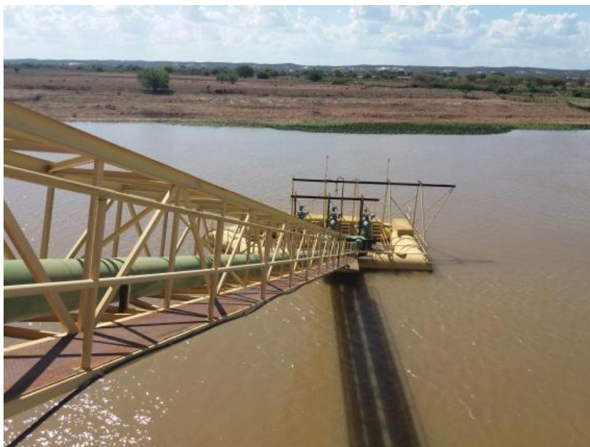
Figura 4-17 – Balsa flutuante da captação no Rio São Francisco.
