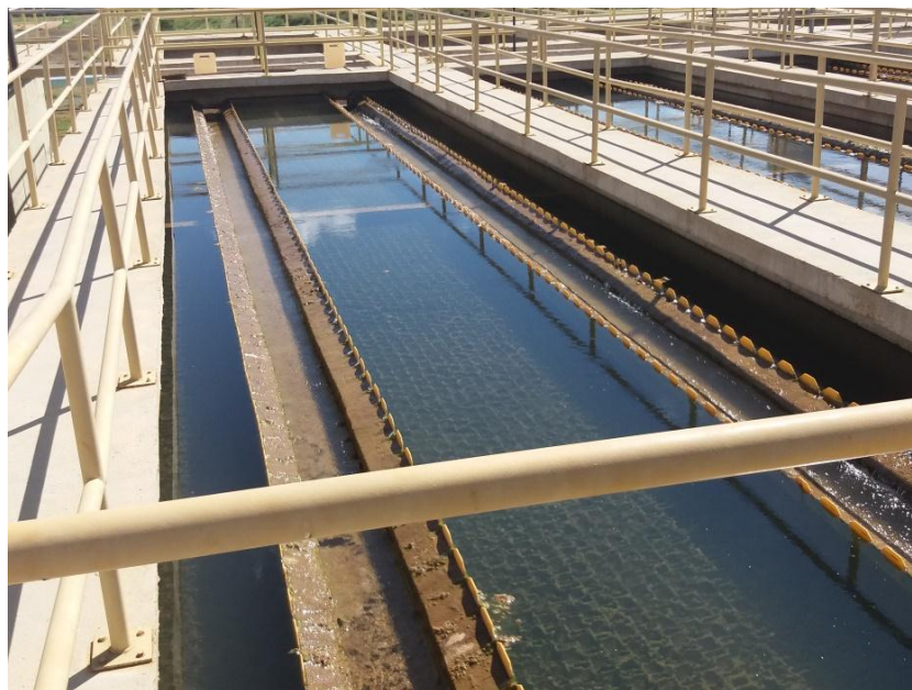
Figura 4-23 – Decantador na ETA Rio Verde
