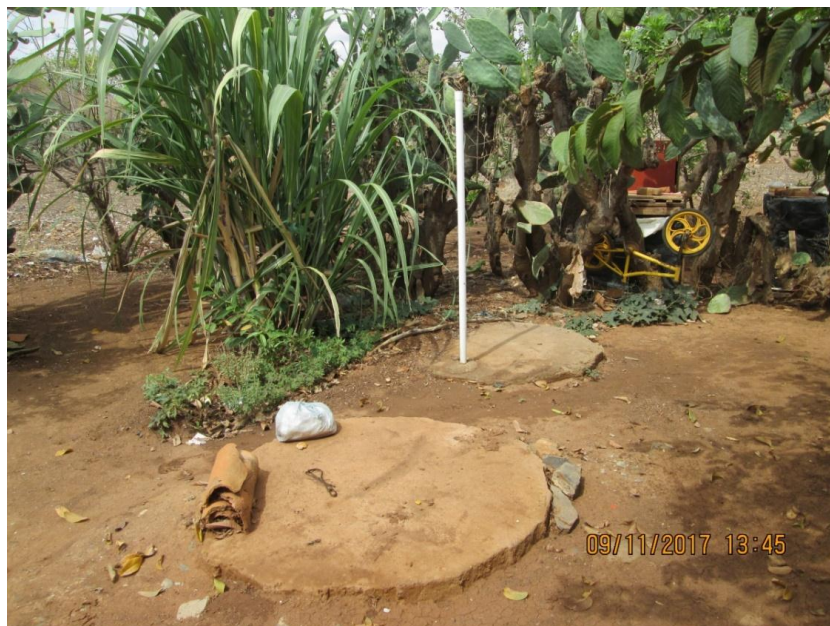
Figura 4-63 – Fossa rudimentar e sumidouro em domicílio na localidade de Sapecado.
