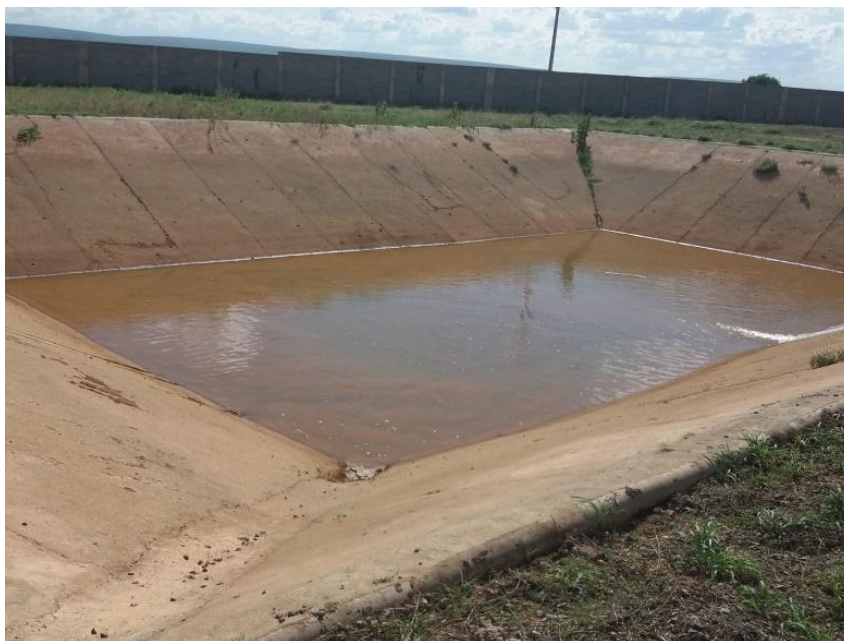
Figura 4-28 – Lagoa de equalização da água de lavagem dos filtros da ETA Rio Verde
