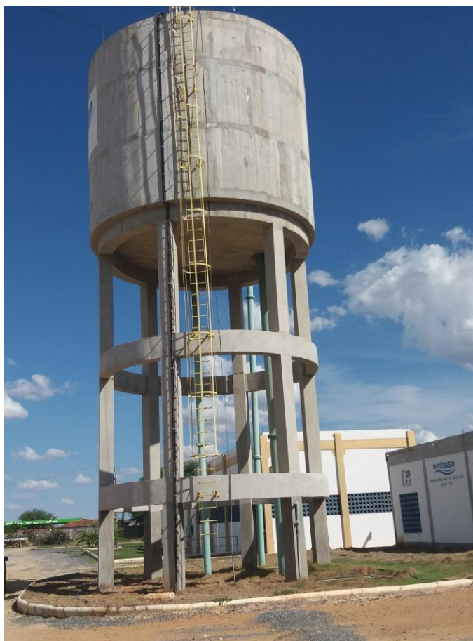
Figura 4-25 – Reservatório de uso geral da ETA Rio Verde
