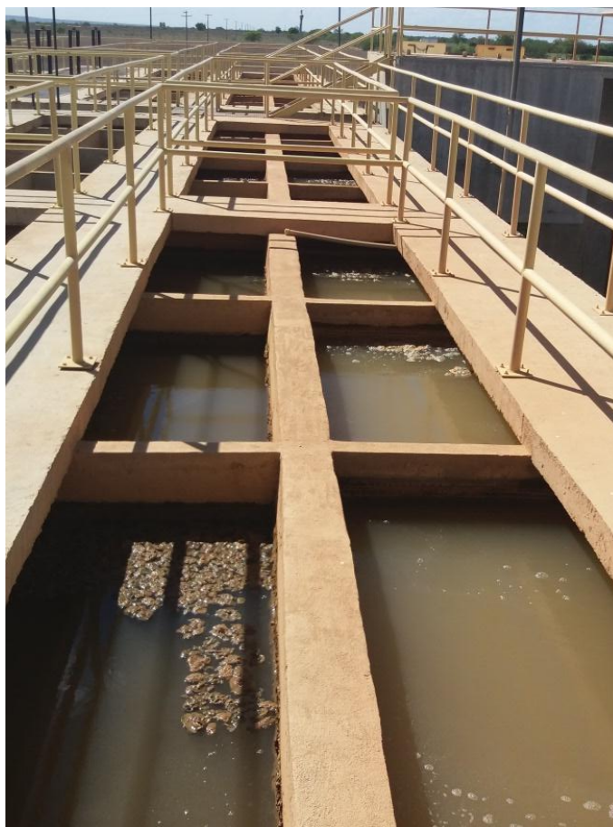
Figura 4-22 – Câmaras de floculação na ETA Rio Verde
