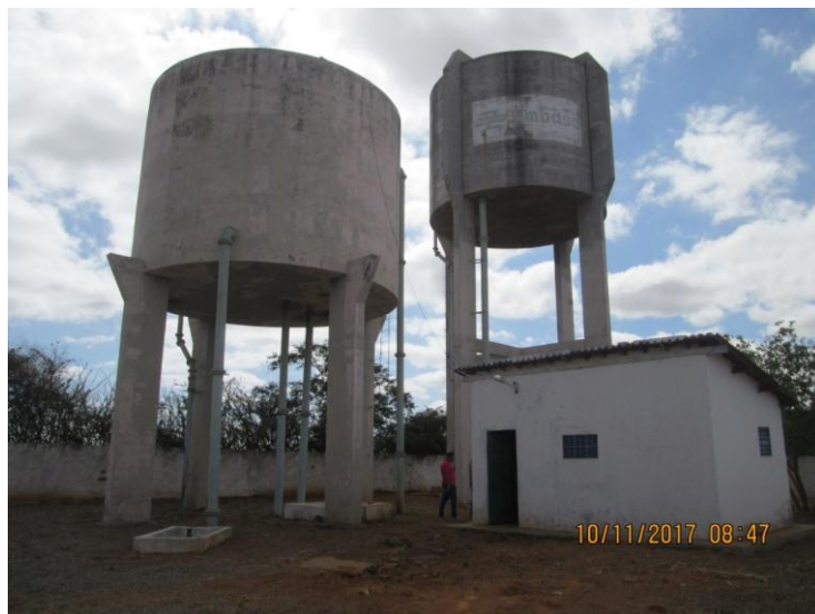
Figura 4-36 – Reservatório (à direita) distribui água para a sede e reservatório (à esquerda) distribui água para o reservatório de Sapecado, ambos localizados na sede de Presidente Dutra.
