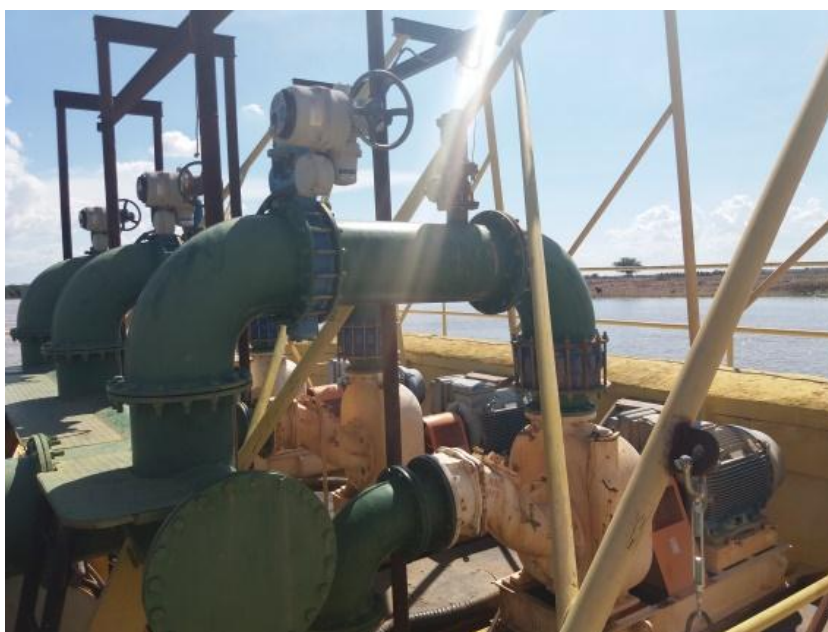
Figura 4-18 – Conjuntos moto-bomba da captação na balsa.
