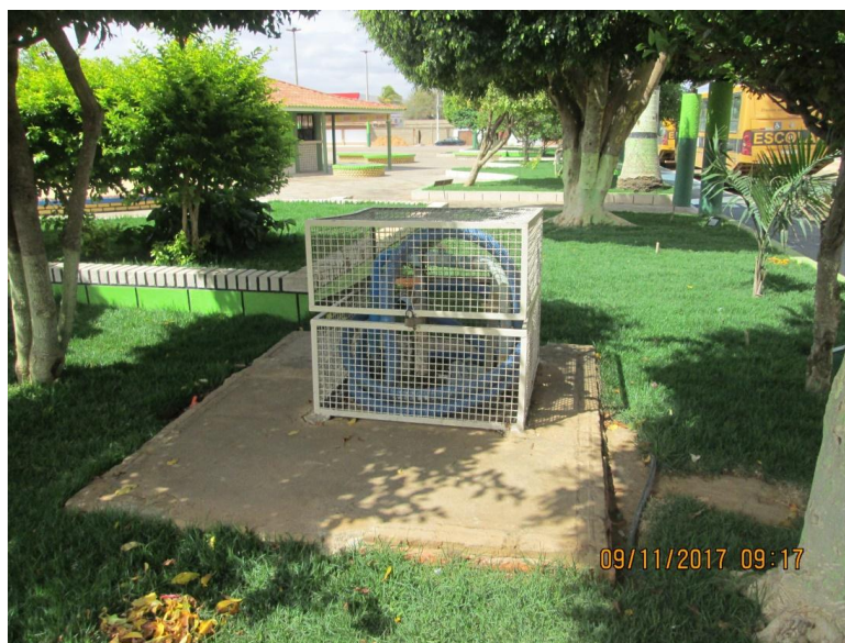
Figura 4-46 – Poço artesiano na Praça Lia Barreto, na sede de Presidente Dutra.
