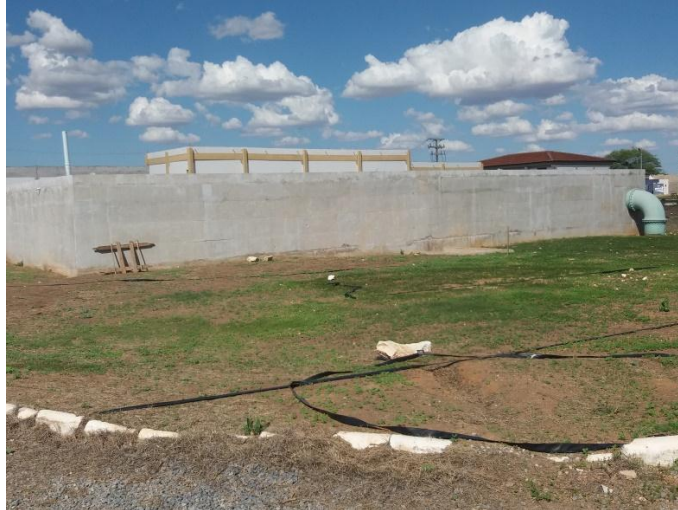
Figura 4-26 – Reservatório de água tratada para distribuição da ETA Rio Verde Fonte: Projeta Engenharia (2017)
