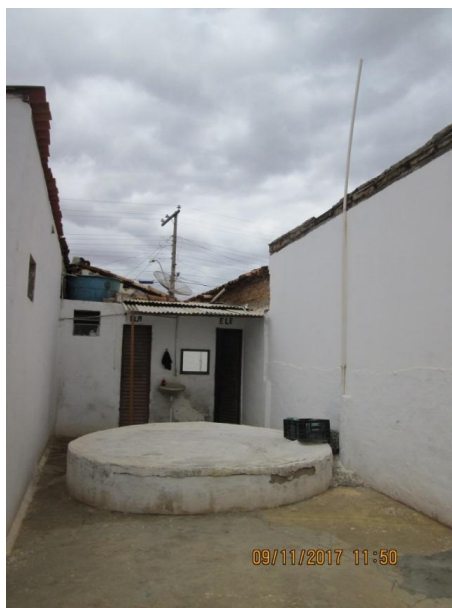
Figura 4-61 – Fossa rudimentar em domicílio na Avenida São Gabriel, na sede de Presidente Dutra.
