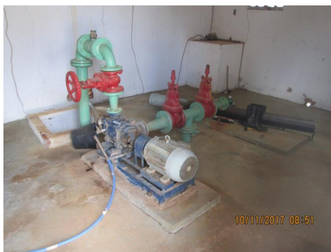
Figura 4-37 – Conjunto moto-bomba da Estação Elevatória de Água da sede de Presidente Dutra
