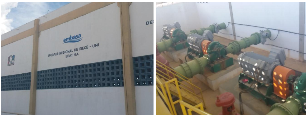
Figura 4-34 – Estação Elevatória de Água Tratada 4A e conjuntos moto-bomba
