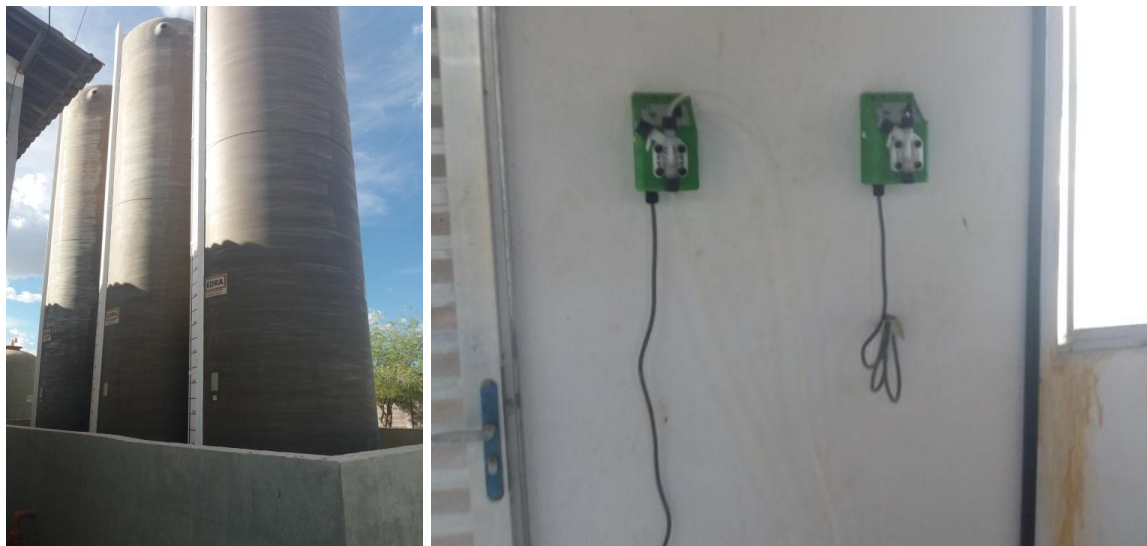
Figura 4-32 – Tinas de sulfato e dosadores de flúor da Casa de Química da ETA Rio Verde
