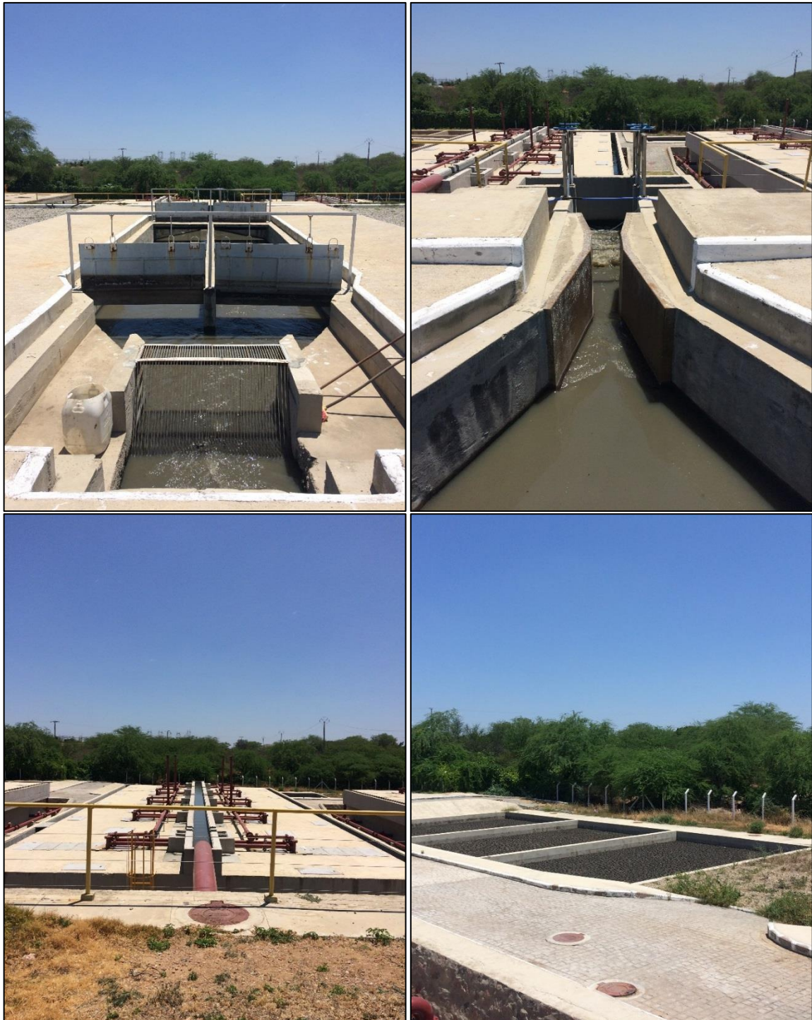
Figura 45 – Componentes da ETE do Sistema Centro. Fonte: DRZ – Geotecnologia e Consultoria, 2017.
