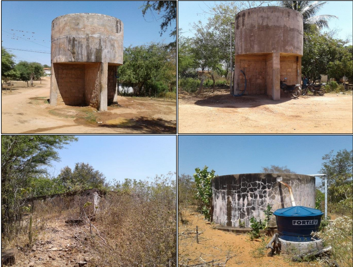
Figura 38 – Reservatórios da Comunidade de Juá.
