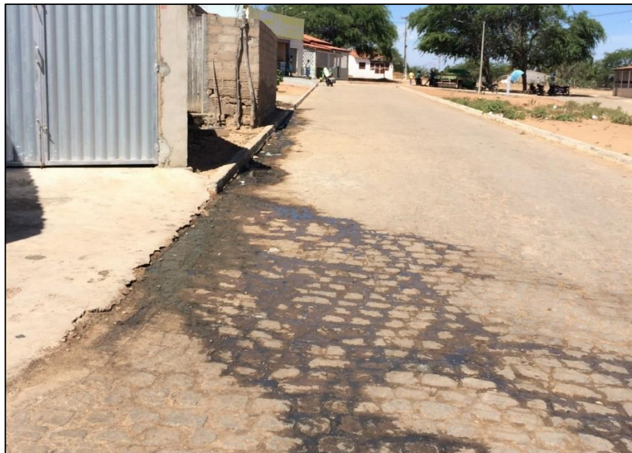
Figura 55 – Efluente de esgoto doméstico lançado em via pública na comunidade de São José.
