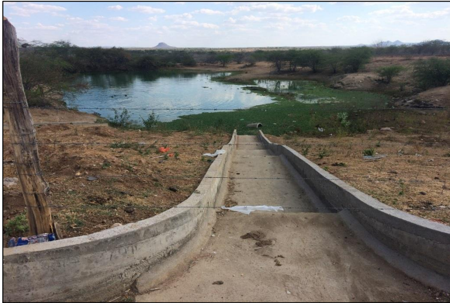
Figura 78 – Reservatório de retenção do tipo a céu aberto e não estruturado com fundo impermeabilizado - Bairro Dom Mario.
