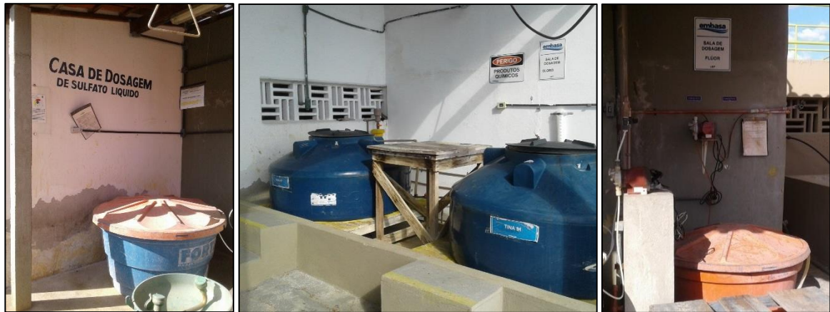
Figura 22 – Misturadores de produtos químicos – sulfato, cloro e flúor. Fonte: DRZ – Geotecnologia e Consultoria, 2017.
