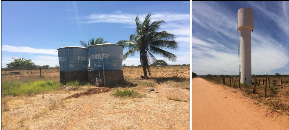
Figura 35 – Reservatórios apoiados (10 m 3 cada) e Reservatório elevado de 50 m 3 da Comunidade de São José.
