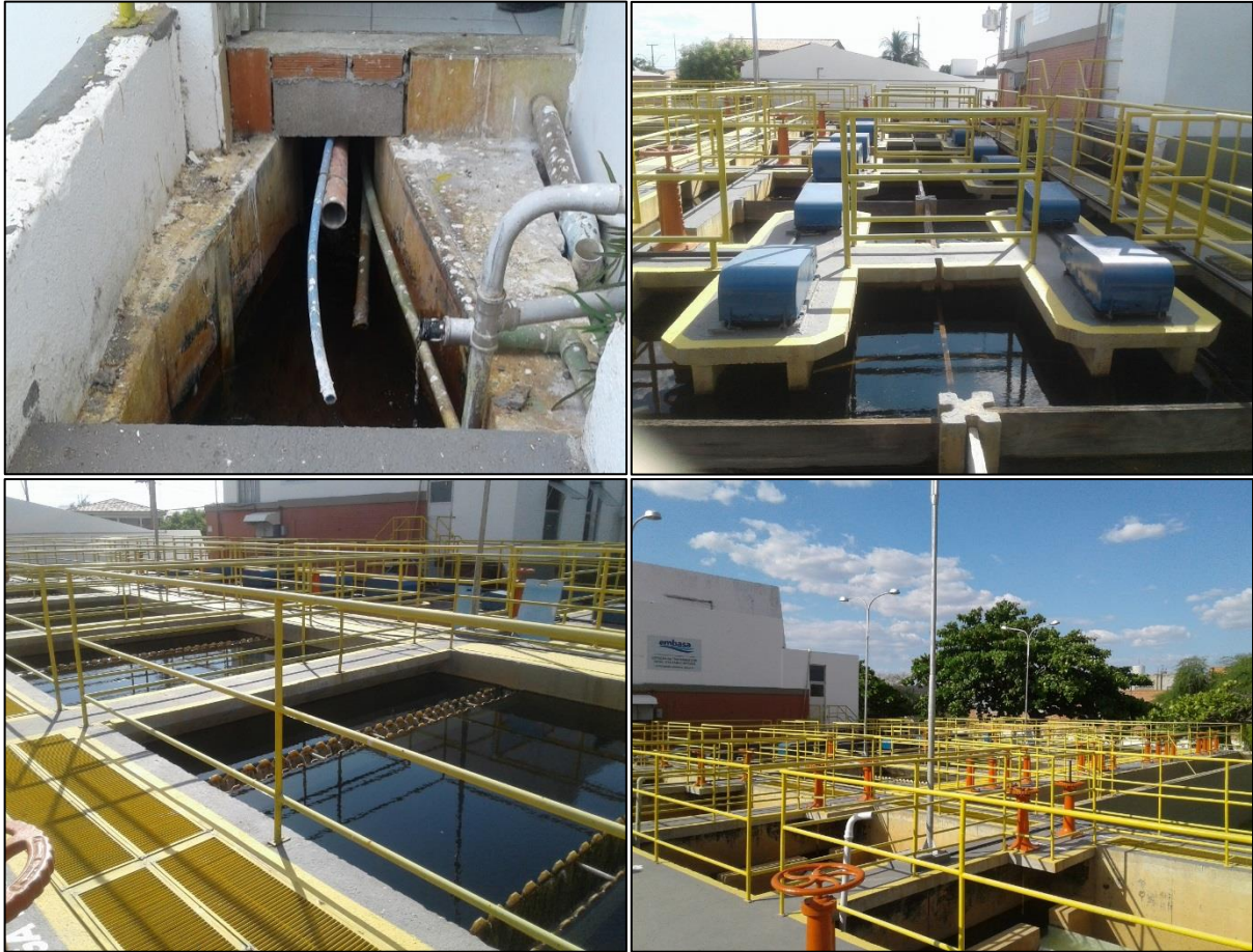
Figura 20 – Componentes da ETA Centro: Calha Parshall, floculadores mecânicos, decantadores e filtros.
