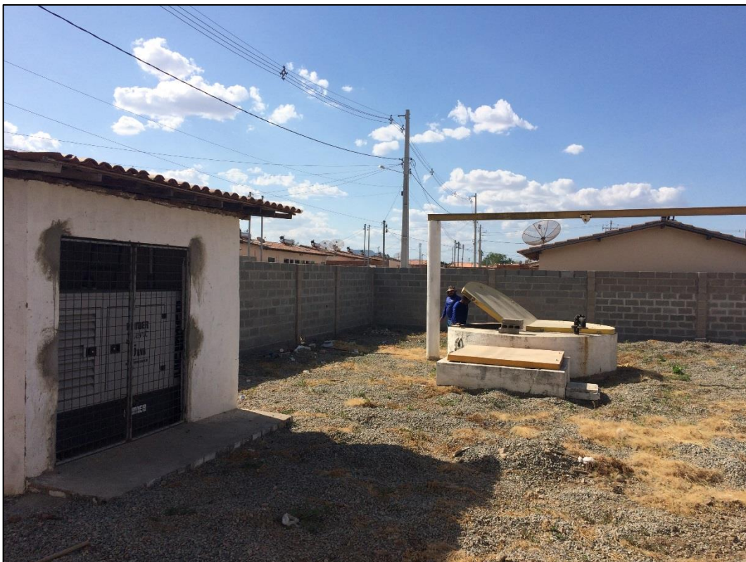
Figura 50 – Estação Elevatória de Esgoto Amanda Moraes.
