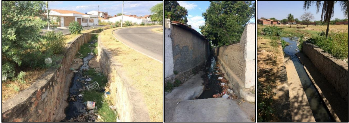
Figura 74 – Sarjetas de drenagem com ligações clandestinas de esgoto.
