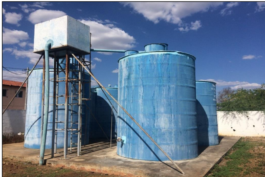
Figura 53 – ETE Beira Rio.
