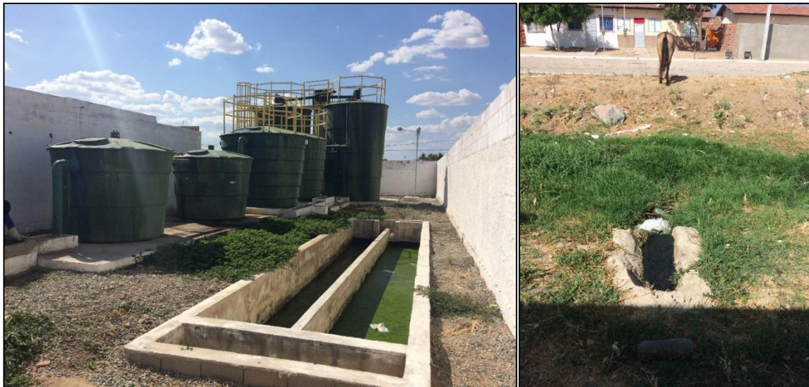
Figura 51 – ETE Amanda Moraes e emissário Fonte: DRZ – Geotecnologia e Consultoria, 2017.
