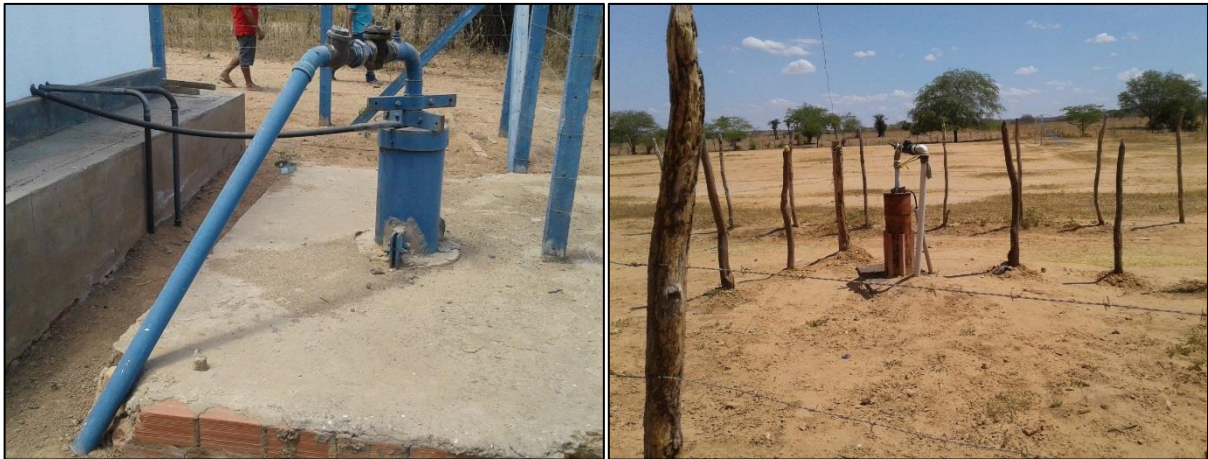
Figura 41 – Poço 1 e poço 2 da comunidade de Várzea.
