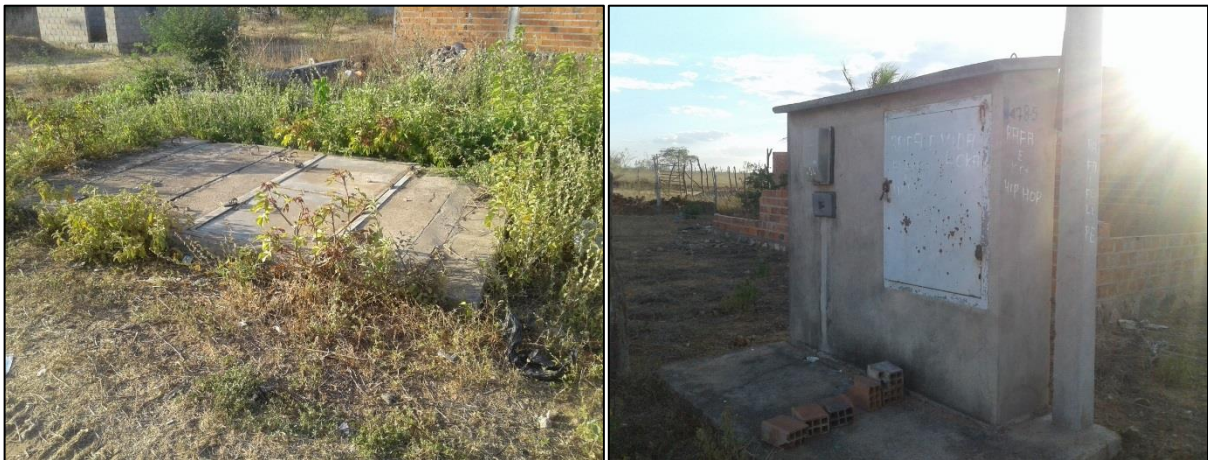
Figura 19 – Booster e quadro elétrico. Fonte: DRZ – Geotecnologia e Consultoria, 2017.
