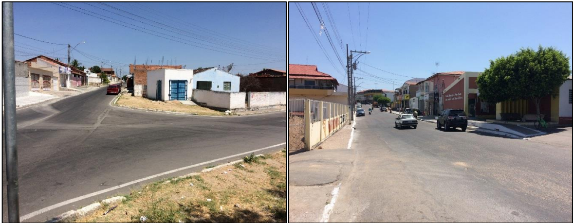
Figura 84 – Pontos com histórico de alagamento devido à insuficiência de rede de drenagem – BTN.
