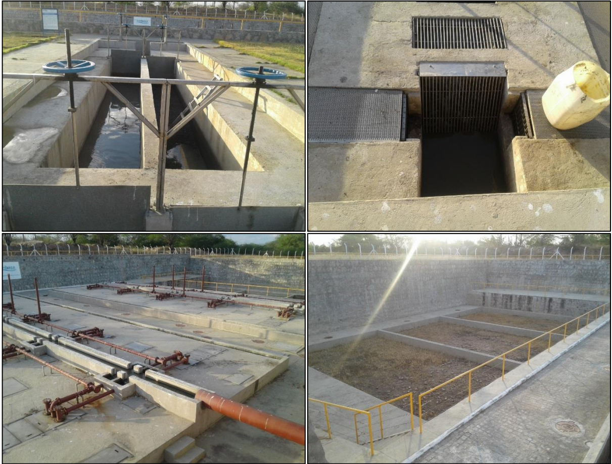
Figura 48 – Componentes da ETE do Sistema BTN. Fonte: DRZ – Geotecnologia e Consultoria, 2017.
