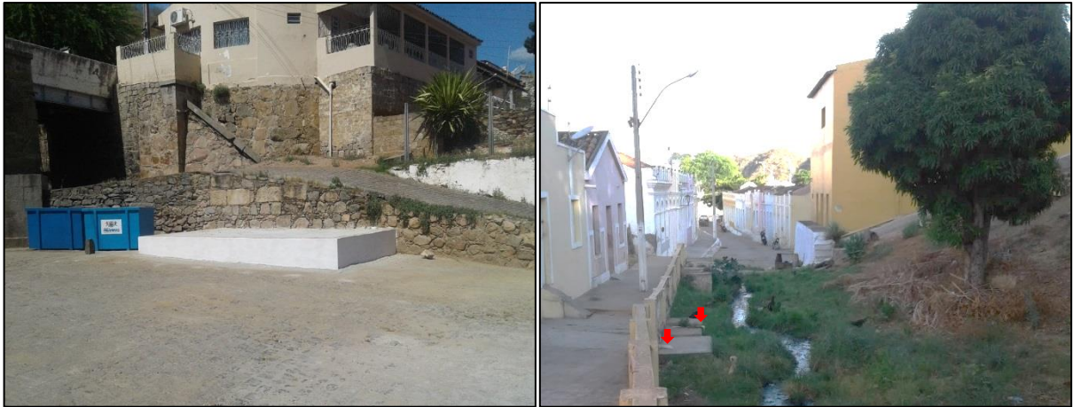
Figura 52 – Fossa coletiva instalada no Centro Histórico e fossas individuais instaladas no leito do afluente do rio São Francisco.
