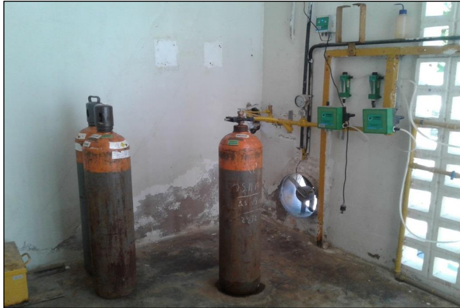
Figura 25 – Dosador de cloro gasoso.
