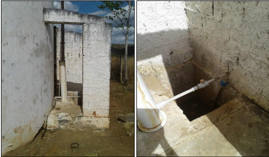
Figura 32 – Sistema de tratamento de água do distrito Entremontes. Fonte: DRZ – Geotecnologia e Consultoria, 2017.
