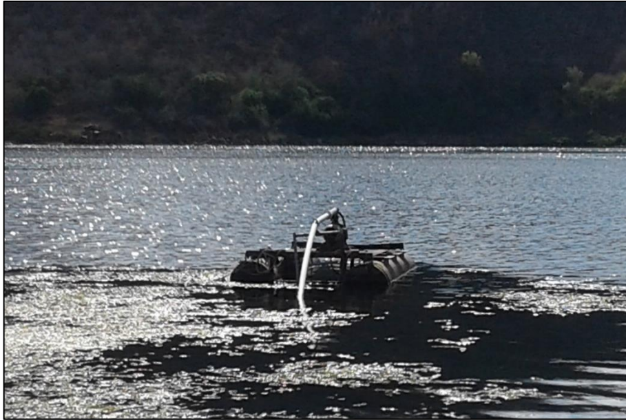
Figura 31 – Captação superficial do distrito Entremontes no rio São Francisco.
