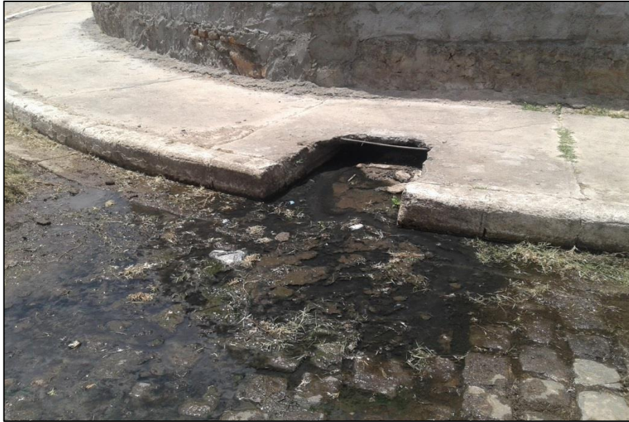
Figura 80 – Dispositivo para captar água de chuva no Bairro Nossa Senhora da Saúde com esgotamento sanitário.
