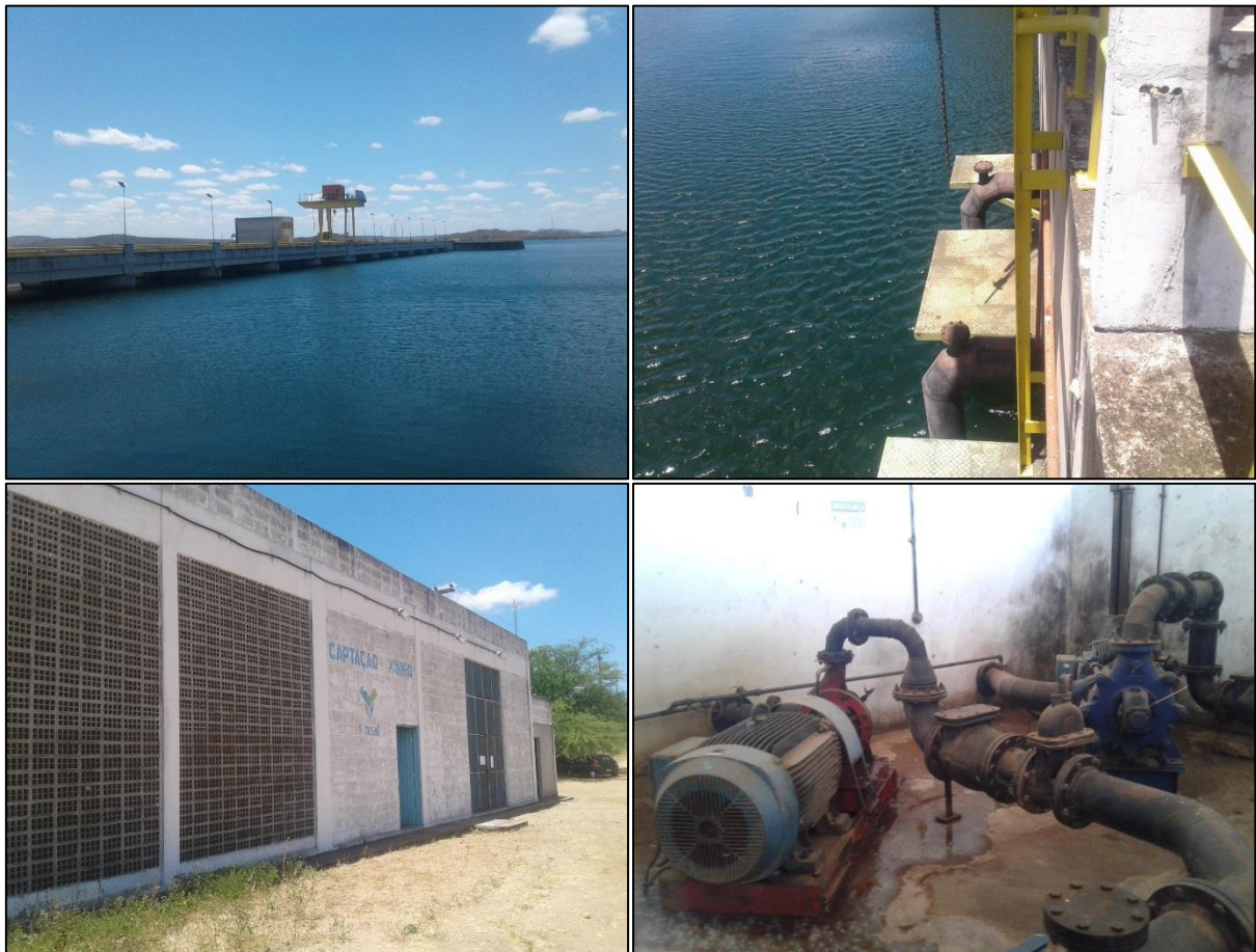
Figura 18 – Captação superficial no rio São Francisco, casa de bombas e bombas de captação: distrito Sede.
