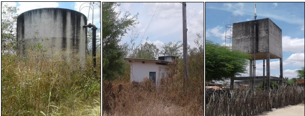
Figura 42 – Reservatórios e EEAT de Lagoa Nova.
