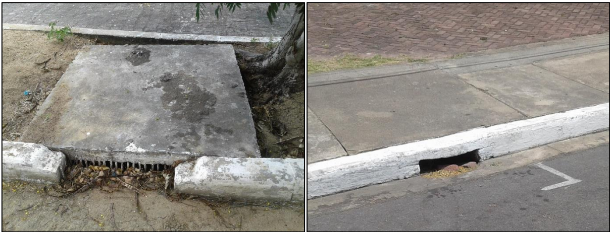
Figura 72 – Exemplos de bocas de lobo utilizadas em Piranhas.
