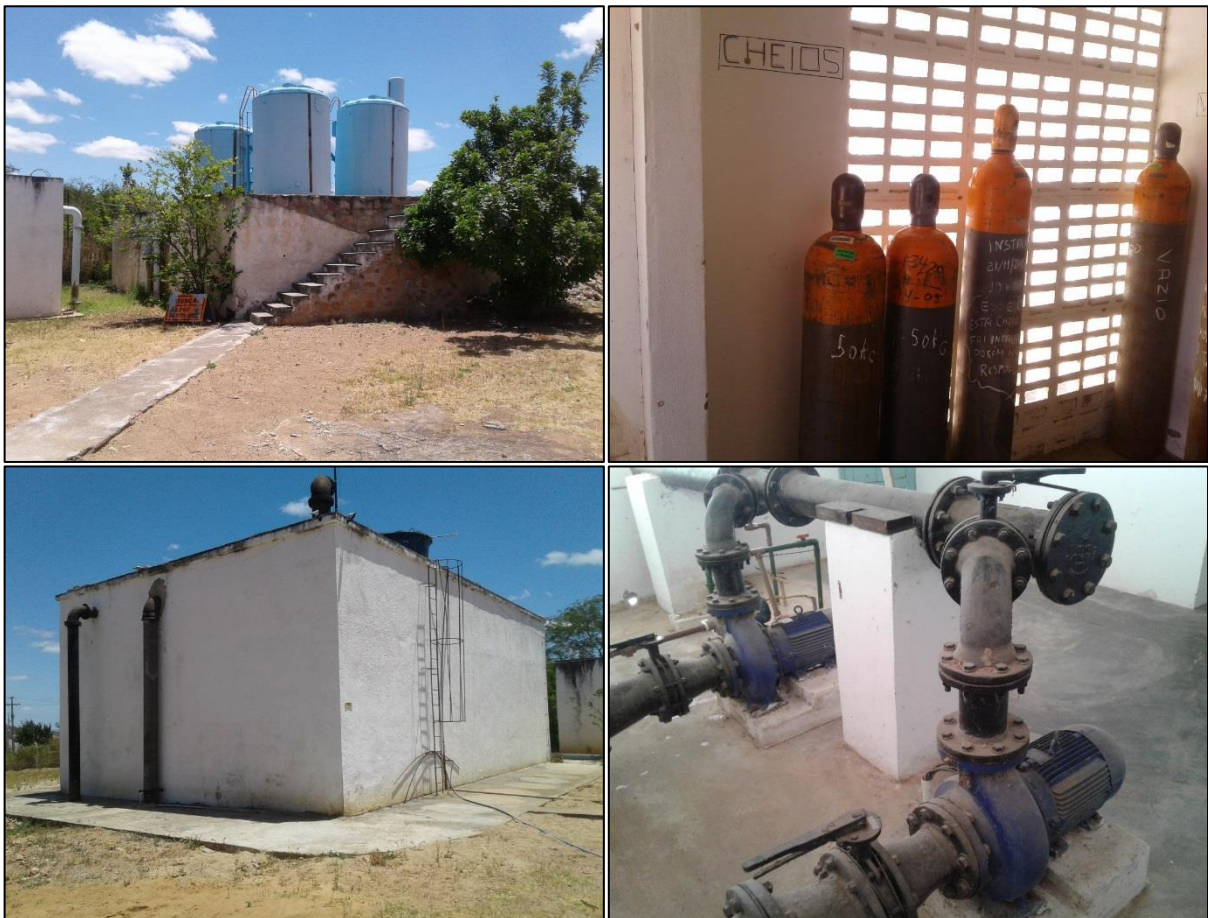
Figura 39 – Processo de simples desinfecção, cilindros de cloro gasoso, RAP e EEAT, respectivamente: ETA ODC.
